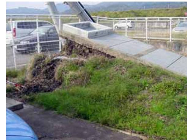
写真 6-7 浄化槽の浮き上がり
