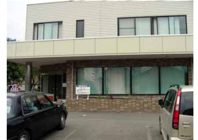
写真 8-7 新しい建物はほとんど無事であった。た だし、窓ガラスは割れている
