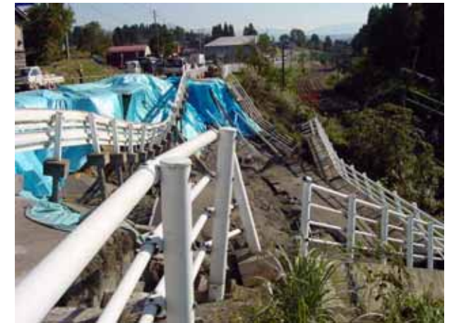
写真 4-15 国道17号線の路肩のすべり崩壊
