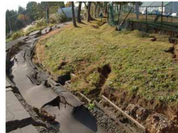
写真9-11 校庭周辺法肩道路の崩壊(校庭から法面にかけて多数の開口クラックが発生している。)
