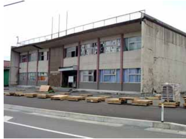
写真 8-2 壁に大きな亀裂が入り変形した2階建 コンクリート建物(桜町)
