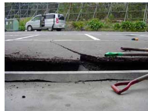
写真 8-10 建物入口から見た周辺地盤との段差
