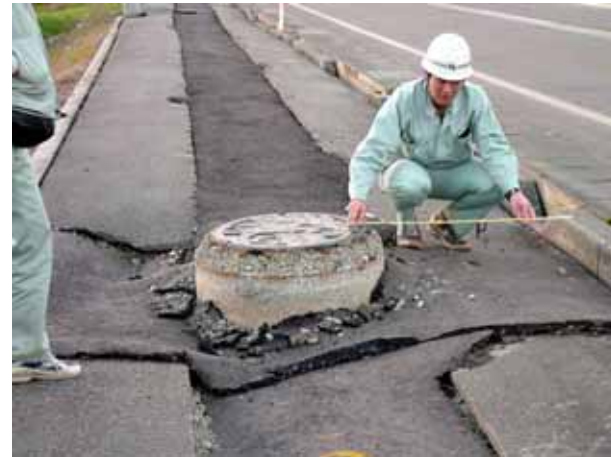
写真 6-2 マンホールの突出地盤の陥没
