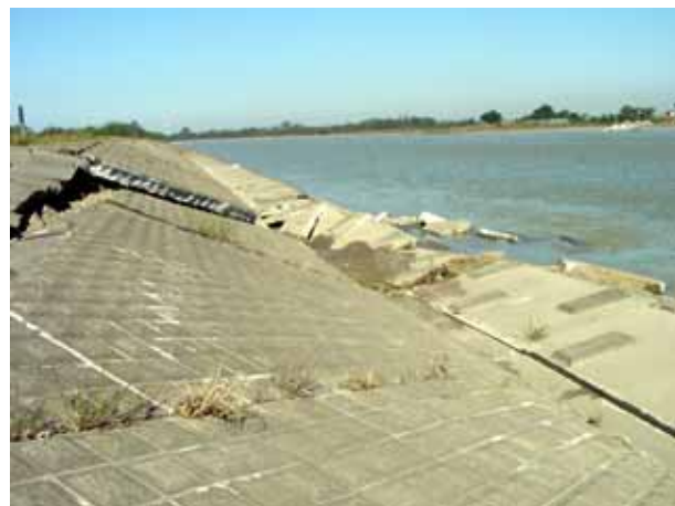
写真 3-4 信濃川左岸の護岸崩壊
