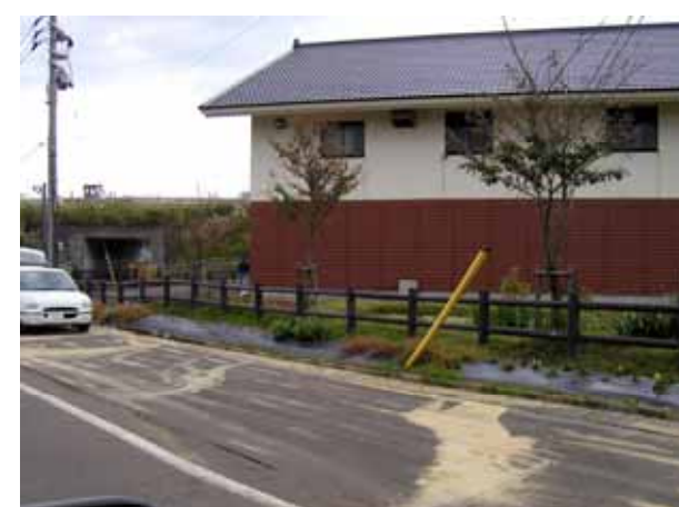
写真 6-6 下水処理場脇の噴砂
