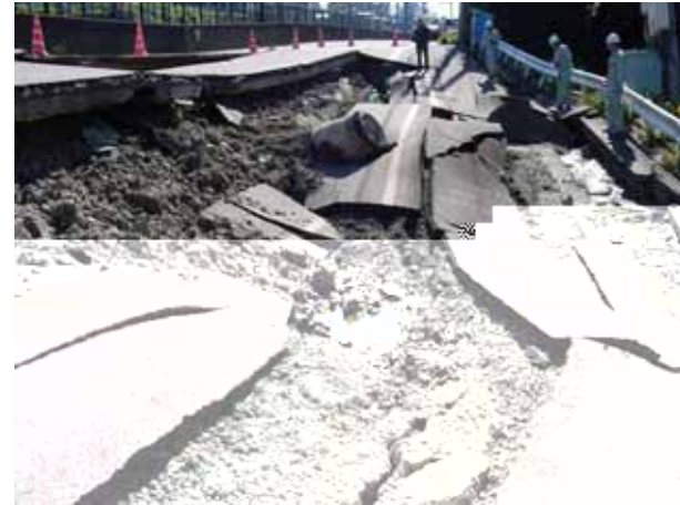
写真 5-12 路肩の崩壊の近景。マンホールの一部が見える。
