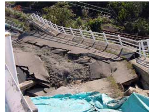
写真 4-16 崩壊して滑り落ちた道路
