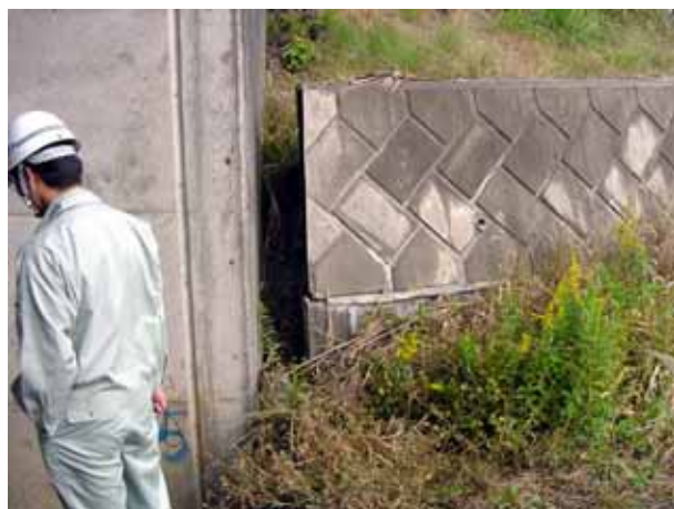
写真 5-4 カルバートと盛土擁壁の隙間。盛土のはらみ出しによって出来たものであろう
