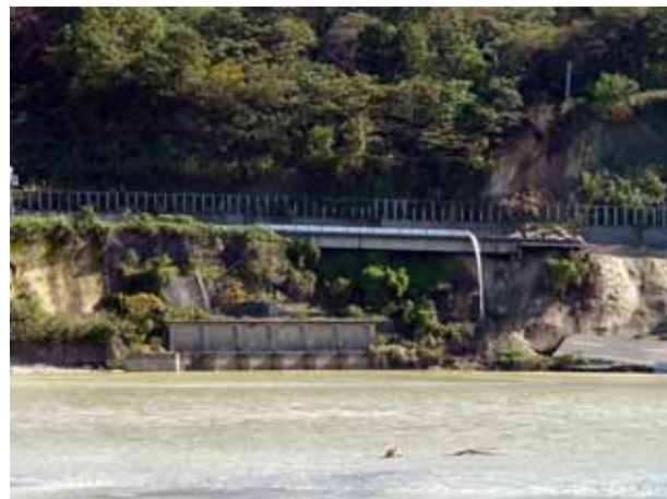
写真 7-3 同左 崩壊下流部の近景。道路舗装が滑り落ち、ガードレイルが垂れ下がっている。
