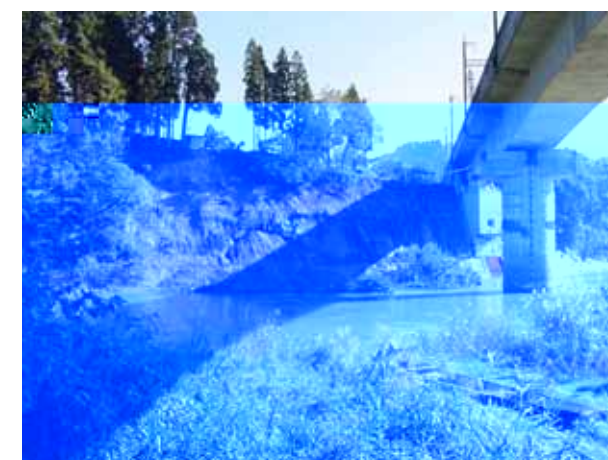
写真 4-8 新幹線橋梁南側斜面に見られた崩壊
