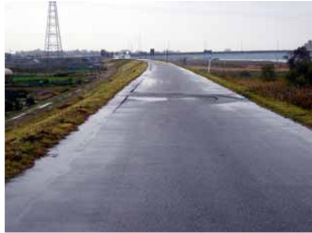
写真 3-2 信濃川左岸(小千谷市三仏生)の堤防の横断クラック
