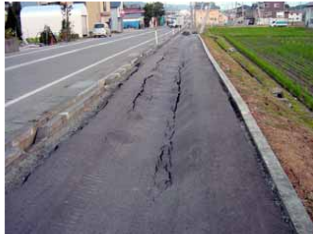
写真 6-1 下水道管路埋設地盤の陥没
