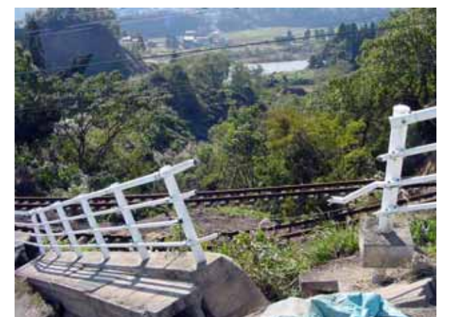
写真 4-17 路盤が崩壊して宙づりになった線路
