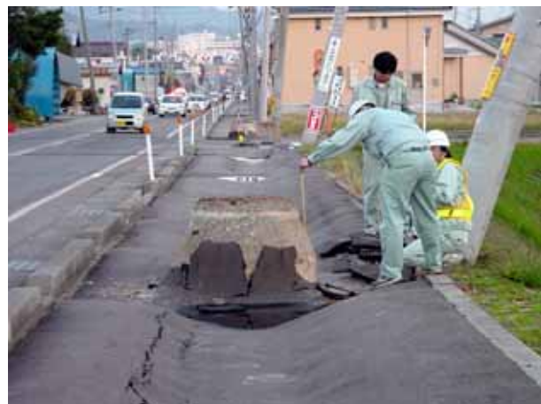
写真 6-3 マンホールの突出
