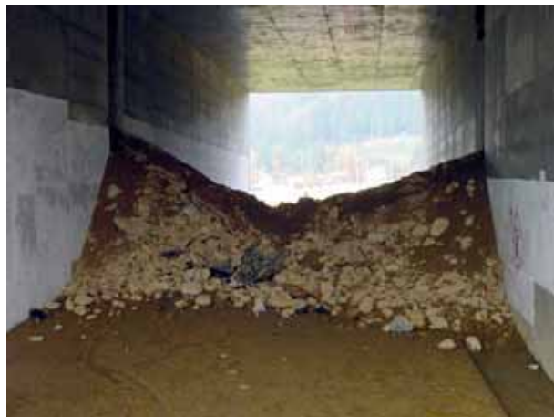
写真 5-2 開口して土砂が流入したカルバート内部
