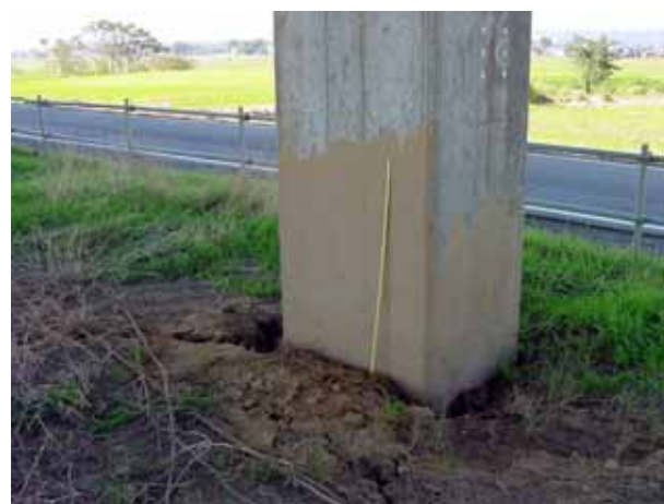
写真 4-3 橋脚基部に見られた泥の痕跡
