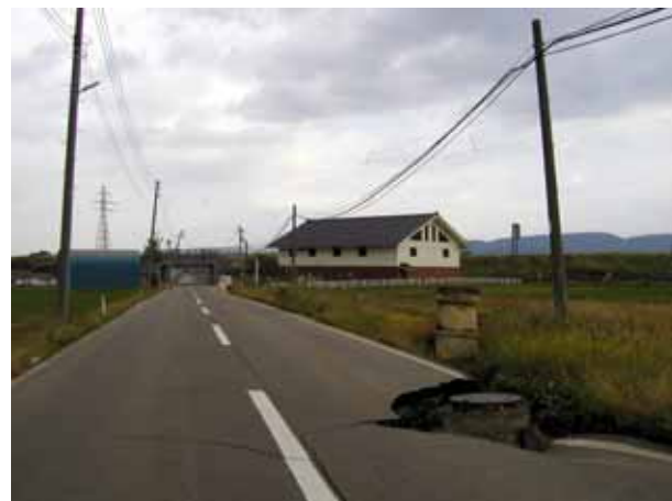
写真 6-5 下水処理場手前のマンホールの突出
