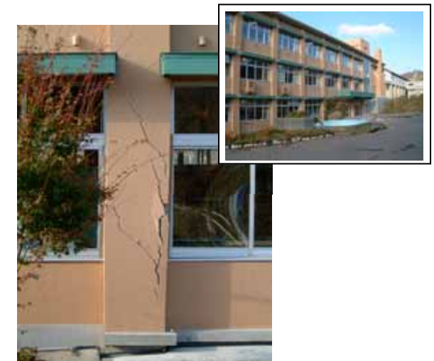
写真9-12 柱に生じた亀裂(3階建てのRC建物の1階部分の柱)
