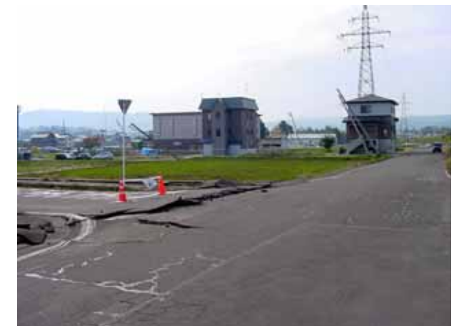
写真 6-9 配電柱が大きく傾斜した桜町地区
