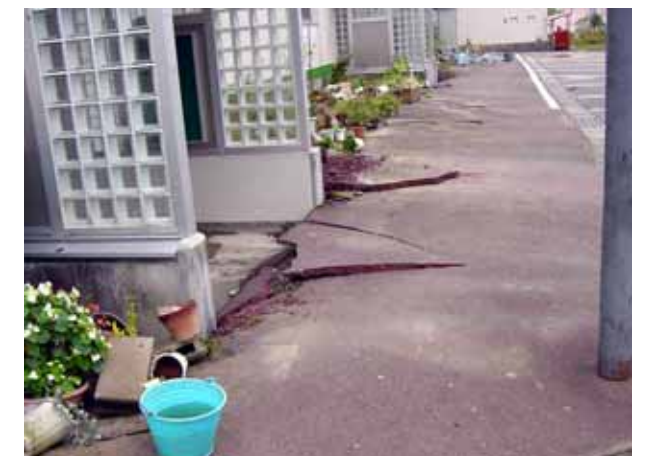
写真 8-9 建物玄関部分のめり込みの状況
