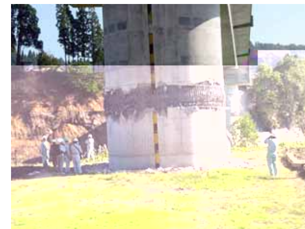
写真 4-6 新幹線橋脚のコンクリート剥落
