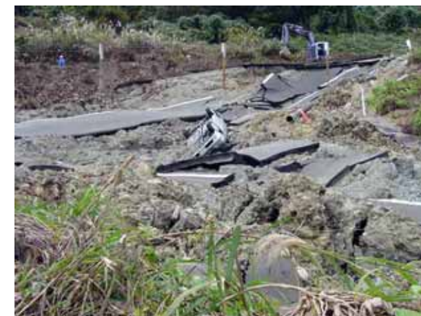
写真 5-18 川井大橋北側の崩壊箇所。道路は斜面端の盛土と思われる
