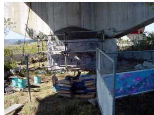
写真 5-9 右岸側第1橋脚のコンクリートが一部剥落したが、調査時には補修されていた。
