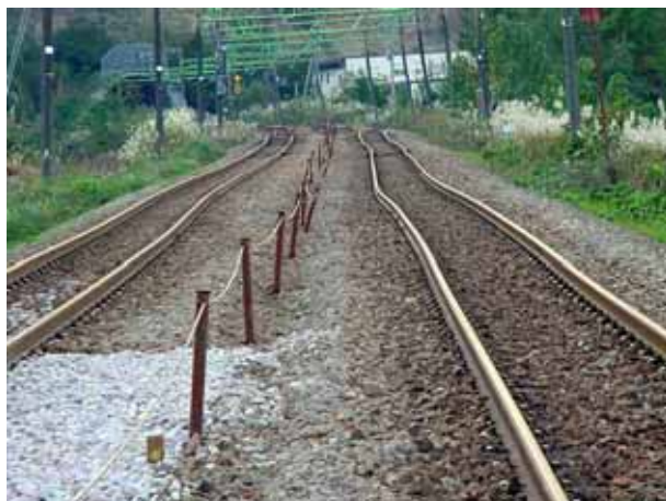
写真 4-14 崩壊地点西側の線路の蛇行。前方は和南津トンネル
