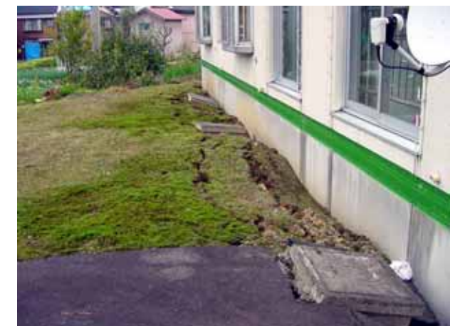
写真 8-11 建物裏のめり込みの状況
