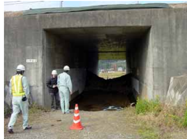
写真 5-1 開口・沈下したボックスカルバート(小千谷2)
