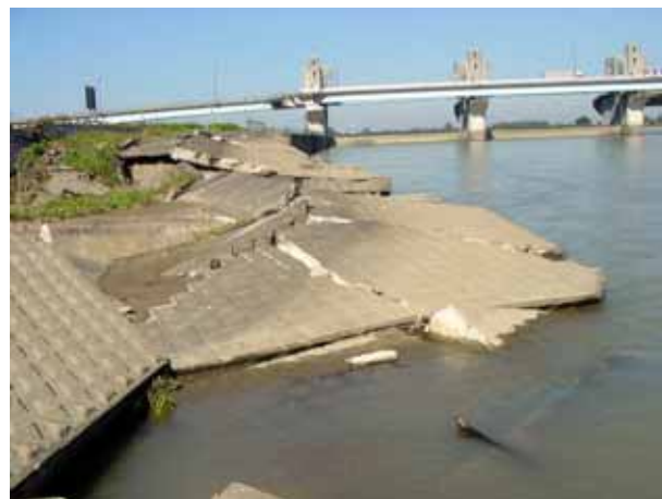
写真 3-5 信濃川左岸の護岸崩壊。向こう側に見えるのは越の大橋
