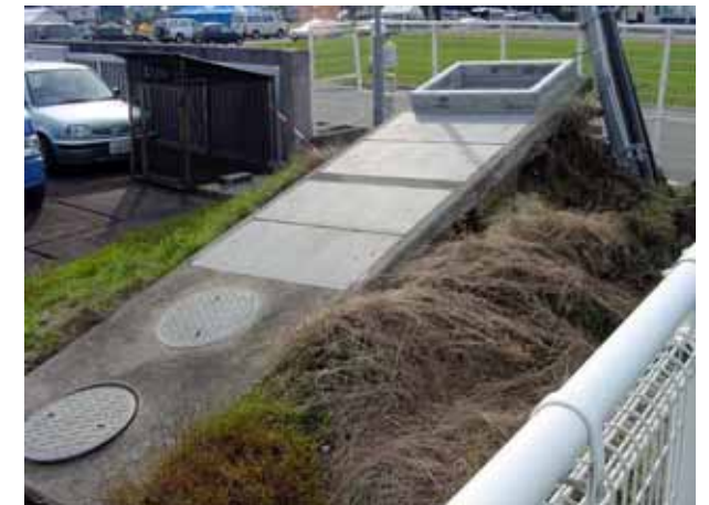
写真 6-8 浄化槽の浮き上がり
