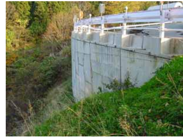
写真9-6 道路盛土の被害(補強土壁と思われる)
