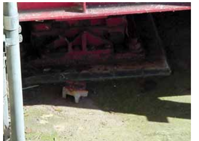
写真 5-10 左岸側橋台の支承金具の一部欠落
