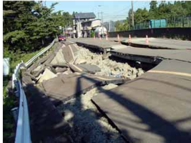
写真 5-11 路肩の崩壊の様子
