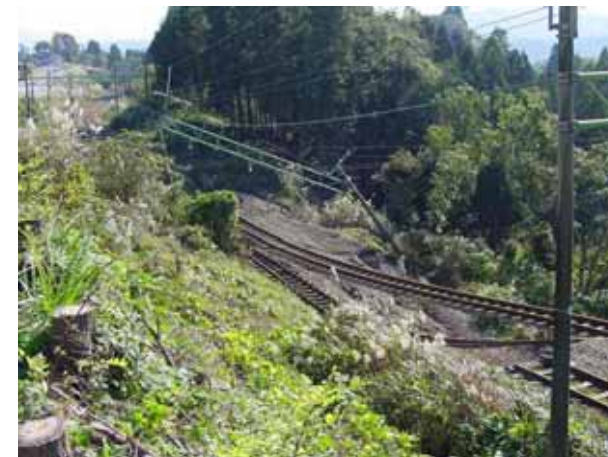
写真 4-18 路盤が崩壊して宙づりになった線路
