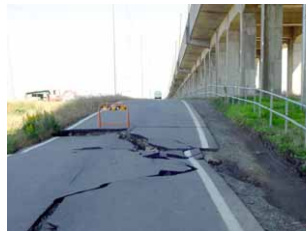
写真 4-4 橋脚被害箇所で見られた道路の陥没
