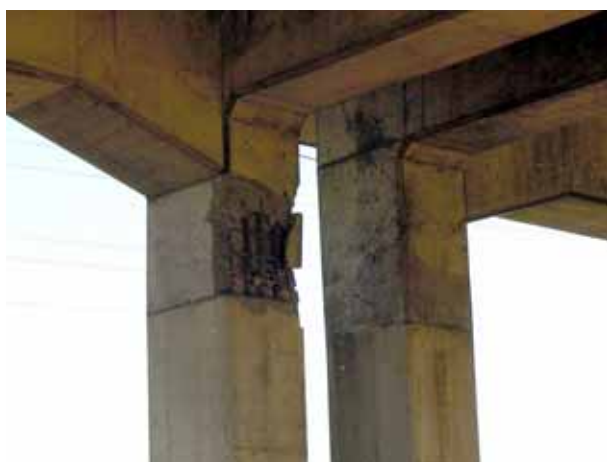
写真 4-2 脱線箇所の100m程南側で見られた高架橋脚のコンクリート剥落
