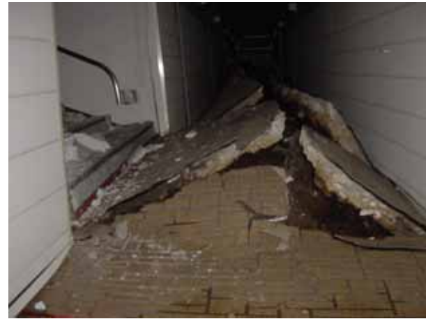
写真 4-11 地下通路の横断部。床のコンクリートが70cmほど持ち上がっている
