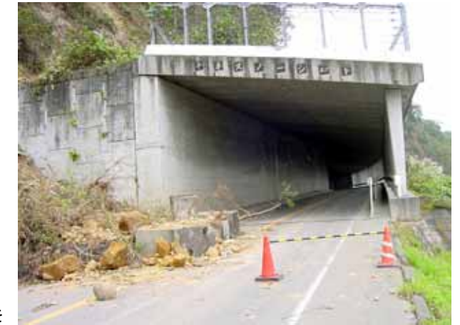
写真 7-11 崩落土砂がスノーシェッド前の道路を塞ぐ
