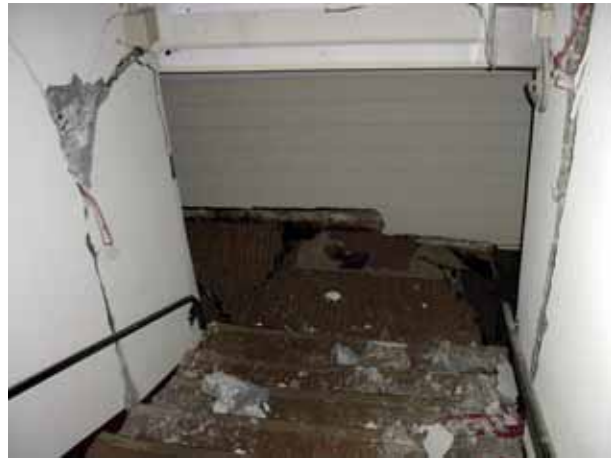
写真 4-10 地下通路の降り口。壁のモルタルが一部剥落している
