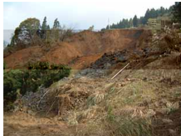
写真9-3 崩壊下部より上部を望む
