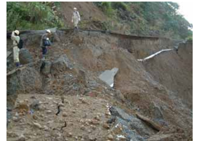
写真9-7 崩壊した道路盛土
