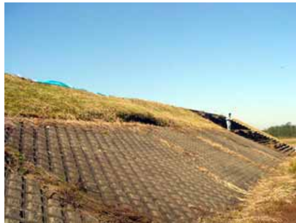
写真 3-3 堤体のり面のはらみ出し
