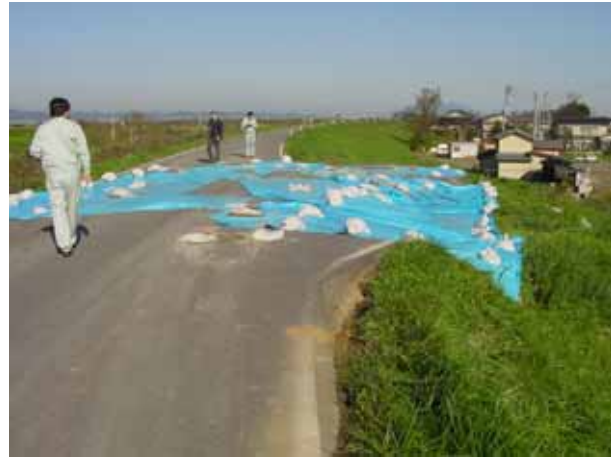
写真 3-1 信濃川堤防右岸(長岡市黒津町)の被害
