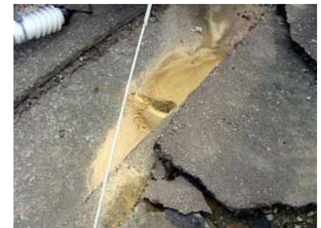
写真 6-11 倒壊した配電柱脇の地盤の噴砂
