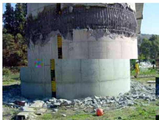
写真 4-7 コンクリート剥落のクローズアップ。地面にはコンクリート片とともに帯鉄筋と思われる鉄筋が見られる。
