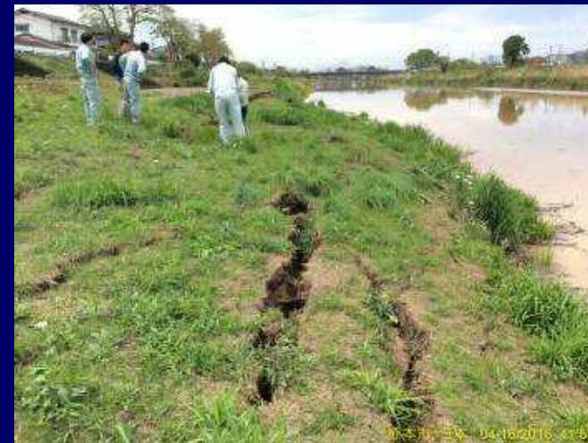
木山川左岸の変状(本震後)
