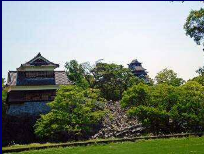
熊本城戌亥櫓付近の石垣と櫓の崩壊
