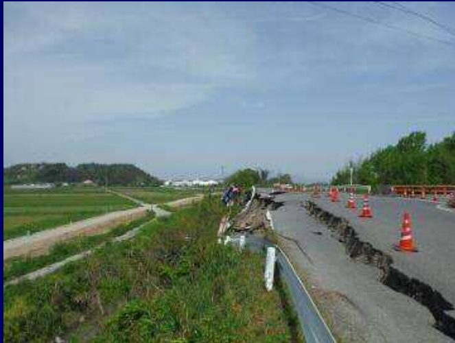
乙女橋左岸の法面崩壊(前震後)
