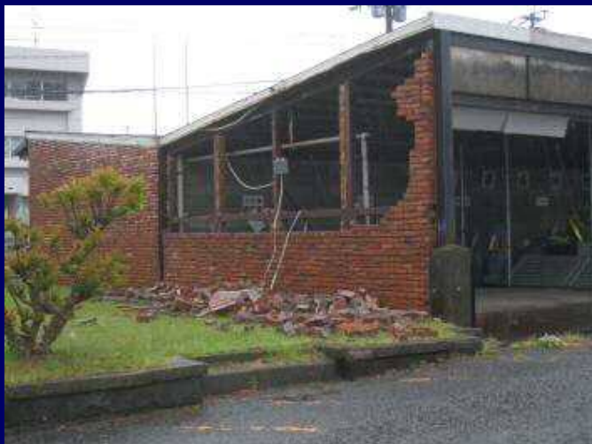
レンガ壁車庫の被害 (宇土市役所)
