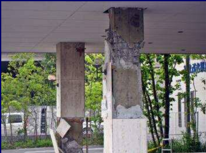
病院 1 階ピロティ柱のせん断破壊（益城町古閑）
