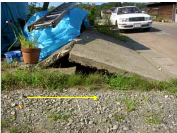
写真4.4.17 道路のバックリング
