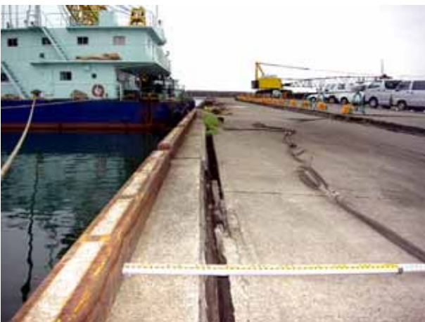
写真4.2.15 北西側泊地岸壁のはらみ出しと背後地盤の開口・亀裂
