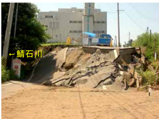
写真4.1.11 路面の陥没と鯖石川方向への移動
