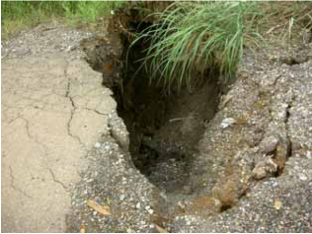
写真4.3.29 海岸堤防小段で見られた陥没孔
