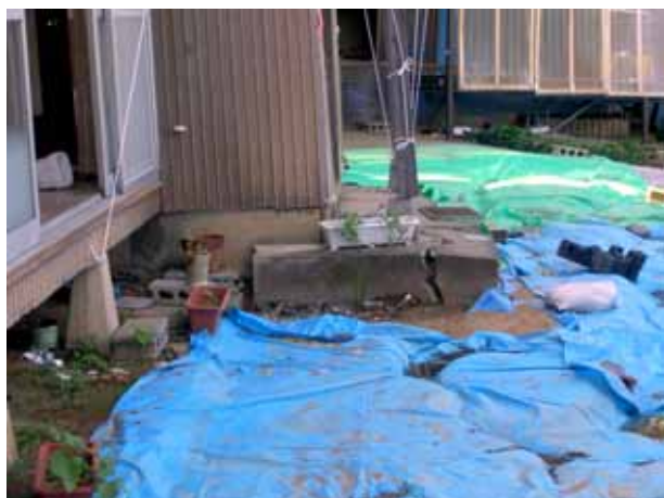
写真4.4.9 地盤変状によってヒビが入った玄関タタキ
