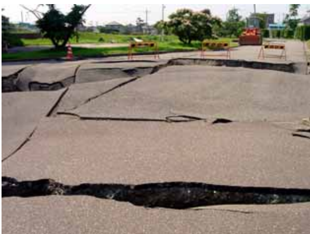
写真4.5.26 構内道路の亀裂・陥没
