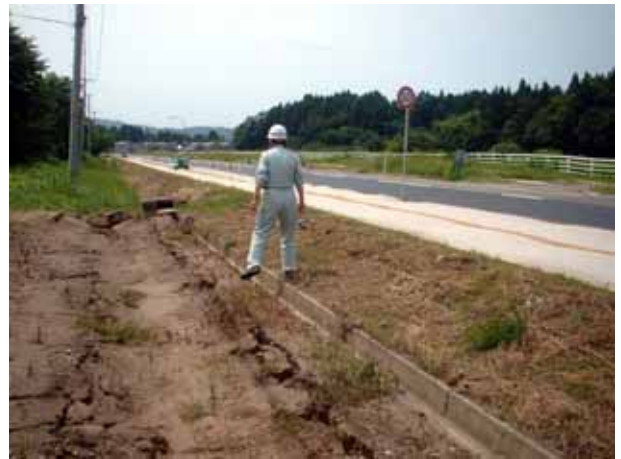
写真4.7.21 道路横の空地に生じていた噴砂
