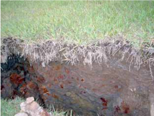
写真4.7.15 地割れの様子
