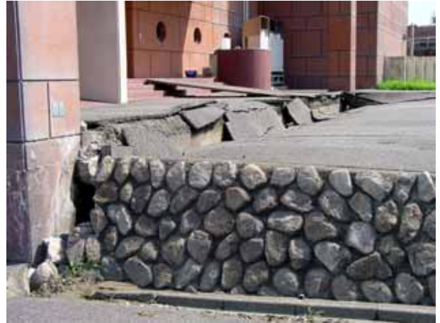
写真4.5.9 同左。玄関前の地盤沈下近景
