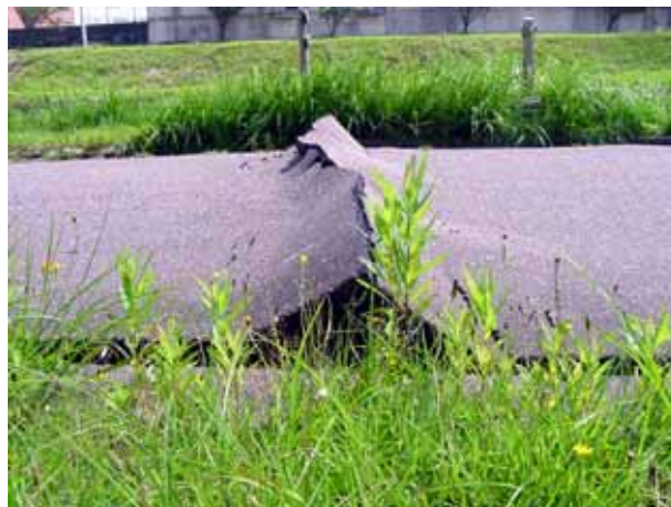
写真4.5.25 構内道路の隆起
