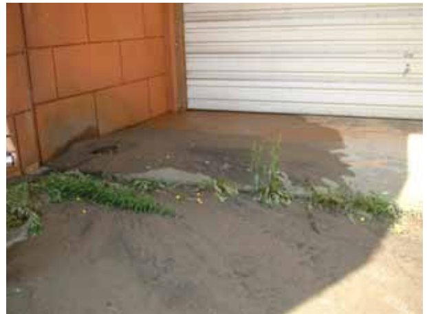
写真4.7.4 地下室搬入路に生じた噴砂
