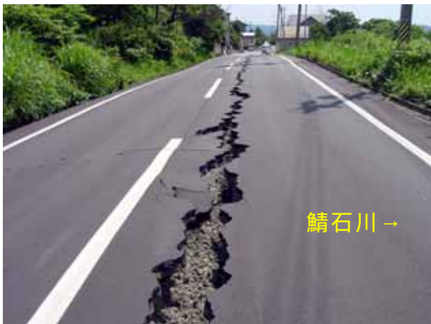
写真4.1.15 鯖石川方向に引き裂かれるようにして生じた縦断亀裂
