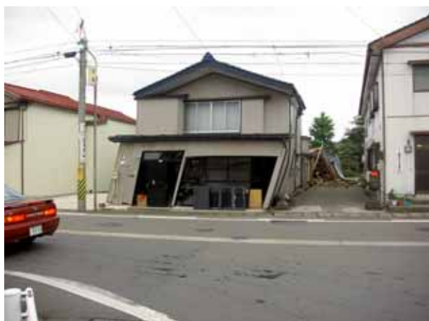
写真4.4.27 1階間口が大きい住宅のせん断変形（柏崎市米山町）
