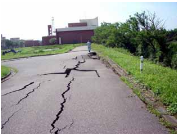
写真4.5.22 マンホール傍の亀裂と陥没
