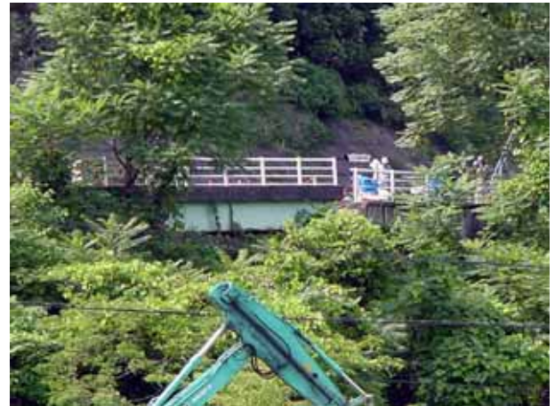
写真4.1.28 滑落地点東側の橋梁取り付け部の沈下
