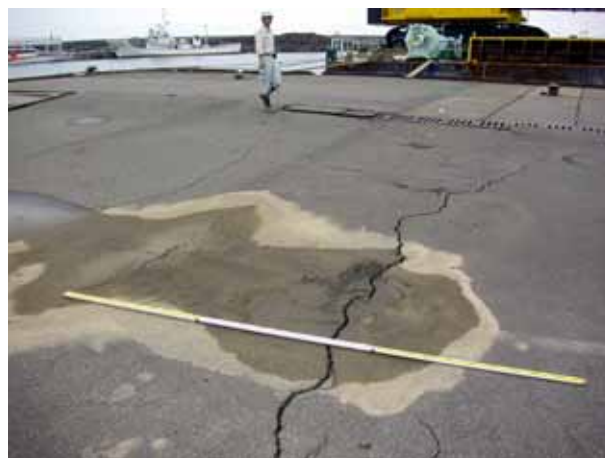
写真4.2.22 背後地盤の亀裂沿いに噴き出した噴砂
