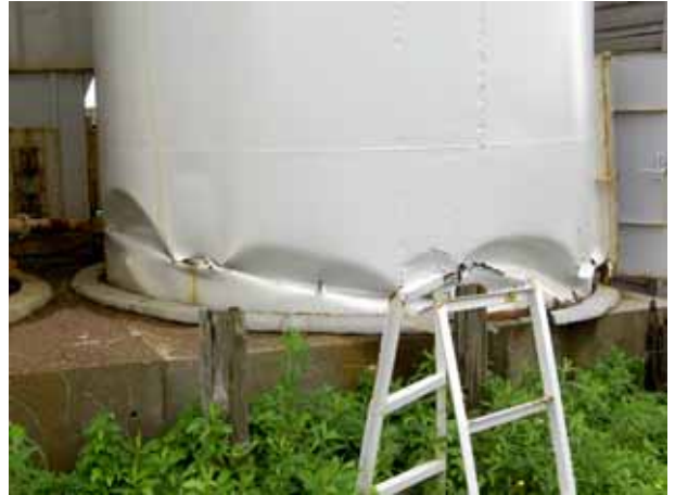
写真4.4.36 サイロ基部の座屈
