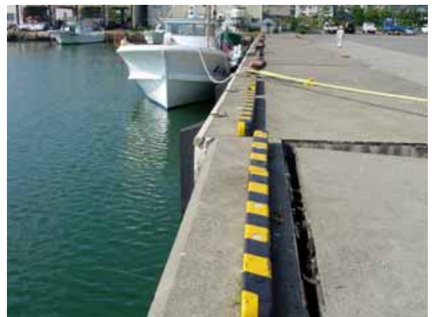
写真4.2.16 南東側泊地岸壁のはらみ出し
