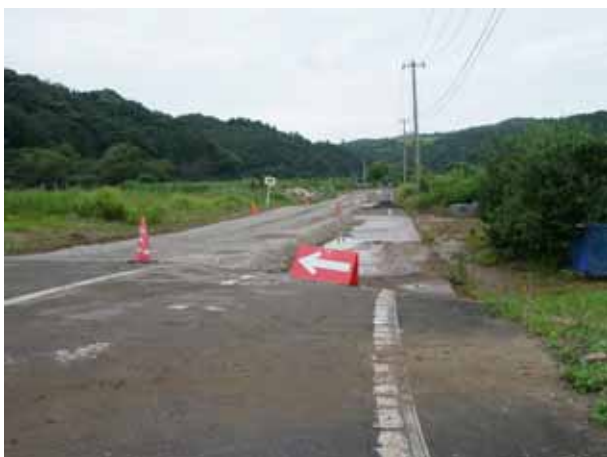
写真4.1.21 湿地帯を通る道路の沈下
