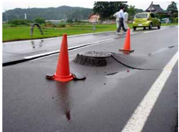
写真4.5.32 車道上のマンホールの突出( 西山町五日市 )
