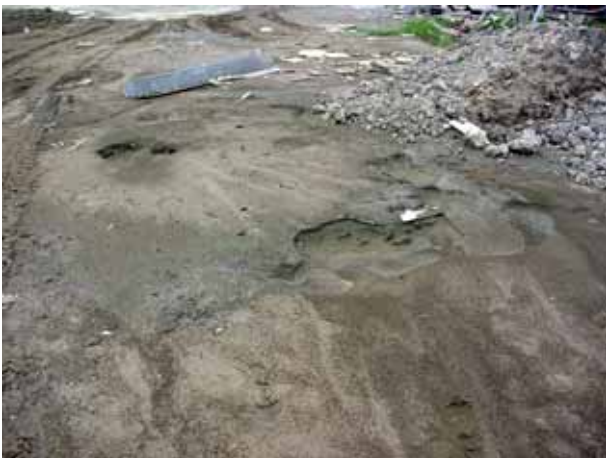
写真4.4.37 被害施設近傍の噴砂
