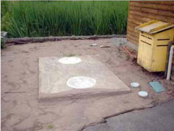
写真4.7.25 噴砂と浄化槽の浮き上がり
