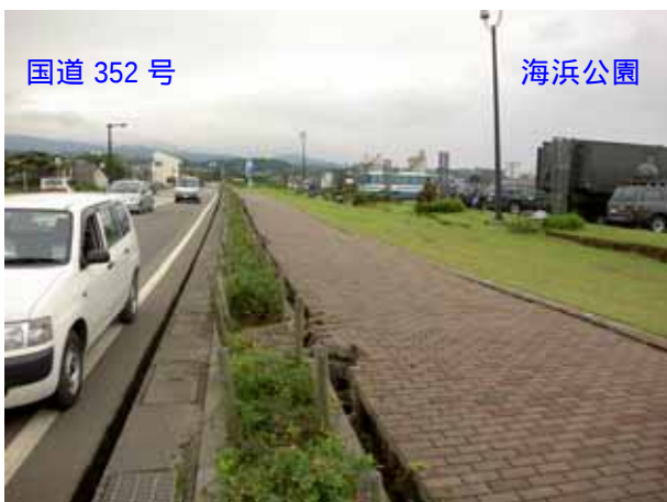
写真4.2.24 国道352号の歩車道境界にできた開口亀裂
