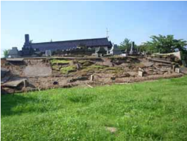
写真4.4.19 墓地の擁壁の転倒 (柏崎市西本町)
