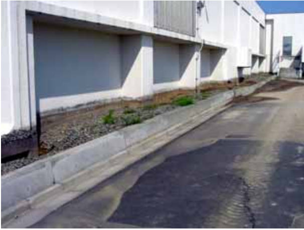
写真4.5.18 エアレーションタンク建物側面の地盤沈下跡
