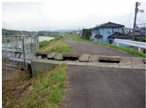
写真 4.5.38 堤防の沈下によりU字溝から飛び出した管路
