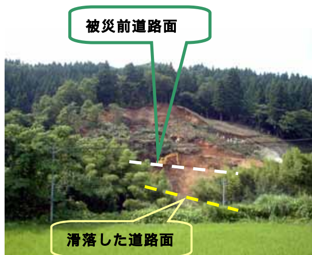
写真4.1.23 滑落斜面現場遠景
