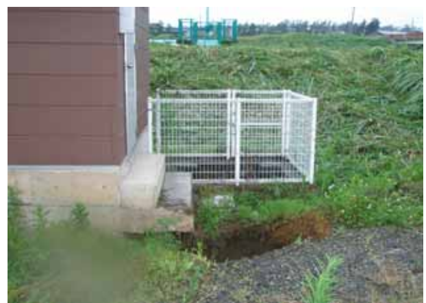
写真4.3.8 開運橋左岸下流側の穴
