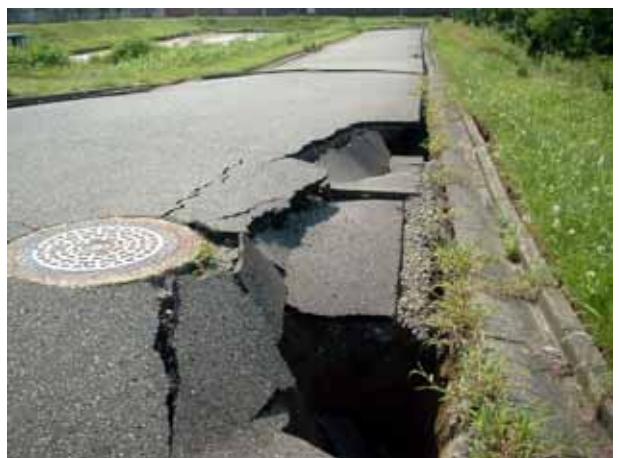
写真4.5.23 同左。マンホール傍の地盤の亀裂と陥没
