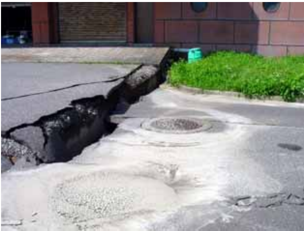
写真4.5.6 管理棟裏側道路の亀裂と段差
