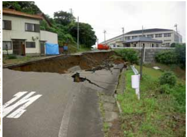
写真4.1.6 路面に生じた滑落約1.5m
