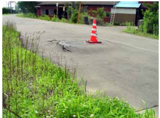
写真4.5.30 マンホールの突出( 柏崎市吉井 )
