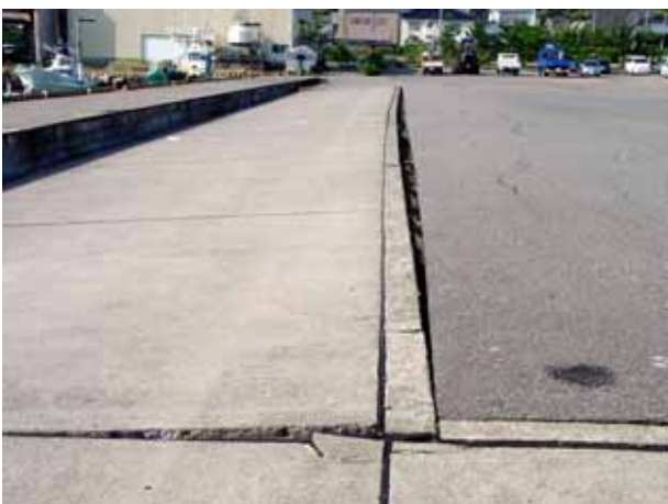
写真4.2.19 岸壁背後の沈下と海側への移動
