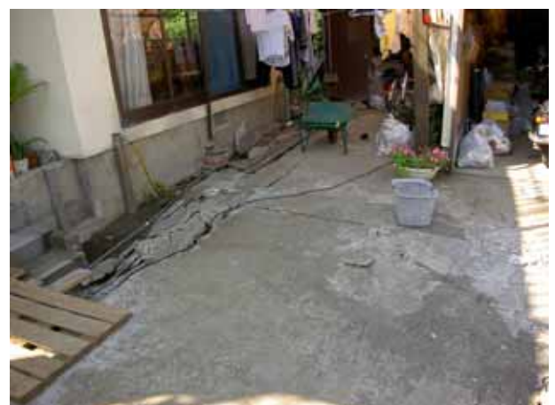
写真4.4.18 住宅庭先の亀裂
