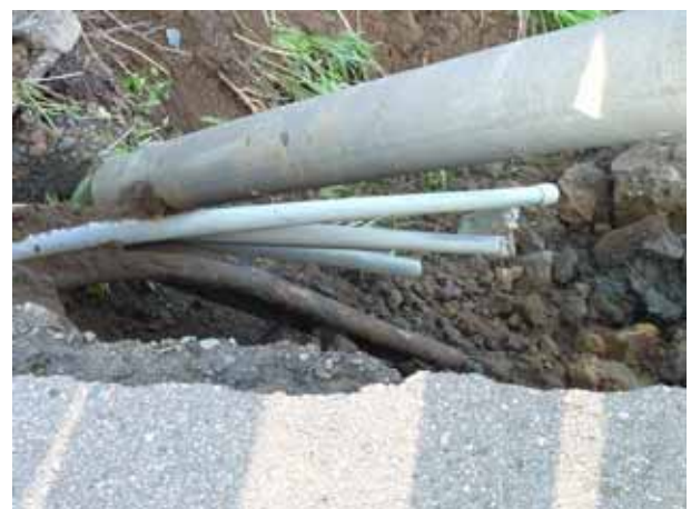
写真4.5.42 道路崩壊部の電柱および地中埋設管
