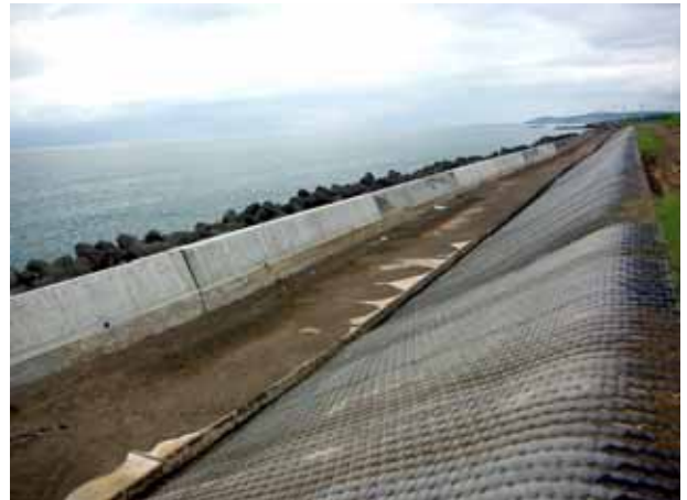
写真4.3.18 一面に噴出した護岸背後の噴砂
