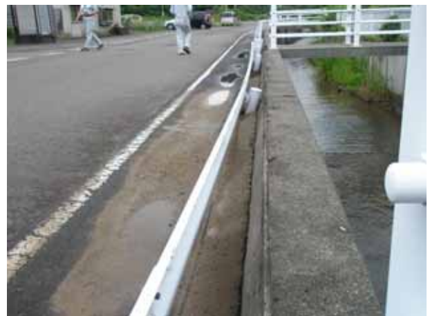
写真4.1.22 路面の沈下とガードレールの支持ボールの陥没
