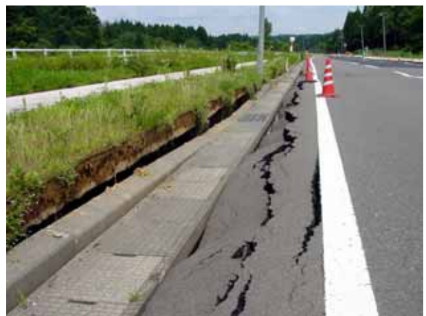
写真4.1.5 車道部の大きな沈下
