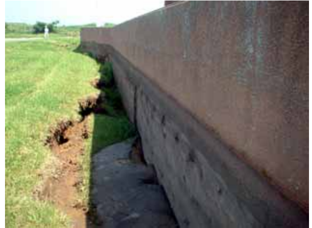
写真4.5.15 同左近景。盛土が大きく沈下し、擁壁の側面には噴砂が見られる
