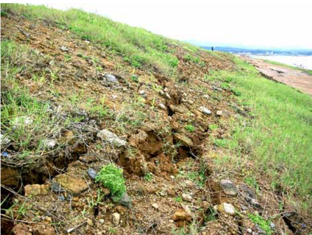
写真4.3.27 堤防のり面の亀裂
