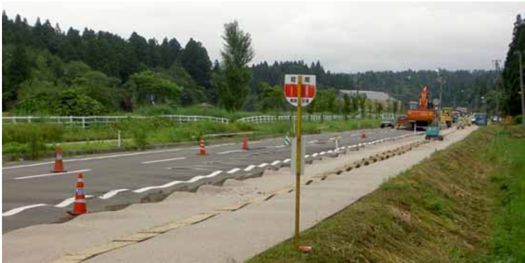
写真4.1.1 路肩から歩道において約2.3mの周期で波状の沈下
