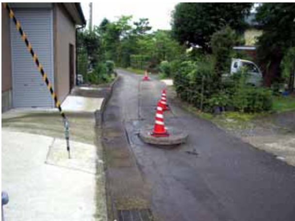
写真4.5.31 マンホールの突出( 柏崎市上田尻 )
