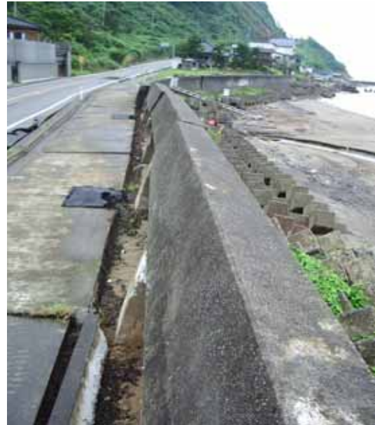
写真4.3.14 防潮護岸の傾倒
