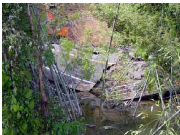
写真4.1.25 滑落した道路面
