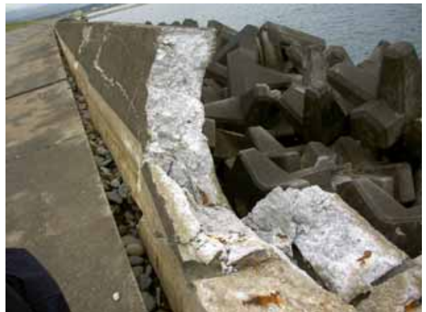
写真4.3.20 破壊した護岸上部
