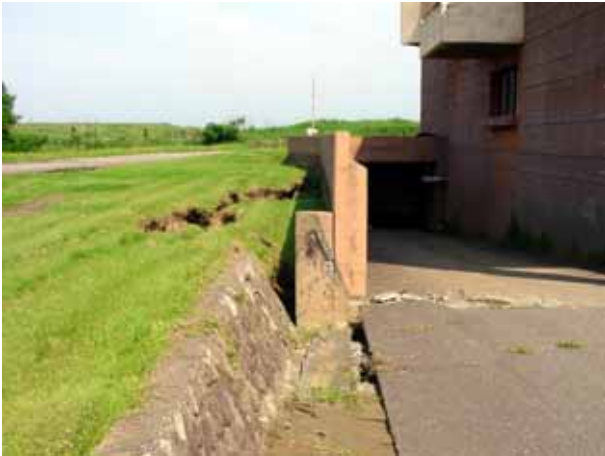
写真4.5.14 監視汚泥棟地下通路擁壁の外側盛土に生じた大きな亀裂・陥没
