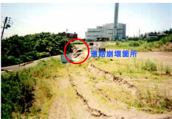
写真4.1.19 道路崩壊箇所をって一直線に続く段差
