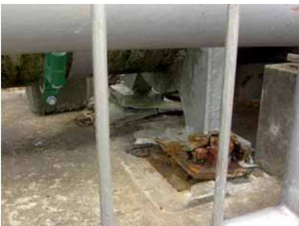
写真4.5.37 水管橋橋台部の固定金具の抜け出し
