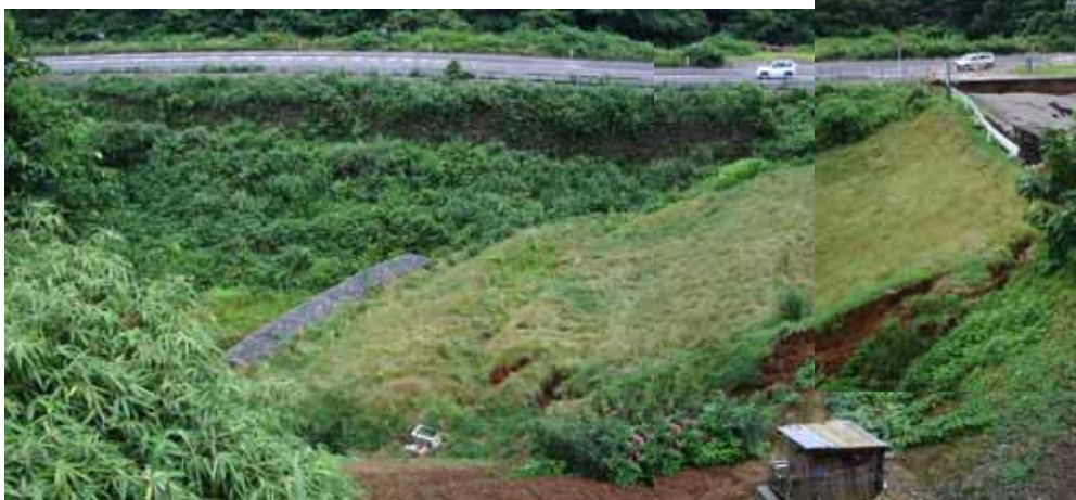
写真4.1.7 高さ約10mの盛土が基礎地盤からすべり破壊を生じた
