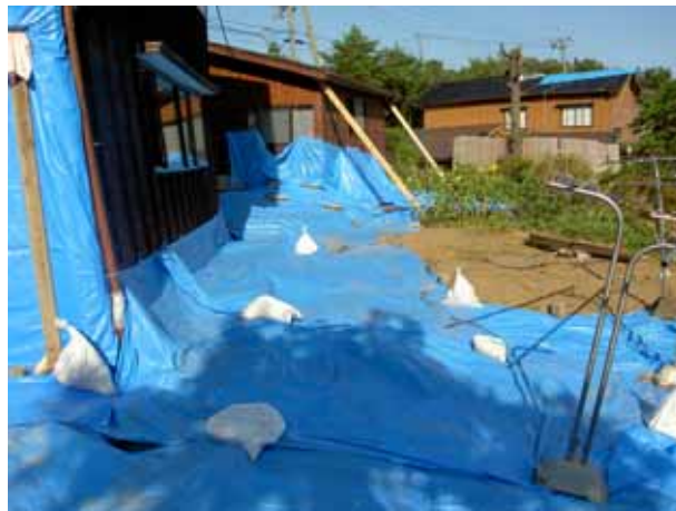
写真4.4.10 池に面した宅地の被害
