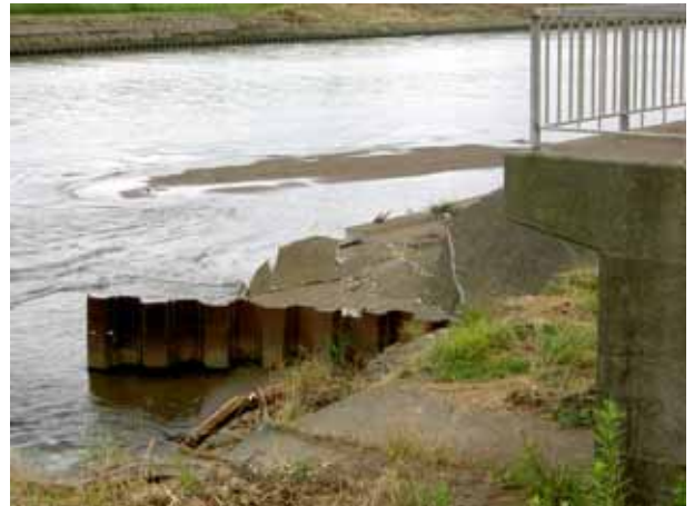
写真4.3.11 鯖石川河口左岸側の護岸の破壊
