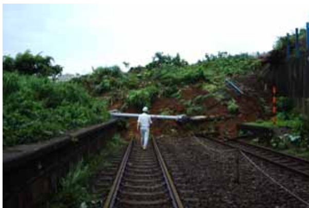
写真4.6.10 笠島駅方面から見た崩壊土砂
