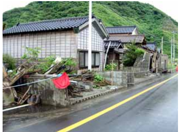
写真4.4.22 ブロック塀の転倒(西山町大崎)
