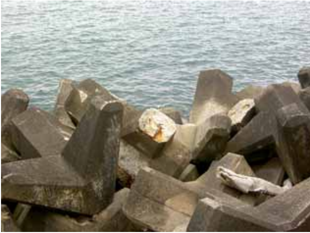
写真4.3.23 先端が壊れたテトラポッド
