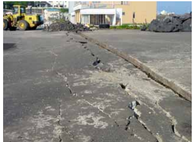
写真4.2.4 物揚場背後の沈下と亀裂
