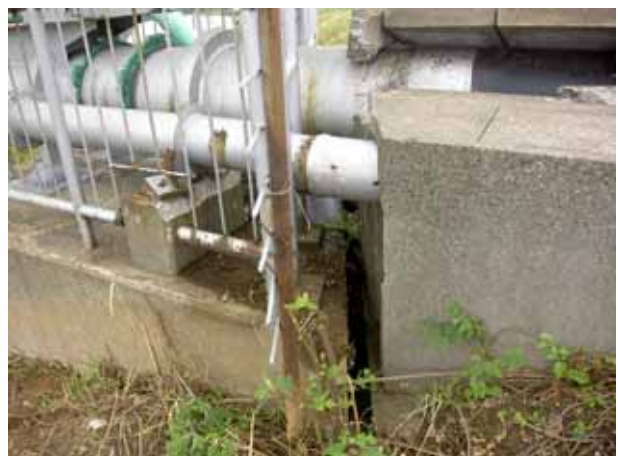
写真4.5.36 水管橋橋台（左岸）と堤防を横断するU字溝の開き
