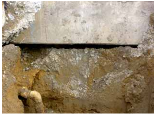
写真4.5.7 地盤沈下によって管理棟建物の基礎に生じた隙間
