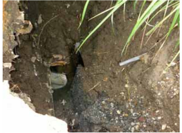
写真4.3.30 同左。陥没孔の底に見える樋管の開口
