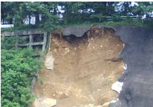
写真4.6.28 滑落崖の状況
