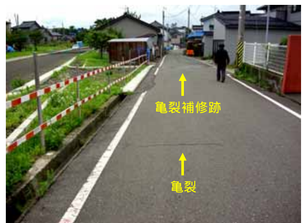
写真4.2.27 同左。国道352号の南側の直交道路に生じた横断亀裂と補修跡。この道路は南東方向（紙面向こう側）に緩やかに傾斜している。
