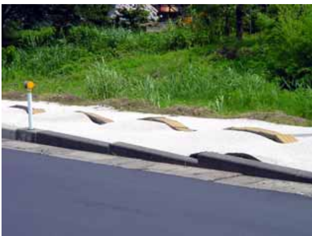
写真4.1.4 縁石も波打ちに対応して傾斜
