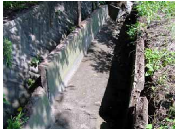
写真4.5.17 同左。盛土のり尻の水路は破壊し、大量の噴砂が堆積している
