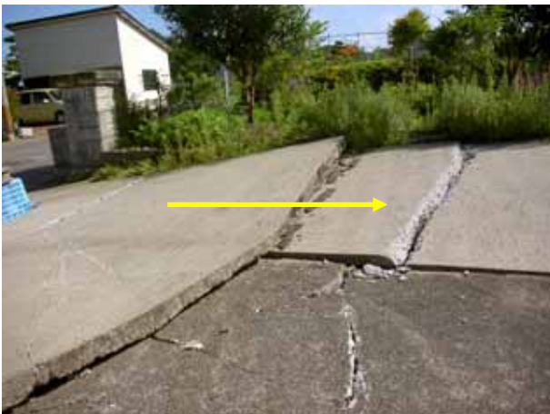
写真4.4.15 道路の亀裂とバックリング
