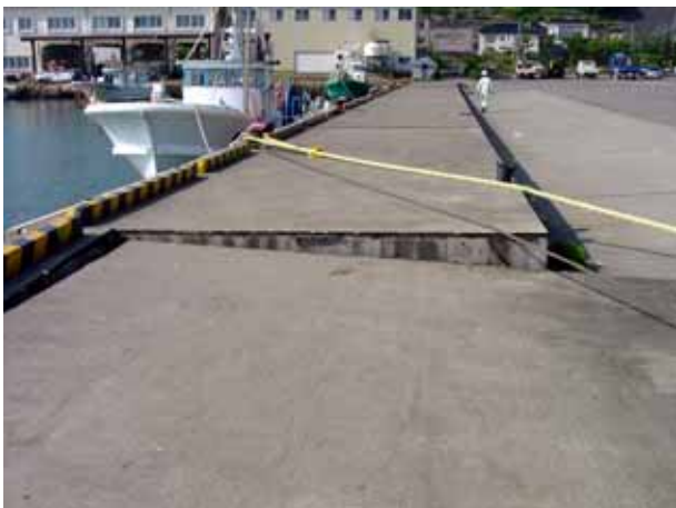
写真4.2.17 南東側泊地岸壁の背後地盤の沈下
