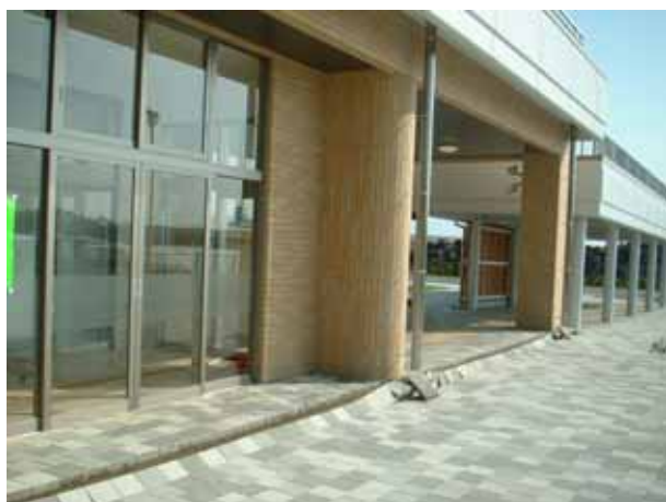
写真4.7.2 交流センターに生じた沈下による段差
