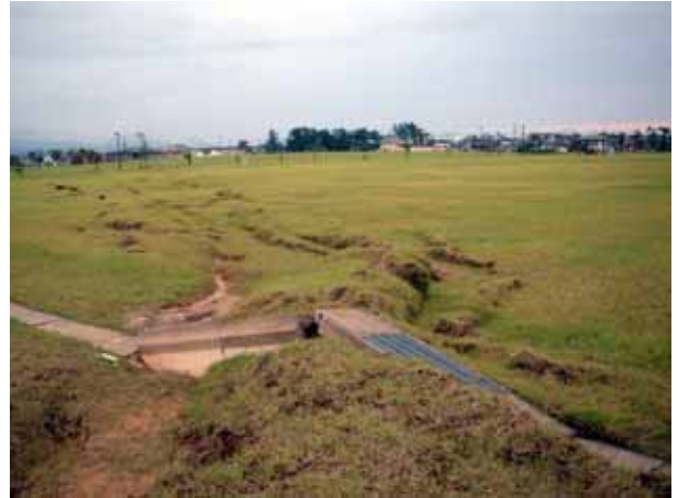
写真4.7.16 押し上げられた排水溝
