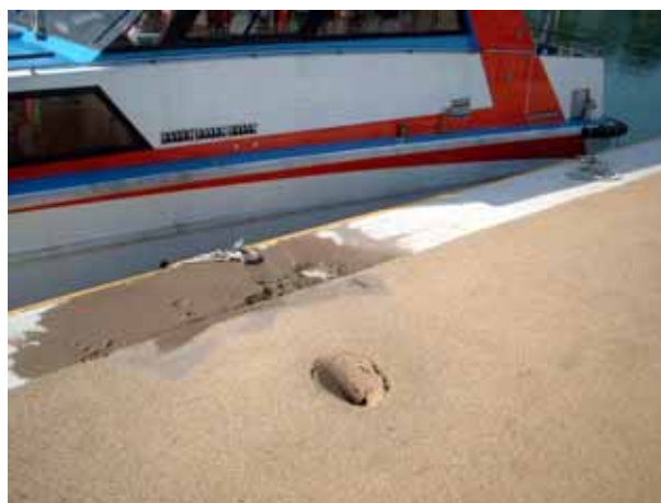
写真4.7.1 交流センター前面岸壁に生じた噴砂
