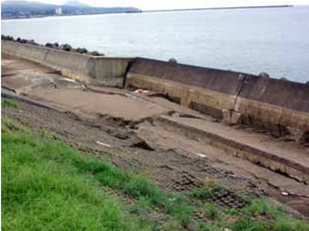
写真4.3.17 護岸の前傾と背後の噴砂
