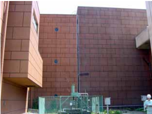
写真4.5.10 監視汚泥棟建物間のエクspansionジョイントの開口
