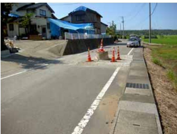
写真4.5.33 マンホールの突出( 柏崎市長崎 )
