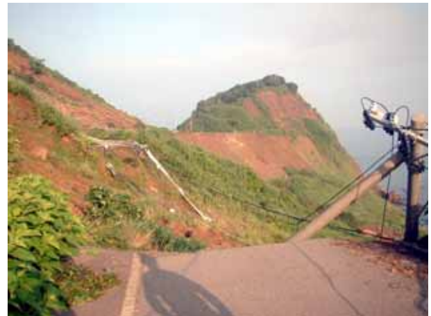
写真4.5.40 同左道路崩壊部
