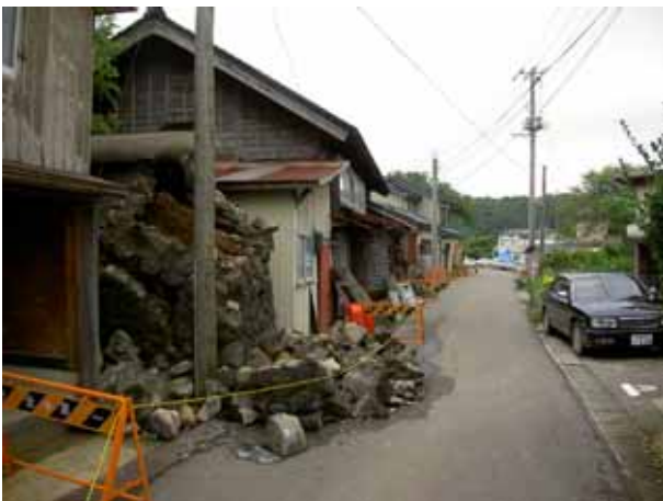
写真4.4.21 石垣の崩壊(柏崎市青海川付近)
