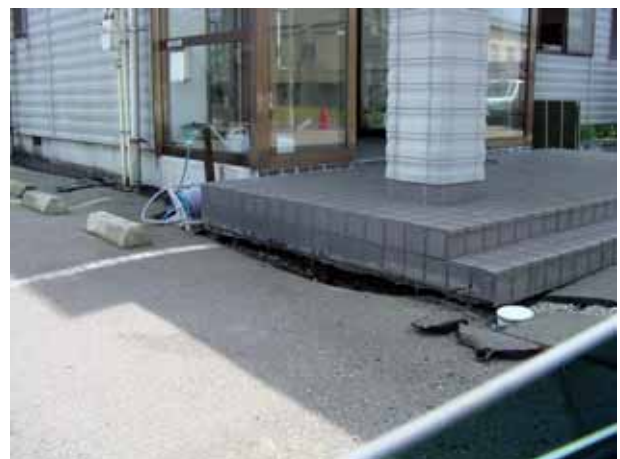
写真4.4.14 地盤沈下によりできた隙間
