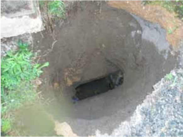
写真4.3.9 樋管の継ぎ目が開き、堤防土砂が流入し、穴ができていた
