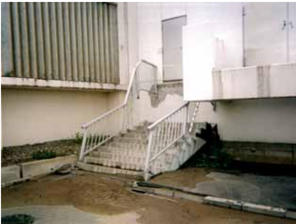
写真4.5.20 建物取付階段の落下
