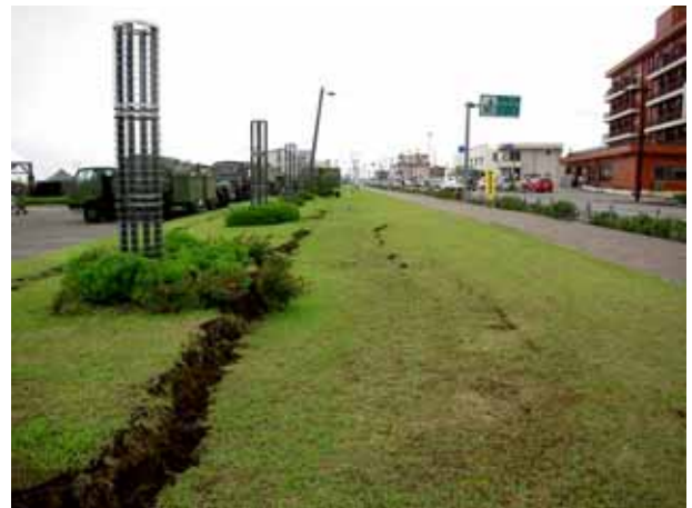
写真4.2.23 国道352号の緑地帯に生じた段差を伴う亀裂
