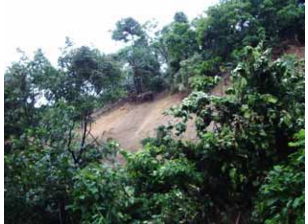
写真4.6.18 滑落崖の状況
