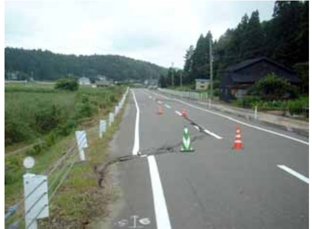
写真4.7.26 道路盛土の変状
