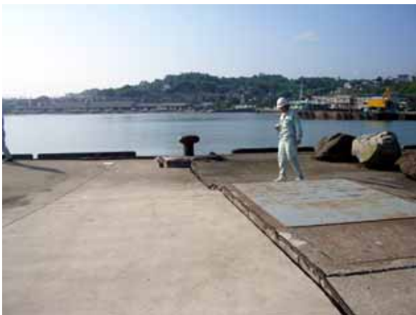
写真4.2.5 岸壁背後の沈下
