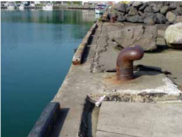
写真4.2.3 物揚場の岸壁法線のはらみ出し
