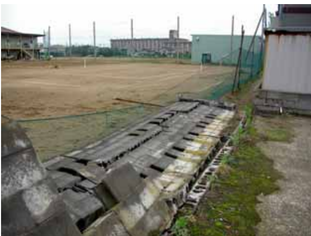
写真4.4.23 ブロック塀の倒壊(柏崎市学校町)
