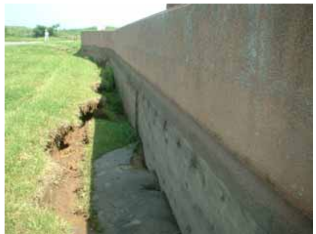
写真4.7.6 大きな地割れの中に生じた噴砂
