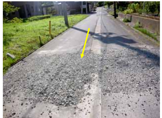
写真4.4.16 道路の亀裂補修跡
