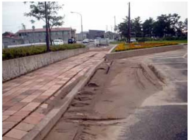
写真4.7.20 駐車場に生じた噴砂
