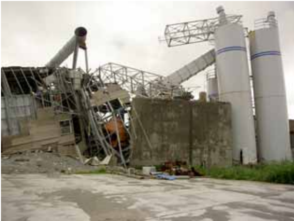
写真4.4.35 サイロの傾斜
