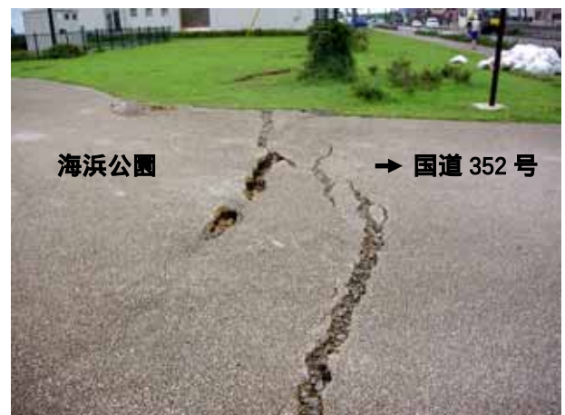
写真4.2.25 海浜公園の出入口に生じた国道と平行する横断亀裂
