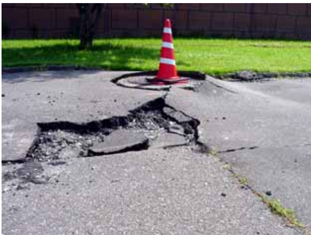
写真4.5.24 マンホール付近の地盤の亀裂・陥没
