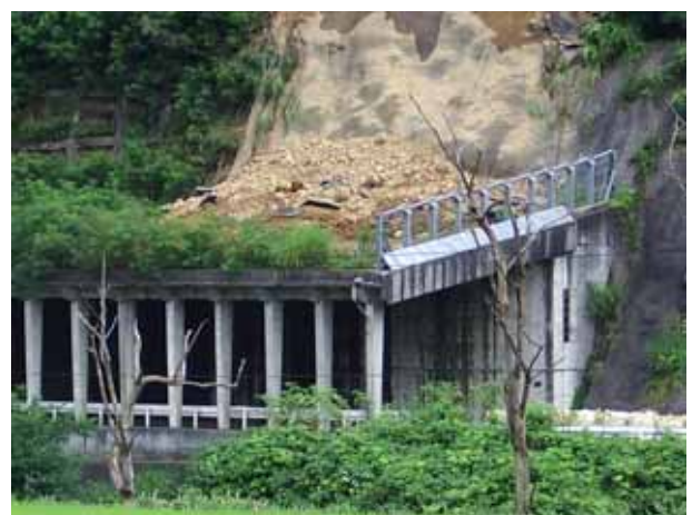
写真4.6.29 崩落土砂の状況
