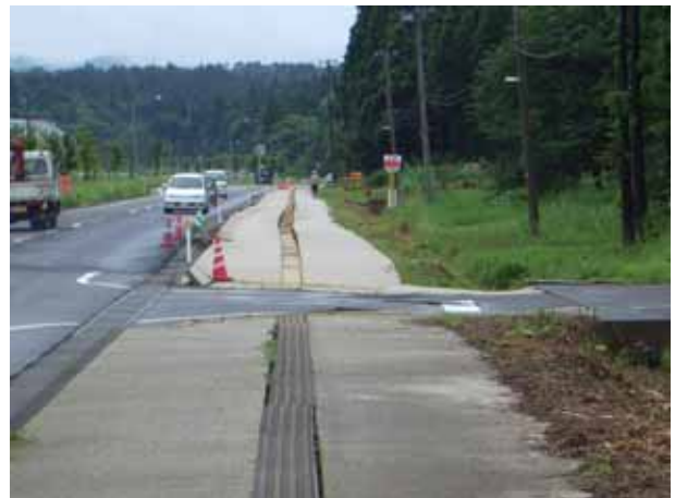
写真4.1.3 変状区間は水平変位も生じた
