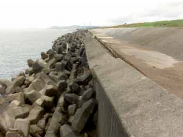
写真4.3.19 大きく前傾した護岸と背後の噴砂及び先端が破壊したテトラポット
