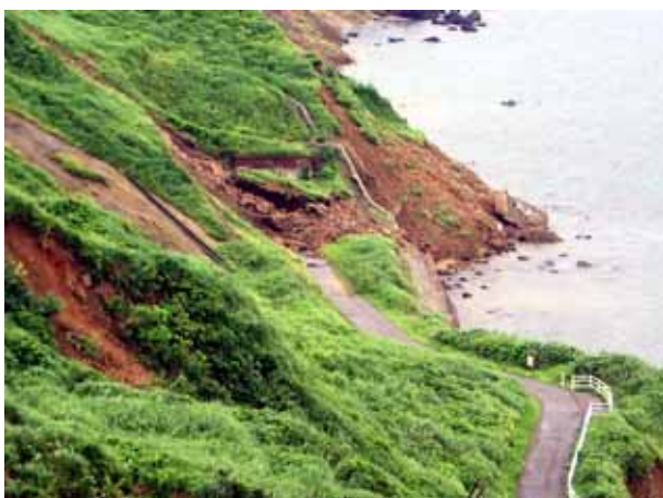
写真4.6.15 崩壊土によって埋まった遊歩道トンネル坑口
