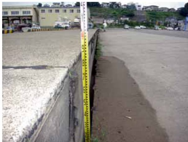
写真4.2.18 同左。南東側泊地岸壁背後の70cmに及ぶ沈下
