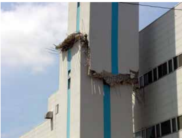
写真4.4.4 煙突破壊部の近景
