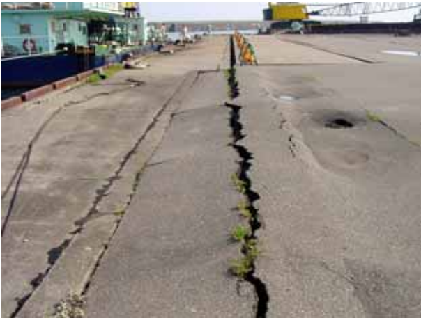
写真4.2.13 北西側岸壁の法線沿いの亀裂
