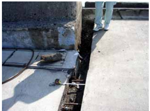
写真4.2.6 岸壁のはらみ出しによる床板ブロックの開口
