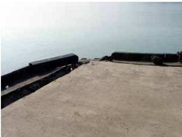
写真4.2.7 埠頭先端の隅角部の開口
