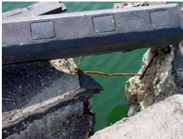
写真4.2.8 同左 隅角部の近景。岸壁のはらみ出しによって隅角部が開いた。
