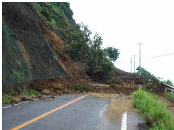
写真4.6.4 道路に崩落した土石
