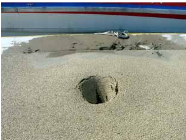
写真4.2.11 観光交流センター前の岸壁背後の噴砂と舗装の陥没
