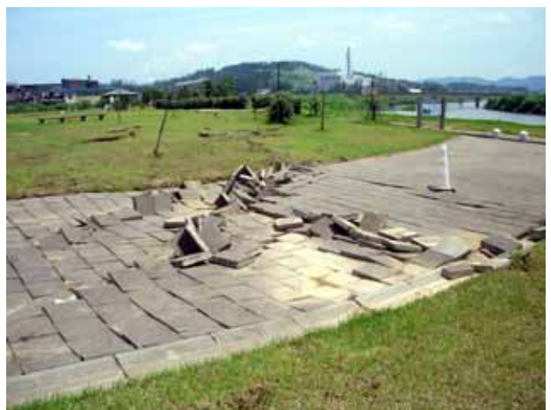
写真4.7.18 歩道の舗装の変状
