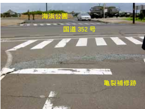
写真4.2.26 国道352号を挟んだ南側の道路にも海岸線と平行な亀裂の補修跡があった
