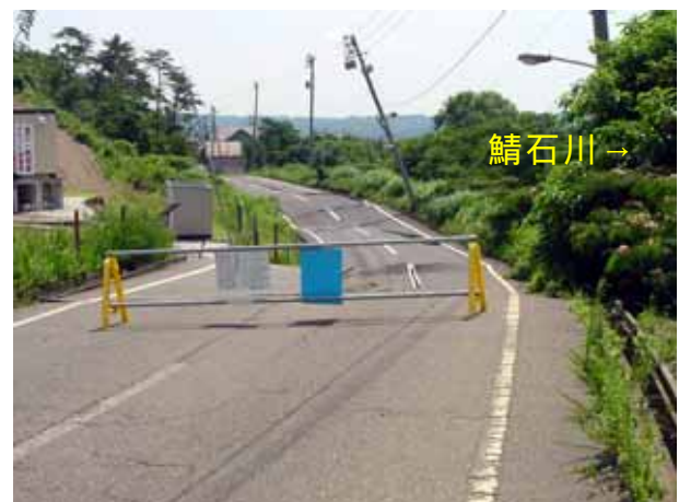
写真4.1.14 道路崩壊箇所西側から見た路面の変状
