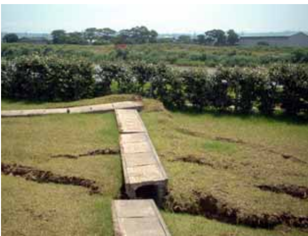
写真4.7.17 新河川側のり肩付近で押し上げられた排水溝
