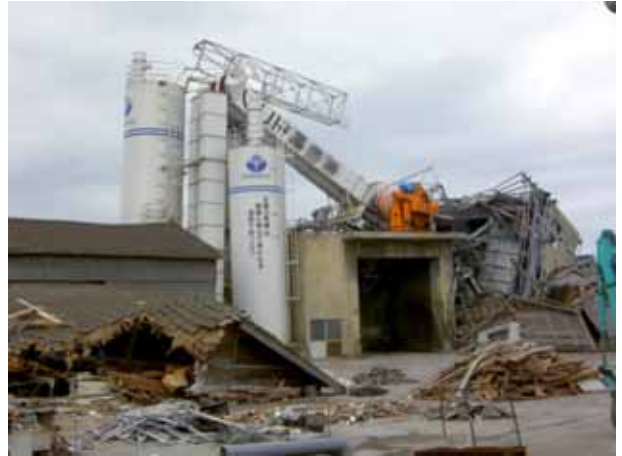
写真4.4.34 北東側からみた被害状況
