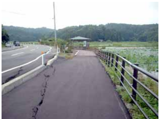
写真4.7.22 道路と遊歩道に生じた亀裂
