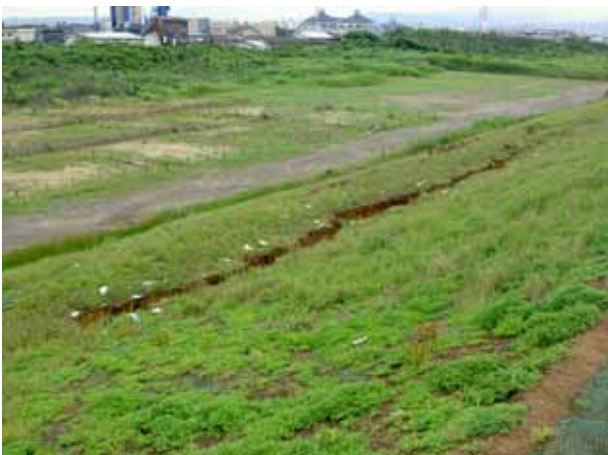
写真4.3.33 海岸堤防の内陸側のり面に生じた亀裂
