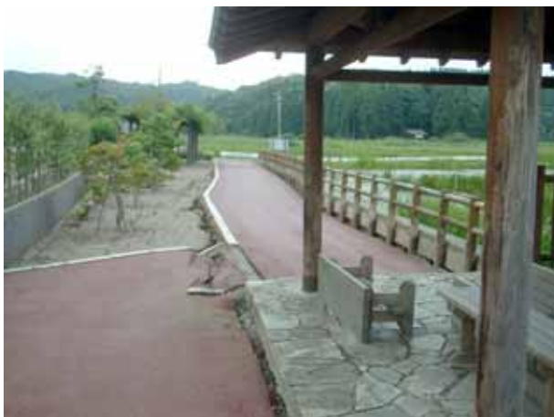
写真4.7.23 護岸が池側に押出される
