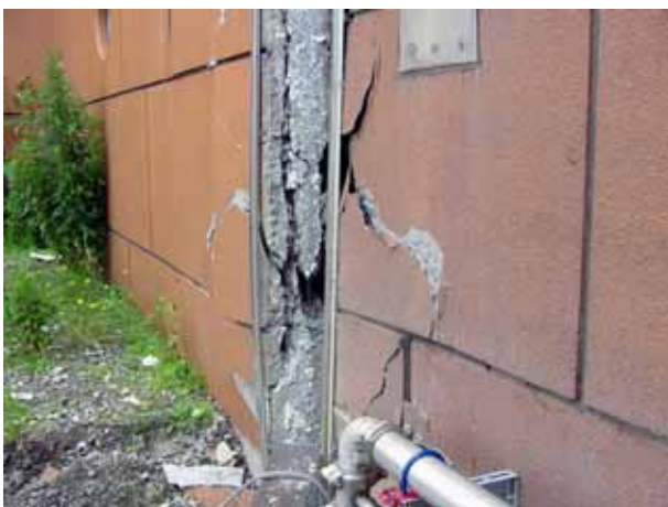
写真4.5.12 同上。南西側エクspansionジョイントの水平ずれ
