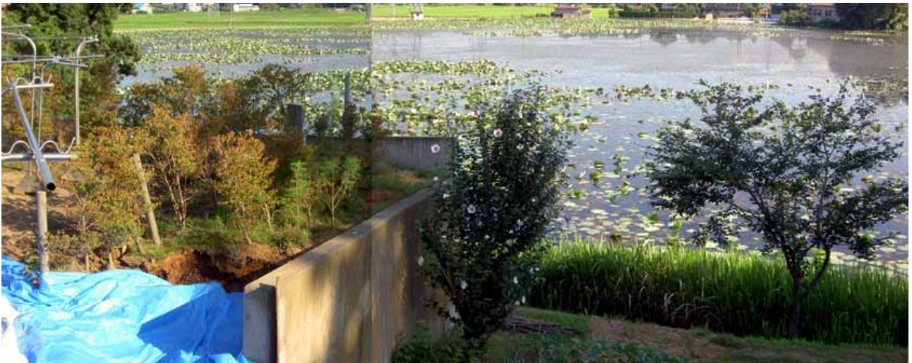
写真4.4.11 池に面した宅地の被害。擁壁が前傾して背後の宅地に亀裂・陥没が生じた
