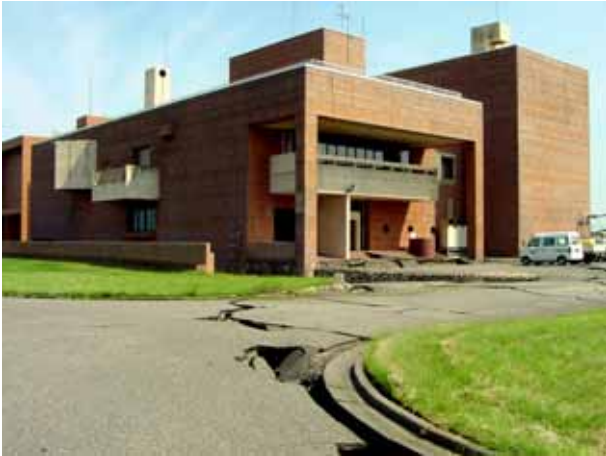
写真4.5.8 監視汚泥棟の前の道路の亀裂
