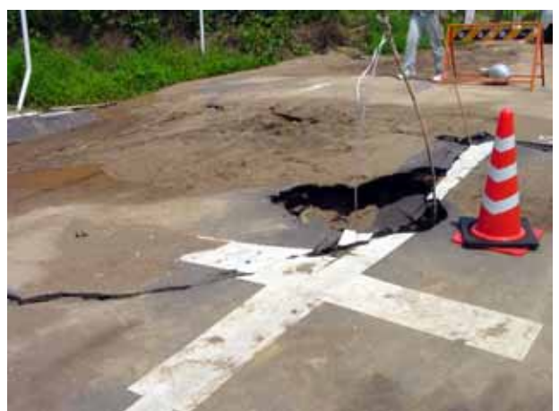
写真4.7.7 マンホール周辺に生じた噴砂と陥没
