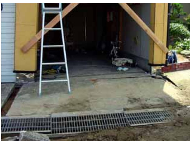
写真4.7.11 コンクリートの目地の開き
