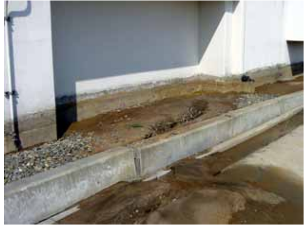
写真 4.5.19 同左近景。地盤沈下と噴砂
