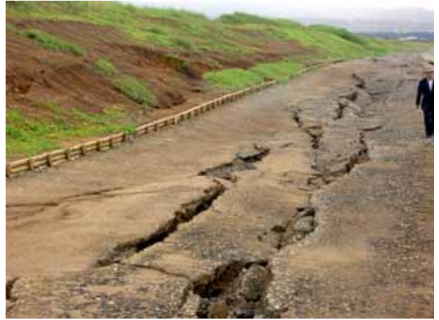
写真4.3.24 海岸堤防小段の亀裂
