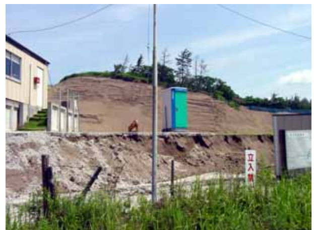
写真4.1.18 道路崩壊箇所東側の道路陥没箇所の断面
