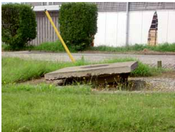
写真4.5.27 構内のマンホールの突出。地盤沈下によるものか浮き上がりによるものかは分からない。
