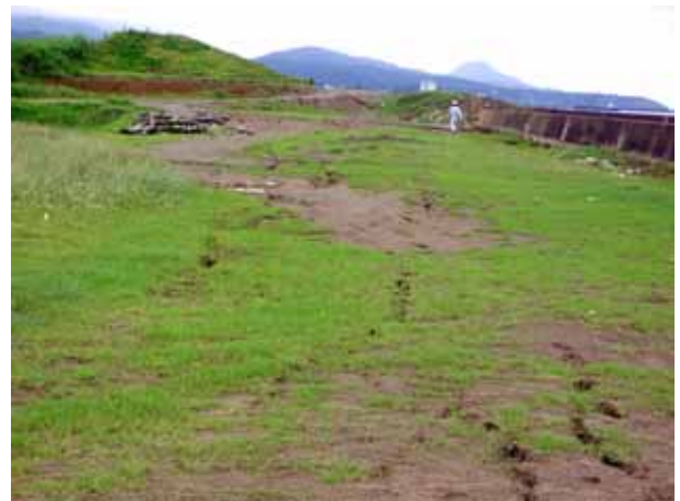
写真4.4.38 被害施設の海側に生じた地割れ・噴砂
