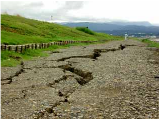
写真4.3.25 海岸堤防小段の亀裂
