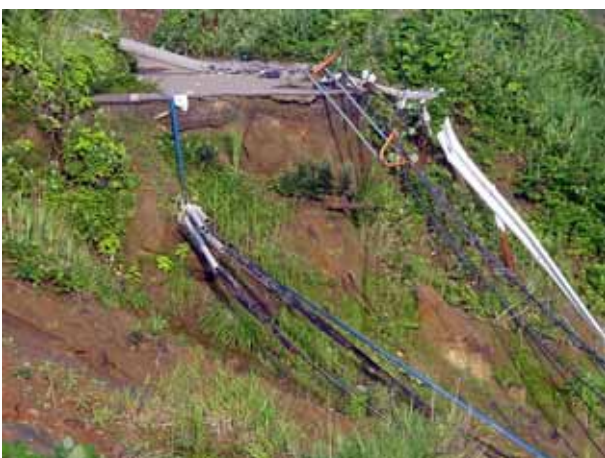
写真4.5.41 道路崩壊により垂れ下がった電線及び地中埋設管
