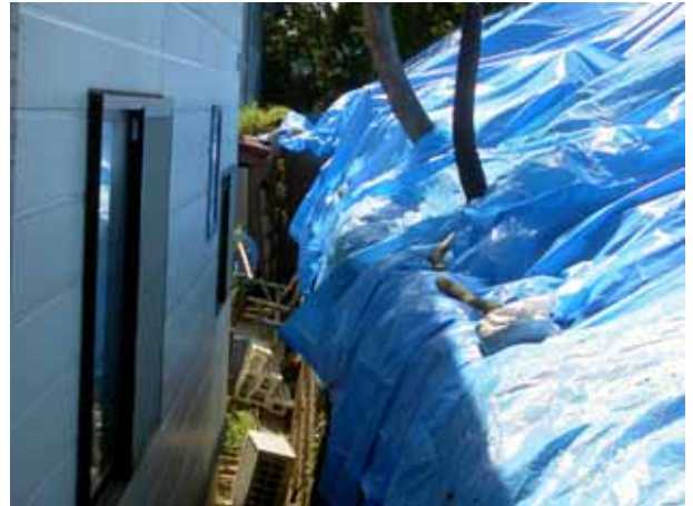
写真4.4.20 住宅背後の擁壁がはらみ出して 物置が一部圧壊した(柏崎市山 本)
