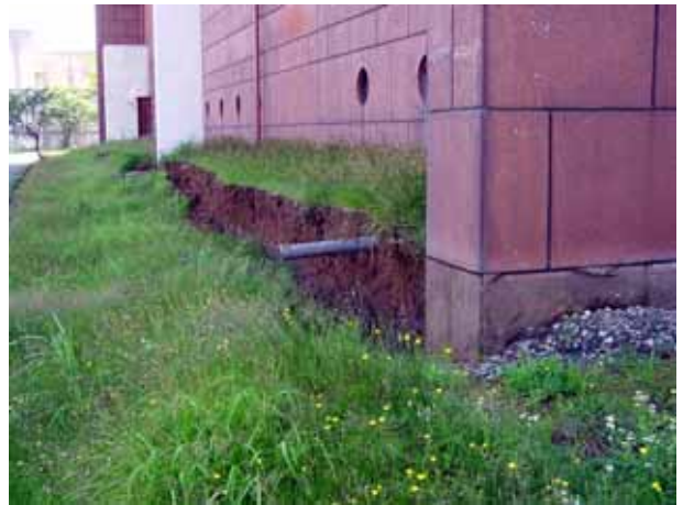
写真4.5.5 管理棟裏側の盛土の沈下
