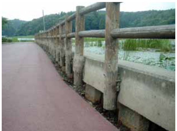
写真4.7.24 矢板護岸背面に生じた沈下
