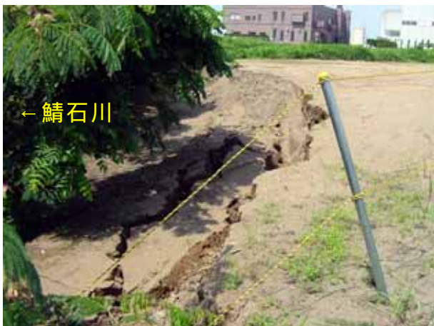
写真4.1.17 道路崩壊箇所続く盛土のり面の崩壊
