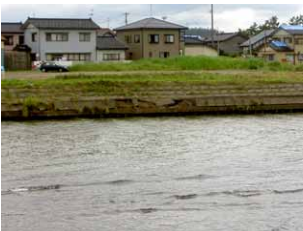
写真4.3.12 鯖石川河口右岸側の護岸ブロックの破壊
