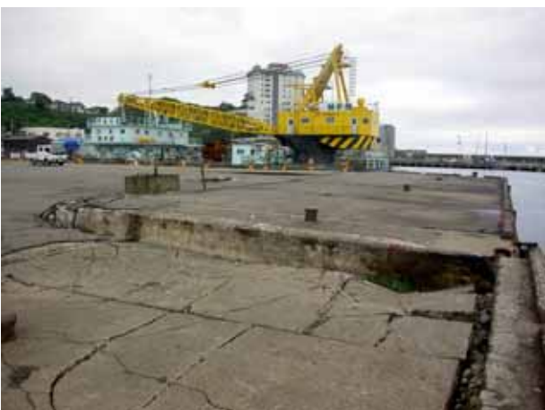
写真4.2.21 -5.5m岸壁のはらみ出しと沈下
