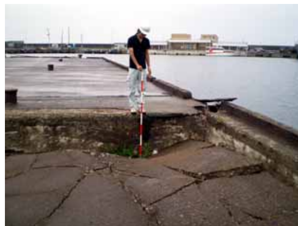
写真4.2.20 埠頭先端部（北側）の沈下。背後の岸壁は栈橋形式となっているため沈下していない。
