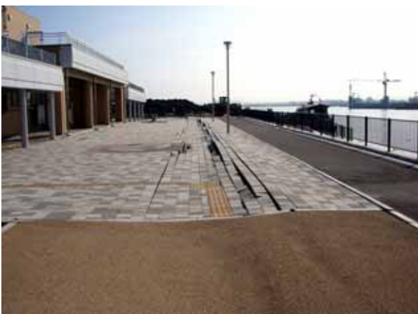
写真4.2.9 観光交流センター前のインターロッキングの乱れ
