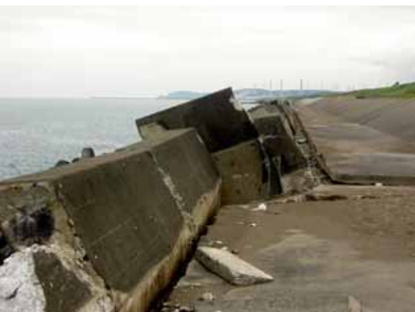
写真4.3.21 大きく前傾した護岸（階段部）
