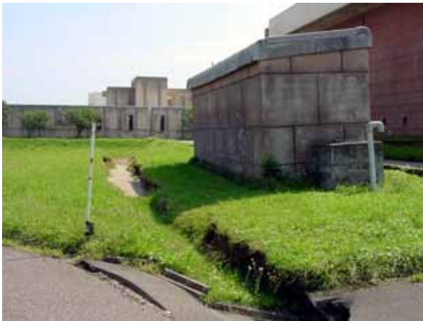
写真4.5.4 管理棟裏側の地盤に生じた大きな亀裂・開口と噴砂
