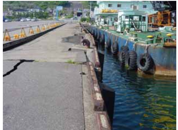
写真4.2.14 北西側泊地岸壁のはらみ出し
