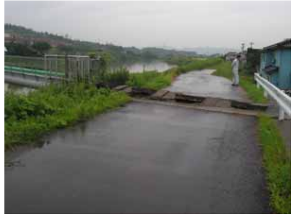
写真4.3.10 堤防に埋設されていた管の抜け上がり
