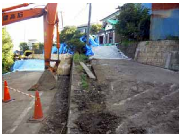
写真4.4.7 同上。道路の崩壊によって擁壁が動いたものと思われる
