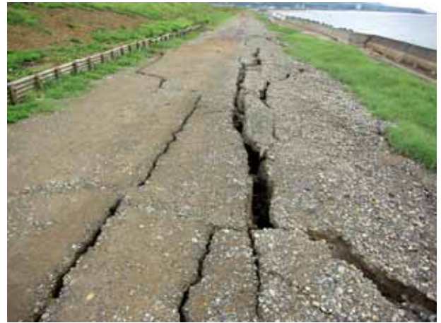
写真4.3.26 海岸堤防小段の亀裂
