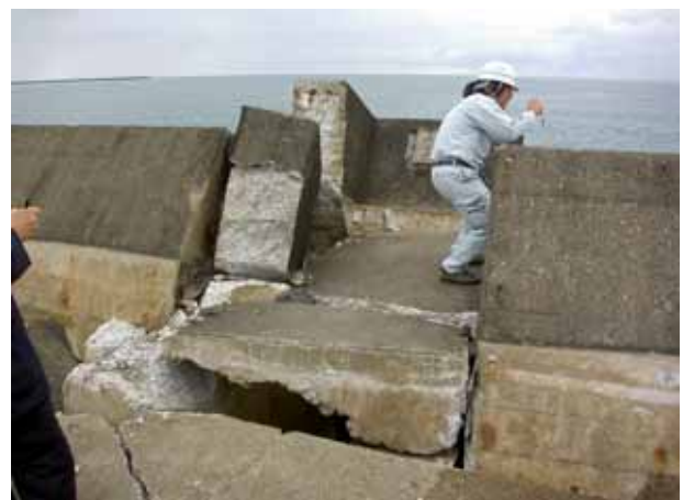
写真4.3.22 大きく前傾した護岸（階段部）
