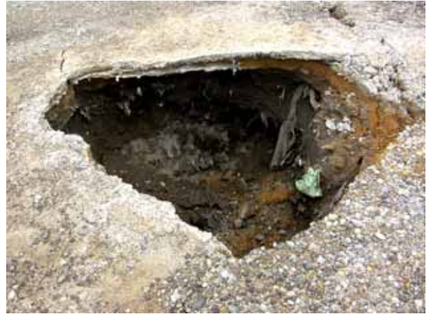
写真4.3.32 海岸堤防小段に見られた陥没孔
