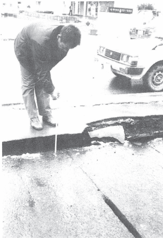
写真 4 - 1 8 浦河町地内における歩道の沈下状況 (浦河町東町)
