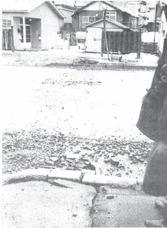
写真 4 - 1 路面の横断クラック ( 浦河町東町 )
