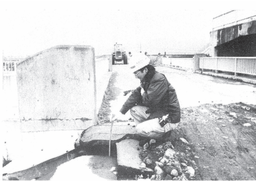
写真 4 - 2 1 静内町入船の海岸道路の取付部の沈下状況
