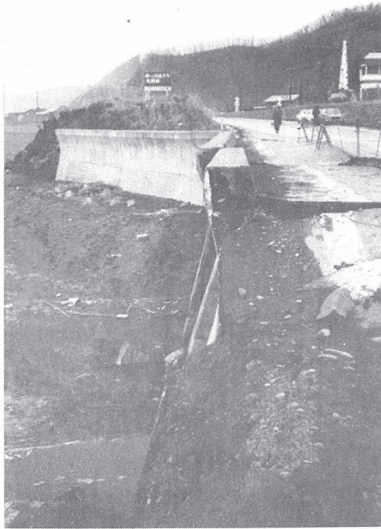
写真 4 - 19 三石町地内における国道 235 号の波返し擁壁の倒壊
