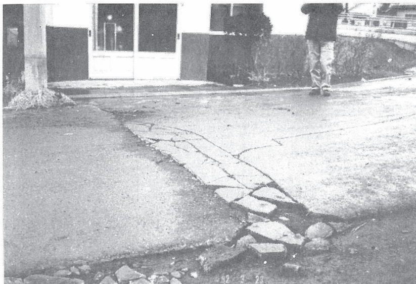
写真 4 - 3 路面の横断クラック
