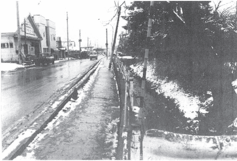
写真 4 - 1 7 浦河町地内における歩道の沈下状況 (浦河町常盤町)
