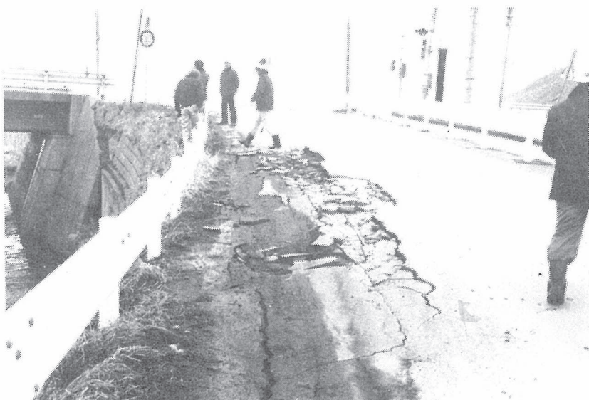
写真 4 - 20 東静内町道の破損状況（東静内）
