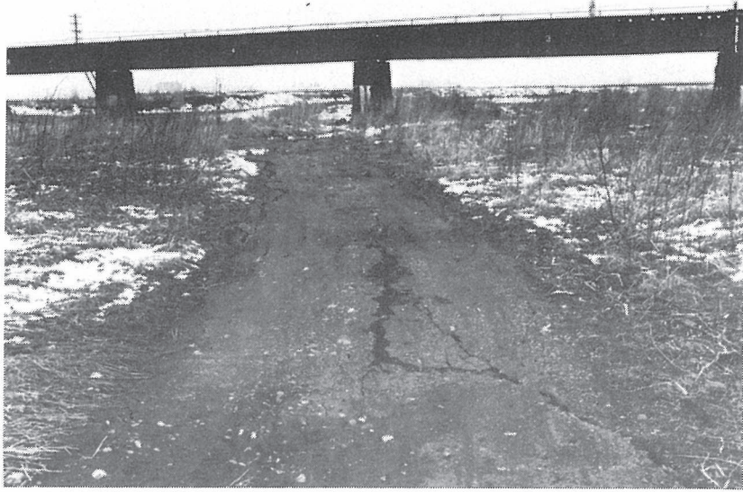
写真 5 - 6 静内川鉄道橋右岸部地割状況
