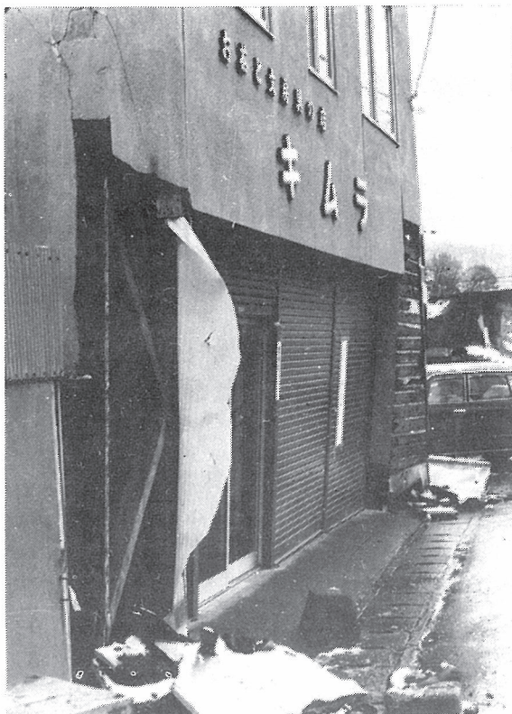
写真 3 - 7 浦河町常盤町モルタル壁の肌落ち
