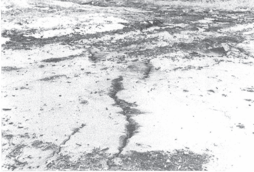
写真 7 - 1 静内川右岸部静内橋付近の噴砂跡
