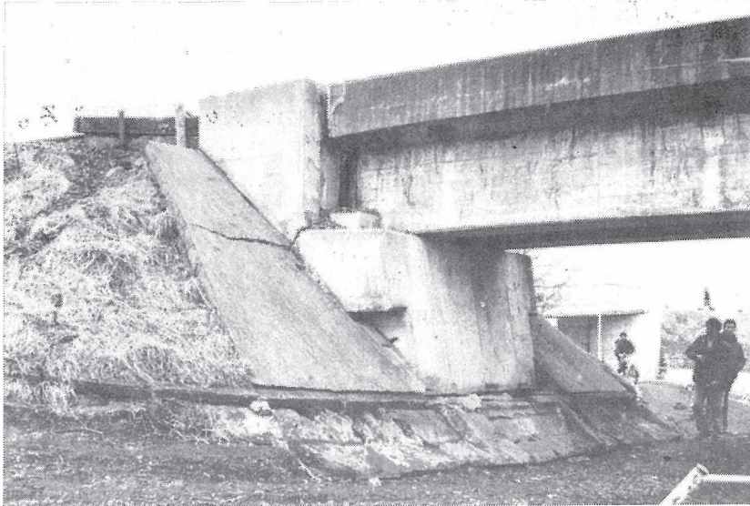
写真 5 - 8 浦河町乳呑川鉄道橋々台破損状況
