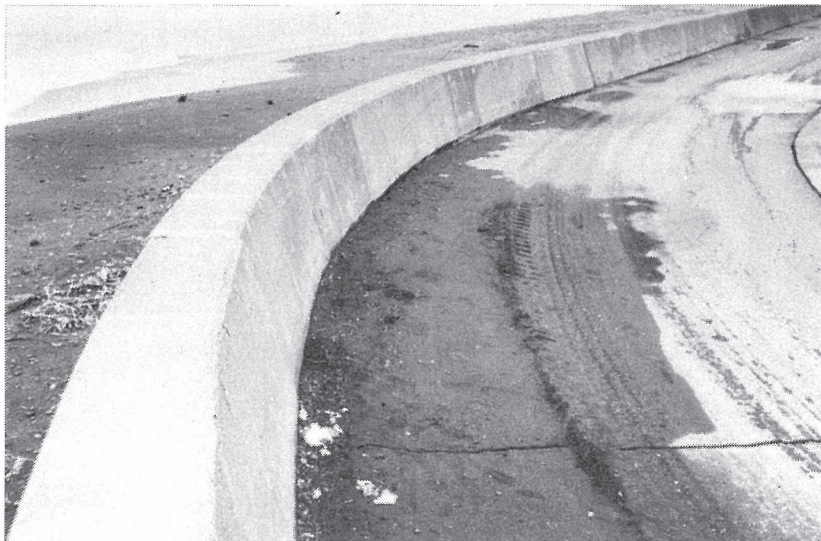
写真 6 - 9 静内橋下流海岸堤防の沈下，クラック
