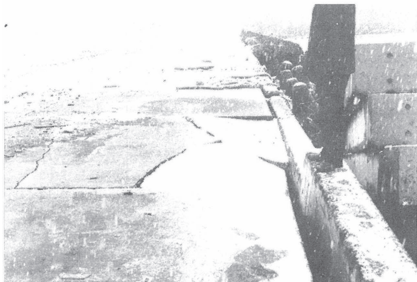
写真 6 - 12 浦河港岸壁の変状
