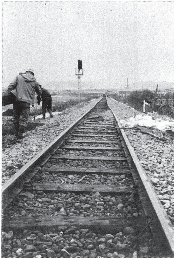
写真 4 - 2 2 静内町入船における鉄道盛土の沈下
