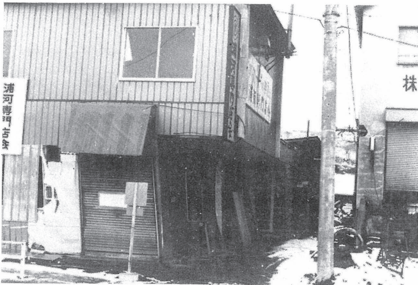
写真 3 - 6 浦河町常盤町住宅の傾斜
