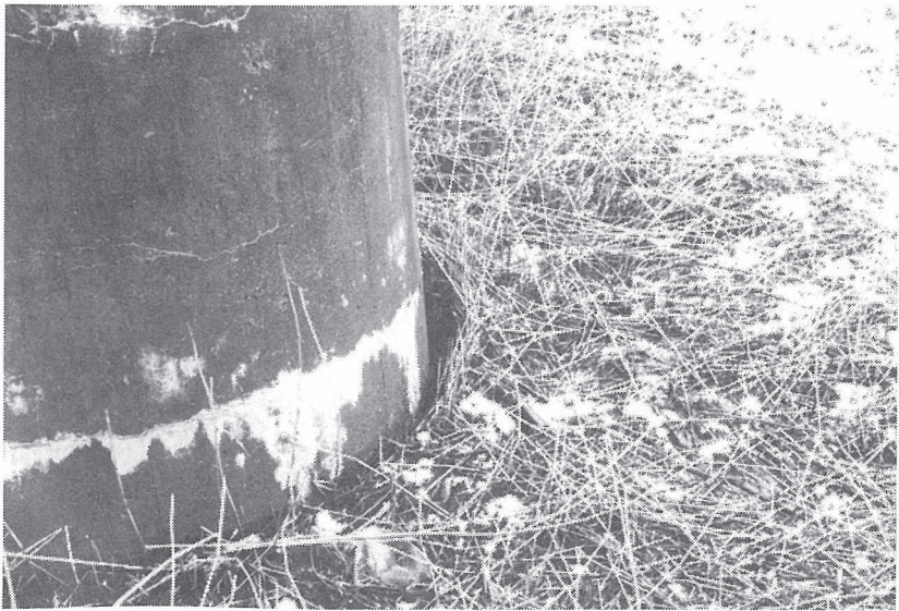
写真 5 - 7 静内川鉄道橋右岸部橋脚の水平移動状況
