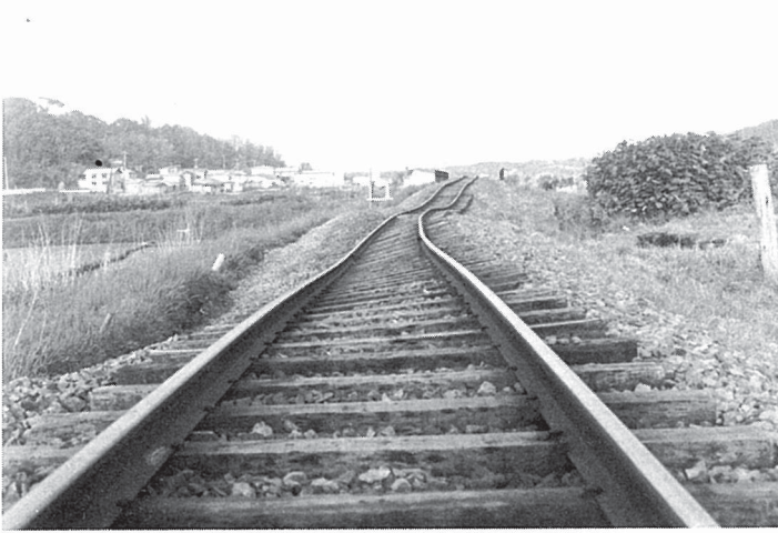
国鉄五能線鱒ヶ沢-鳴沢間 鳴沢鉄橋付近 盛土崩壊による線路の沈下
