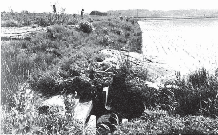
写真4-1の東側押え盛土 のり尻付近の噴砂
