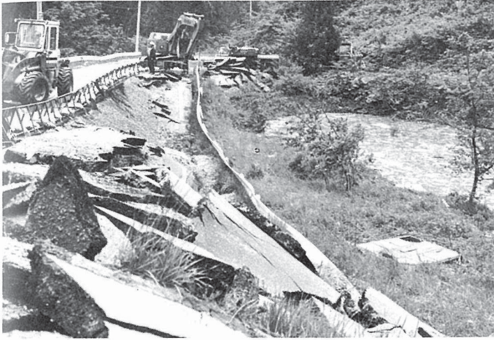
県道今別-蟹田線小国峠付近 盛土の崩壊
