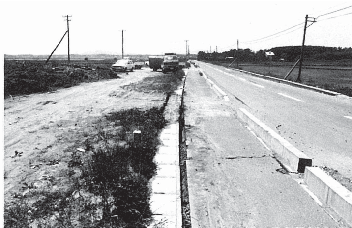
男鹿街道若美町 玉ノ池南町の道路被害
