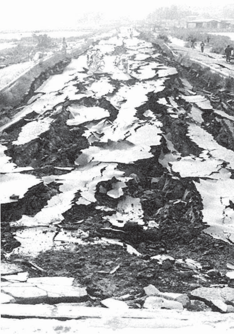
男鹿街道と八郎潟を結ぶ 五明光橋の取り付け部 における大崩壊
