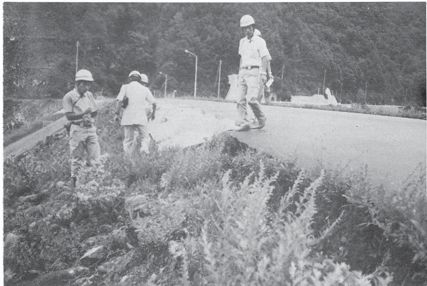
写真 7-2 堤頂部下流側の滑り落ちた状況
