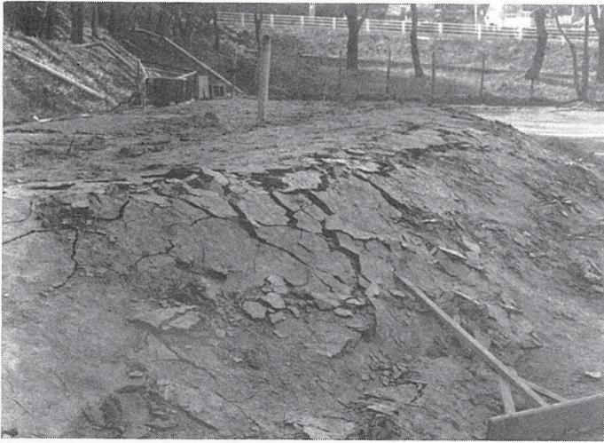
写真 3 - 4 法尻部隆起の近景
