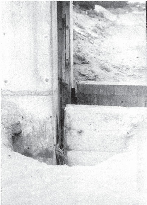
写真2-8 水門のコンクリート の離れ (真亀川)
