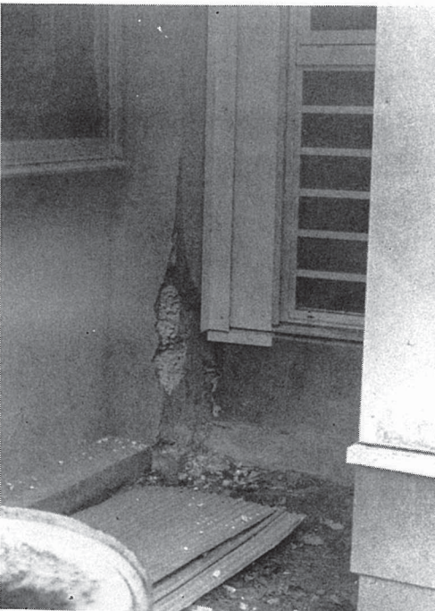
写真5-6 校舎接合部の柱のコンク リート剥落 (長南中学校)
