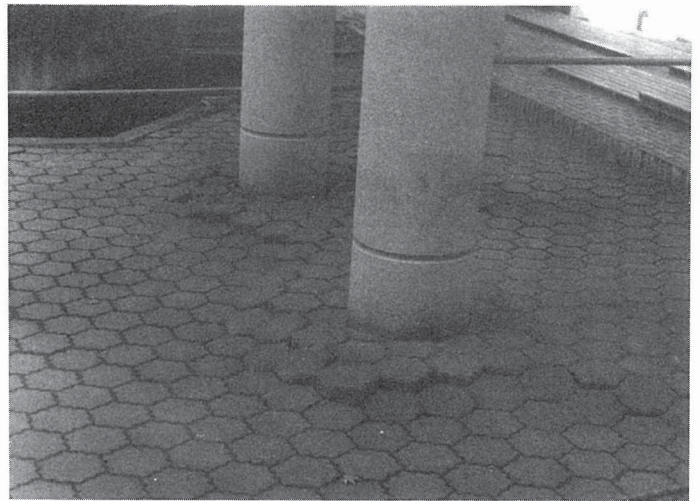
写真5-8 中庭の床ブロックの 不同沈下（長南中学校）
