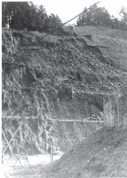
写真4-7 長南町小沢の切土斜面の崩壊
