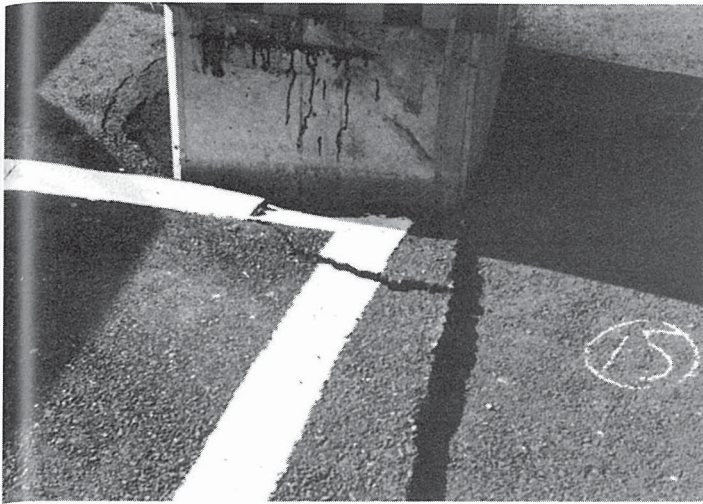
写真6-7 高架橋下部の地盤変状 (京浜急行線)
