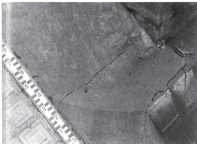
写真6-1 下傍止橋の右岸橋台の 亀裂（南白亀川）
