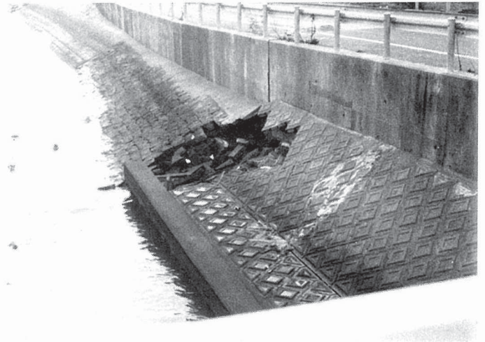
写真2-13 河口付近の護岸の崩壊 （作田川右岸）
