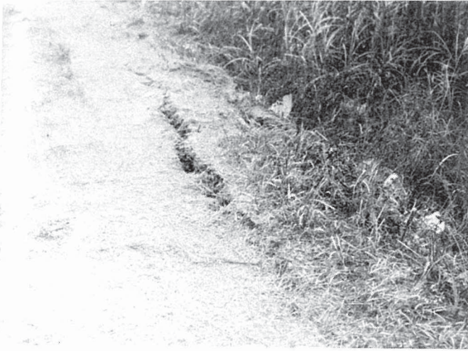
写真 2 - 3 堤防の縦断亀裂 (真亀川)
