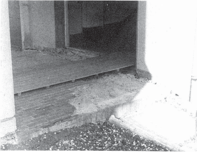
写真5-7 地盤の沈下とタイルの 被害（長南中学校）
