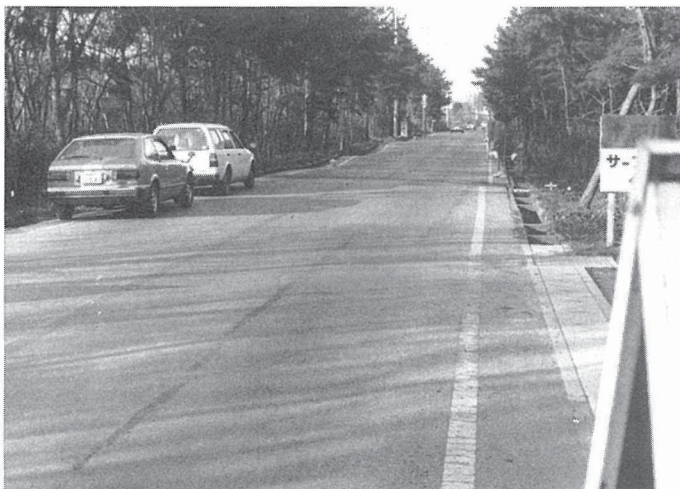
写真 1 - 1 不同沈下による 道路の波打ち
