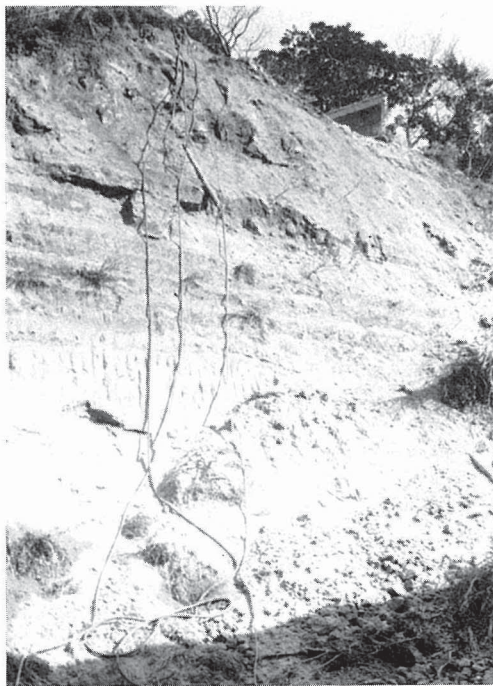
写真3-8 校舎背後の切土の崩れ
