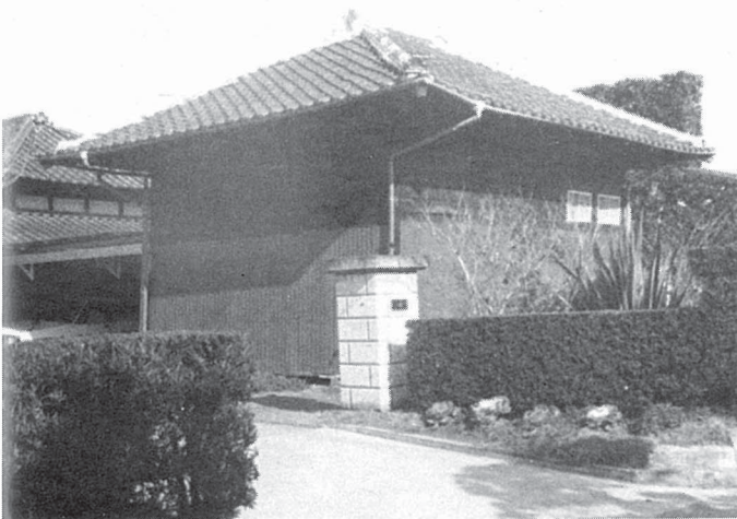
写真5-3 傾斜した納屋 (長南町報恩寺)
