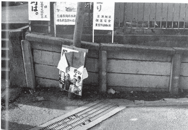
写真6-9 擁壁の変形 (上宮田団地)
