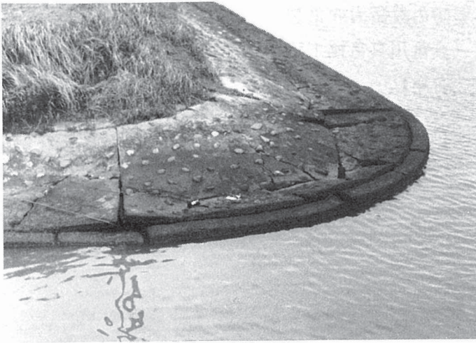
写真2-12 水路合流部の護岸の 変状（作田川）
