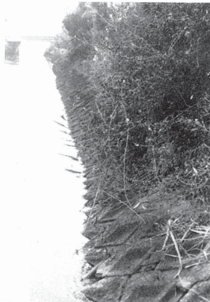
写真2-11左 亀裂が微少か全く生じていない新しい護岸 写真2-11右 亀裂が大規模に生じている古い護岸
