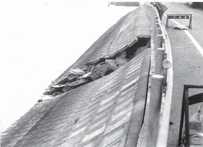
写真2-14 河口付近の護岸の崩壊 （作田川右岸）
