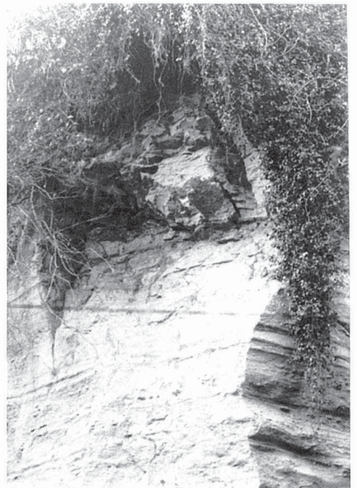
写真4-3 東金市台方の崖崩れ
