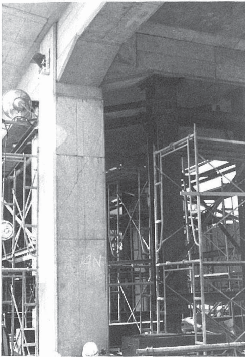
写真6-5 高架橋脚の せん断亀裂 (京浜急行線)
