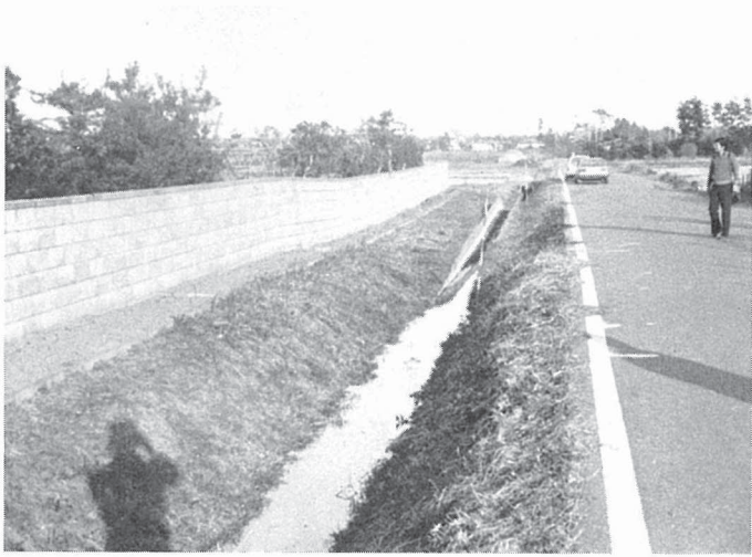
写真7-4 側溝の浮き上がり (一宮町東浪見)
