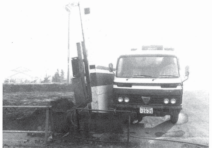
写真7-2 コンクリート塀の傾斜 (ガソリンスタンド)
