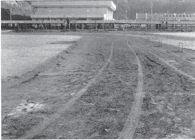
写真3-7 グラウンドの亀裂
