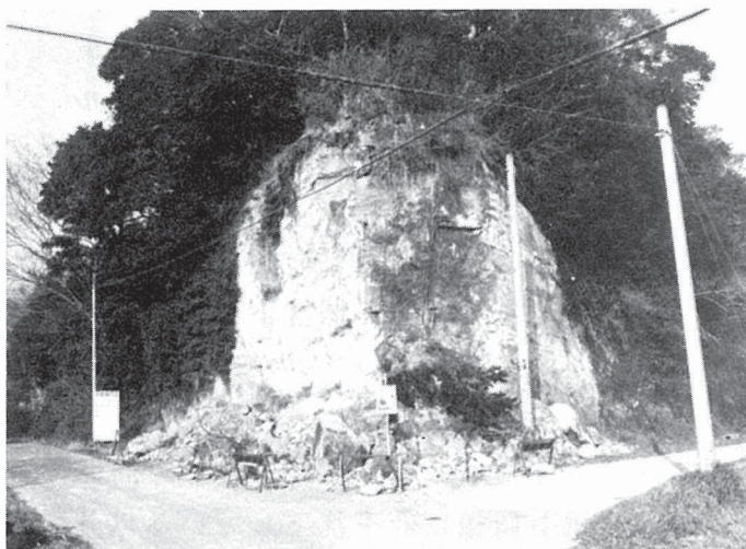
写真4-8 睦沢町の崖崩れ
