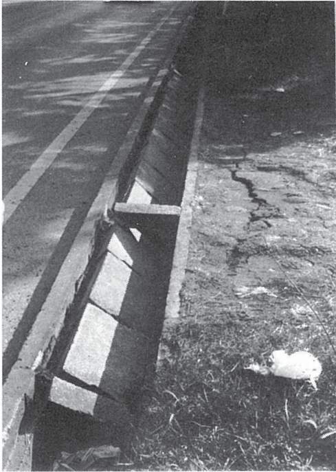
写真7-9 側溝の開きによるフタの 落下（一宮町東浪見の県道）
