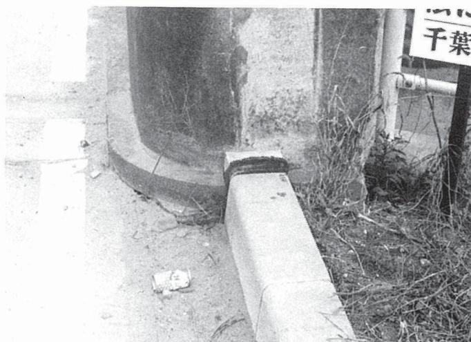
写真6-2 取付け道路の沈下のため 縁石がずれている （下傍止橋）
