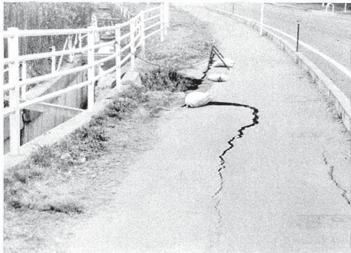
写真7-8 水路変形箇所 の歩道の亀裂・陥没 (黒潮橋取付け部)
