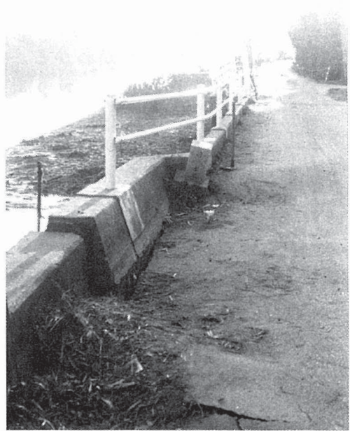
写真 2 - 2 橋の取付部分のはら み出しと沈下 (一宮川)
