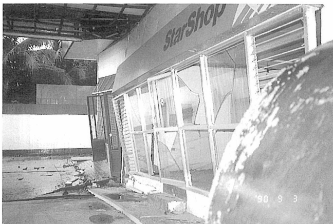
写真 8-30 ゆがんだガソリンスタンドの建物。
