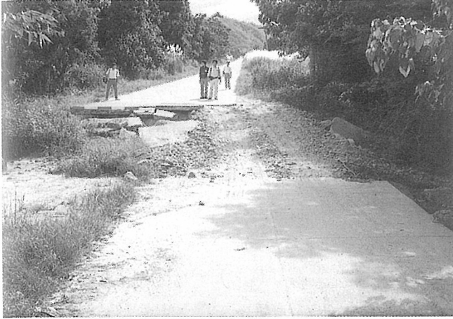
写真7-11 地震断層による道路面の 横ずれ (水平変位 約4.7m)
