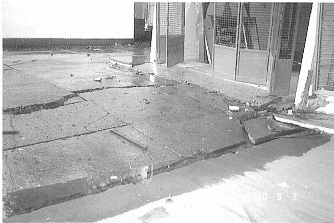
写真 8-29 ガソリンスタンドのコンクリートスラブの亀裂の状況。
