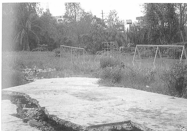
写真5-28 液状化による地盤の沈下と地盤の流動を示すスラブの大きな亀裂。
