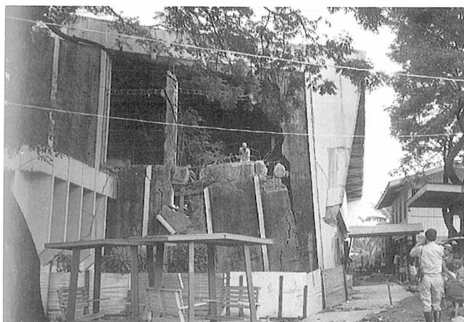
写真5-29 液状化に伴う地盤の流動によって引き裂かれた体育館の壁。
