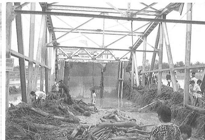
写真 8 - 4 床版の一部が橋脚に乗り 上げて折れたG13トラス。 付近は洪水による流木や 草がからみついている。
