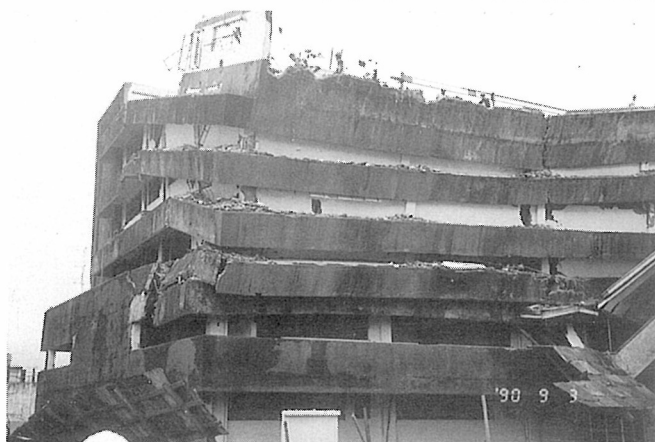
写真6-14 後ろから見た被害状況。
