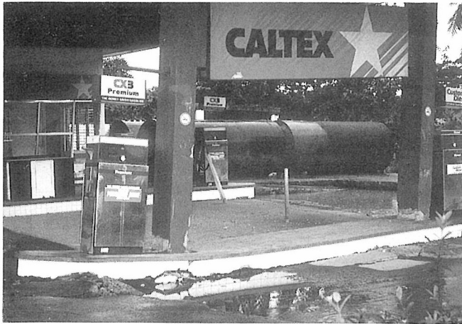
写真 8-28 液状化によるものと思われるガソリンスタンドの被害。
