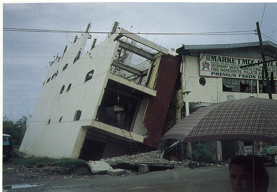
ダグバン市 液状化により大きく沈下，傾斜した建物
