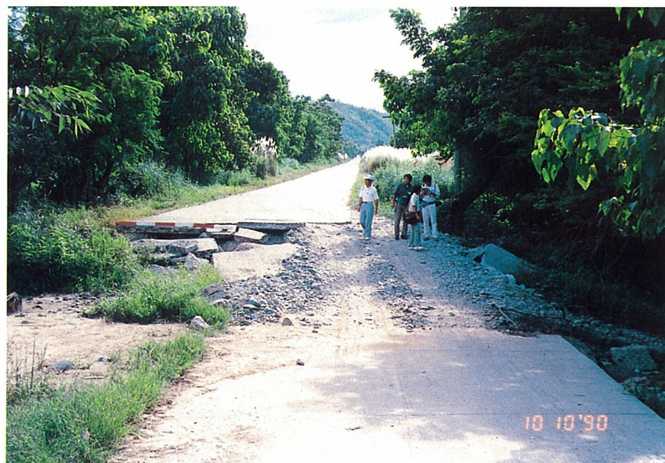
ディグディグ 断層により4.7m水平変位が生じた道路
