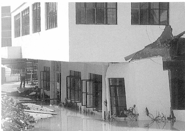
写真5-9 液状化によって沈下・前傾した放送局1階部分を拡大したもの。
