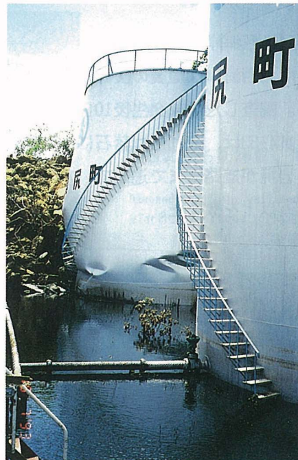
写真4-29 破壊された石油備蓄タンク Damaged oil tank at the foot of the slope
