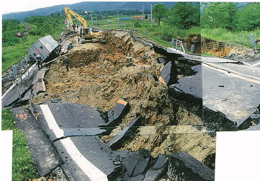
約100mにわたって崩壊した道路盛土（国道5号線知来付近）
