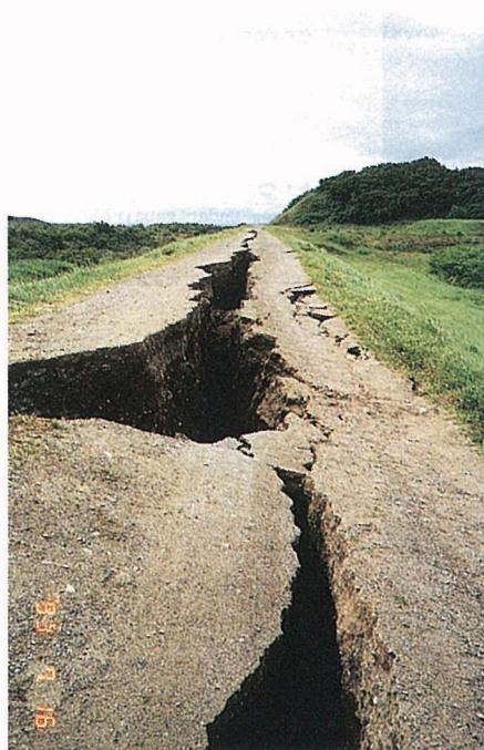
写真5-2 堤防天端の亀裂・陥没 (兜野橋付近)
