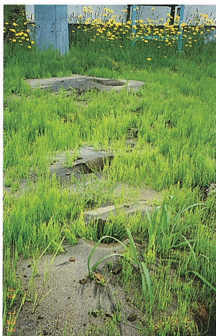
写真7-8 周辺地盤の噴砂
