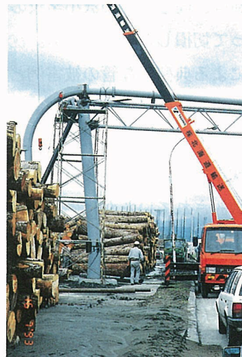
写真7-29 サイロの傾斜に引きずられて変形したパイプ支柱
