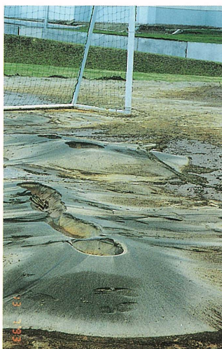
写真7-18 グラウンドの噴砂 Sandboils in the playground
