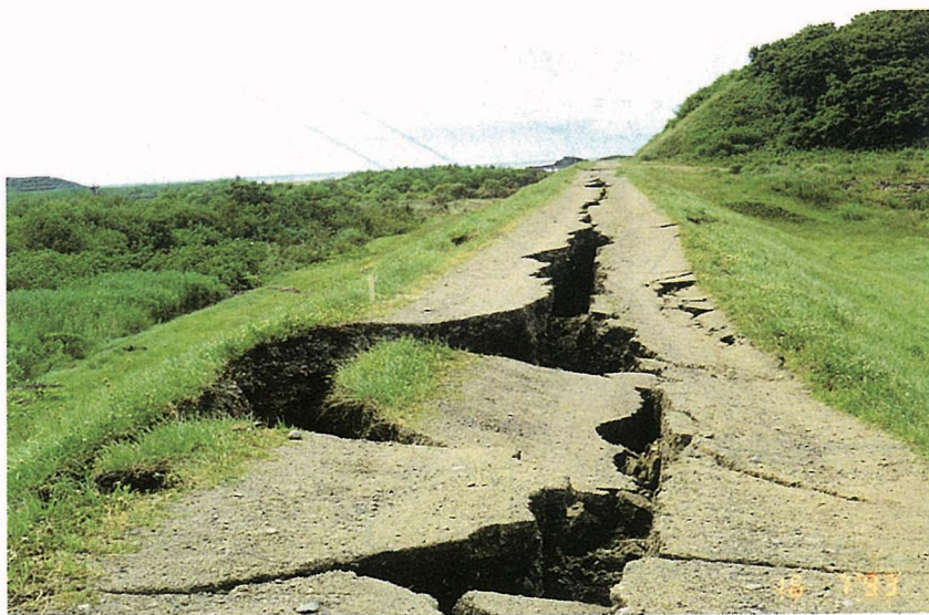
液状化により大きな亀裂・陥没が生じた堤防（後志利別川）
