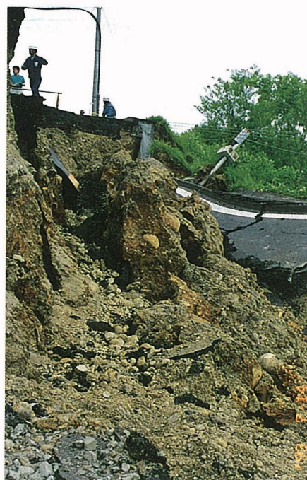
写真4-3 同 上 崩壊により生じた段差 Same as above
