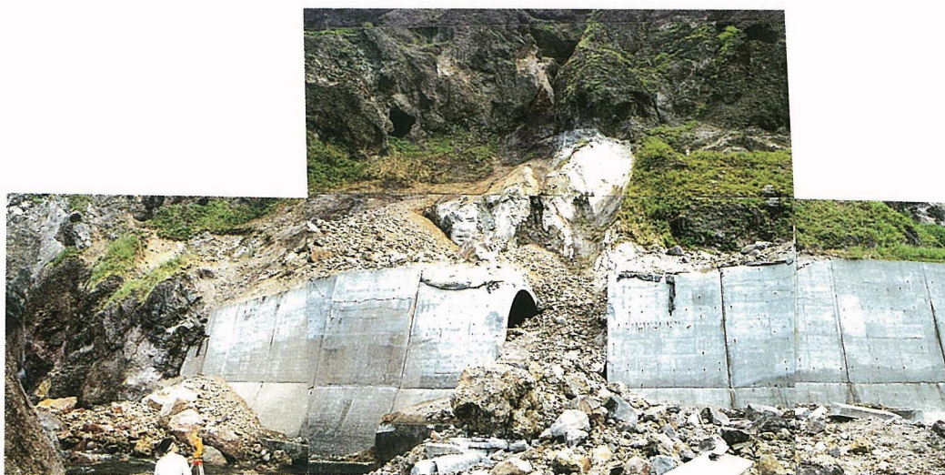
斜面崩壊により破損したトンネル（国道229号線第2白糸トンネル）
