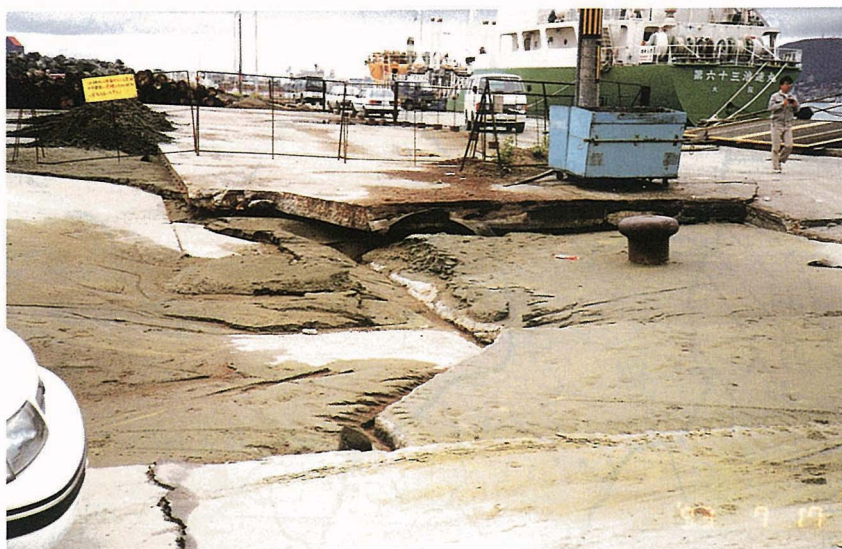
液状化により沈下・陥没した岸壁のエプロン（函館港北埠頭）
