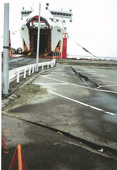
写真6-19 アスファルトの亀裂・段差、左手に噴砂跡（フェリー埠頭）
