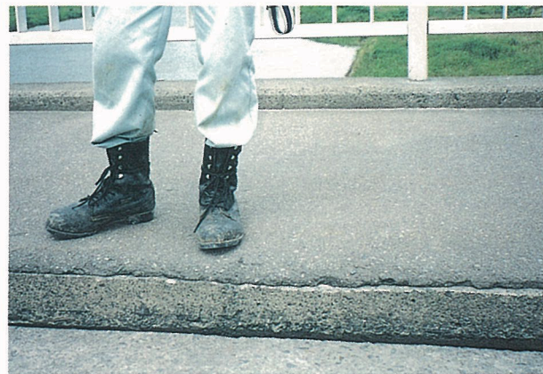
写真4-18 車道部と歩道部との段差
