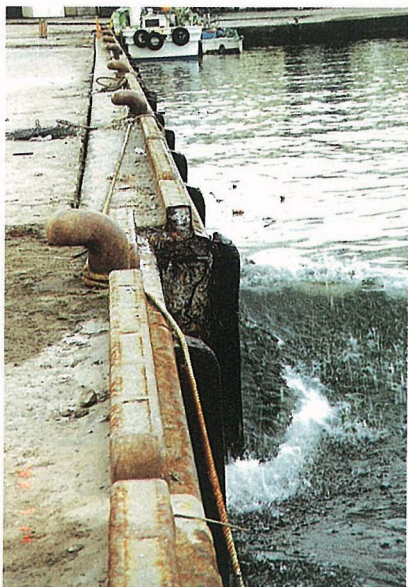
写真6-27 岸壁のせりだし（森港） Lateral displacement of the quay wall
