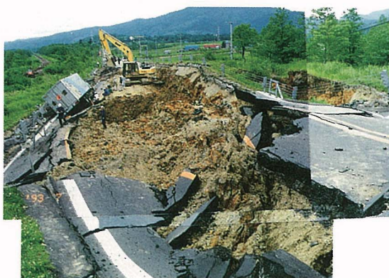
写真4-1 道路盛土の崩壊（国道5号線知来－蔵岱間） 黒松内側より長万部方向を撮影 Collapse of road embankment (Highway Route No. 5)
