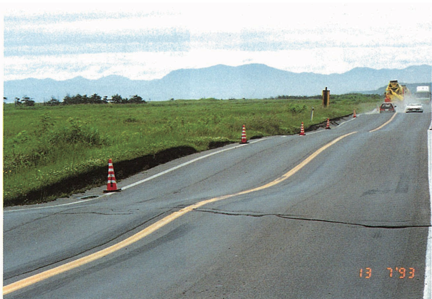
写真4-8 道路の波打ち（長万部町豊津付近） Wavy road
