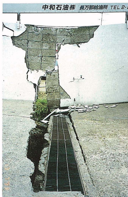
写真7-2 地割れに伴って給油所の塀に 入った大きな裂け目
