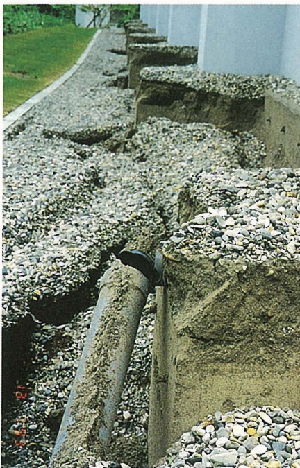
写真7-34 地盤の沈下による埋設管の切損 (中の沢小)
