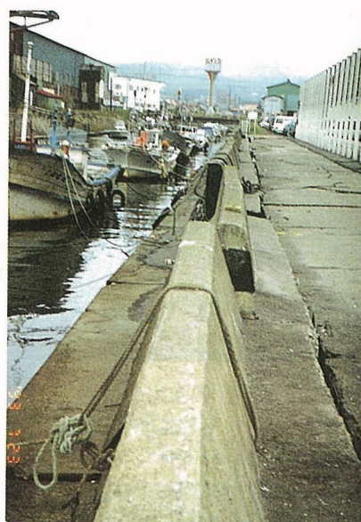
写真6-20 埠頭北側岸壁のずれ、エプロンの段差（フェリー埠頭）
