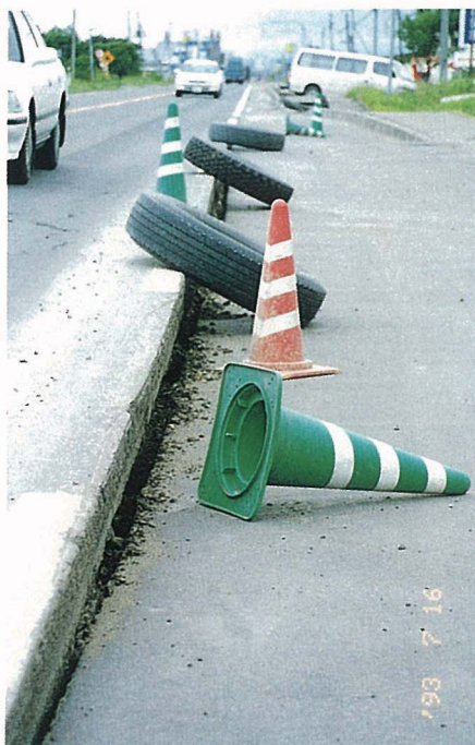
写真4-10 引き込み部との段差 Subsidence of the pavement
