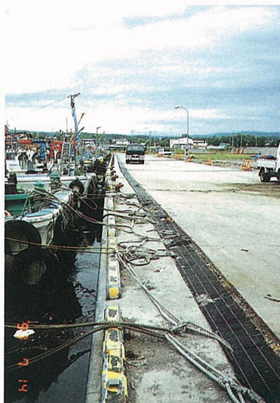
写真6-28 岸壁のはらみだし（森港） Same as the left
