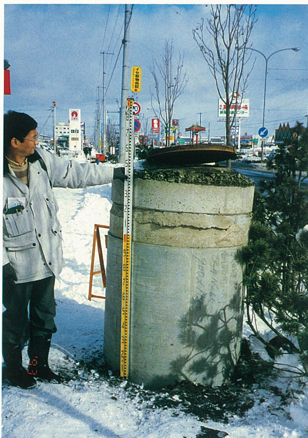
1.5m浮き上がった下水道 マンホール（釧路町桂木）
