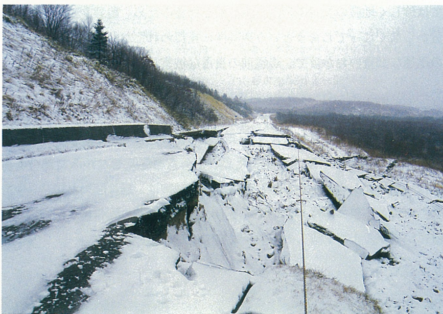
約50mにわたって崩壊した道路盛土（国道44号線厚岸町糸魚沢付近）
