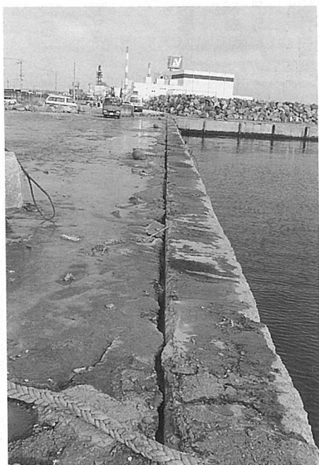
写真7-2 西港第一埠頭の亀裂と噴砂
