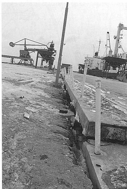
写真7-3 西港第一埠頭の地盤沈下
