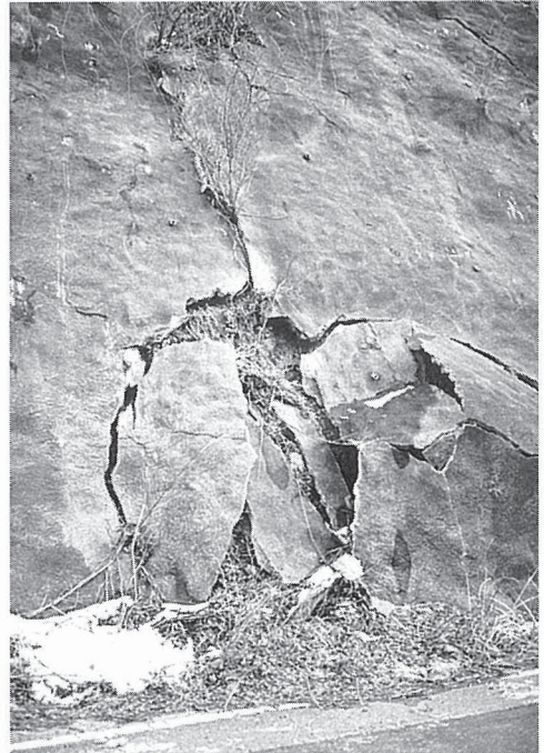
写真 4-9 県道のり面のモルタル 吹付の破損 (珠州市笹波地内)
