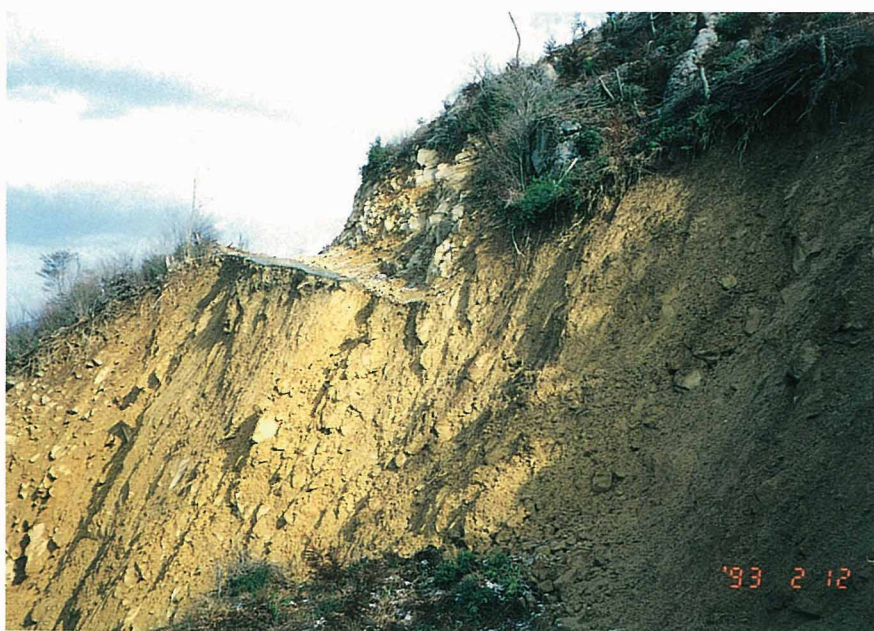
② 地震5日後に発生した斜面崩壊（柳田村久田）
