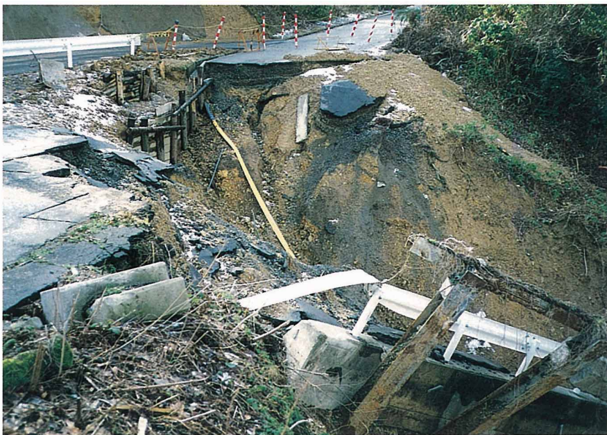
③ 道路盛土の崩壊（珠洲市東山中）
