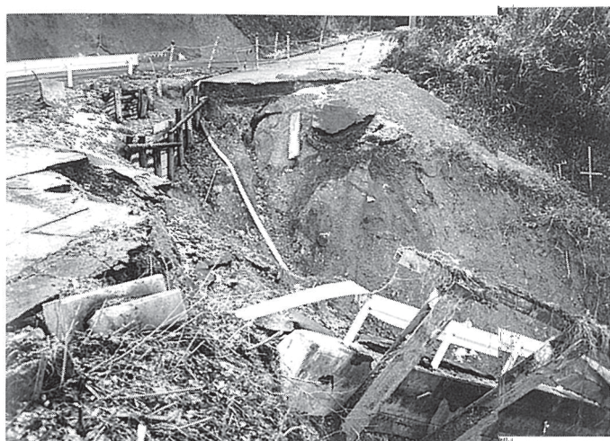
写真 4-1 道路盛土の崩壊 (珠洲地区幹線農道 ：珠州市東山中)
