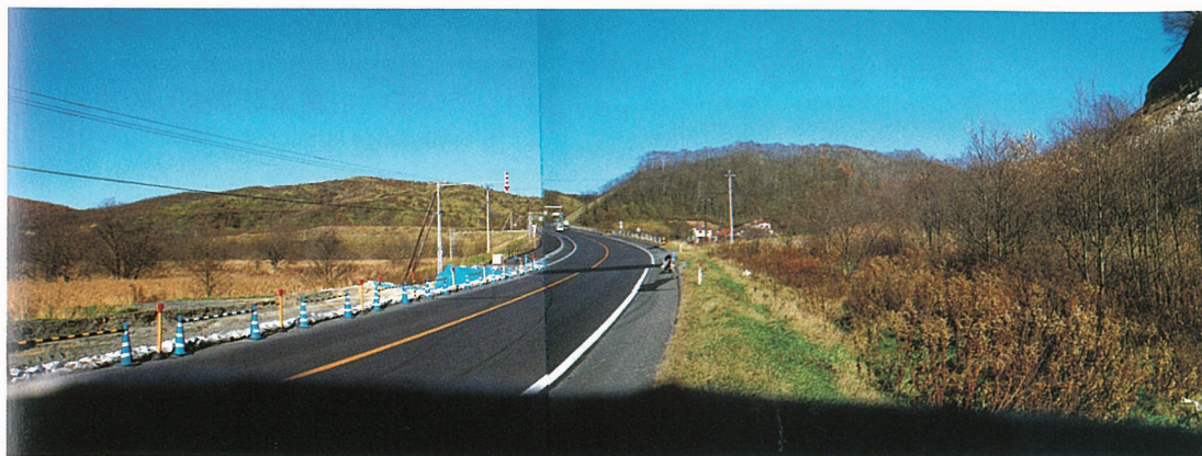
写真-4.8 国道391号釧路町達古武の路肩崩壊箇所の遠景
