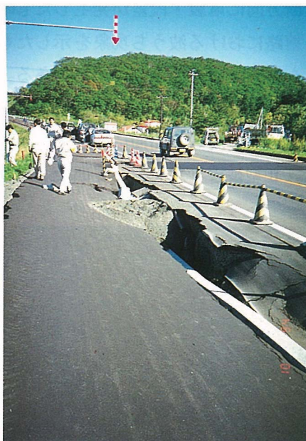
写真-4.7 国道391号釧路町達古武の路肩崩壊
