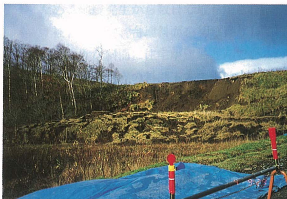
写真-5.7 宅地造成斜面の崩壊（東9条北7丁目） Slope failure in built-up area
