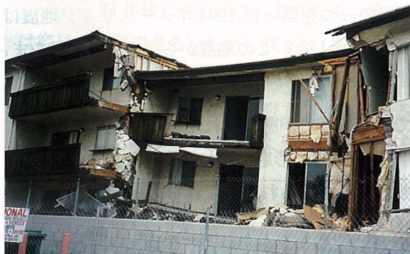
崩壊したノースリッジ・メドウズ共同住宅
