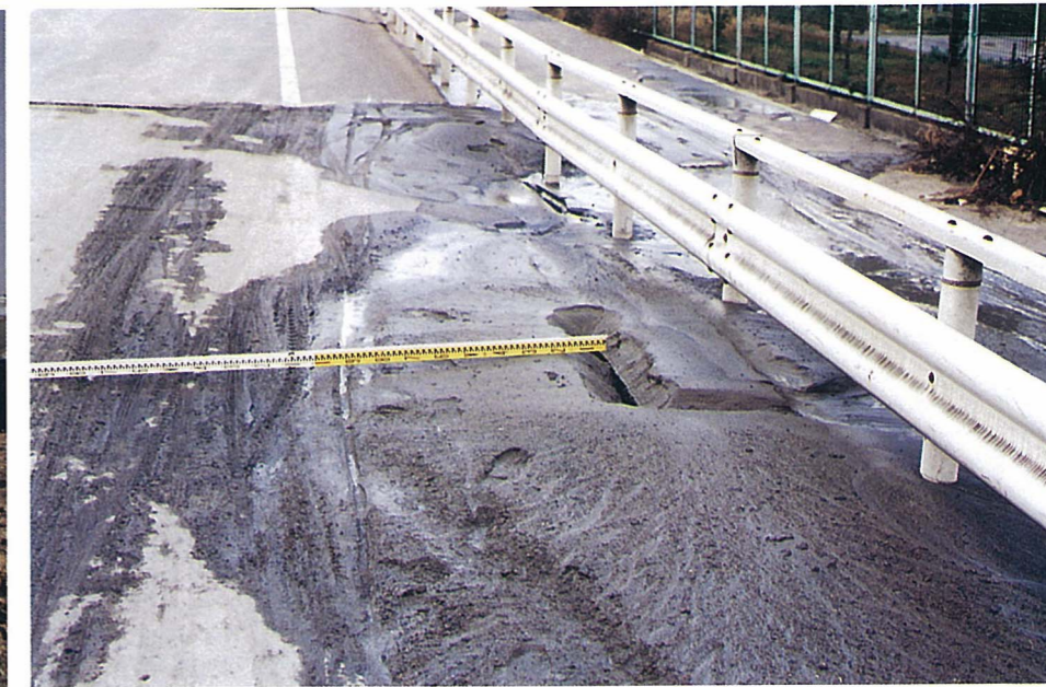
25. 淀川左岸側の噴砂
