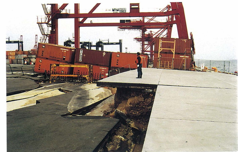
15. 六甲アイランド南側護岸の崩壊
