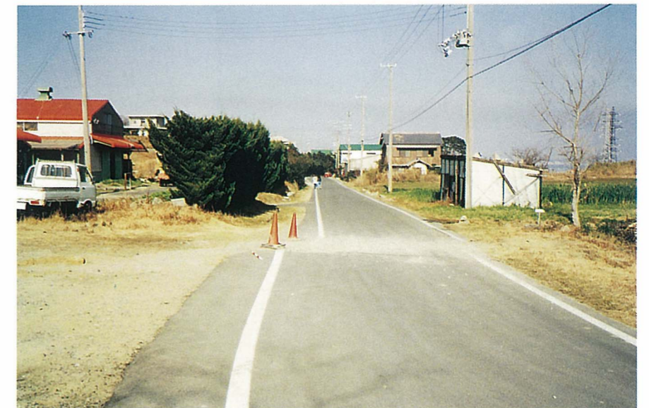
淡-12 富島地区近郊。舗装路が水平方向で約0.8mずれている。
