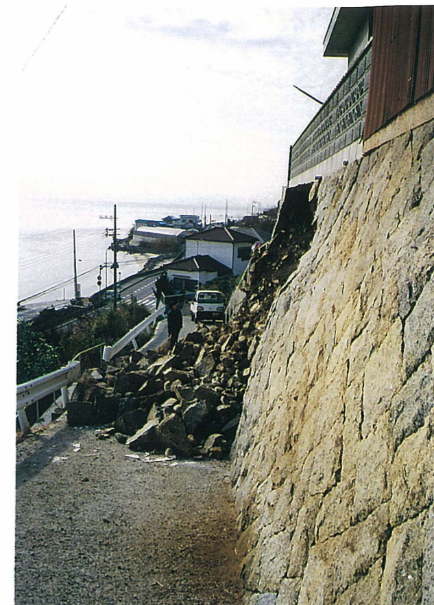
淡-1 小井地区民家石積ブロックの崩壊状況
