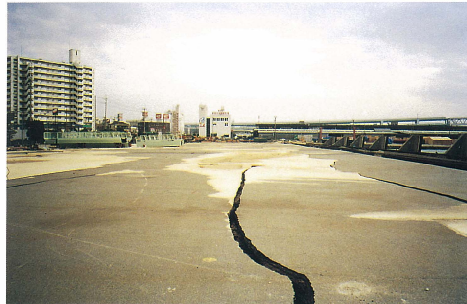
13. 深江浜西護岸の噴砂
