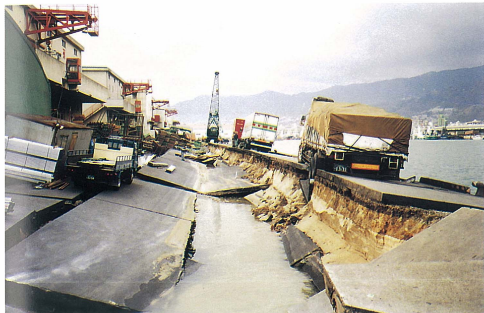
10. 深江浜北側護岸への崩壊
