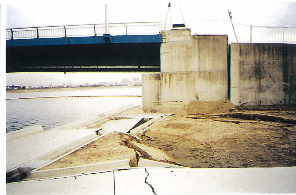
23. 甲子園浜北側護岸の崩壊
