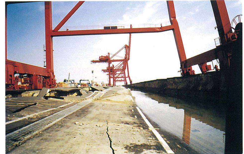
16. 六甲アイランド南側護岸の崩壊
