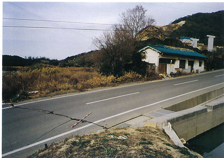
淡-5 枯木地区の道路上の地割れ及び家屋の損壊状況
