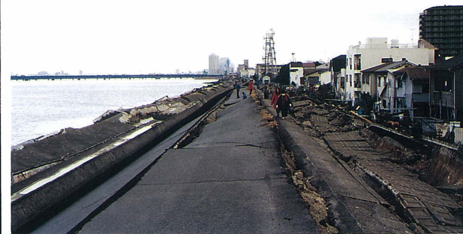
24. 淀川左岸堤防の崩壊
