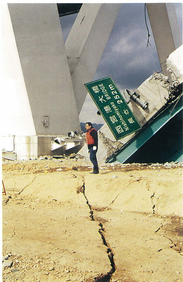
19. 甲子園浜西側のクラック
