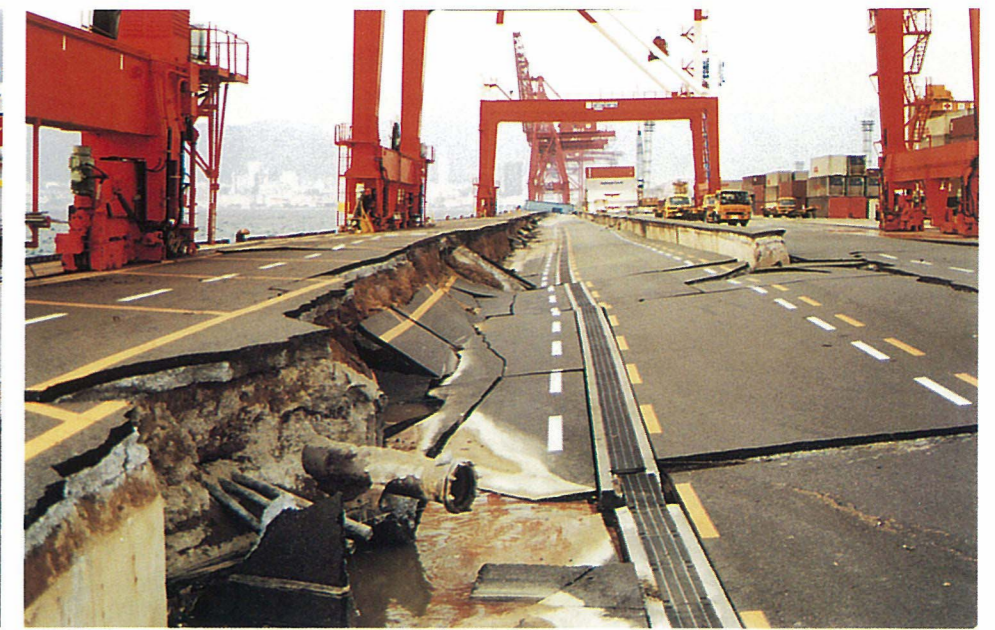
5. ポートアイランド第Ⅰ期 西側護岸の崩壊
