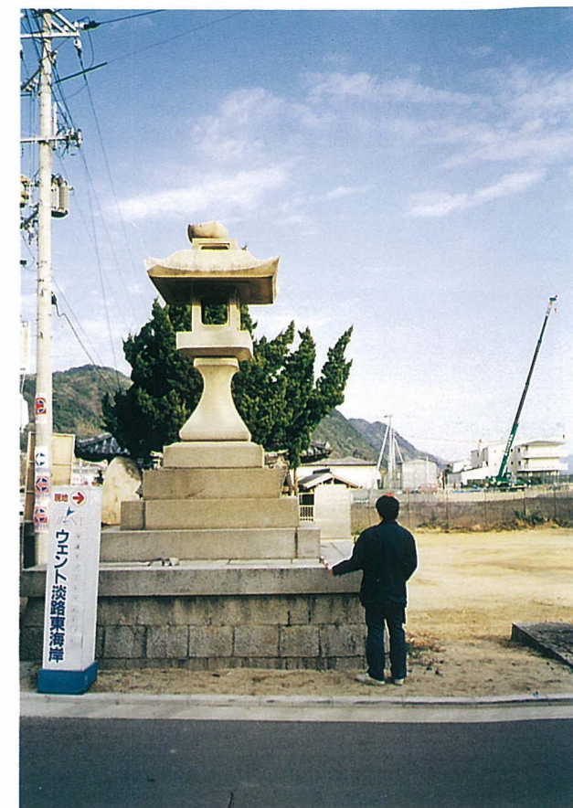
淡-2 平安浦地区燈籠の頭部破損状況
