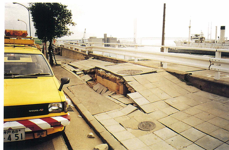
12. 深江南町のマンホール周辺地盤の沈下
