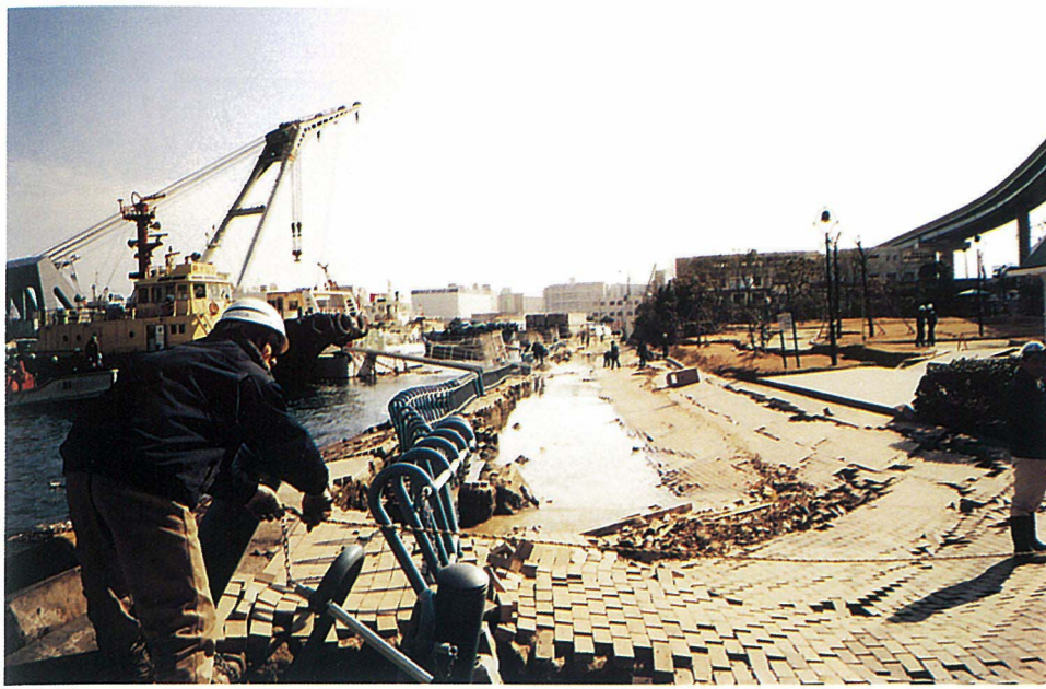
1. ポートアイランド 北側護岸の崩壊
