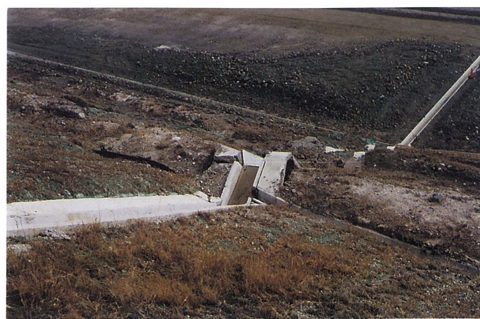
淡-19 圧縮力によりもち上がった排水路
