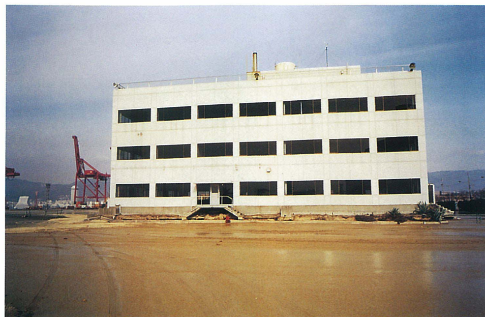
7. ポートアイランド第Ⅰ期 上屋周辺地盤の沈下
