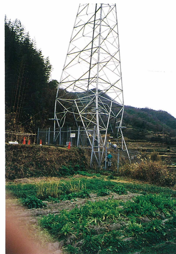
淡-3 江崎地区の鉄塔脚部の破損状況
