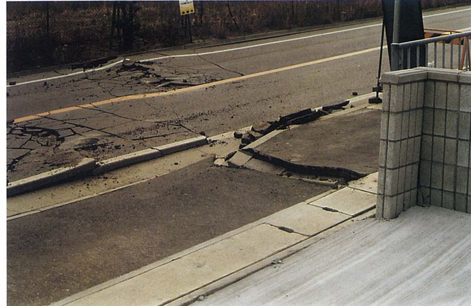
淡-21 断層による路面の破壊
