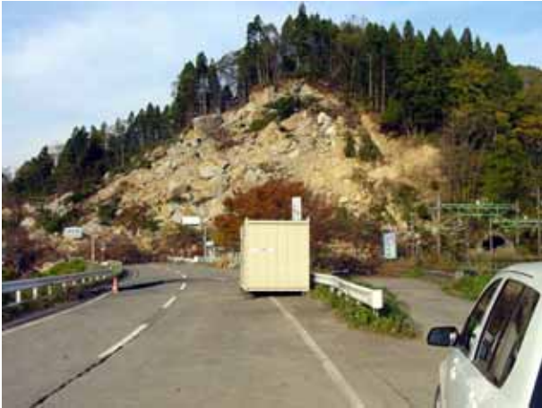
写真4.5.2 県道589号線の小千谷方向から見た崩壊地点
