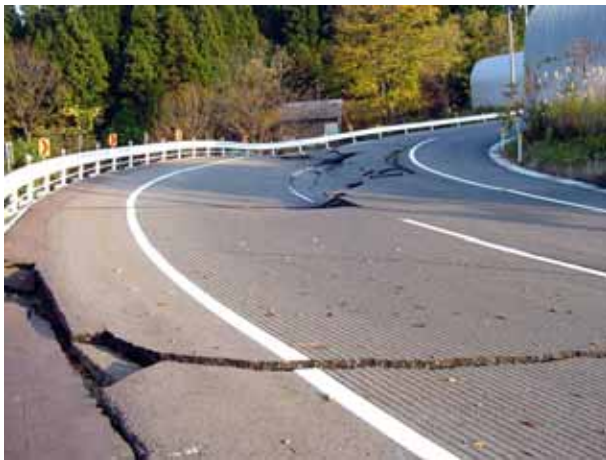
写真4.3.57 斜面上の道路の沈下・陥没（位置）
