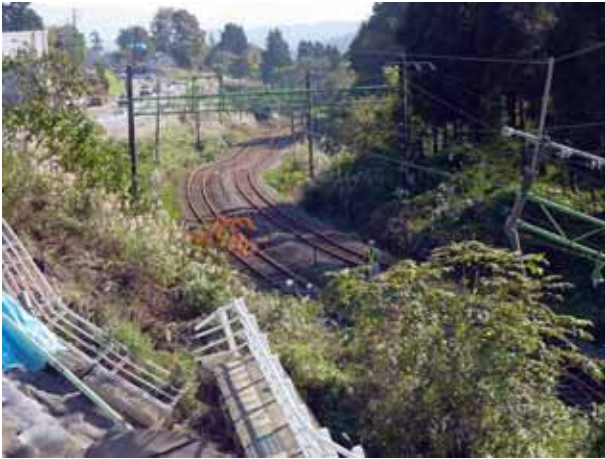
写真4.2.20 崩壊地点東（越後川口）側の線路の波打ち
