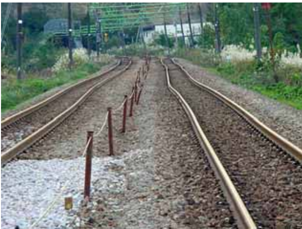
写真4.2.17 斜面崩壊地点西側の線路の不陸・蛇行
