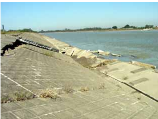
写真4.1.7 信濃川左岸の護岸崩壊
