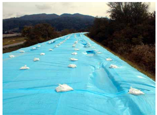
写真4.1.2 信濃川右岸堤防（長岡市大川原町）天端亀裂の養生状況。亀裂部のシートの上に雨水がたまっている
