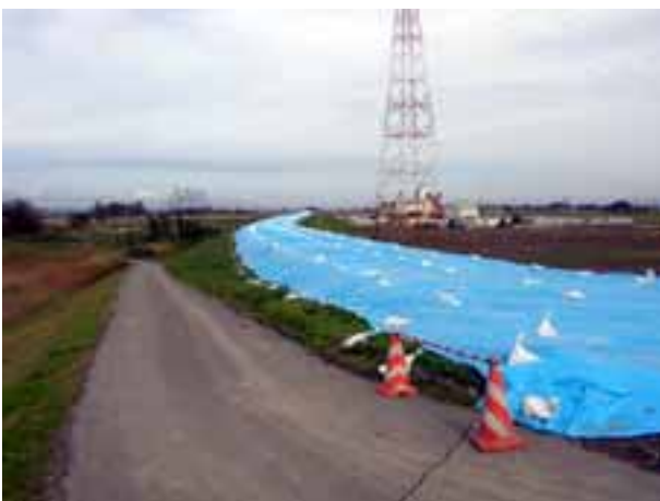
写真4.1.1 信濃川右岸堤防（長岡市大川原町）天端亀裂の養生状況
