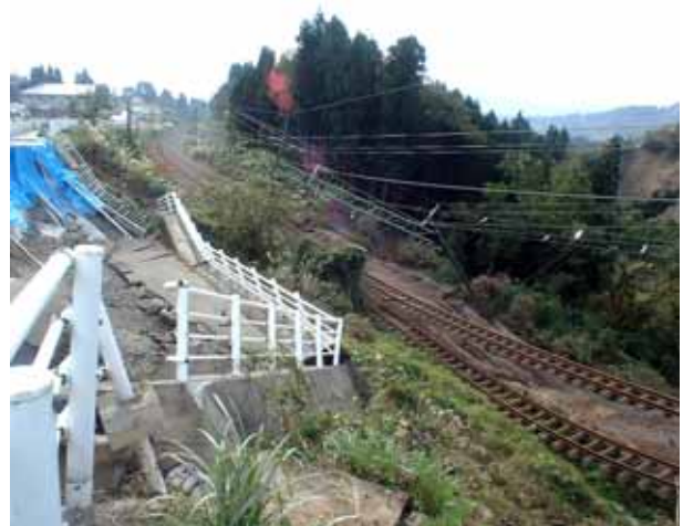
写真4.2.19 国道17号線とJR上越線の斜面崩壊
