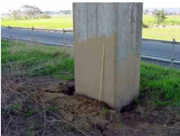
写真4.2.5 高架橋脚の根元で見られた噴泥
