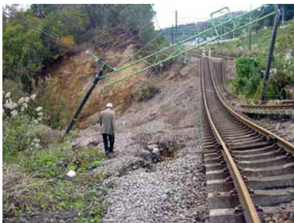
写真4.2.18 路床が滑り破壊を起こして線路が宙づりになった
