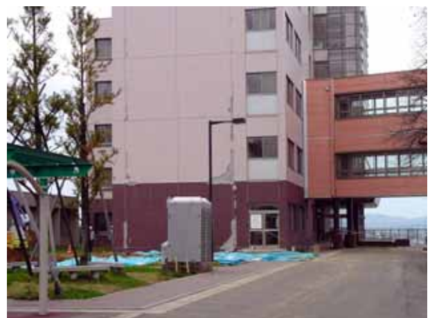
写真4.6.25 壁のモルタル剥落
