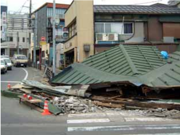
写真4.6.1 木造建物の倒壊
