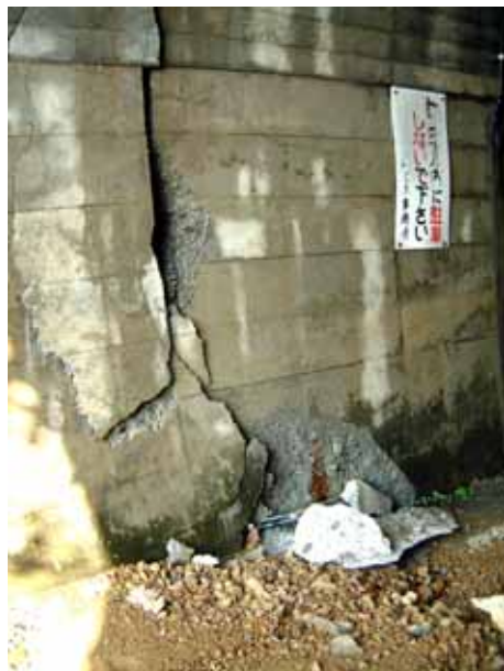
写真4.5.30 トンネル壁の亀裂
