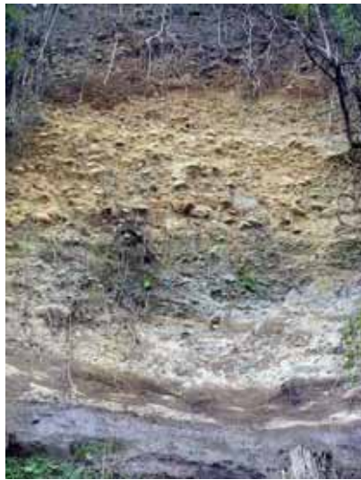
写真4.3.45(2) 同上。崩壊した斜面の様子
