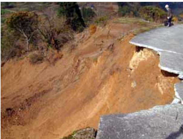
写真4.5.23 崩壊頂部の近景
