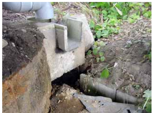
写真4.3.35 同左。周辺地盤のすべり沈下によるU字溝の段差
