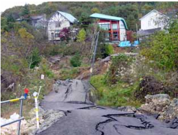
写真4.6.39 ため池沿いの道路の崩壊。ため池の方向にすべり落ちるように崩壊した
