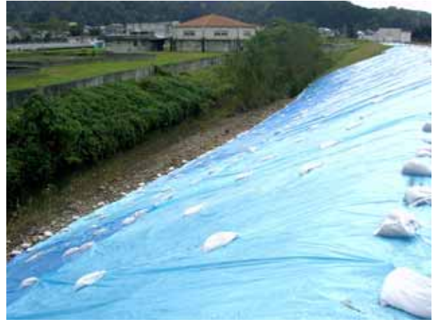
写真4.1.4 堤防崩壊現場（長岡市三俣野町）の 応急復旧状況。シート養生
