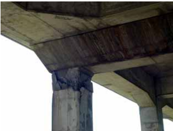
写真4.2.3 高架橋脚のコンクリート剥離
