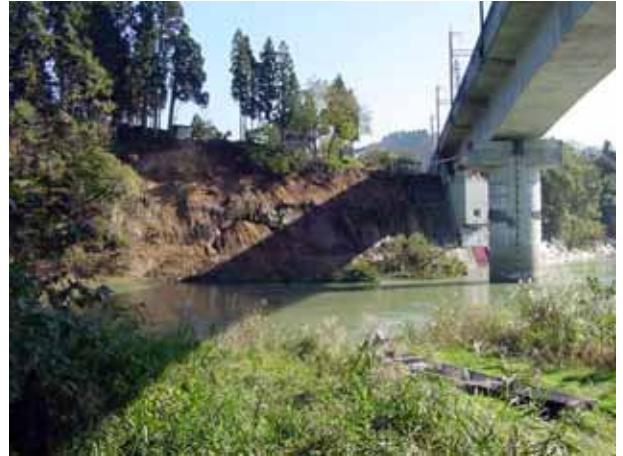
写真4.2.11 P 2 橋脚の被りコンクリートの剥落
