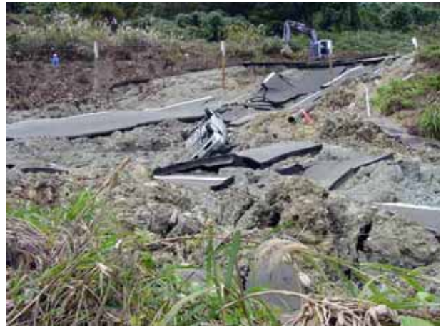
写真4.3.27 川井大橋北側の道路崩壊。道路は斜面端の盛土と思われる（位置図）
