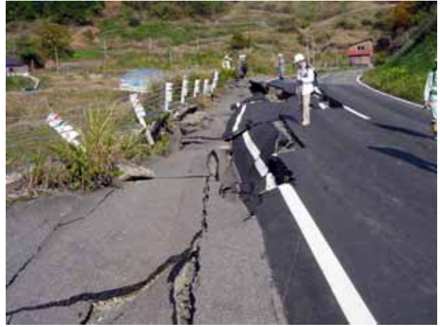
写真4.3.54 斜面上の道路路肩の沈下・陥没（位置）
