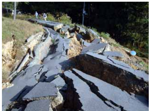
写真4.3.47 外周道路のすべり・陥没
