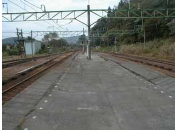
写真4.2.29 上越線川口駅ホームの沈下
