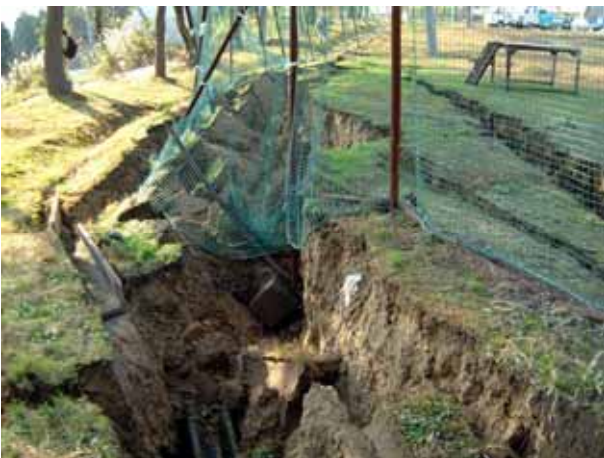
写真4.6.46 法面に近いグラウンド端における大きな亀裂
