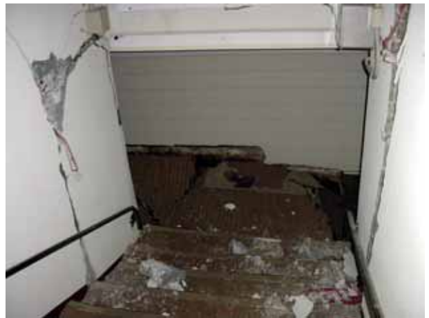
写真4.2.31 同左。地下連絡通路の入口
