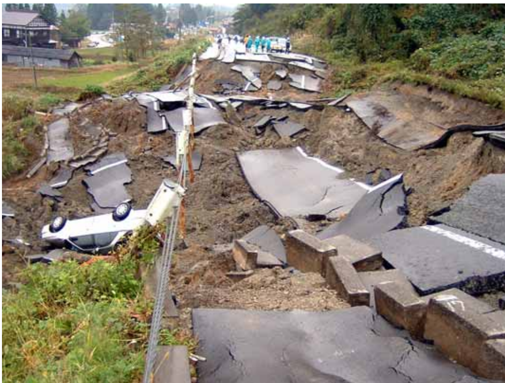
道路の崩壊（国道 117 号 小千谷市塩殿）
