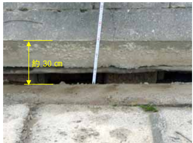
写真4.1.8 法尻部の約30cmの段差。止水矢板が露出している
