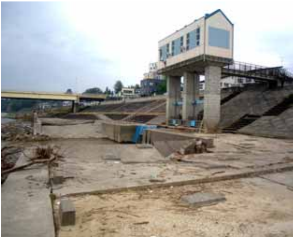
写真4.1.7 茶郷川樋門周辺の護岸変状
