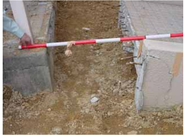
写真4.6.27 同左近景。約70cm開いている
