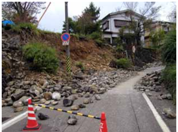
写真4.6.6 宅地法面積み石の崩落
