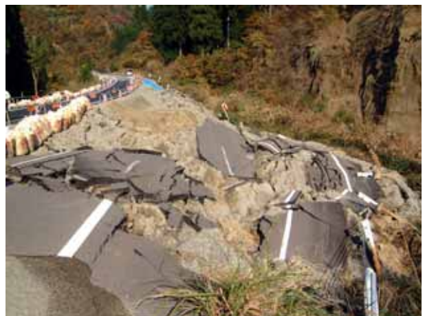
写真4.3.43 同上。西側より見た崩壊地点
