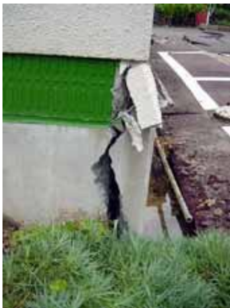
写真4.6.21 基礎壁面の破壊
