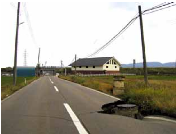
写真4.4.1 国道403号沿線（小千谷市吉谷）の下水道マンホール浮上
