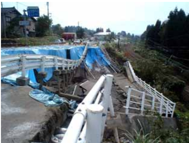
写真4.3.11 路肩のすべり崩壊
