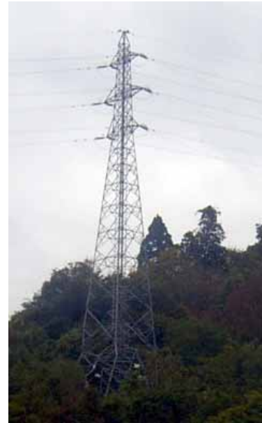
写真 4.4.8 同左。鉄塔下部の部材が座屈した鉄塔の近景
