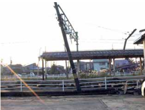
写真4.2.22 駅構内の架線柱の傾斜
