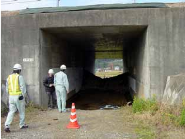
写真4.3.1 開口・沈下したボックスカルバート（小千谷2）
