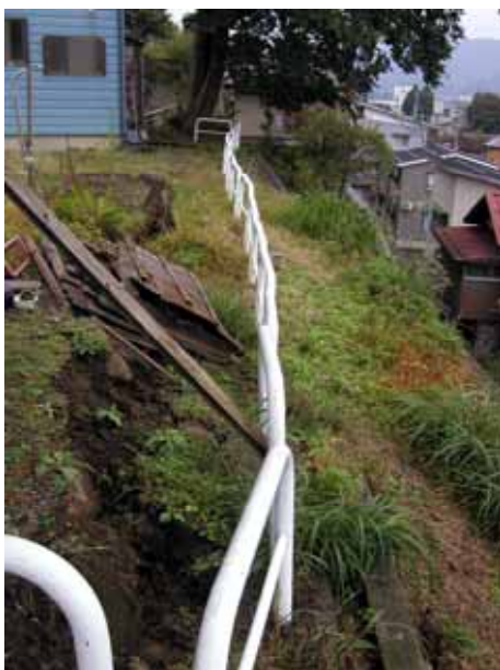
写真4.6.5 宅地法肩の亀裂
