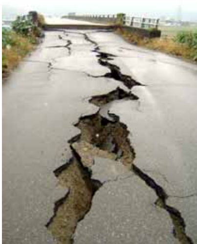
写真4.3.44 堀之内町下島のJR跨線橋。橋梁取付部の段差と縦断亀裂（県道333号線）
