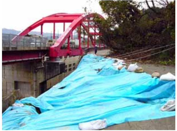
写真4.3.37 橋梁横の斜面の崩壊
