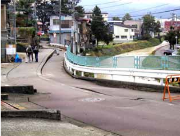
写真4.3.48 小千谷市本町。道路の河川側の半分が沈下している
