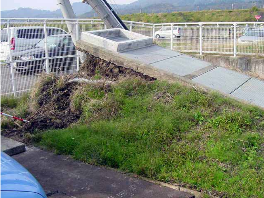
浄化槽の浮き上がり（小千谷市桜町）
