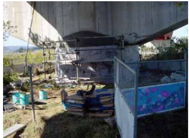
写真4.3.15 右岸側第1橋脚のコンクリートが一部剥落したが、調査時には補修されていた
