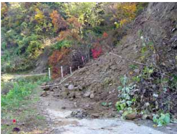
写真4.3.50 山間道路の土砂崩れによる埋 (十日町市慶地)
