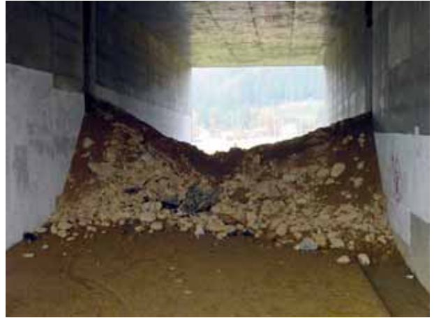
写真4.3.2 開口して土砂が流入したカルバート内部
