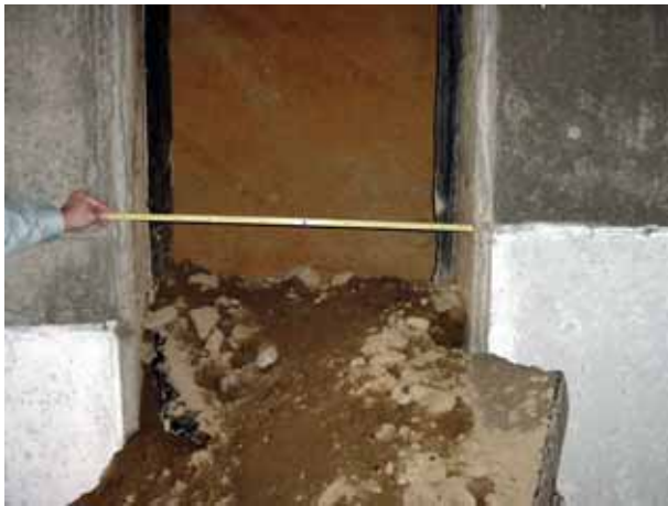
写真4.3.3 開口部の近景(開口幅約82cm)。背後に仮復旧の鋼板が設置されている
