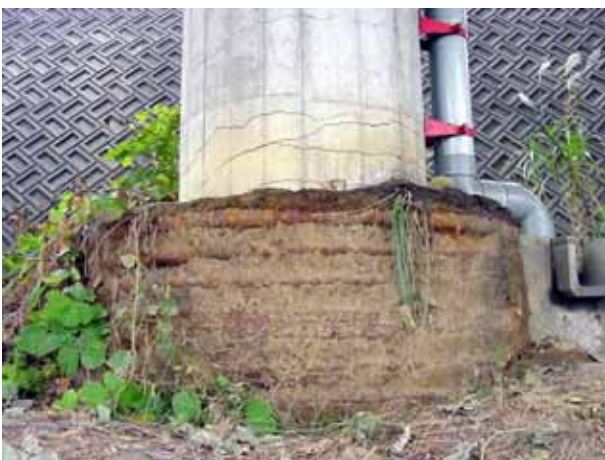
写真4.3.34 基礎の抜け上がり（周辺地盤の沈下）と橋脚下部の亀裂
