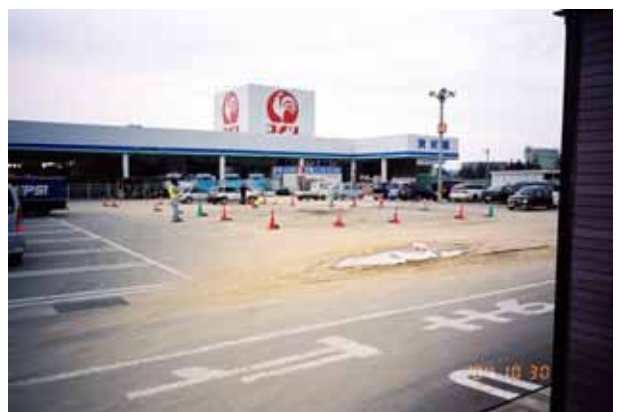
写真4.7.5 駐車場内の噴砂
