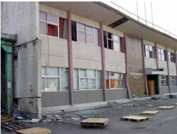
写真4.6.3 鉄骨造建物の変形
