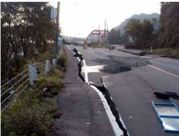
写真4.3.40 橋梁西側の道路端の亀裂。道路の左側は斜面となっている
