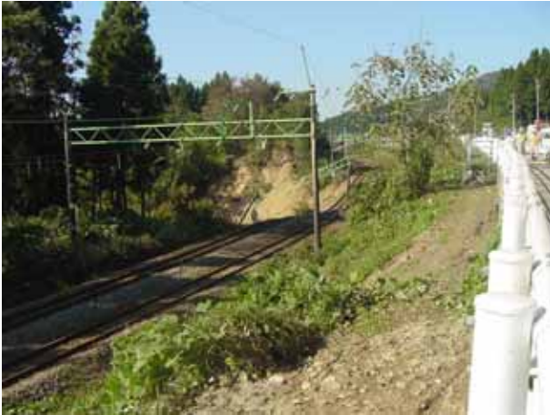
写真4.3.13 崩壊範囲は国道とJRの部分だけでなく脇の自然斜面まで広がっている
