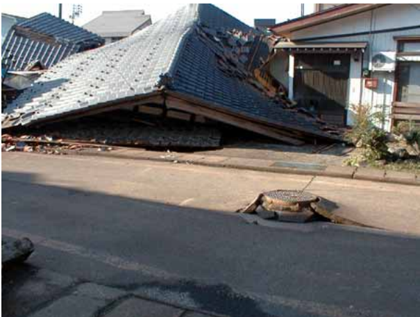
写真4.6.9 建物の全壊とマンホールの突出
