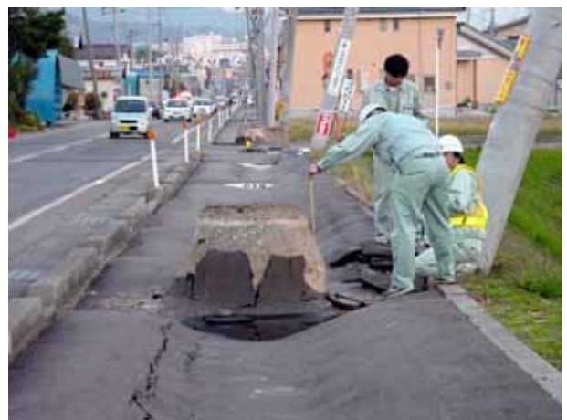
写真4.4.2 国道291号沿線（小千谷市桜町）の下水道マンホール浮上
