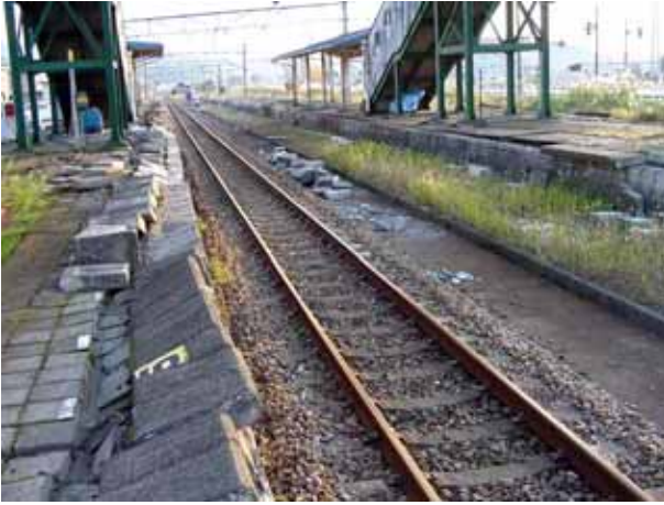
写真4.2.24 ホーム敷石の被害。線路には蛇行・不陸等の変状はみられない
