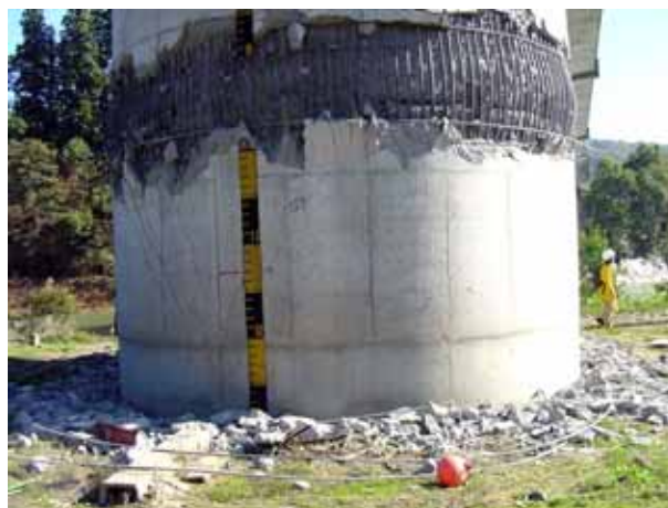
写真4.2.9 同左近景。主鉄筋がはらみ出している
