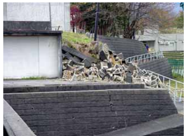
写真4.6.31 ブロック積み擁壁の崩壊
