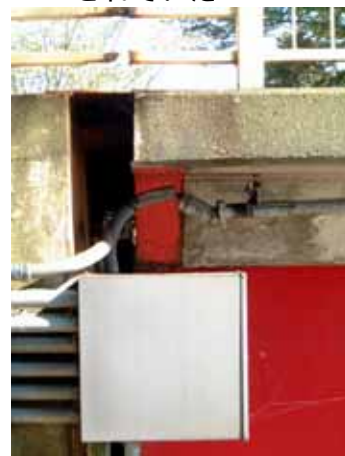
写真4.3.17 配線の断裂、欄干にも隙間が生じている
