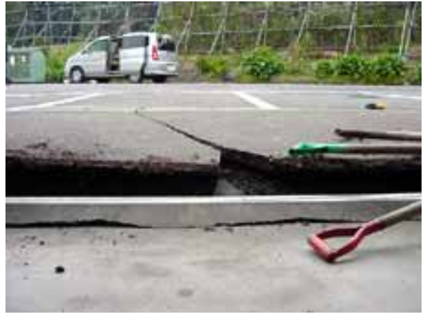
写真4.6.18 建物入口から見た周辺地盤との段差
