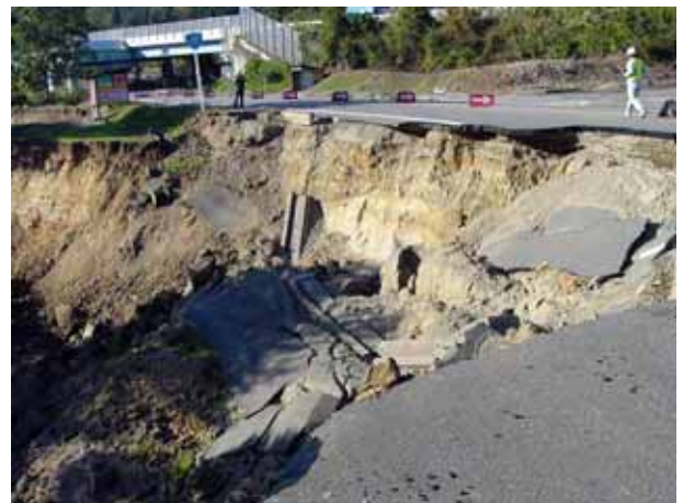
写真4.3.23 道路脇斜面の崩壊。路肩の一部は崩壊したが、車線は確保されている
