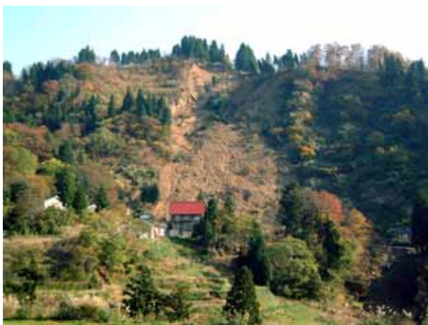
写真4.5.24 羽黒山トンネル西口の斜面崩壊全景
