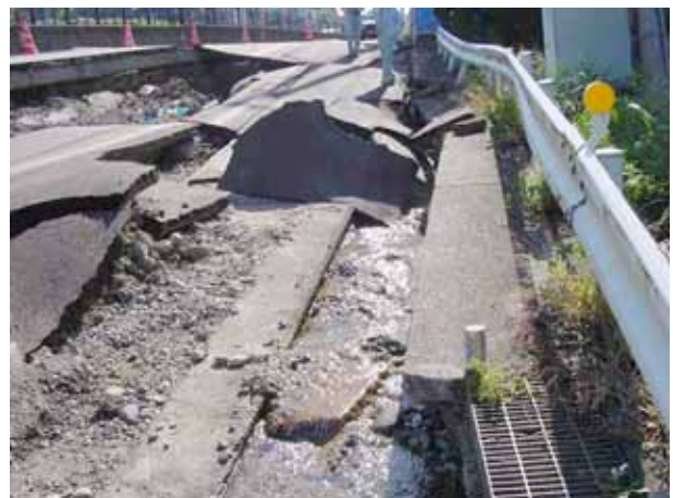
写真4.3.21 上水道の被害によると思われる流水
