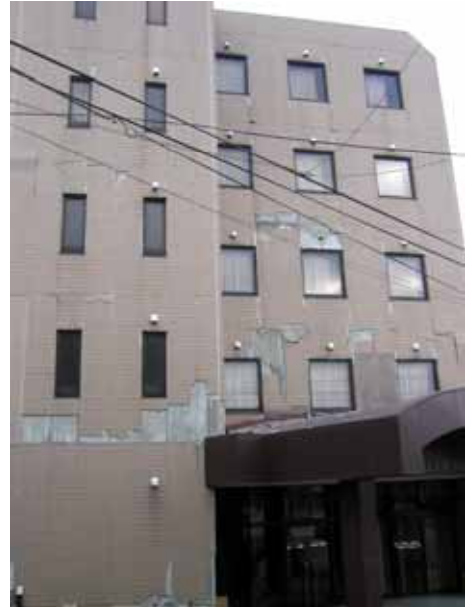
写真4.6.2 壁タイルの剥落
