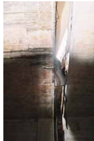
写真4.3.4 川口IC付近のC-BOX上部。開口して空が見える
