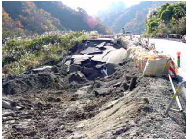
写真4.3.42 東側より見た崩壊地点。道路が中央付近から谷側に崩壊した
