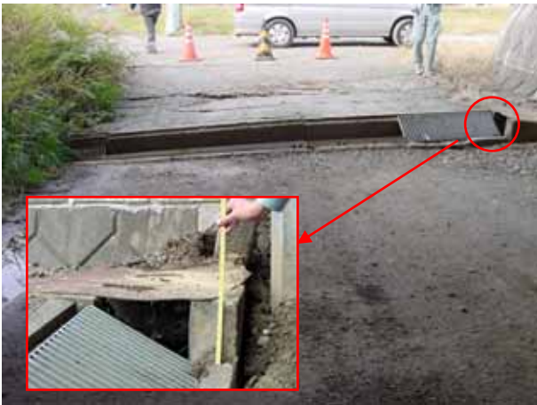
写真4.3.7 カルバートの沈下により生じた段差
