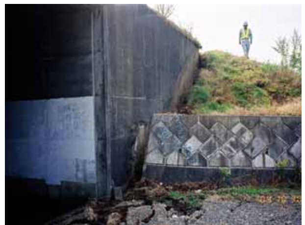
写真4.3.6 カルバートと盛土擁壁の隙間。壁面に盛土と擁壁の跡が残っている
