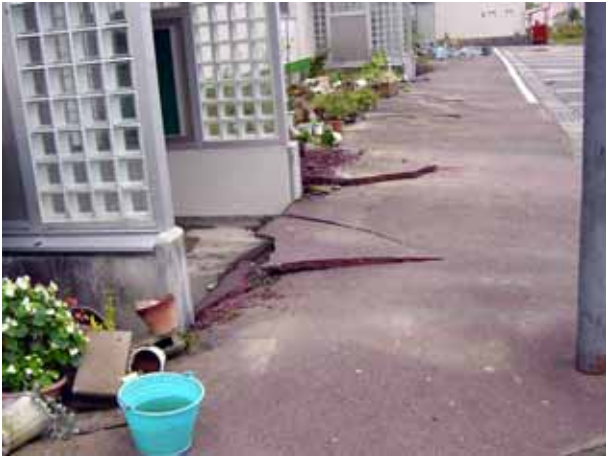
写真4.6.17 建物玄関部分のめり込みの状況
