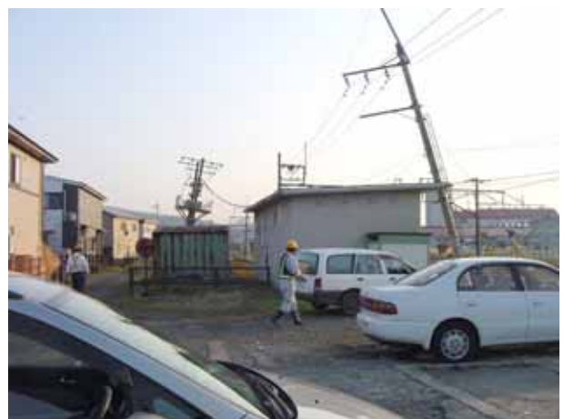
写真4.2.23 駅構内の電柱の傾斜
