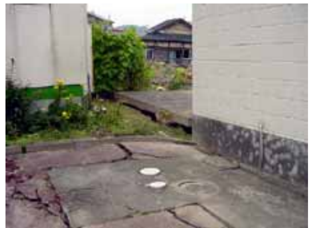
写真4.6.22 浄化槽の浮き上がり
