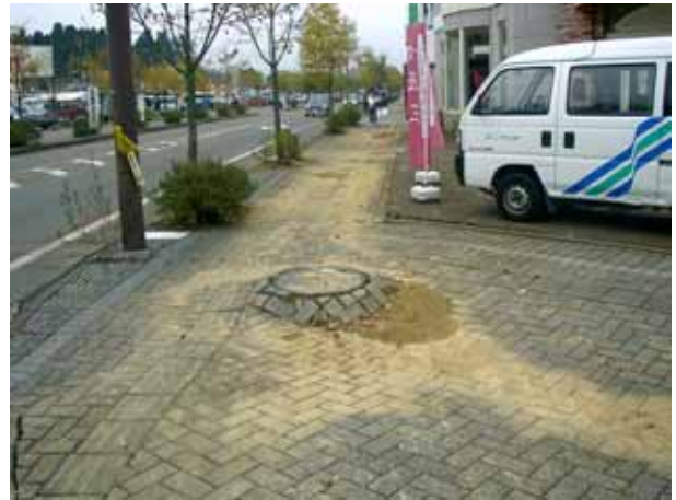
写真4.7.11 管路に沿った噴砂跡
