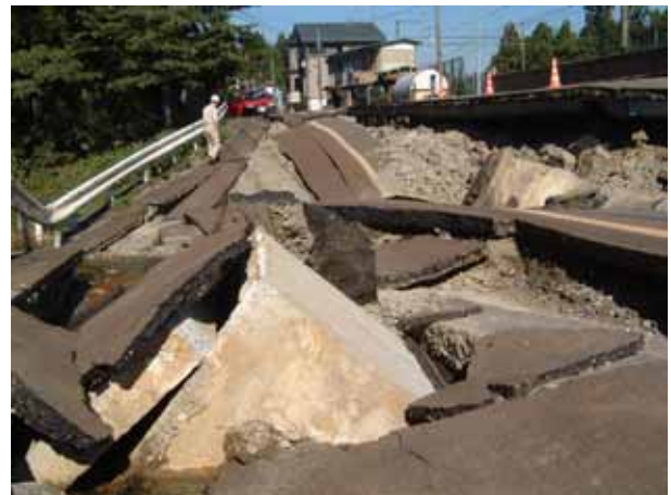
写真4.3.19 マンホール（奥）と雨水枡？（手前）の転倒
