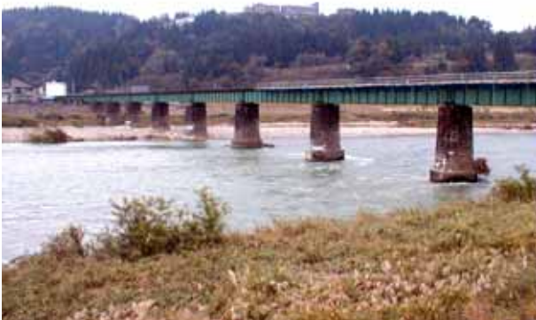
写真4.2.32 飯山線魚野川橋梁橋脚の被害
