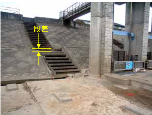
写真4.1.9 茶郷川樋門の抜け上がり。階段部分に段差がある
