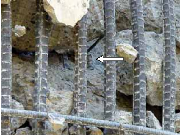
写真4.2.10 P 3 橋脚の被りコンクリートの剥落部分の近影。段落とし部の鉄筋の先端が見える（矢印）
