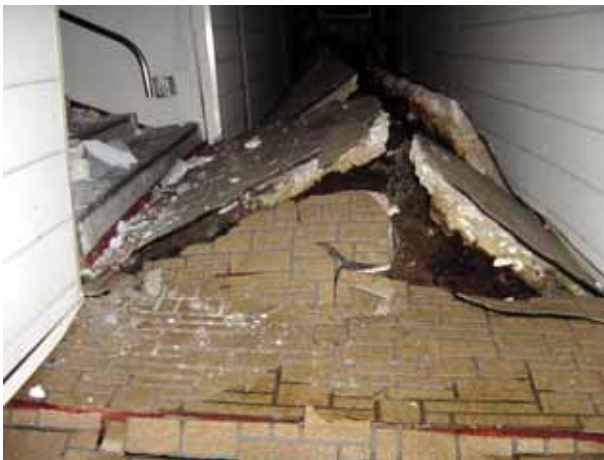
写真4.2.30 床が膨れあがった地下連絡通路
