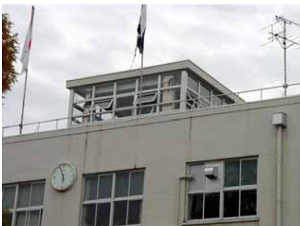
写真4.6.24 柱が破壊した展望塔。時計は本震発生時刻で停まっている
