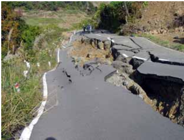
写真4.3.55 斜面上の道路の崩壊（位置）
