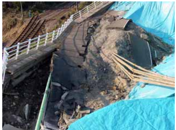
写真4.4.12 国道17号線崩壊箇所で見られた各種埋設管・ケーブル
