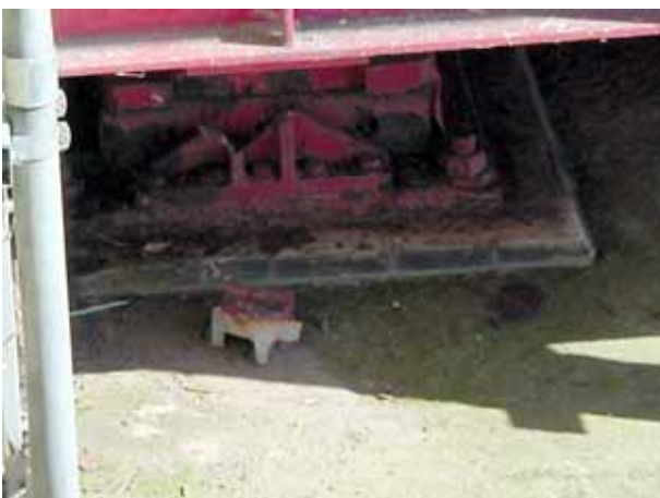
写真4.3.16 左岸側橋台の支承金具の一部欠落
