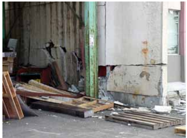
写真4.6.4 同左。コンクリート亀裂・陥没
