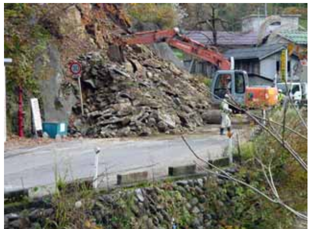
写真4.5.16 道路沿いの岩盤崩壊
