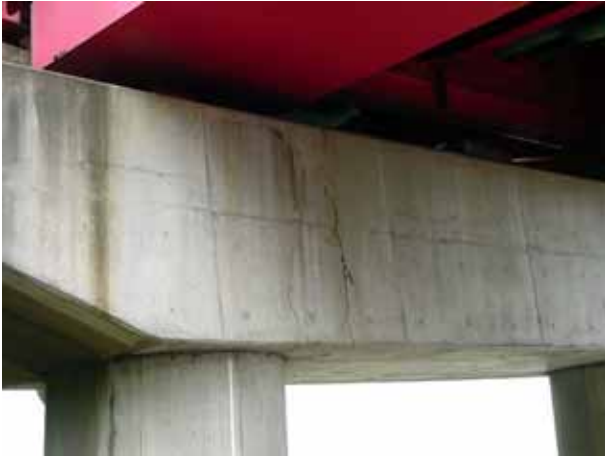
写真4.3.36 ラーメン型橋脚横梁の亀裂
