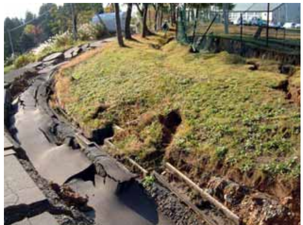
写真4.6.45 グラウンド脇の道路の陥没
