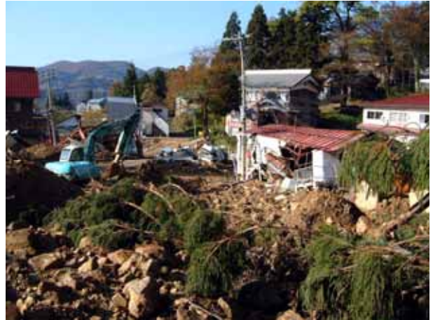
写真4.5.27 崩壊土砂により被害を受けた建物
