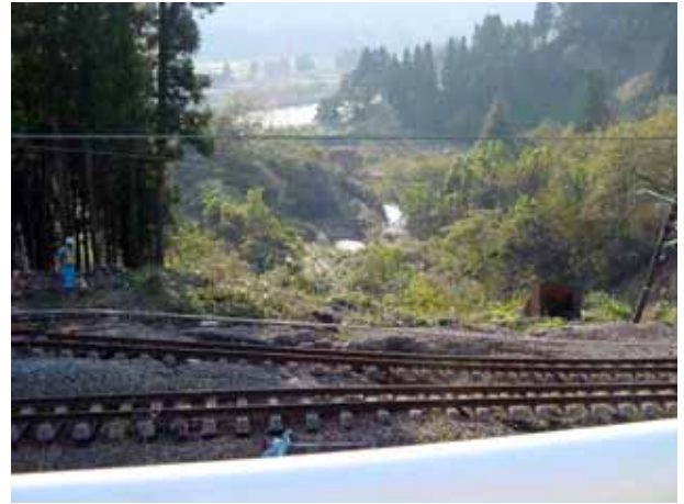
写真4.2.21 国道17号線より信濃川の方角を見る。崩壊した路盤の向こう側に小河川のような水面が見える
