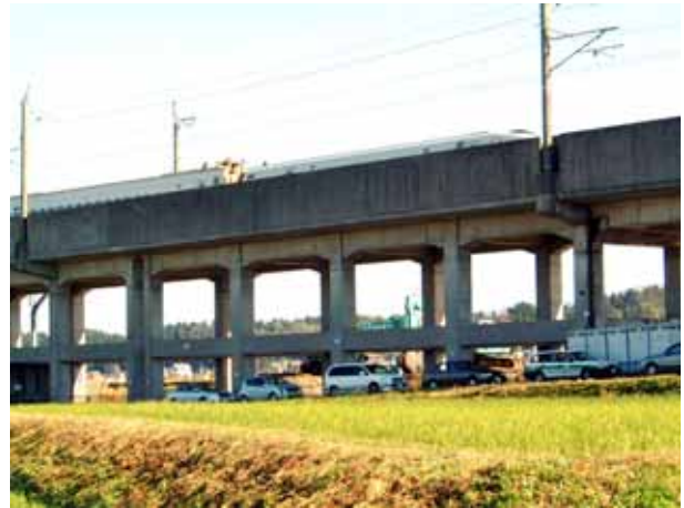
写真4.2.2 脱線して傾いた「とき325号」の最後部車両
