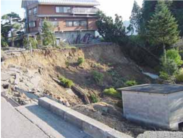
写真4.3.24 家屋は危うく滑落を免れた。右方は崩壊土砂とともに滑り落ちた物置（位置図）
