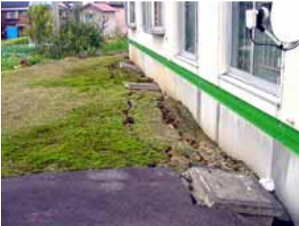
写真4.6.19 建物裏のめり込みの状況
