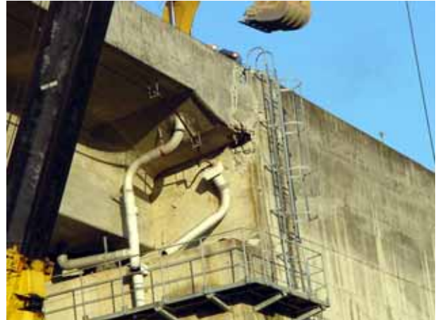
写真4.3.10 橋台と橋桁連結部におけるコンクリートの亀裂・剥落
