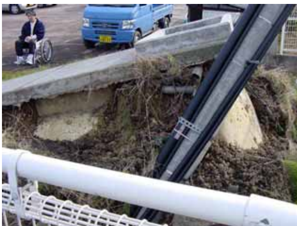
写真4.4.5 浄化槽と思われる地下構造物の浮き上がり（小千谷市桜町）
