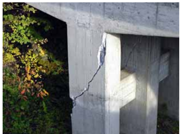
写真4.5.7 新浦柄橋の隣にある旧道の橋脚のせん断クラック
