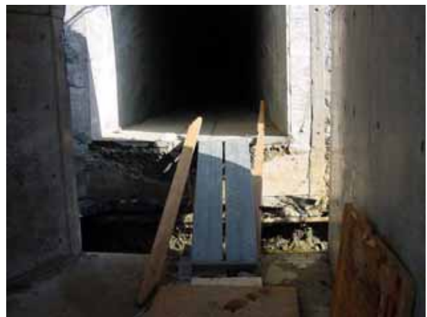
写真4.5.31 歩行者用トンネル入口の段差
