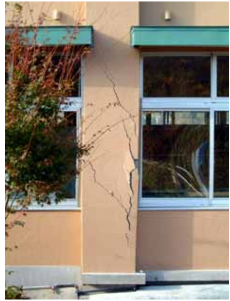
写真4.6.43 校舎の柱に生じたせん断亀裂
