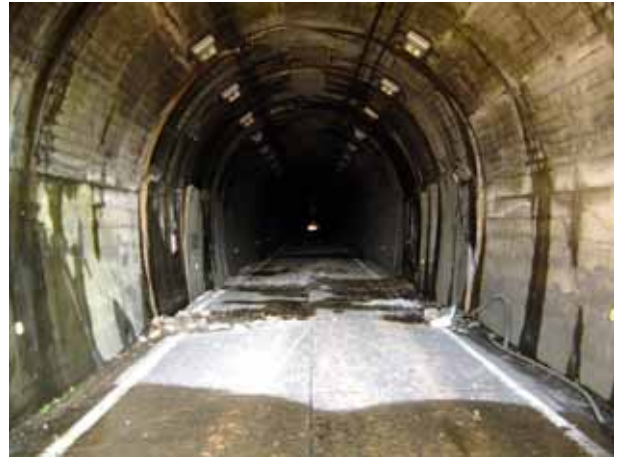
写真4.5.29 トンネルの内部。コンクリートが剥落している。
