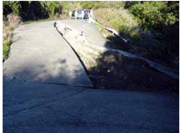
写真4.3.46 小千谷市塩殿付近。大きく崩れた農道（位置は図4.3.7参照）
