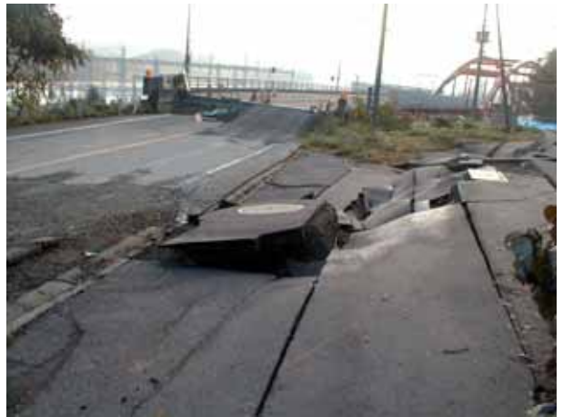
写真4.3.39 同左。中央は電信用人孔
