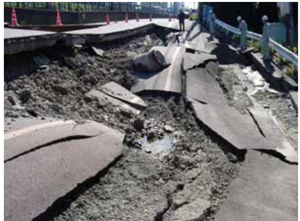
写真4.4.13 国道291号線の道路崩壊で見られた下水道マンホール
