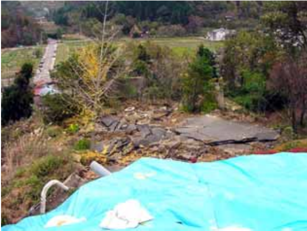
写真4.6.33 高町1丁目東斜面の崩壊下部の様子。擁壁や下水道人孔等が散乱している（位置）
