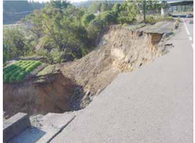
写真4.3.25 隣接したもう一つの崩壊箇所。左方の崩壊土砂は原形を留めている（位置図）
