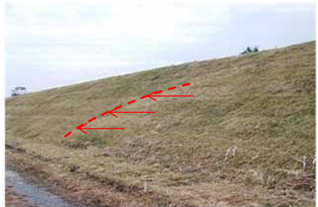
写真4.1.6 信濃川左岸堤防法面のはらみ出し
