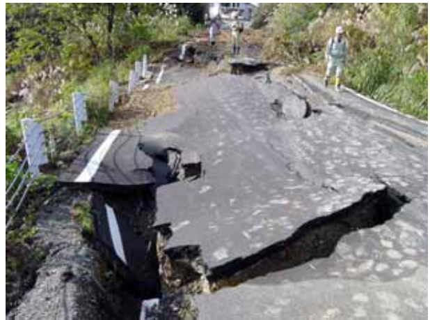
写真4.3.56 斜面上の道路の沈下・陥没（位置）
