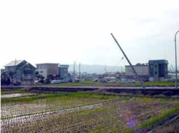
写真4.4.10 大きく傾斜した電柱(小千谷市桜町)
