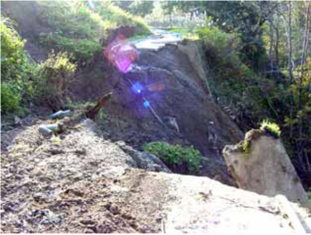
写真4.3.53 斜面上の農道の崩落。擁壁ごと崩落している（位置）
