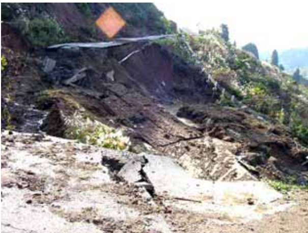
写真4.3.51 斜面上の道路の崩落(位置)
