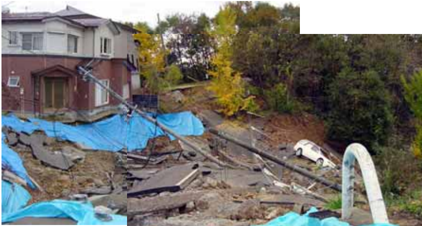
写真4.6.35 高町4丁目南西側斜面の崩壊（位置）
