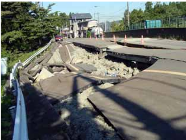
写真4.3.18 路肩の崩壊の様子
