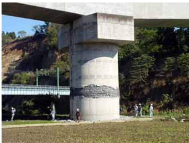
写真4.2.8 P 3 橋脚の被害の遠景
