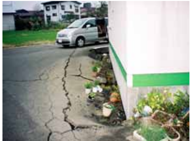
写真4.6.20 側面の沈下状況
