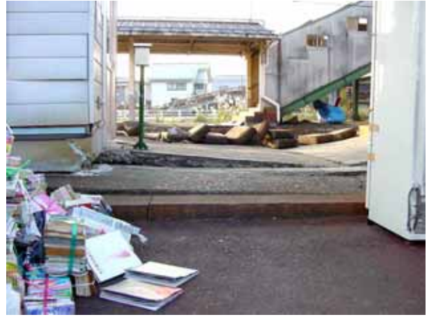
写真4.2.25 駅舎横の地盤の沈下・傾斜
