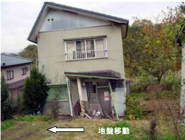
写真4.6.41 斜面上に建つ家屋の地盤移動による変形
