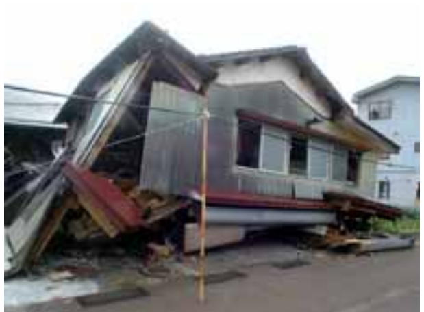
写真4.6.10 1階部分が潰れた家屋
