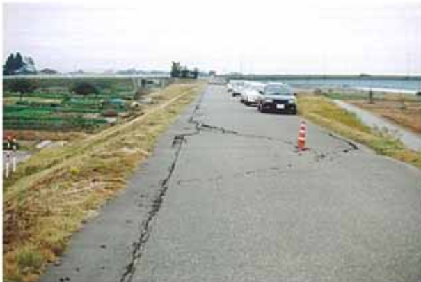
写真4.1.5 信濃川左岸堤防天端のすべり破壊 による亀裂
