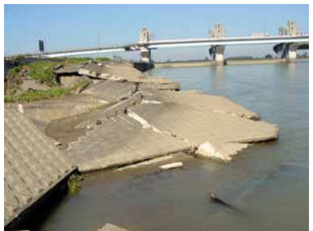
写真4.1.8 信濃川左岸の護岸崩壊。向こう側 に見えるのは越の大橋
