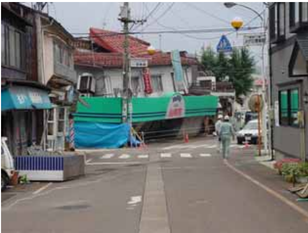
写真4.6.7 駅前から信濃川方向を望む。1階部分が倒壊した商店
