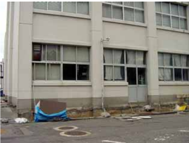
写真4.6.28 建物周辺地盤の沈下
