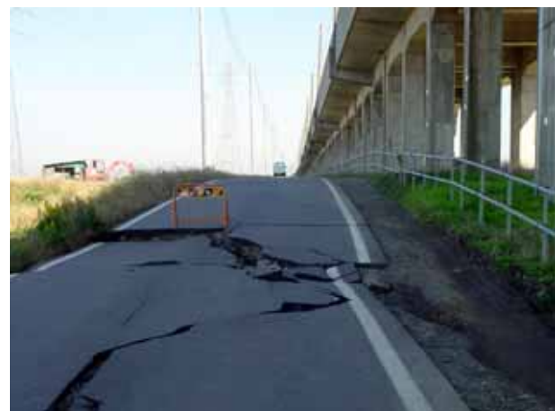
写真4.2.6 高架橋横の道路の亀裂・陥没
