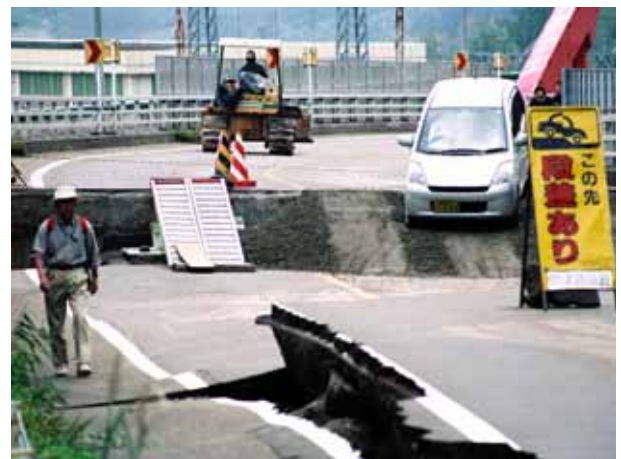
写真4.3.33 西側取付道路の沈下に伴う段差の近景。1m近い段差が生じている
