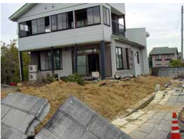
写真4.6.37 背後の法面が崩れて傾斜した家屋。ブロック塀も倒壊している（高町4丁目）
