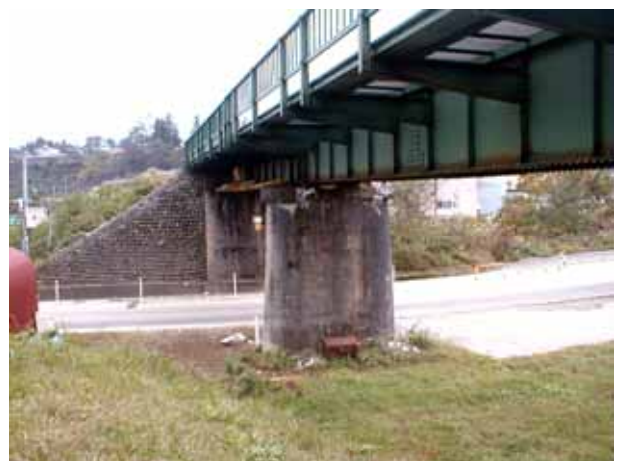
写真4.2.33 飯山線魚野川橋梁橋脚(左岸側)の被害
