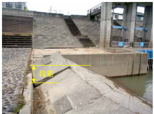
写真4.1.10 茶郷川樋門の翼壁背面の段差
