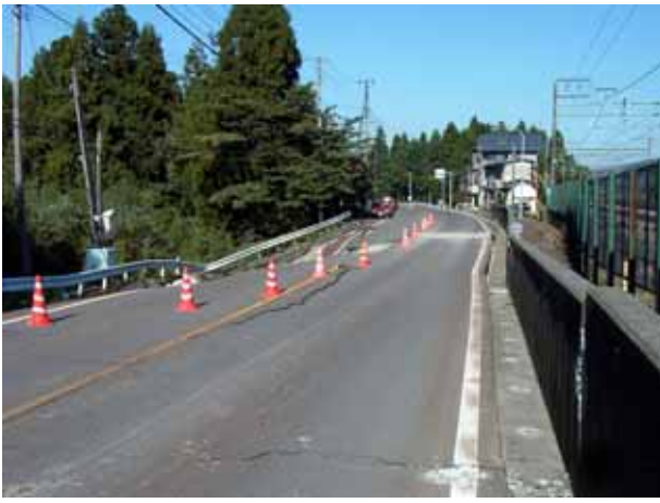
写真4.3.22 線路の防護壁の変状
