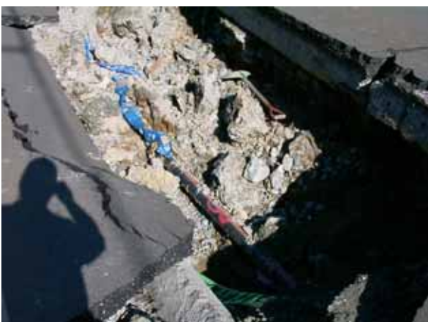
写真4.3.20 被害を受けた埋設管
