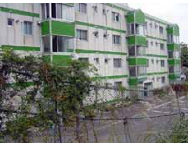
写真4.6.15 建物全体がめり込んだ町営アパート
