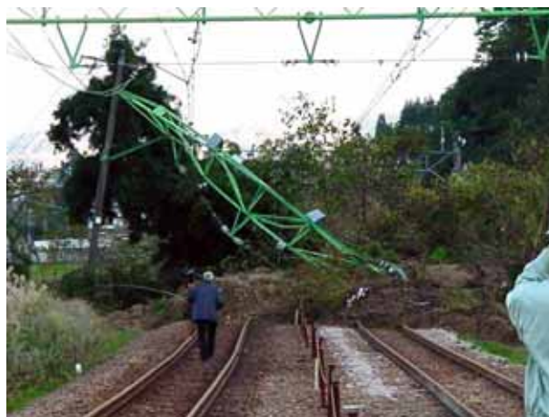
写真4.2.14 崩壊土砂に押し倒された架線柱
