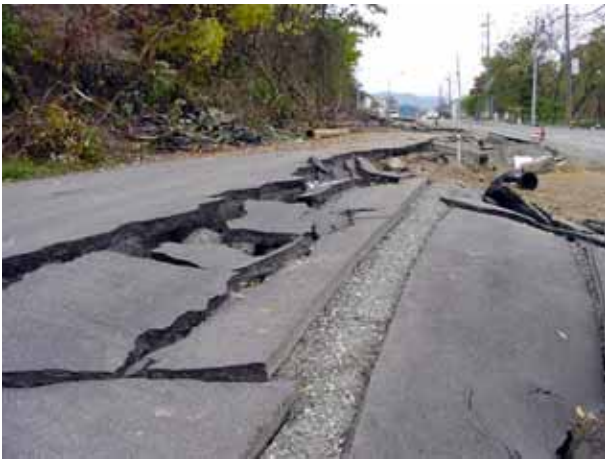
写真4.3.38 斜面脇道路の亀裂・陥没
