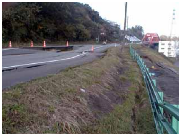
写真4.3.41 橋梁東側の道路の陥没
