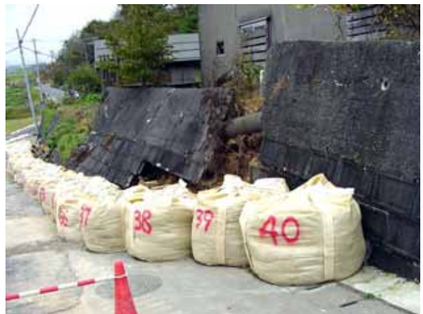
写真4.6.42 斜面の移動による擁壁の崩壊
