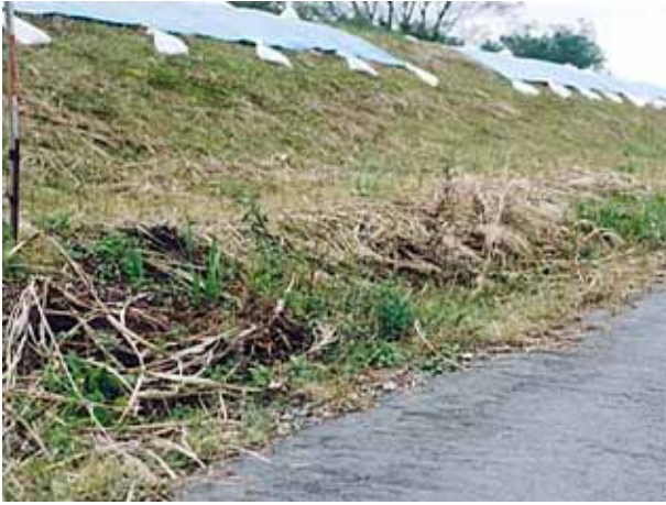
写真4.1.3 信濃川右岸堤防（長岡市大川原町） 法尻のはらみ出し
