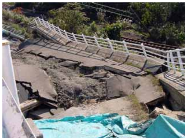
写真4.3.12 崩壊して滑り落ちた道路
