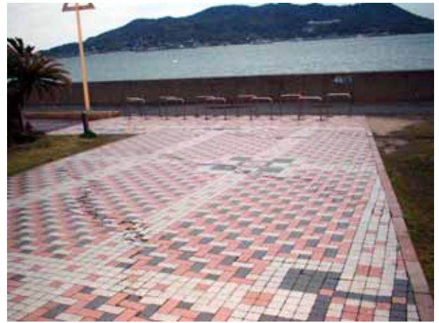
写真4.2.12 遊歩道に生じた亀裂（新小戸公園）。奥は能古島
