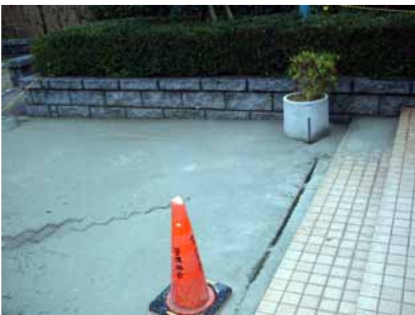
写真4.2.5 マンション敷地内の噴砂(愛宕浜地区)
