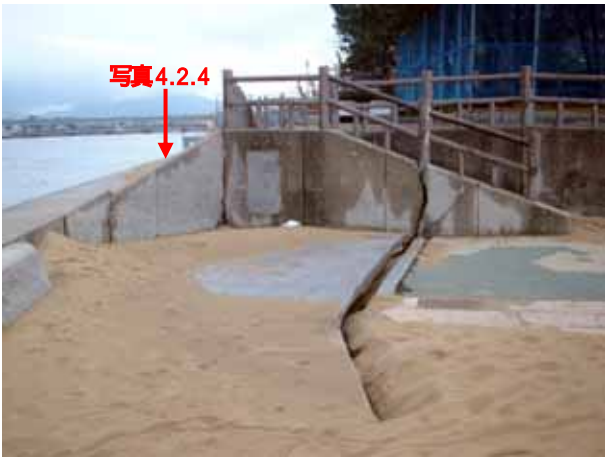
写真4.2.3 室見川の護岸の変状（愛宕浜地区）
