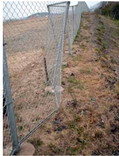
写真4.2.33 東西方向のフェンスの変形
