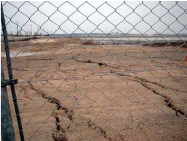
写真4.2.32 盛土上の南北方向の亀裂
