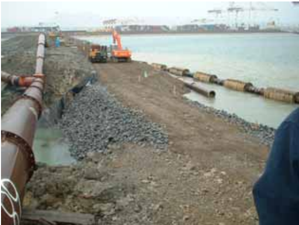
写真4.2.24 崩壊箇所の近景。堤防全体が崩壊したようであった
