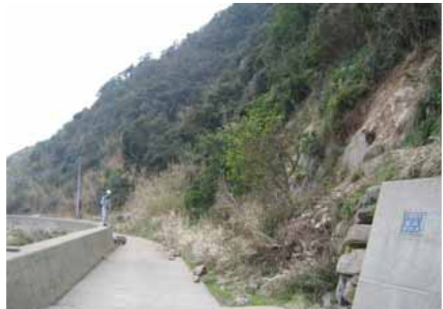
写真4.3.33 小規模な岩盤斜面崩壊
