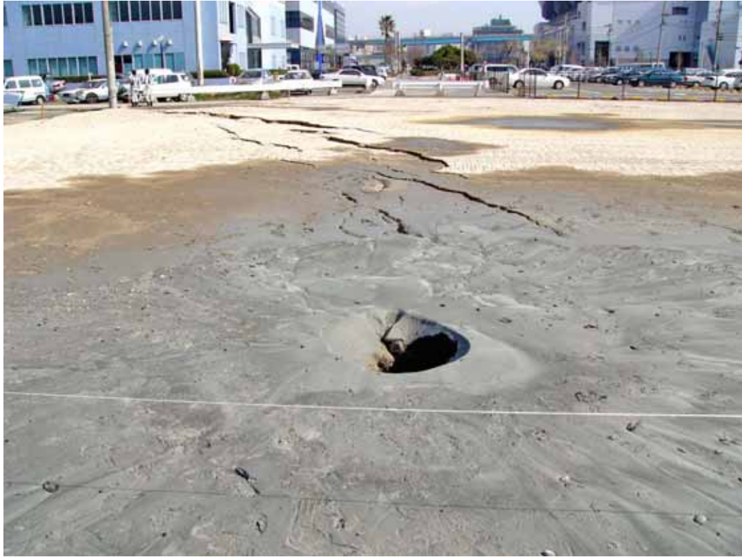
中央埠頭の埋立地で生じた液状化による噴砂と亀裂
