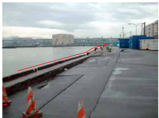
写真4.1.17 中央埠頭東岸壁天端の不陸
