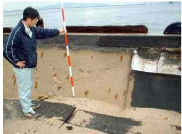
写真4.1.10 沈下した岸壁の背面。マサ土状の噴砂を伴っていた
