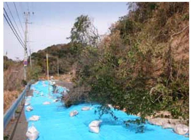
写真4.3.8 道路路肩の段差と背後斜面の表層崩壊
