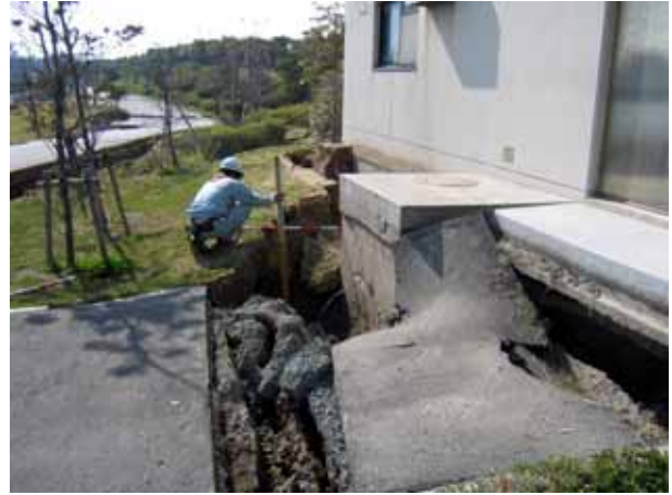
写真4.2.41 公園施設の基礎の抜け上がり
