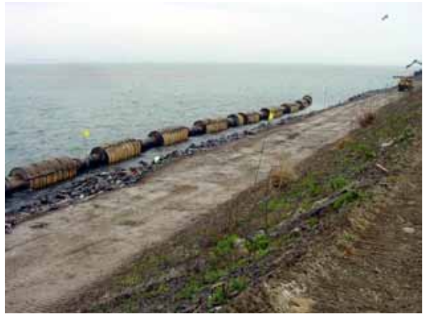
写真4.2.25 崩壊箇所隣の無被害箇所。工事用道路の端に捨石が見える
