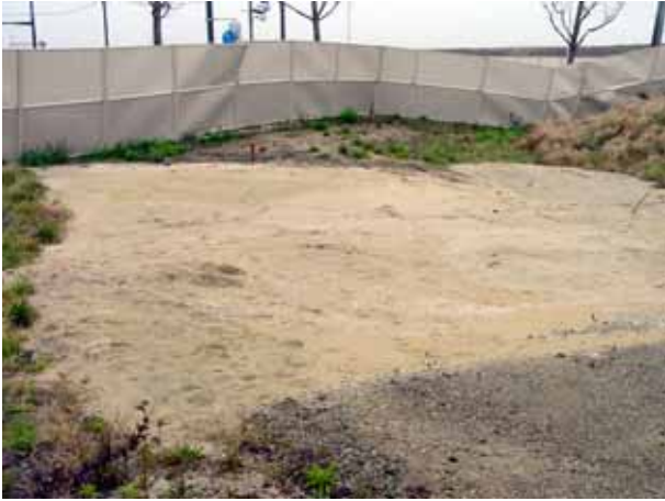
写真4.2.30 盛土のり尻の噴砂
