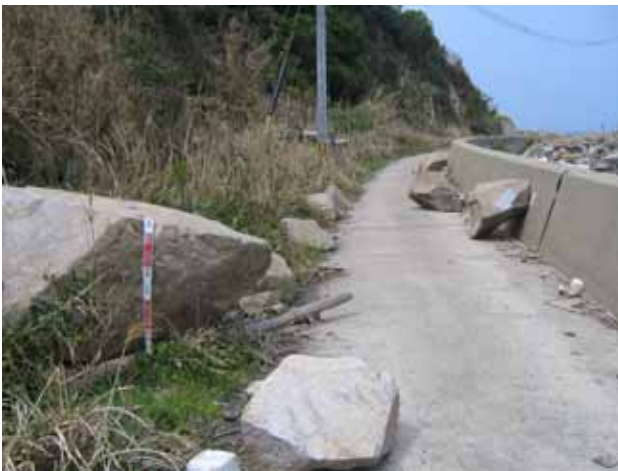
写真4.3.31 落石状況。島北東部海岸
