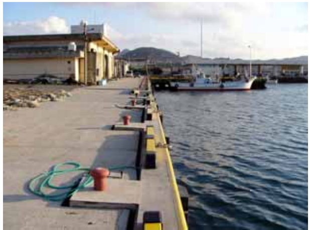
写真4.1.33 西浦漁港岸壁背後地の沈下
