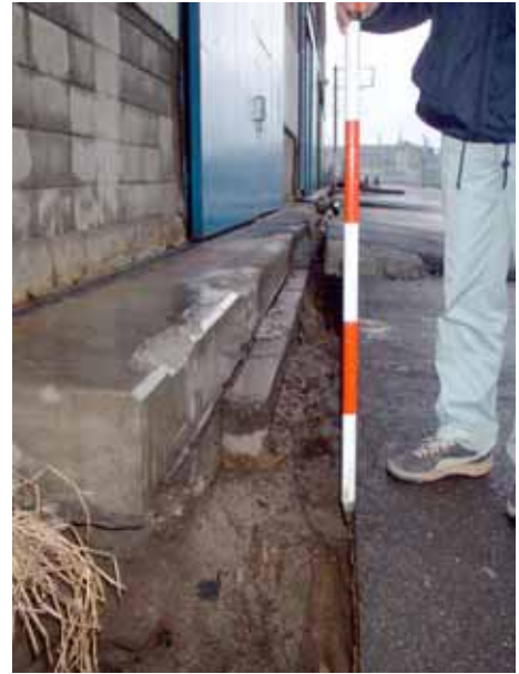
写真4.1.13 上屋基礎の抜け上がり
