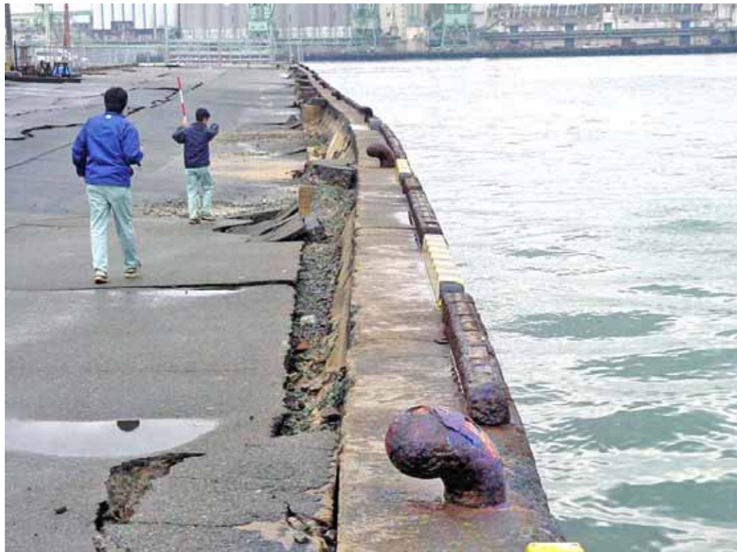
中央埠頭 7~8号岸壁(-5.5m)のはらみ出しとエプロンの沈下
