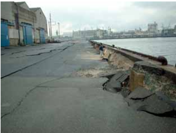
写真4.1.9 中央埠頭北岸の沈下
