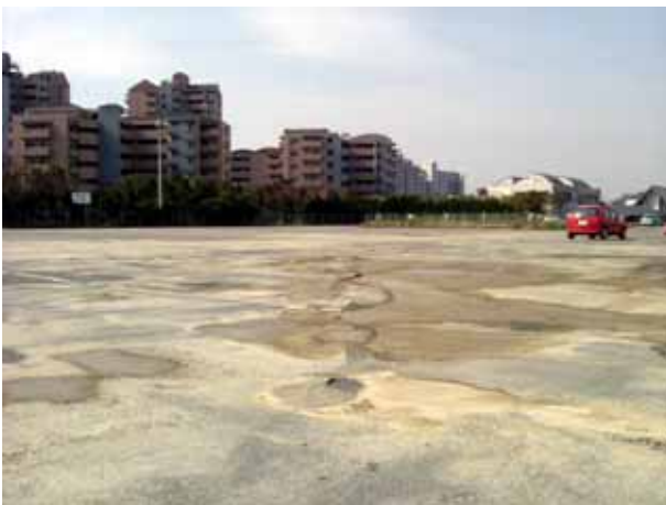
写真4.2.13 アスファルト舗装の駐車場で生じた噴砂
