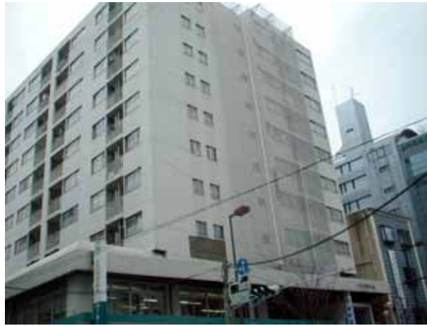
写真4.5.16 RC造の被害
