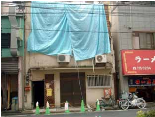
写真4.5.5 木造家屋の被害
