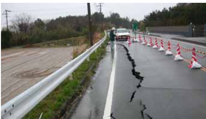
写真4.3.12 道路盛土部の亀裂
