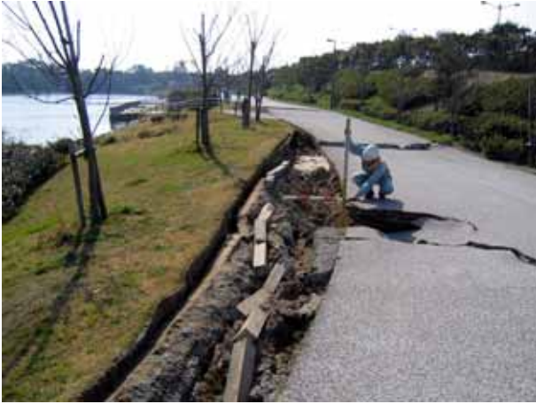
写真4.2.40 公園内で生じた流動と亀裂
