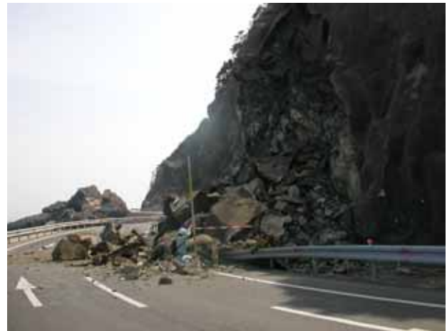
写真4.3.6 吹き付け岩盤斜面の剥離崩壊
