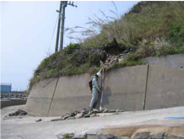
写真4.3.29 擁壁上の石積みの崩落
