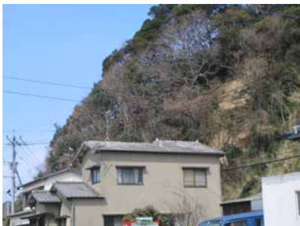
写真4.3.7 民家背後の急傾斜地斜面崩壊
