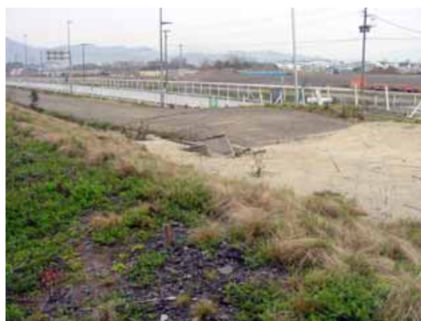
写真4.2.29 盛土と道路の間。右端の砂が噴砂
