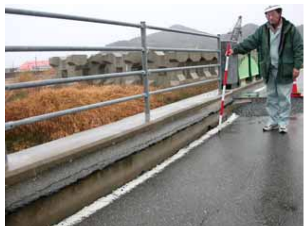
写真4.3.13 橋台背後の裏込め部の沈下
