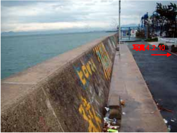
写真4.2.9 小戸（マリノアシティ付近）の護岸の変状
