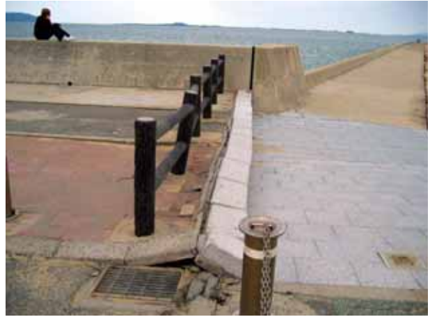
写真4.1.32 姪浜漁港付近の護岸。護岸の継目が押されて盛り上がる
