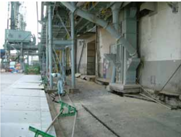
写真4.1.5 プラント基礎の抜け上がり（須崎埠頭）
