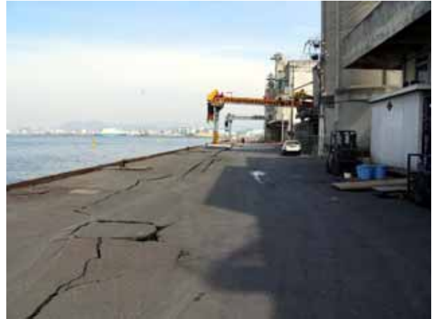
写真4.1.4 北側岸壁の亀裂・沈下（須崎埠頭）
