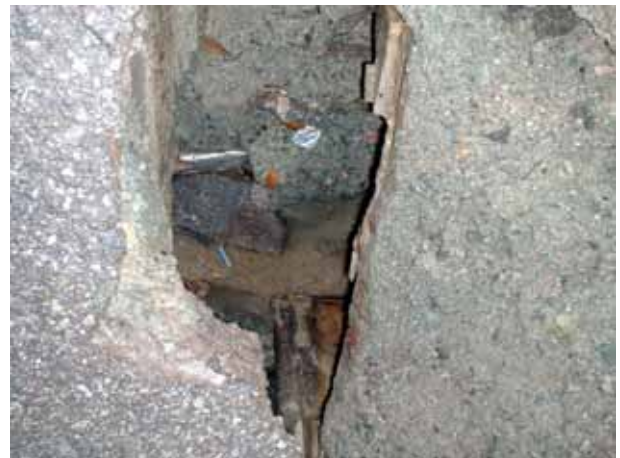
写真4.1.26 ボックスカルバートの開口(箱崎埠頭)
