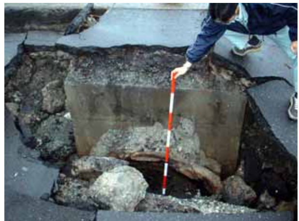
写真4.1.15 排水孔の周辺の陥没
