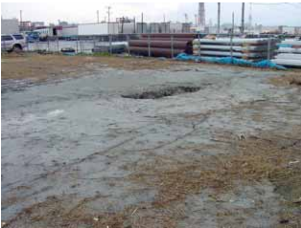
写真4.4.7 変状した護岸背後地の噴砂(中央埠頭)
