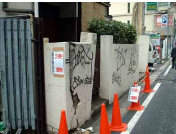
写真4.5.17 ブロック塀の破壊
