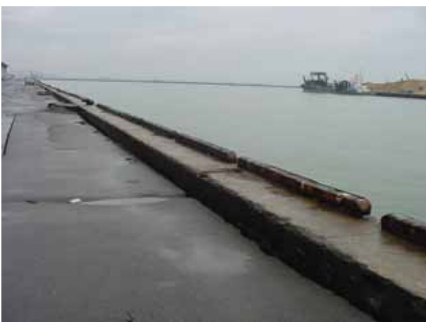
写真4.1.16 中央埠頭東岸壁背後地の沈下
