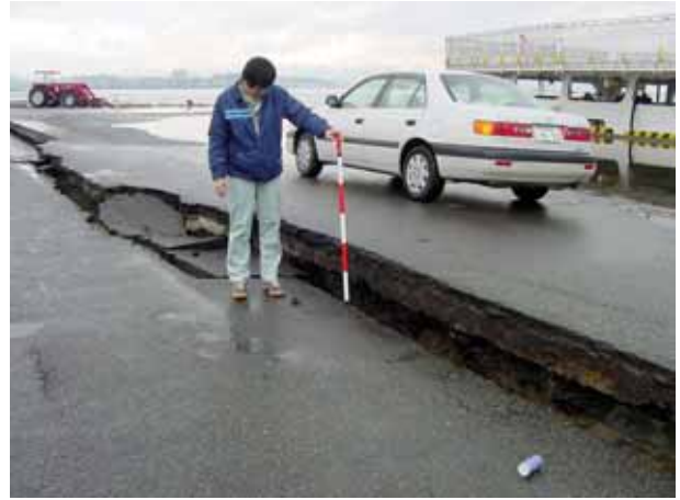
写真4.1.24 箱崎埠頭背後地の段差は約40cm生じていた
