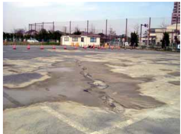
写真4.4.14 駐車場での噴砂(百道浜 福岡 タワー付近)
