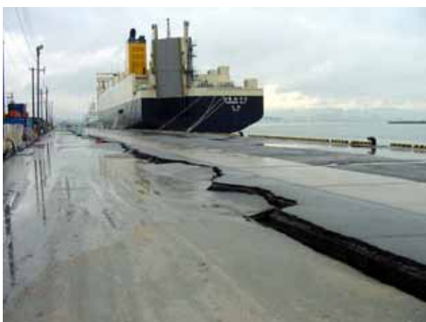
写真4.1.21 箱崎埠頭岸壁背後の噴砂を伴った亀裂
