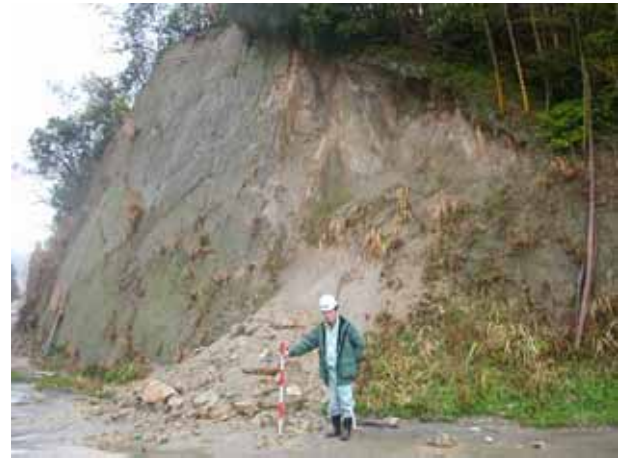
写真4.3.11 まさ土斜面の表層崩壊
