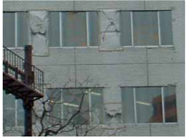
写真4.5.15 壁面の拡大。壁にせん断亀裂が生じている
