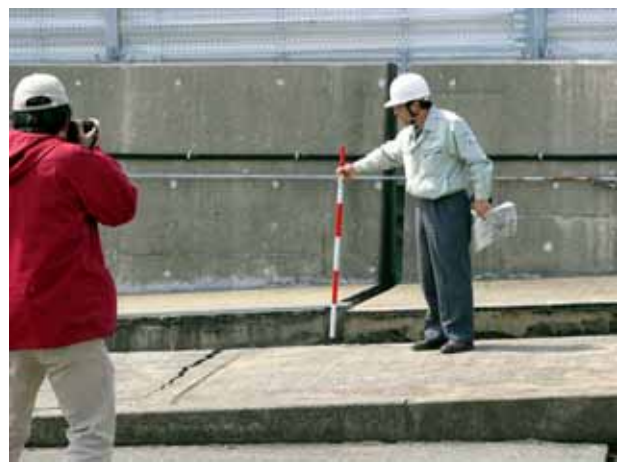
写真4.1.27 護岸の継ぎ目に生じた段差(伊崎漁港)
