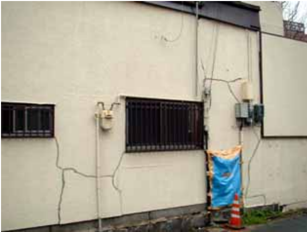
写真4.5.3 木造家屋の被害
