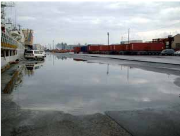
写真4.1.25 沈下した箇所に雨水が溜まっている(箱崎埠頭)
