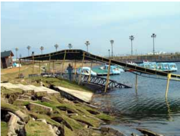
写真4.2.42 ボート乗り場の被害状況
