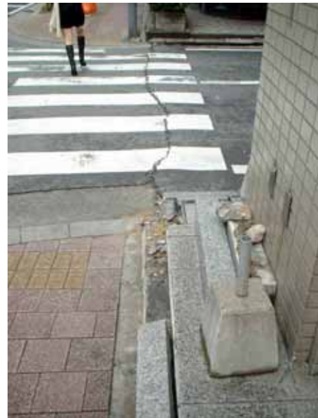
写真4.5.12 道路に生じていた亀裂
