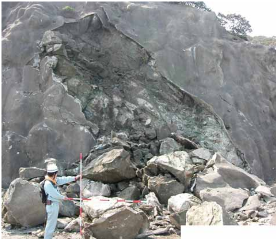
吹き付け法面の崩壊(志賀島の外周道路)
