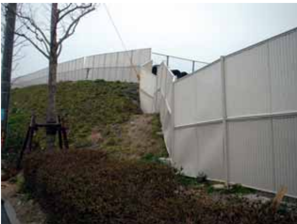
写真4.2.34 南北方向のフェンスの変形
