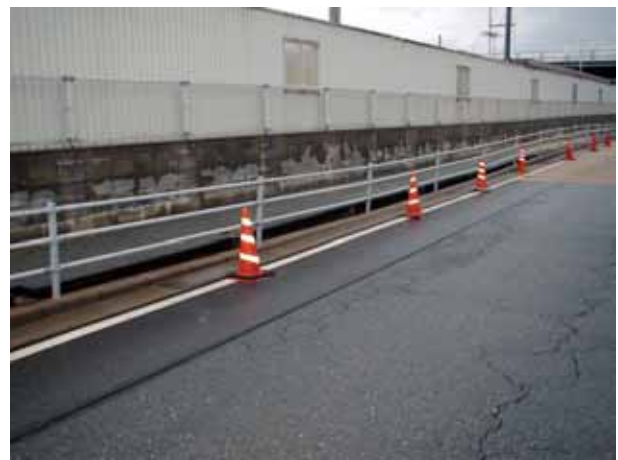
写真4.2.6 護岸付近道路の沈下と亀裂(能古島渡船場付近)
