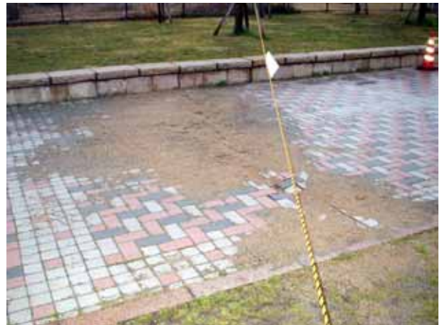
写真4.4.20 遊歩道の亀裂と噴砂（新小戸公園）
