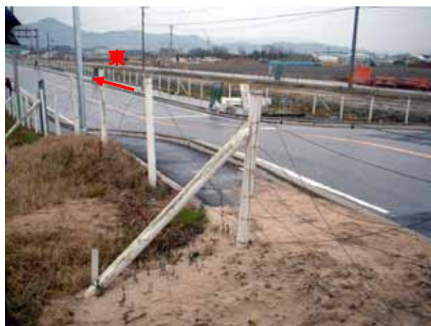
写真4.2.27 道路の盛り上がり
