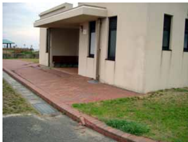
写真4.2.37 歩道に亀裂が生じている
