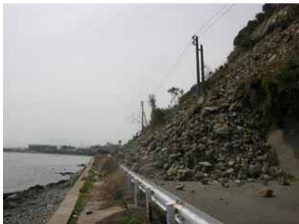
写真4.3.1 志賀島東海岸の岩盤崩壊
