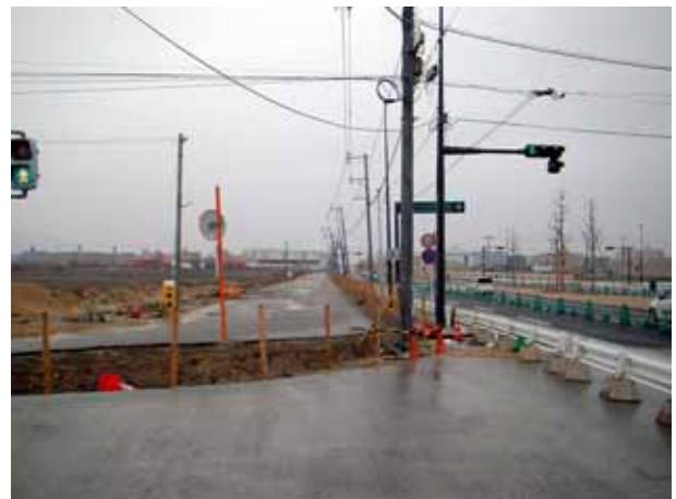
写真4.2.35 道路沿いの電柱の傾き
