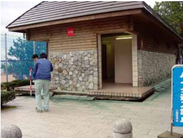
写真4.2.1 公園内トイレ基礎の抜け上がり (愛宕浜地区)
