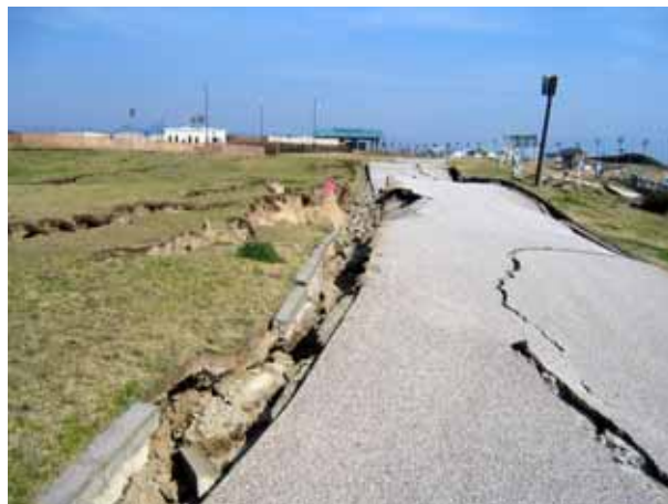
写真4.2.39 公園内で生じた流動と亀裂
