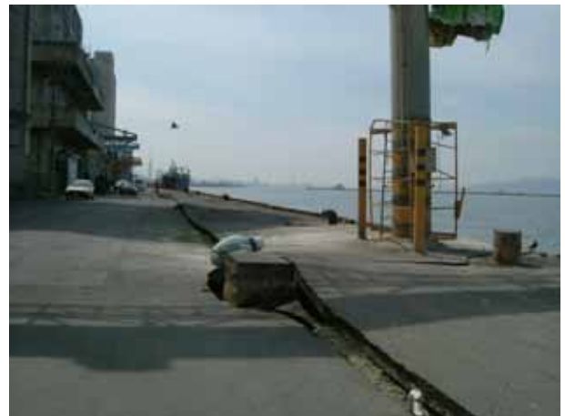
写真4.1.6 岸壁背面の沈下と亀裂（須崎埠頭）
