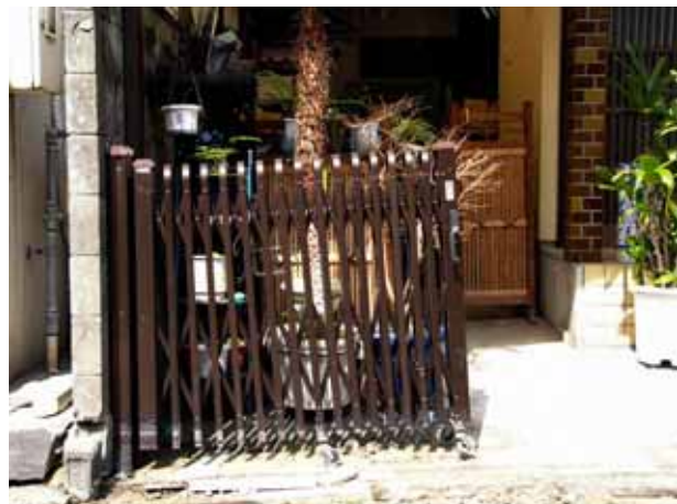
写真4.2.19 同左。コンクリート壁の基礎部が破壊している
