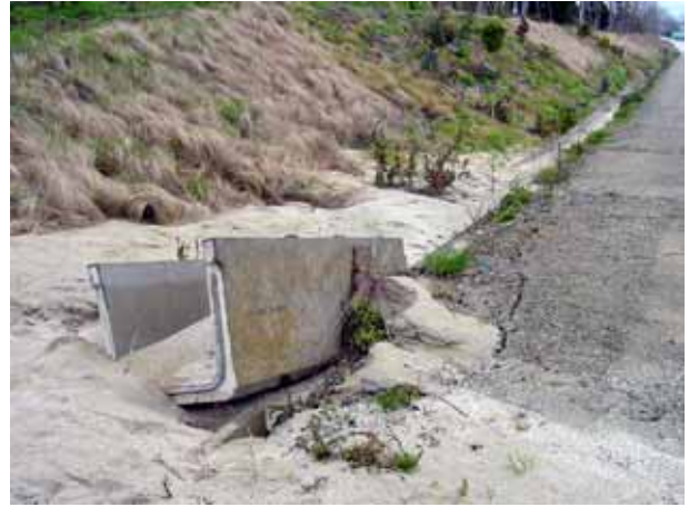
写真4.2.31 噴砂で浮き上がった？側溝
