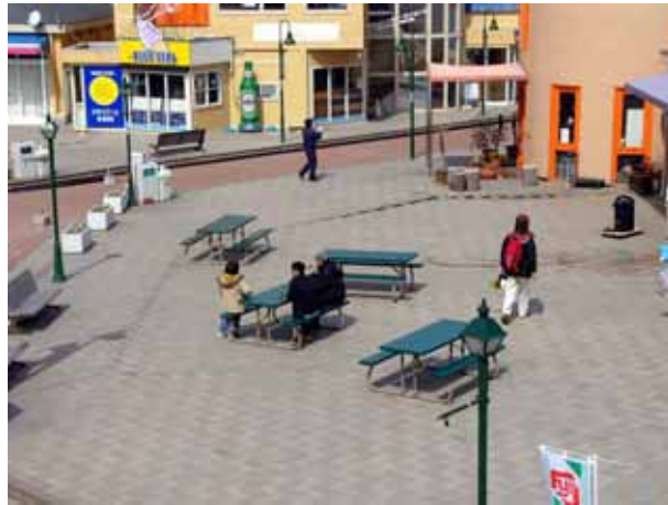
写真4.2.17 マリゾンの広場で生じた沈下
