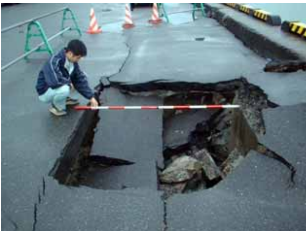
写真4.1.14 中央埠頭東岸。排水孔付近の陥没
