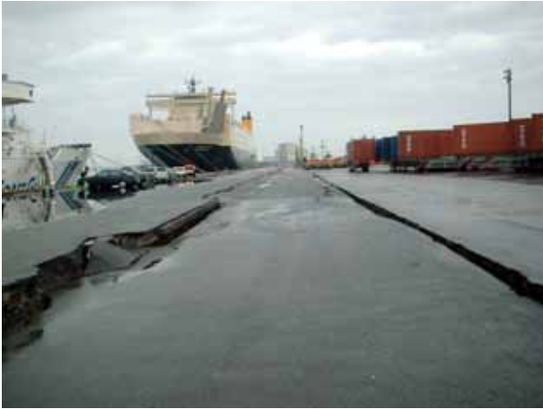
写真4.1.23 箱崎埠頭北側の岸壁に沿って亀裂が連続していた
