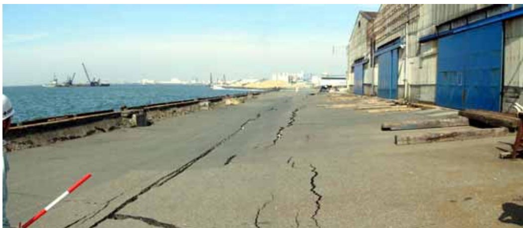
写真4.1.11 中央埠頭北岸の沈下と亀裂
