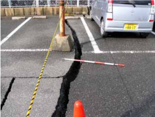
写真4.1.31 駐車場の亀裂（姪浜漁港）
