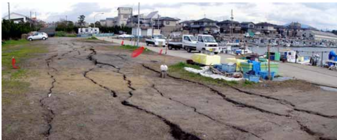
写真4.1.30 岸壁背面の亀裂（姪浜漁港）
