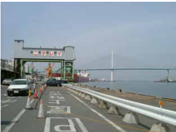
写真 4.1.1 岸壁背後地の沈下 (荒津地区)
