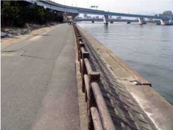
写真4.2.15 護岸の変状（室見川右岸）
