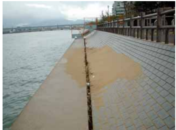
写真4.2.4 護岸の亀裂から噴砂が生じていた（愛宕浜地区）
