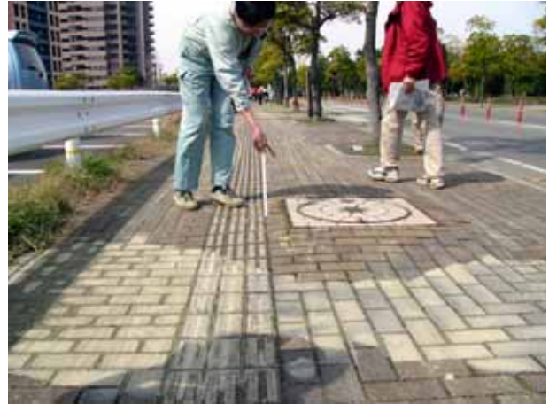
写真4.2.16 マンホールが少し抜け上がっていた
