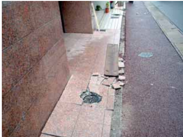
写真4.5.11 建物と道路の境界部の破損
