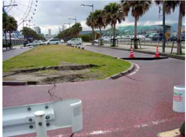
写真4.2.10 護岸に平行して生じた道路の亀裂（小戸 マリノアシティ付近）
