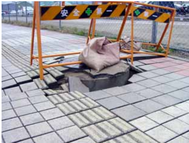
写真4.2.11 マンホール付近の変状（小戸マリノアシティ付近）
