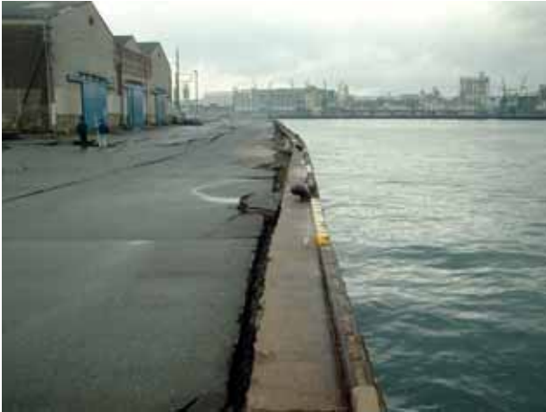
写真4.1.12 中央埠頭北岸岸壁の海側へのはらみ出し
