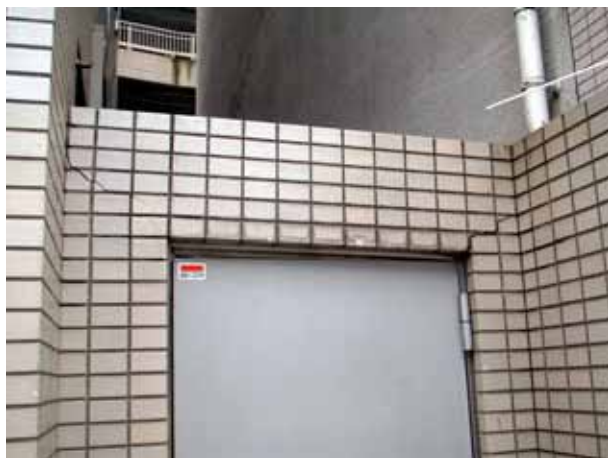
写真4.5.13 隣のビルとの境界にある非常口の壁に生じた亀裂
