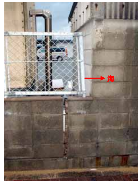
写真4.2.8 ブロック塀に生じた亀裂(能古島渡船場付近)
