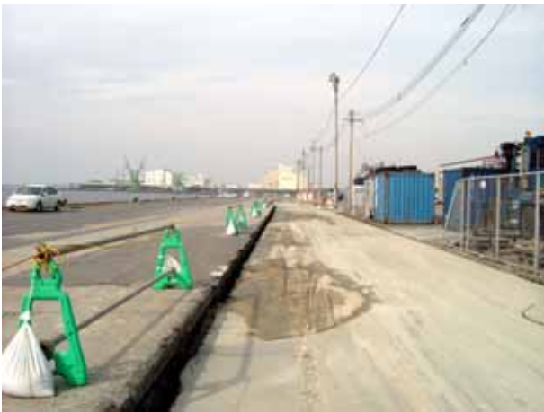
写真4.4.5 護岸変状部の噴砂（箱崎埠頭）
