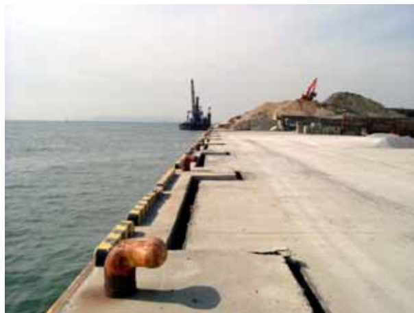
写真4.1.20 東浜埠頭の岸壁の変状
