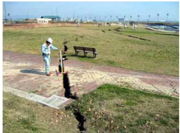
写真4.2.43 池に向かった流動による亀裂
