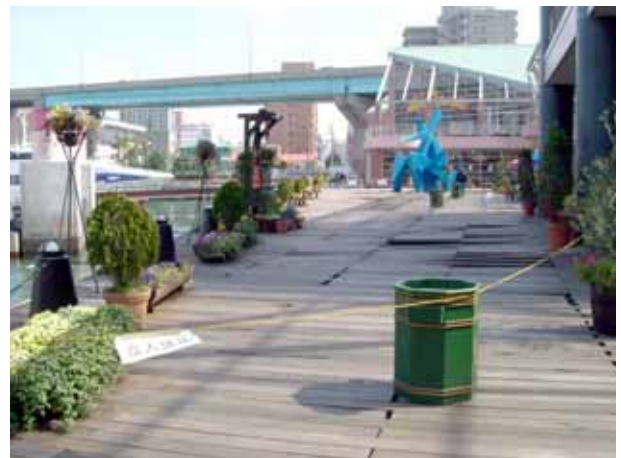
写真4.1.8 沈下で生じた舗装の段差（博多埠頭ベイサイドプレイス）
