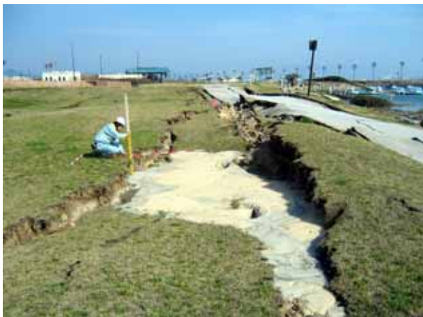
写真4.2.38 公園内で生じた流動と亀裂。噴砂が生じていた
