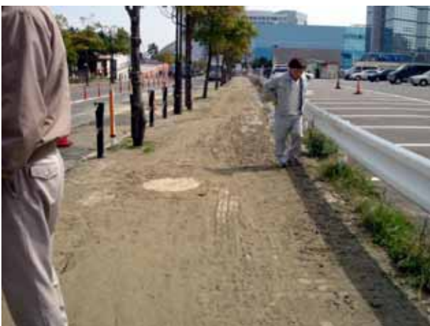
写真4.4.15 歩道での噴砂(百道浜 福岡タ ワー付近)。写真左が海岸
