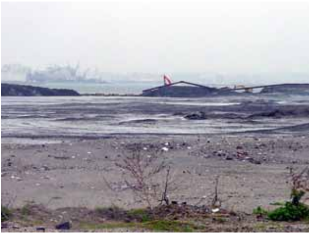
写真4.2.22 締切護岸の崩壊箇所
