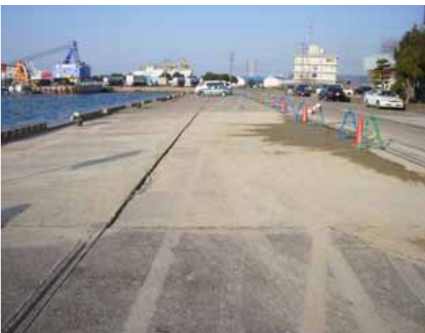
図 4.2.9 七尾港護岸背後の噴砂
