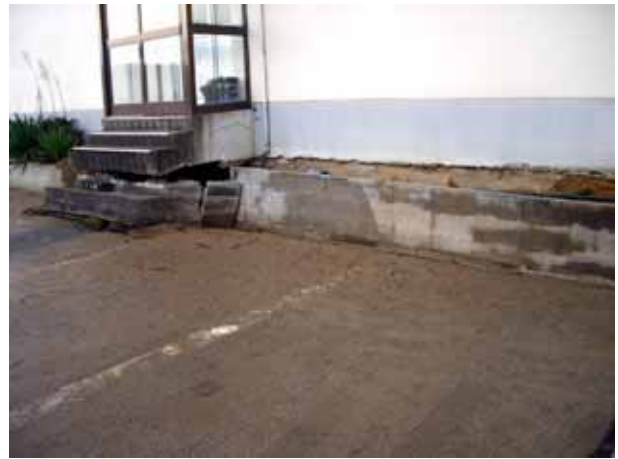
写真 4.5.16 建物周辺地盤の沈下と噴砂
