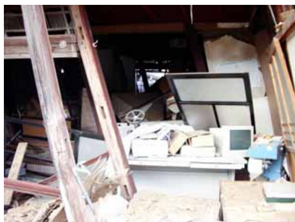
写真 4.4.4 同左家屋の内部
