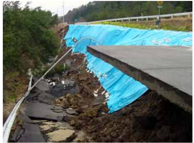
写真 4.1.6 同左。崩壊箇所の近景。道路のセンターラインから崩壊している
