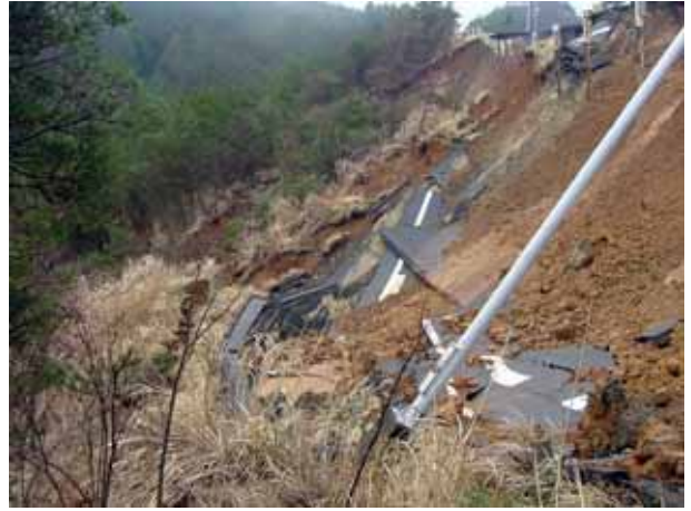
写真 4.1.14 路面崩壊箇所ののり面。崩壊土はあまり下には流下していない
