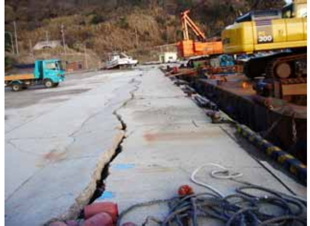
写真 4.2.3 エプロンの沈下・亀裂
