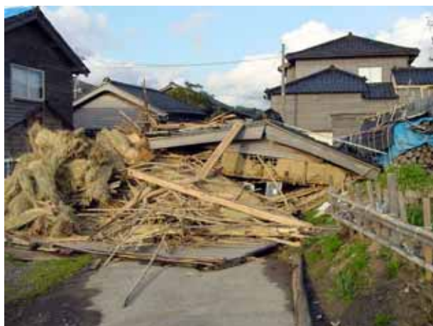
写真 4.4.14 古い木造家屋の倒壊
