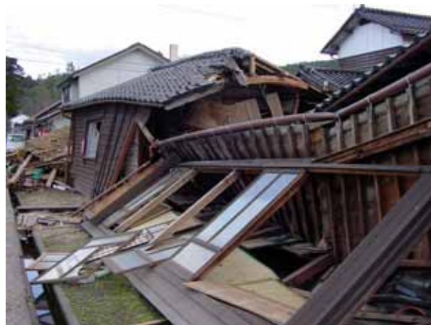
写真 4.4.2 後方に倒壊した家屋
