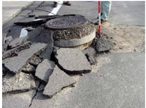
写真 4.5.13 下水道マンホールの浮き上がり
