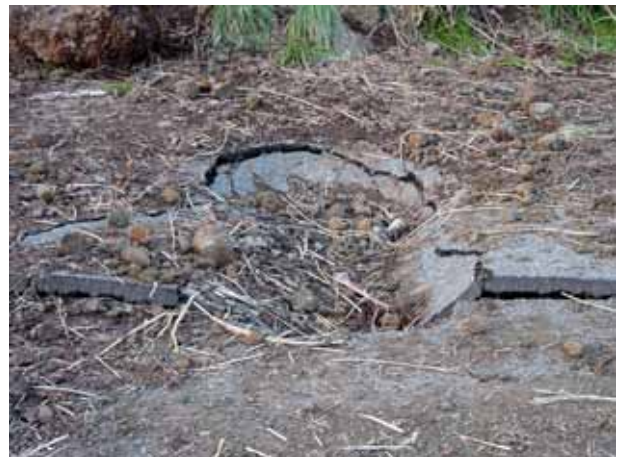
写真 4.2.7 左の巨大な落石がバウンドしてきた道路の凹み
