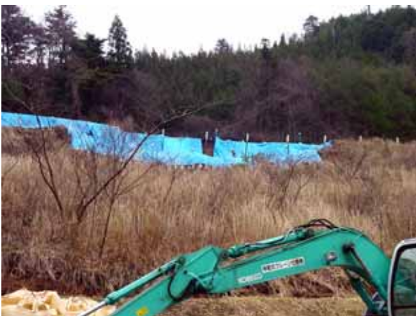
写真 4.1.3 のり尻から見た道路のり面の崩壊
