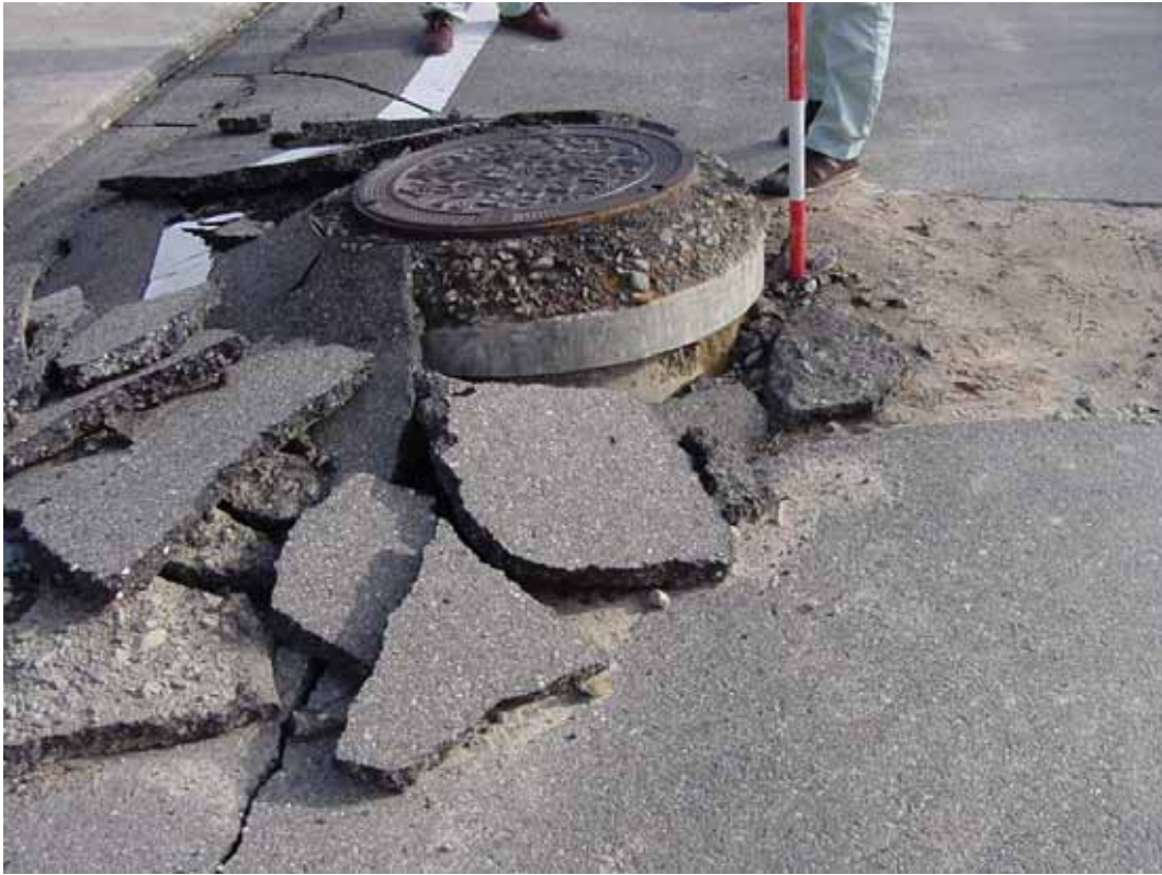
マンホールの浮き上がり（門前町清水）
