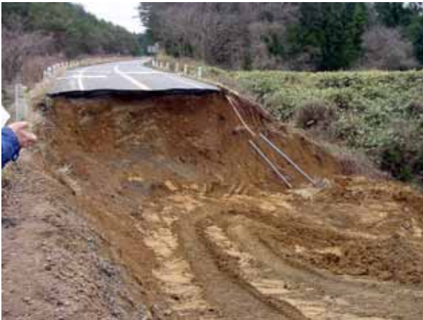
写真4.1.7 路面全体が崩壊した道路。すでに土砂は除去されている
