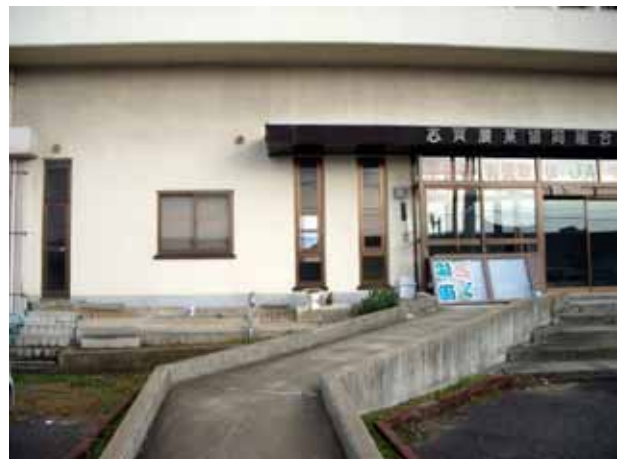
写真 4.5.14 周辺地盤が沈下した建物（志賀町高浜）
