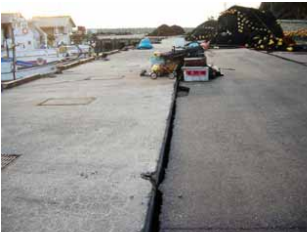
写真 4.2.4 護岸裏込め部の沈下、亀裂
