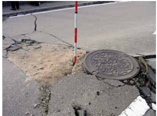
写真 4.5.11 下水道マンホールの埋戻土とみられる噴砂（門前町清水）
