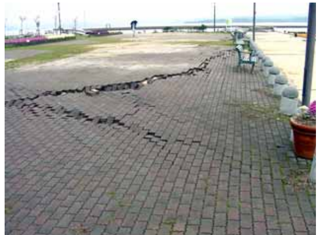
写真 4.5.2 護岸背後の公園で見られた噴砂（和倉港）
