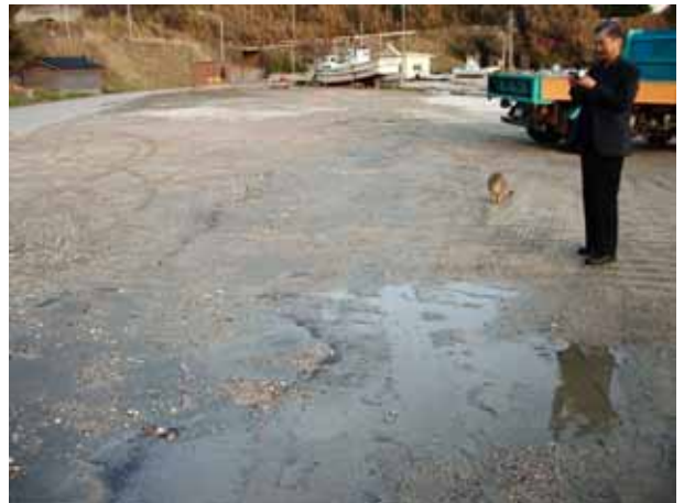
写真 4.2.5 護岸背後地盤での噴砂
