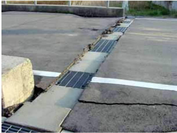
写真 4.4.21 ハヶ川に架かる橋の取付部。沈下とともにやや圧縮されたような痕跡が見られる
