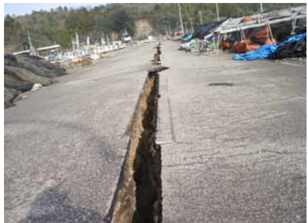
写真 4.2.2 漁港内のエプロンのアスファルトの開口（約 10cm）
