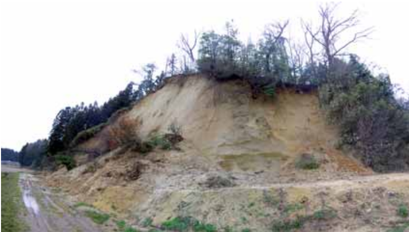
写真 4.3.8 同上写真中央の表層崩壊近景
