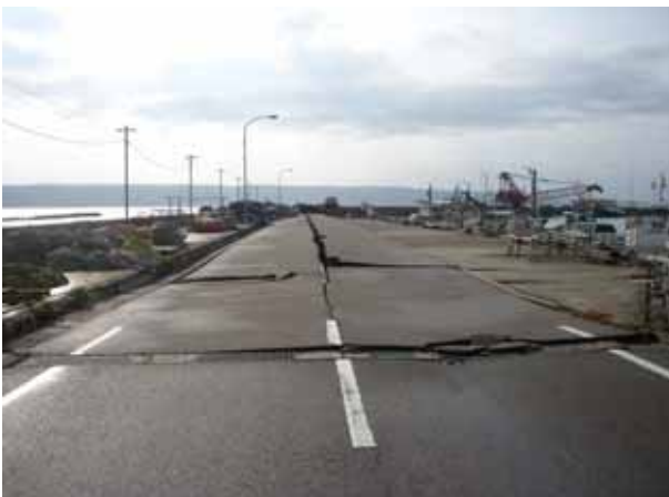
写真 4.2.1 漁港内のアスファルト道路の沈下
