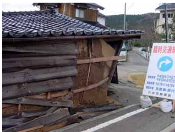
写真 4.4.5 大きく変形した家屋。土壁であることが分かる
