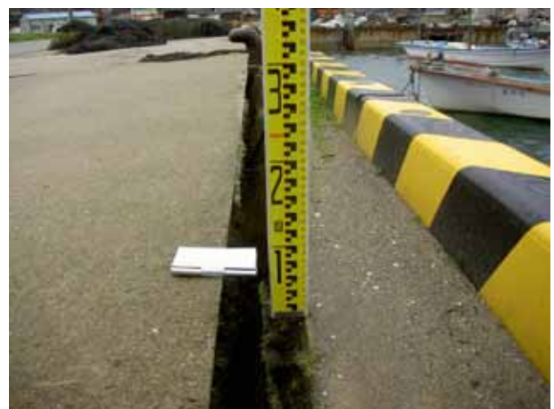
写真 4.2.16 護岸のはらみ出しによる開口
