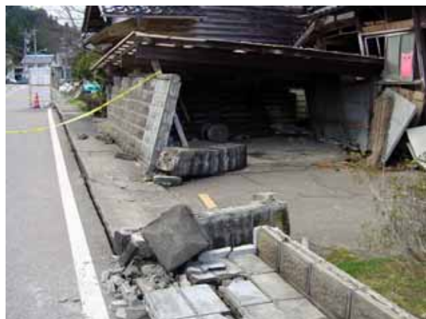
写真 4.4.11 倒壊した門柱とブロック塀
