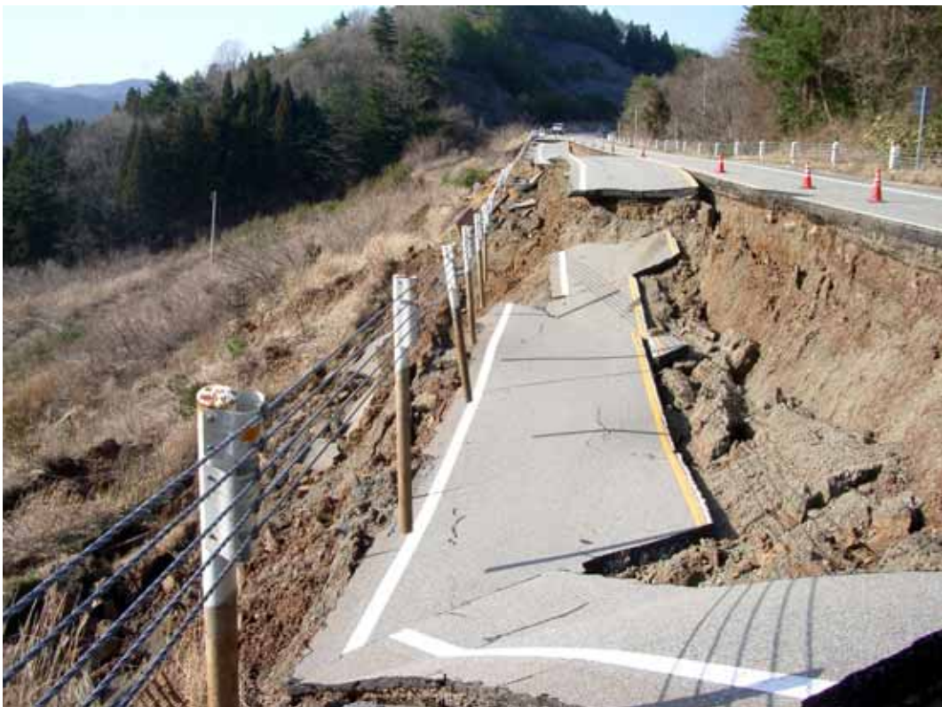
道路の崩壊（能登有料道路 横田 IC 南）
