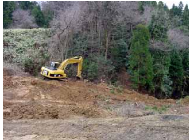
写真4.1.8 崩壊箇所の谷の下流側。勾配がきつく、土砂がかなり下まで流下している
