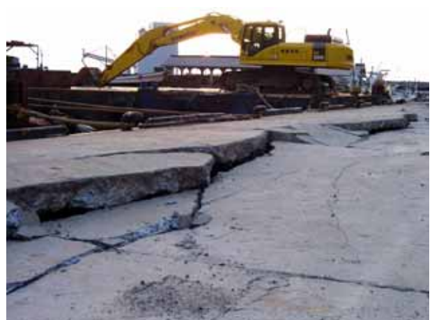
写真 4.5.8 液状化が原因とみられる護岸背後の亀裂・沈下（鹿磯漁港）
