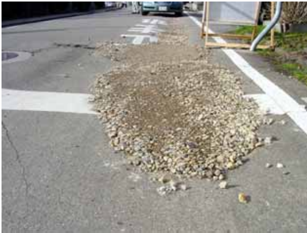
写真 4.5.12 管路埋設地盤の沈下
