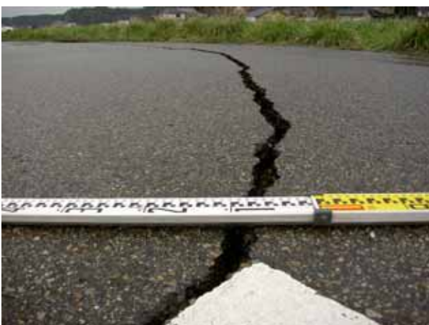
写真 4.2.15 漁港内の路面。アスファルトの開口が連続して確認される
