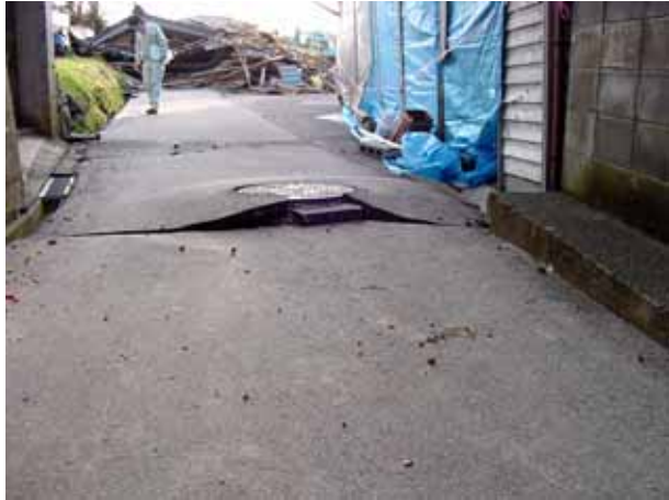
写真 4.4.19 マンホールの浮き上がり
