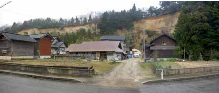
写真 4.3.10 写真 4.3.9 奥の表層崩壊。家屋背後の斜面で表層崩壊が発生
