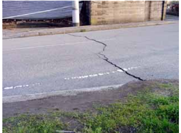
写真 4.4.22 引張亀裂と見られる道路直交方向の亀裂
