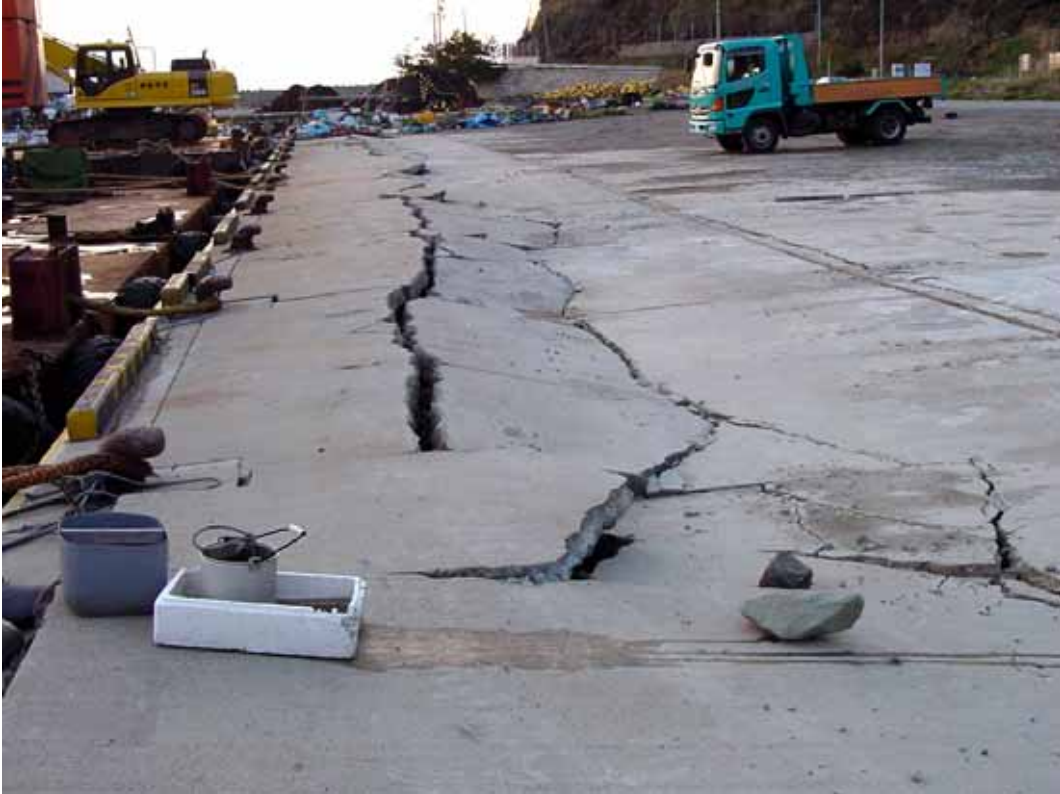
岸壁エプロンの亀裂・沈下（門前町鹿磯漁港）
