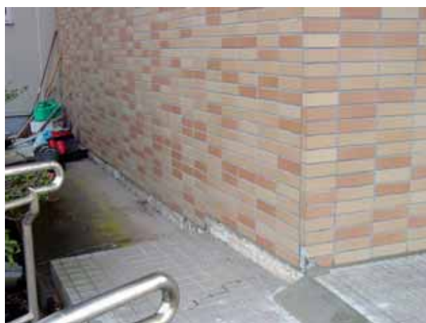
写真 4.4.10 建物周辺地盤の沈下。周辺に噴砂は見られなかった（門前高校）
