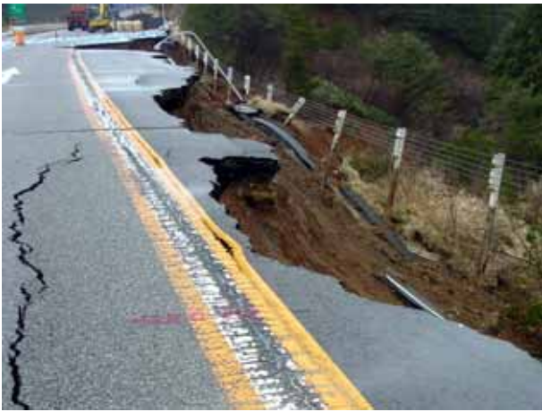
写真 4.1.15 同上。ガードレールが宙吊りになっている
