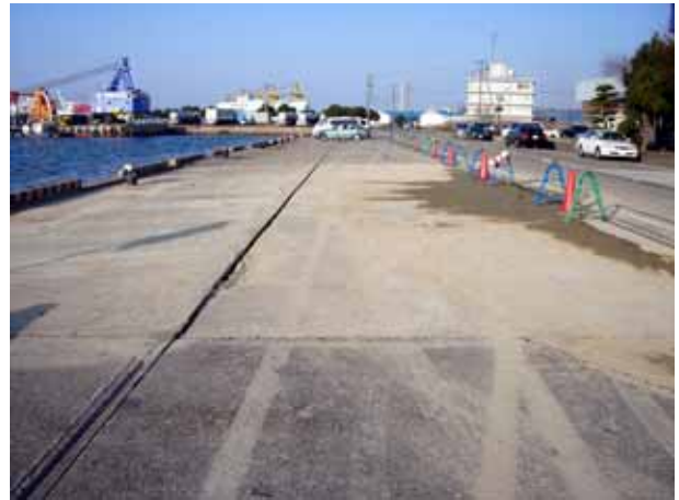
写真 4.5.1 七尾港の岸壁背後で見られた噴砂
