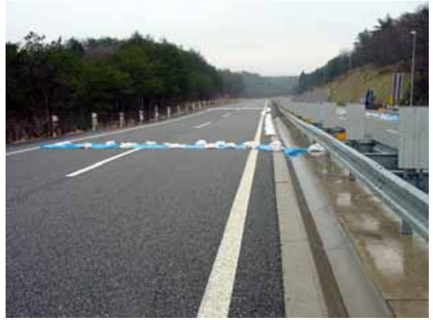
写真 4.1.12 道路の横断亀裂
