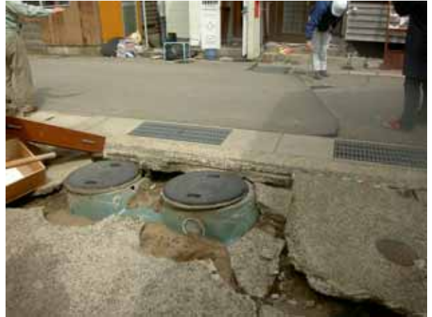
図 4.4.20 宅地被災状況。写真左にわずかに傾斜した宅盤の沈下で、マンホールが浮き上がっているように見える
