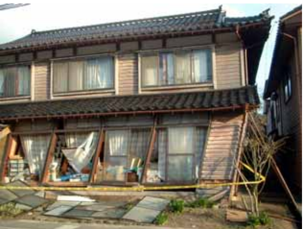
写真 4.4.18 古い木造家屋の倒壊
