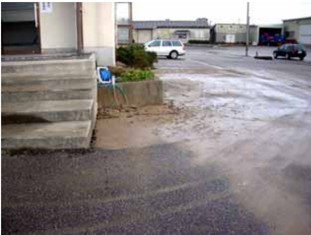
写真 4.5.15 建物周辺地盤の噴砂
