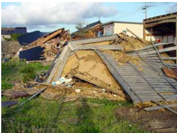
写真 4.4.15 古い木造家屋の倒壊
