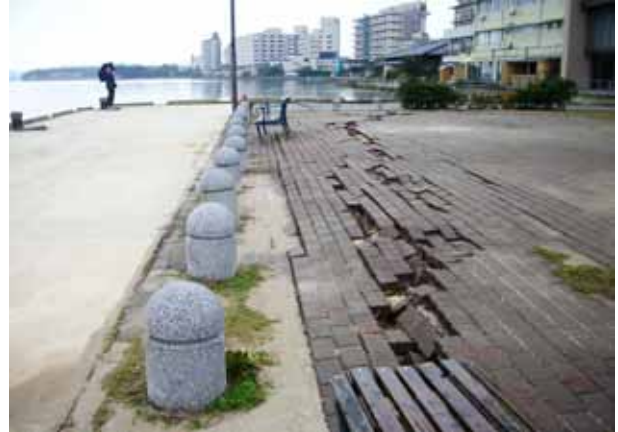
写真 4.2.12 護岸背後地盤の液状化, 亀裂
