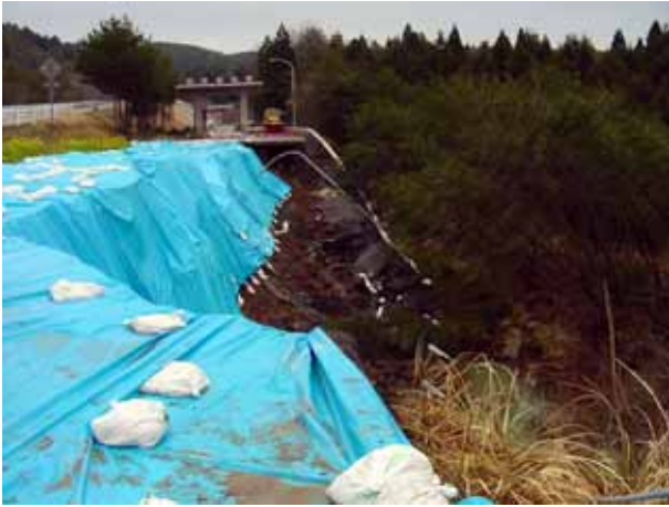
写真 4.1.5 崩壊した横田 IC アプローチ道路。 左側に見えるのが本線
