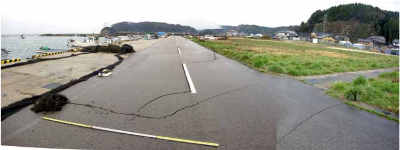
写真 4.2.14 漁港内の被災箇所全景。アスファルトの開口が連続して確認される。写真右手の緑地帯には噴砂が確認される
