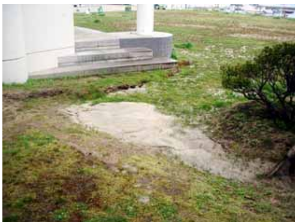
写真 4.5.3 公園で見られた噴砂と地割れ・沈下（和倉港）
