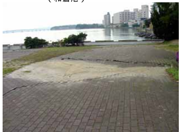
写真 4.5.4 同左。地形から判断して埋立地と考えられる（和倉港）
