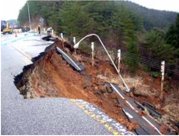
写真 4.1.13 路面崩壊箇所。背後は切土である
