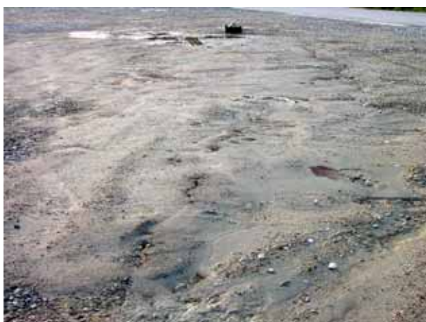
写真 4.5.7 岸壁背後地盤で見られた噴砂（鹿磯漁港）
