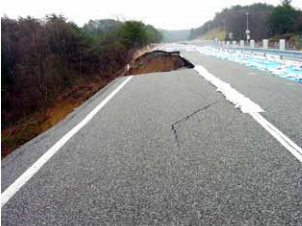
写真 4.1.9 路面崩壊箇所(北側より撮影)
