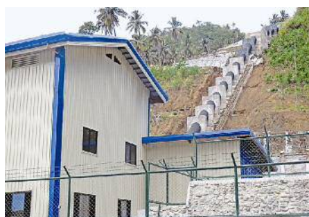
斜面から伸びる導水管とアシガ川 小水力発電所
