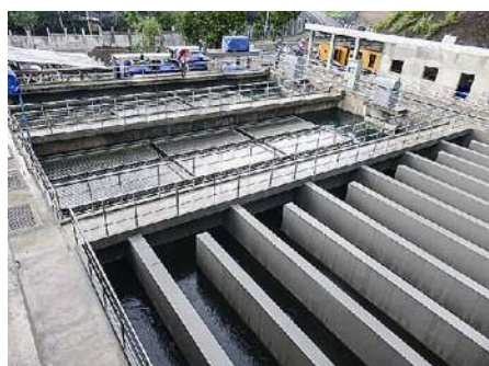
運用が始まった上水供給施設
