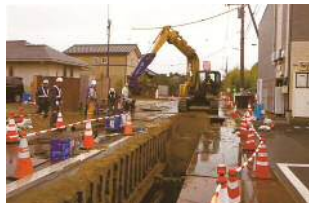
東北地方太平洋沖地震による仙台市青葉区折立5丁目の盛土造成住宅地の被害
