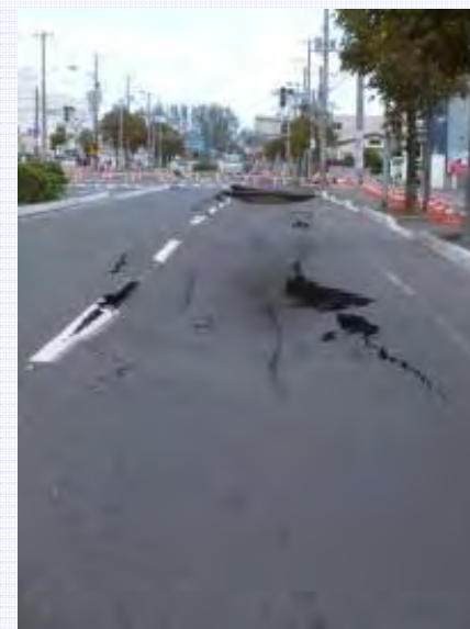
a地区 路面の沈下・陥没（北45条東15丁目）
