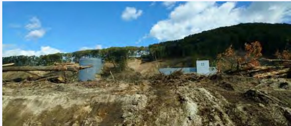
右手の転倒した建物は元は左の高架水槽の横に位置していた。
