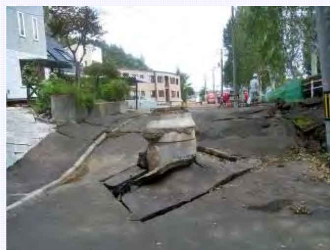
突出した人孔。これは造成地の下の河川暗渠のマンホールである（南西側より撮影）
