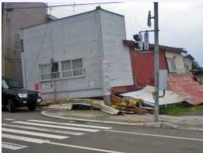
建物の層崩壊
