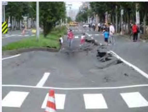
a地区 道路の沈下・陥没（北32条東15丁目）
