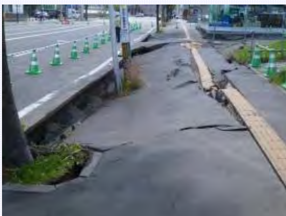
a地区 歩道の沈下・陥没（北14条東15丁目）
