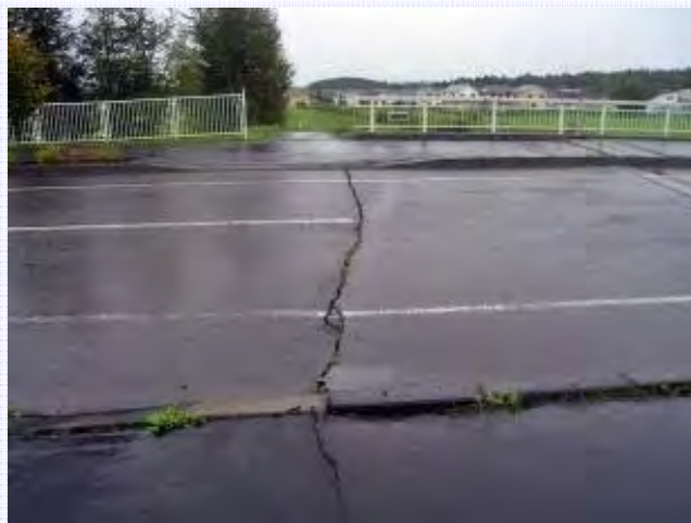
左岸側橋台背後の横断亀裂
