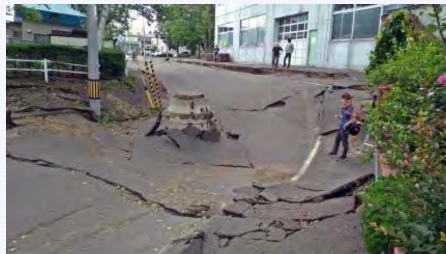
同左。道路陥没のため人孔が浮いたように見える（東側より撮影）
