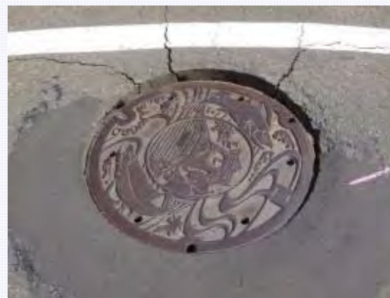
a地区 マンホールと路面の段差（北20条東15丁目）
