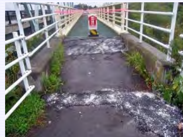
側道橋の段差（右岸側）
