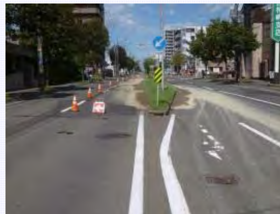
a地区 道路センターにおける噴砂（北20条東15丁目）
