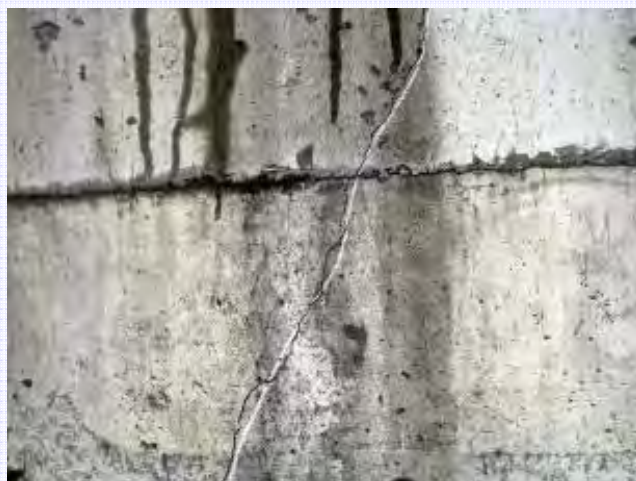
左岸橋台パラペット部の亀裂
