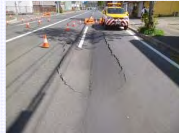
a地区 路面の沈下・陥没（北12条～13条）
