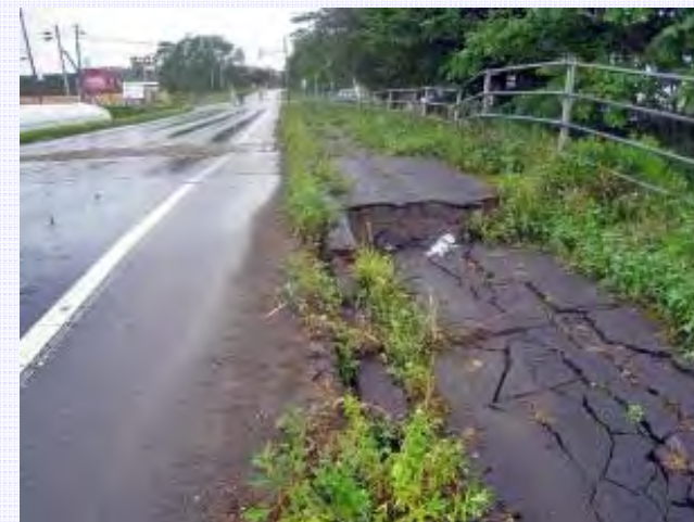
左岸アプローチ歩道の亀裂・陥没
