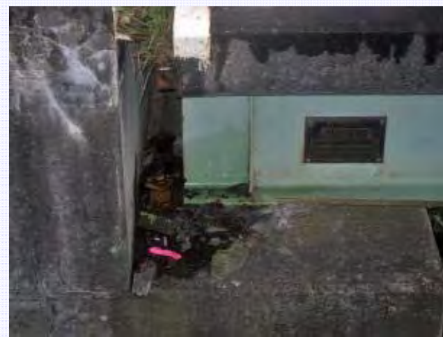
側道橋の支承被害（左岸側）
