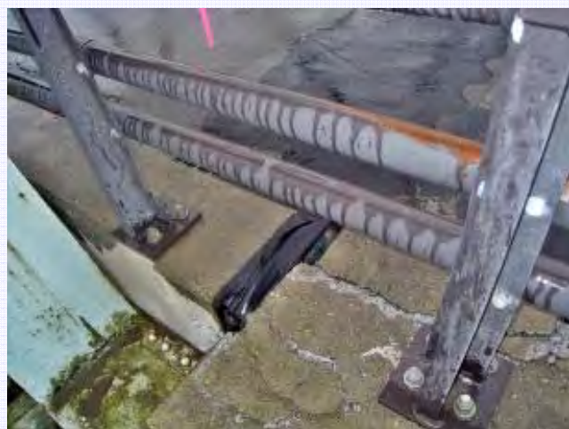
橋台パラペットコンクリートの剥離（右岸橋台）
