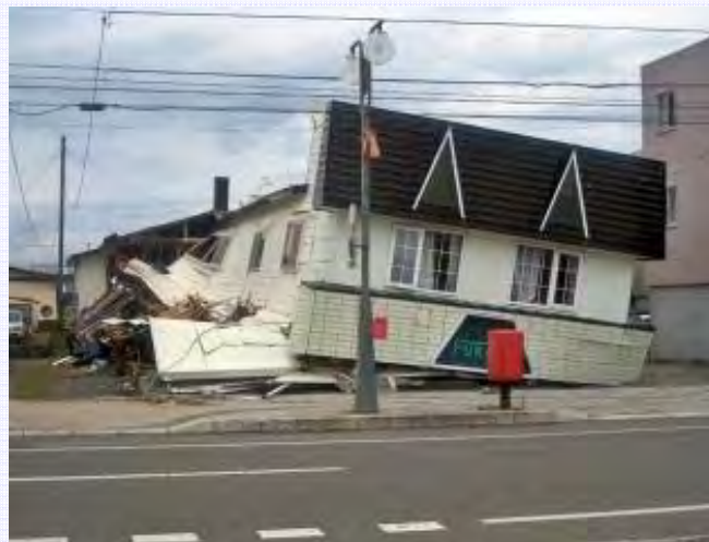
建物の層崩壊
