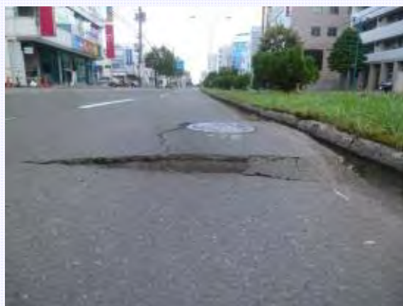
a地区 路面の沈下（北23条東15丁目）
