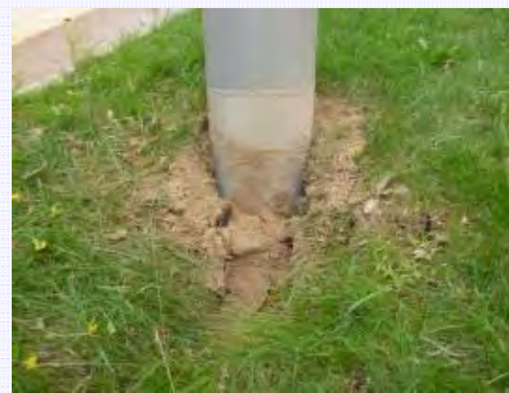
a地区 標識柱の根元の噴砂（北27条東15丁目）
