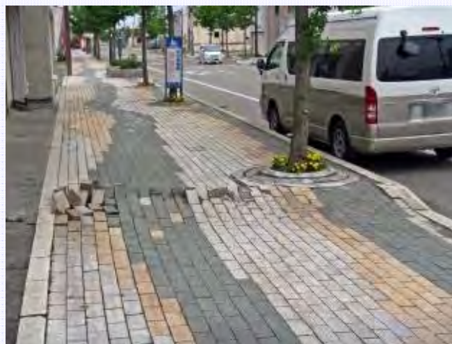
歩道インターロッキングの盛り上がり
