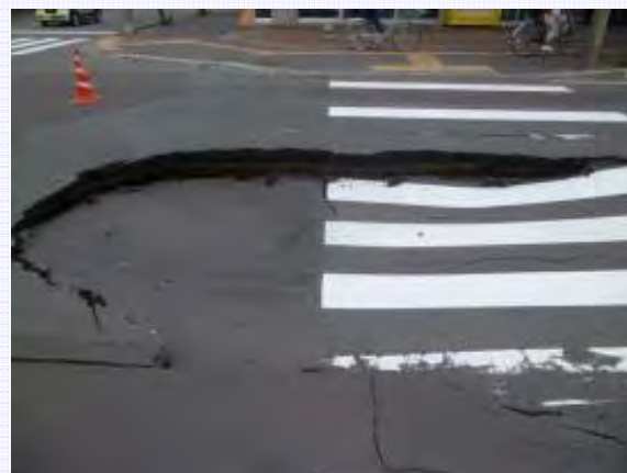
a地区 路面の沈下（北33条東15丁目）
