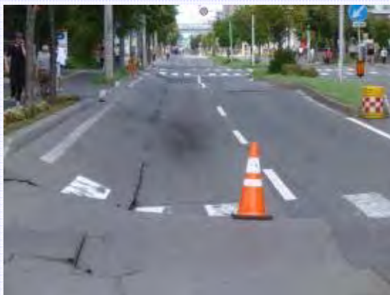
a地区 路面の沈下・陥没（北26条東15丁目）
