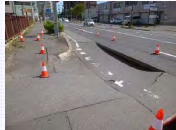
a地区 路面の沈下・陥没（北12条～13条）
