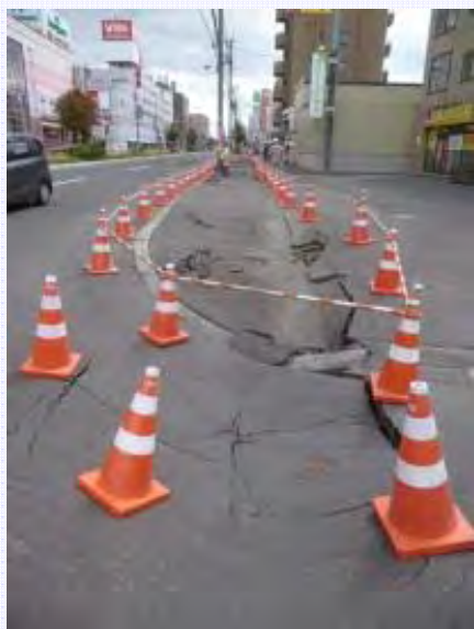
a地区 路面の沈下・陥没（北43条東15丁目）
