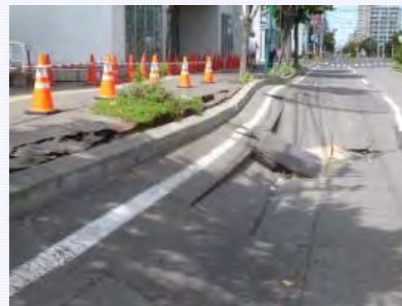
a地区 道路の沈下・陥没（北25条東15丁目）
