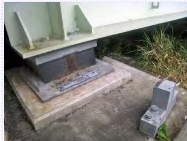
咲来橋（ニッタポロ川、安平町）の橋台ゴム支承のサイドブロックの損傷
