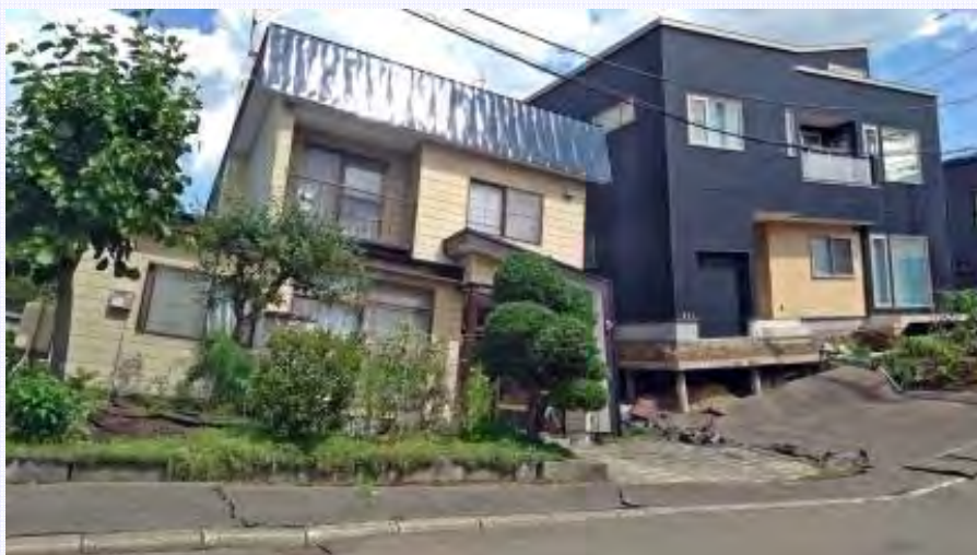
地盤の沈下・陥没により傾斜した住宅（西側より撮影）
