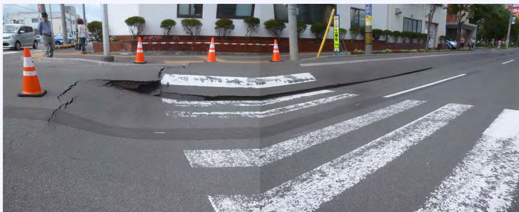
a地区 路面の沈下・陥没（北26条東15丁目）
