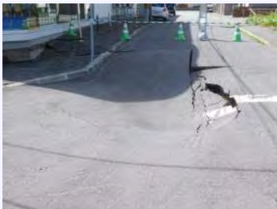
a地区 路面の沈下・陥没（北14条東15丁目）
