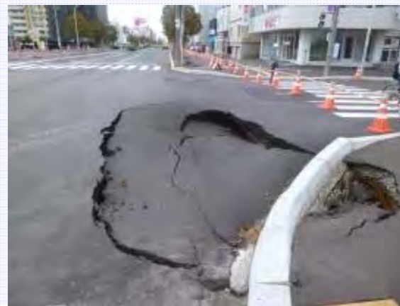
a地区 路面の沈下・陥没（北46条東15丁目）
