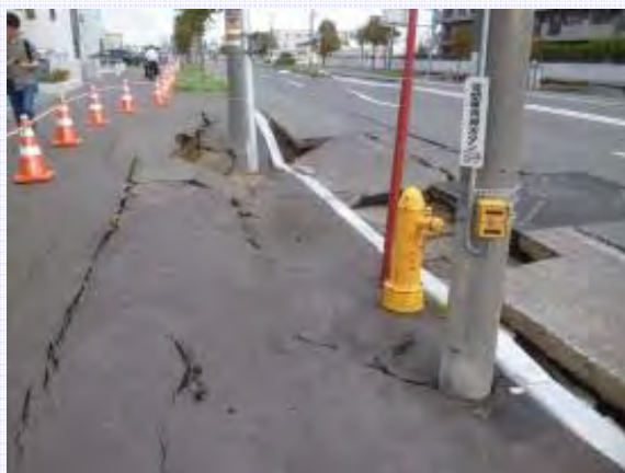
a地区 路面の沈下・陥没（北46条東15丁目）
