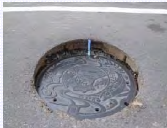
a地区 マンホールと路面の段差（北25条東15丁目）
