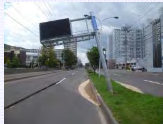
a地区 傾斜した標識柱と噴砂（北27条東15丁目）
