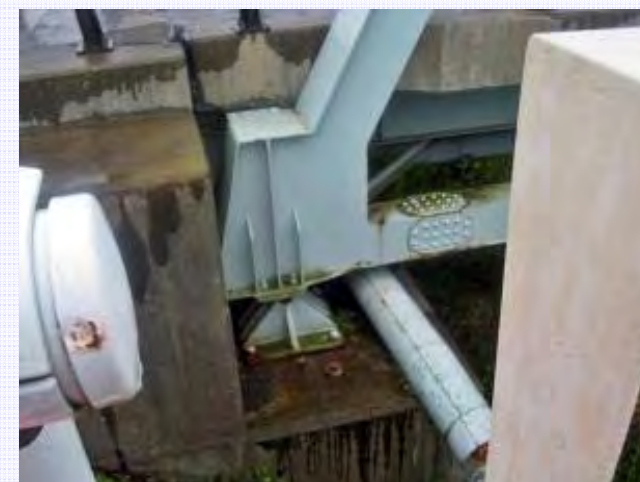
支承の一部と見られるものが転がっているが被害の詳細は不明（右岸橋台）
