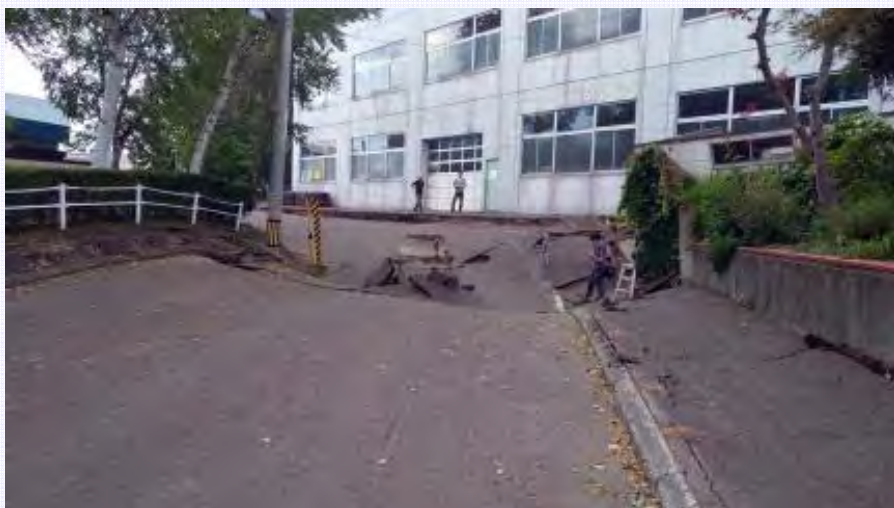
里塚中央ぽぷら公園北西角の道路の陥没（東側より撮影）
