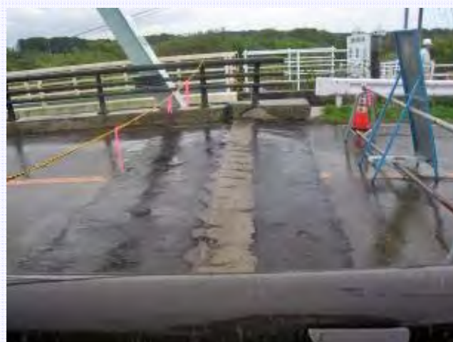
右岸側橋台部の沈下（応急復旧済）
