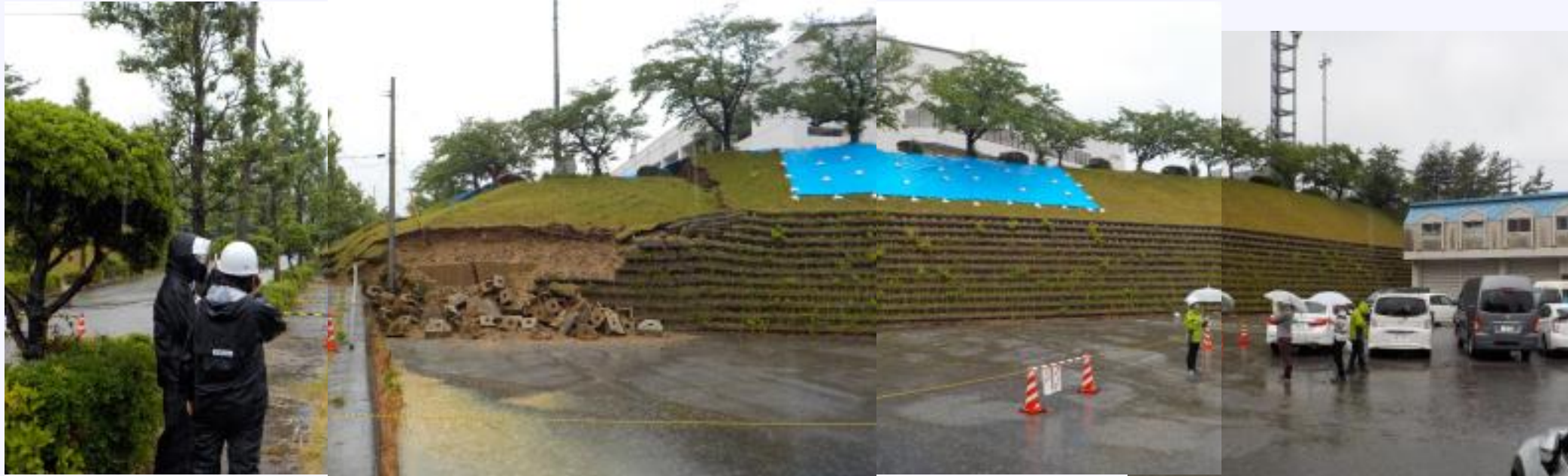
村上市山北町府屋地区 山北総合体育館のり面部の変状
