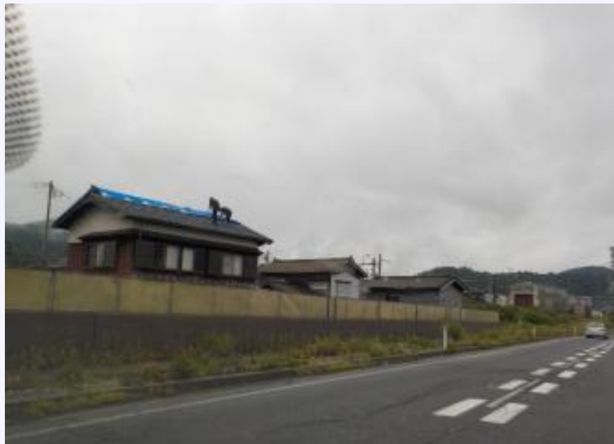
村上市府屋地区の屋根瓦被害
