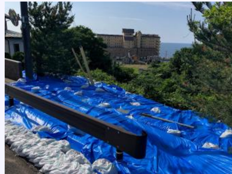
宅地のり面の変状
