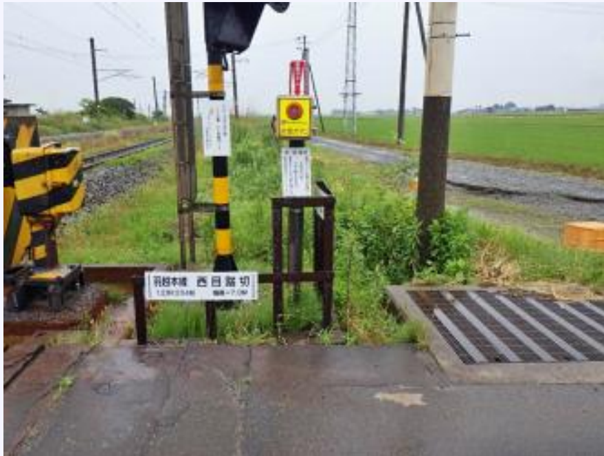
JR羽越本線羽前水沢駅付近の道路亀裂
