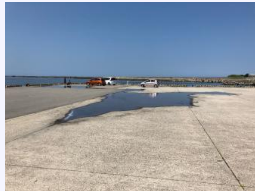
エプロン部の水溜まり（沈下）
