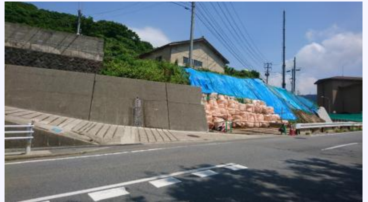
のり面の崩壊
