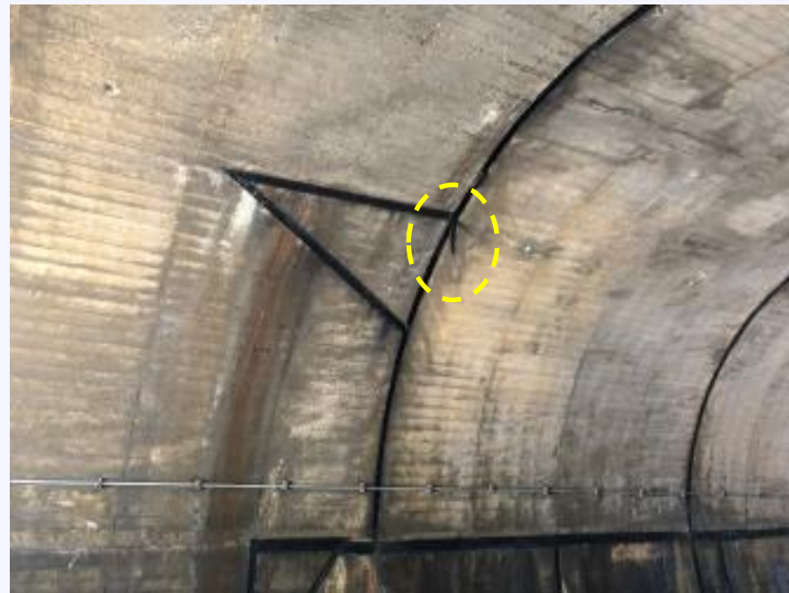
垂れ下がった止水ゴム
