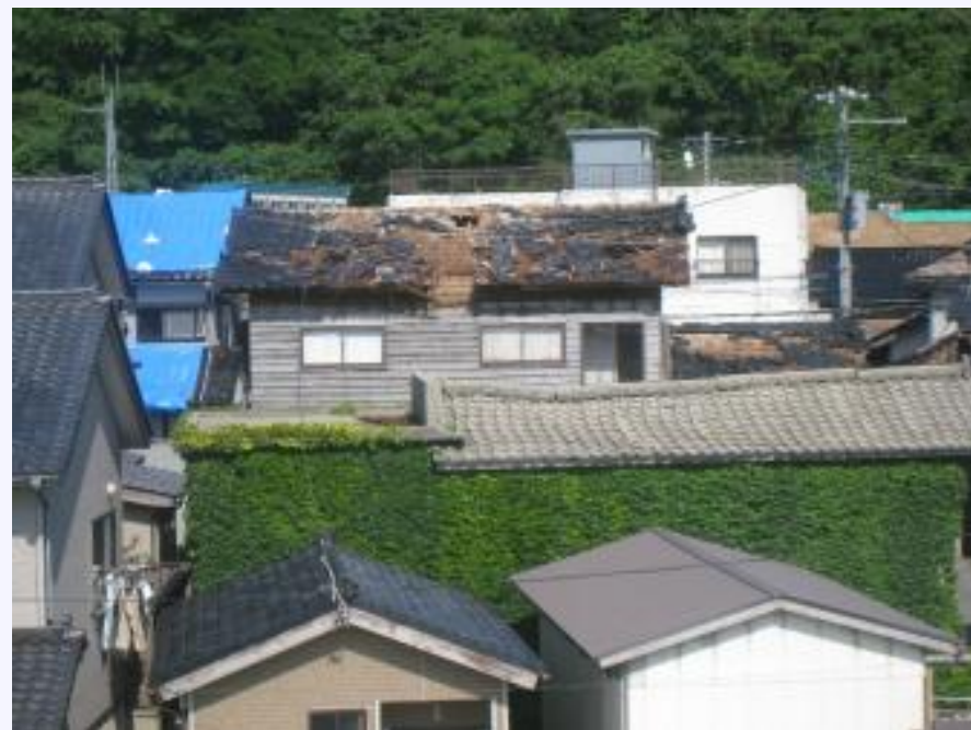
顕著な屋根瓦の被害と屋根の変形 (手前)
