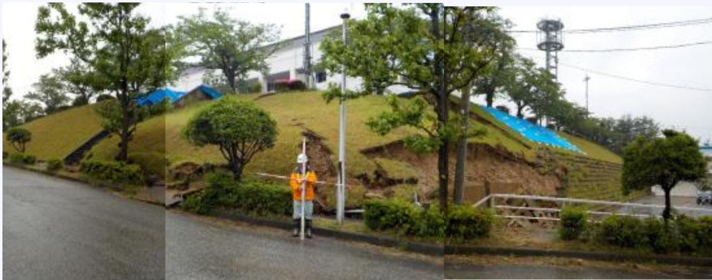
のり面部の変状を別角度から望む
