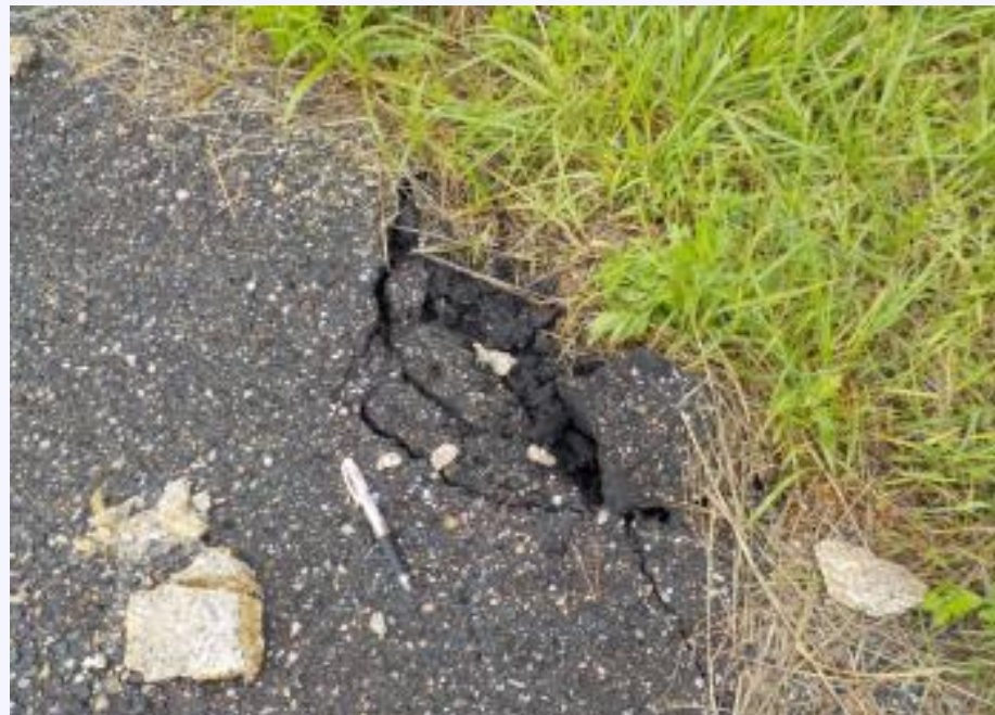
落石による路面陥没
