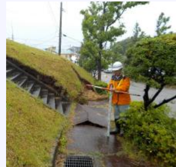
のり尻部の歩道の座屈
