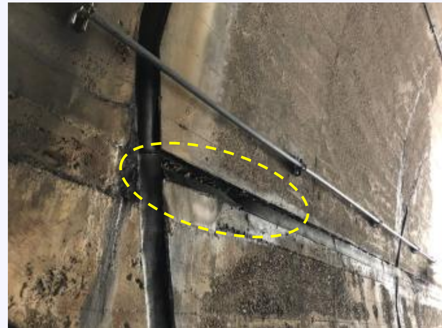
はがれた止水ゴム
