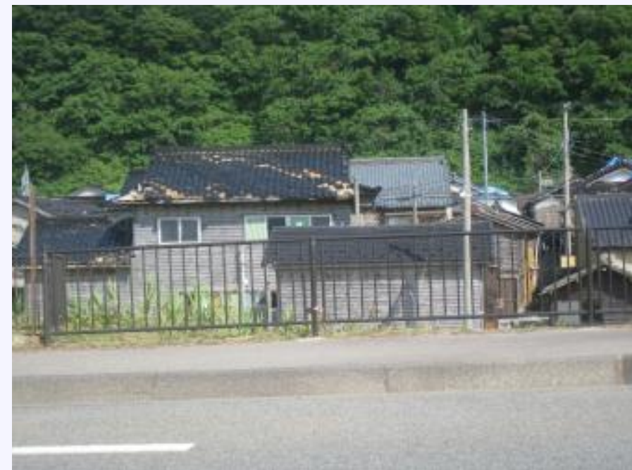
屋根瓦の被害
