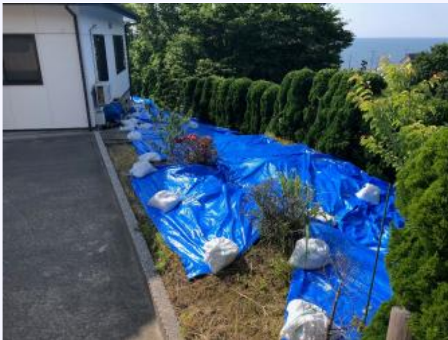
宅地のり面の変状
