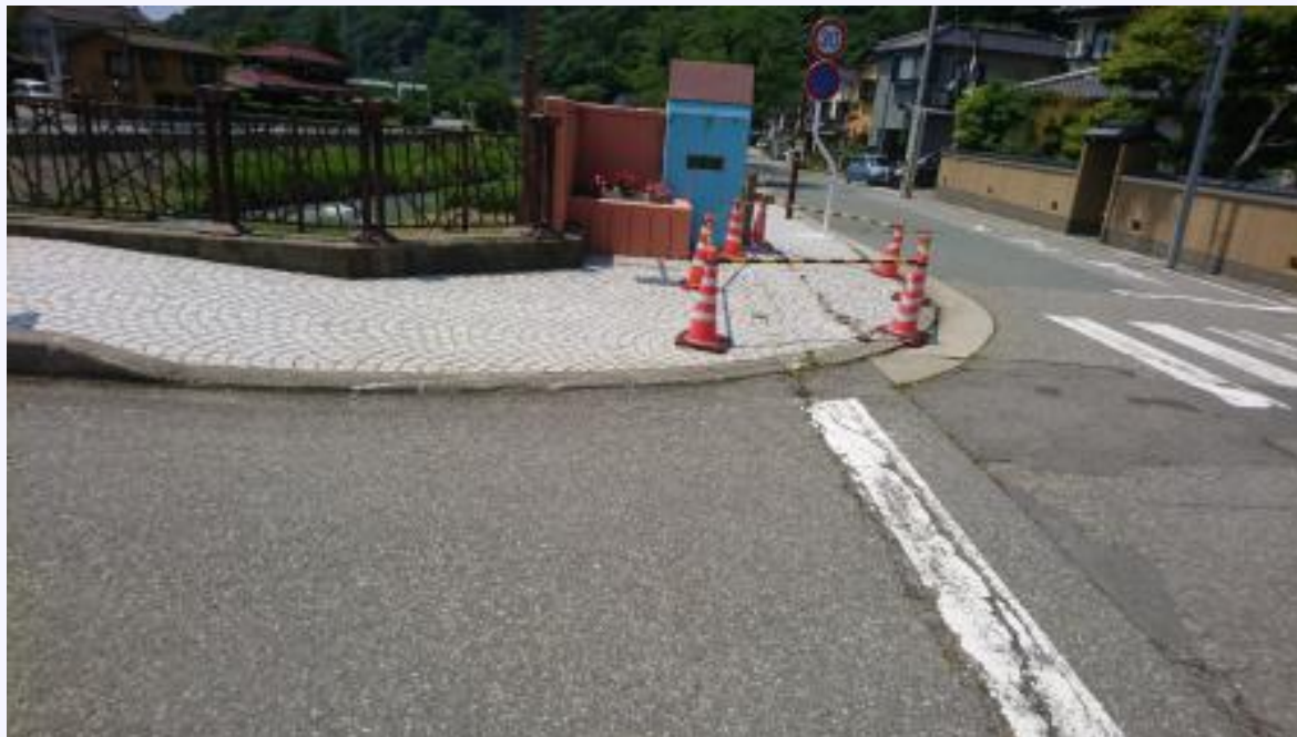
橋の袂のインターロッキングの被害
