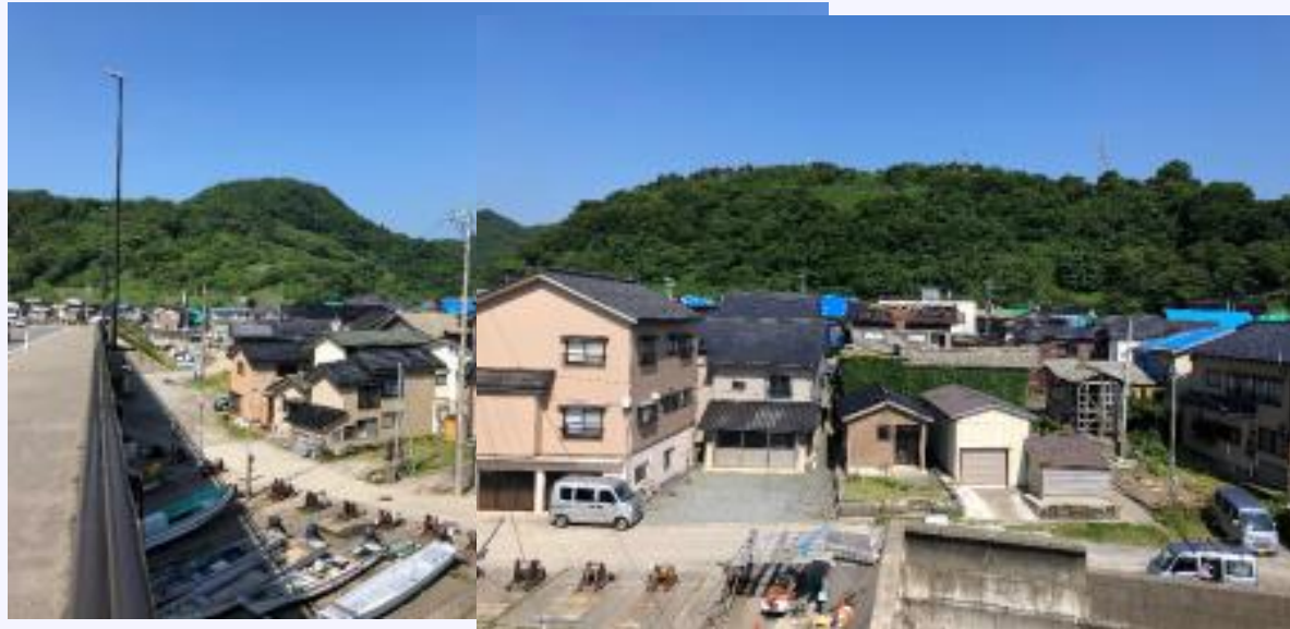
鶴岡市小岩川地区の屋根瓦被害(北側)
