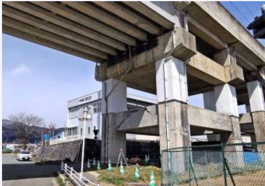
高架橋中層梁の斜め亀裂とコンクリート剥落
