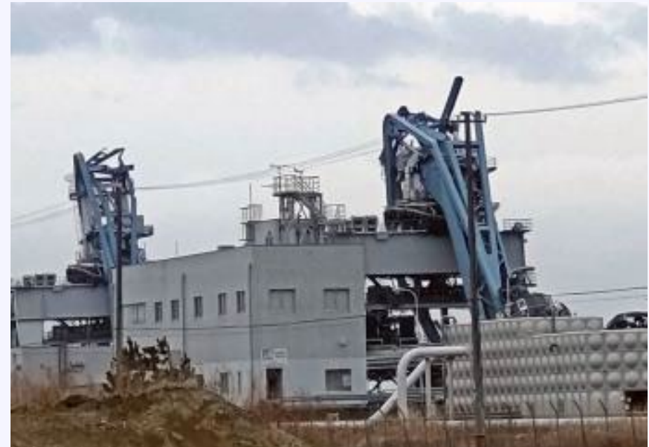
同左 近景。倒壊した揚炭機
