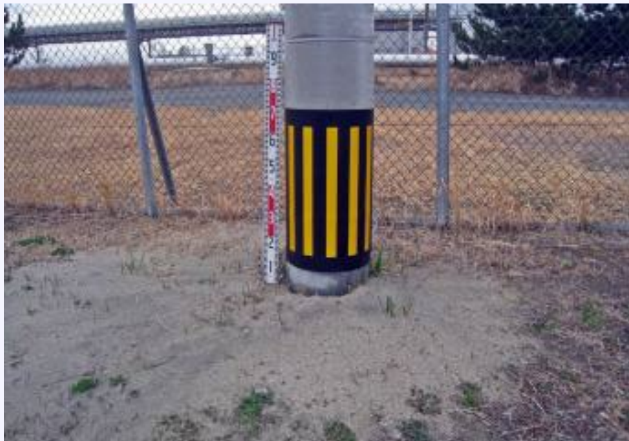
5号ふ頭北側の護岸背後で見られた電柱の沈下と脇から出た噴砂
