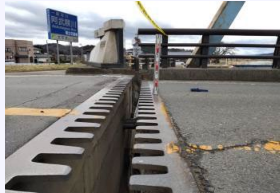
右岸橋台部の変状（橋桁の西側への移動と沈下による伸縮装置の開口）
