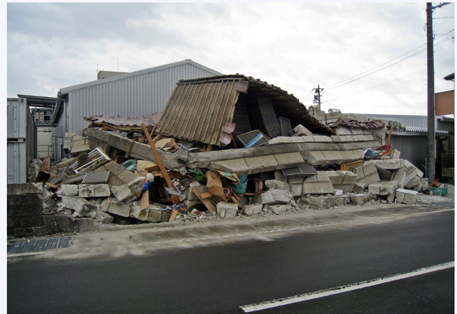
全壊した組積造の建物（非住家）（相馬市尾浜）
