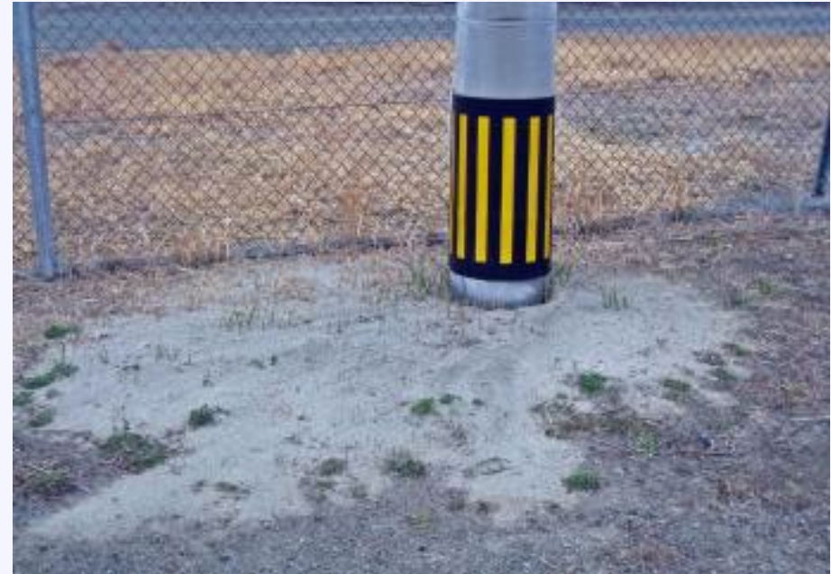
5号ふ頭北側の護岸背後で根元から砂を噴き出して沈下した電柱
