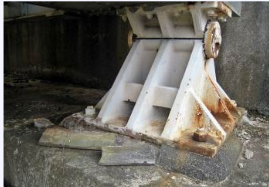
A 1 橋台（左岸側）の支承。支承部のコンクリート台座の縁が少し欠けている
