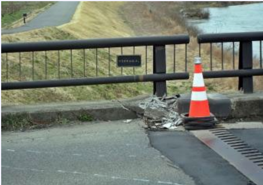
伸縮装置周囲の補修痕と端部のコンクリート破壊
