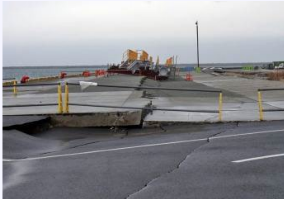
4号岸壁(-10m)の背後の亀裂
