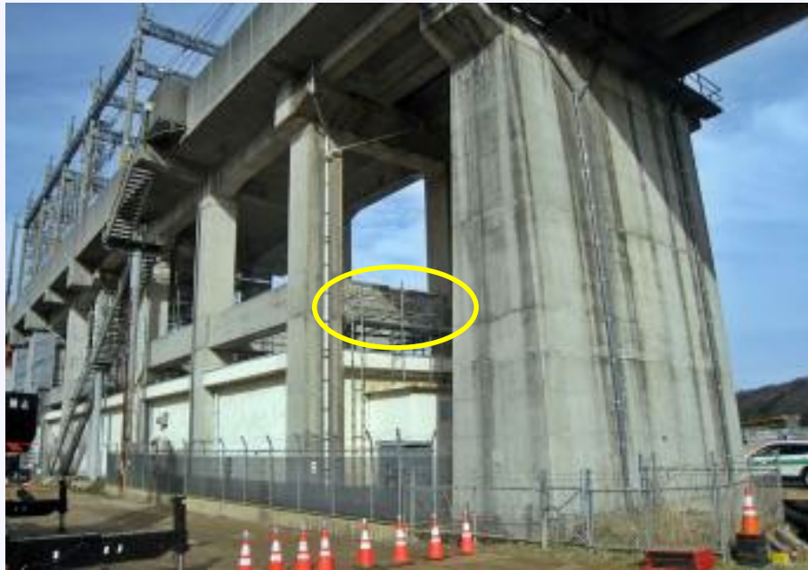
中層梁の斜めひび割れとコンクリート剥落
