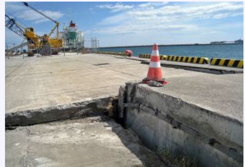
1号岸壁(-5.5m)と2号岸壁(-7.5m)の境目付近の段差
