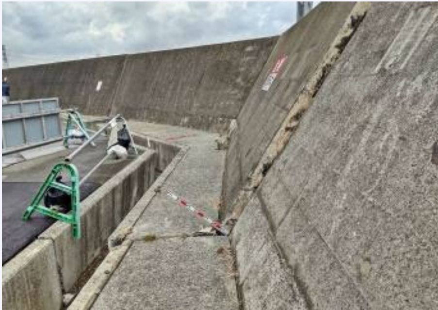
北側防潮護岸のはらみ出し
