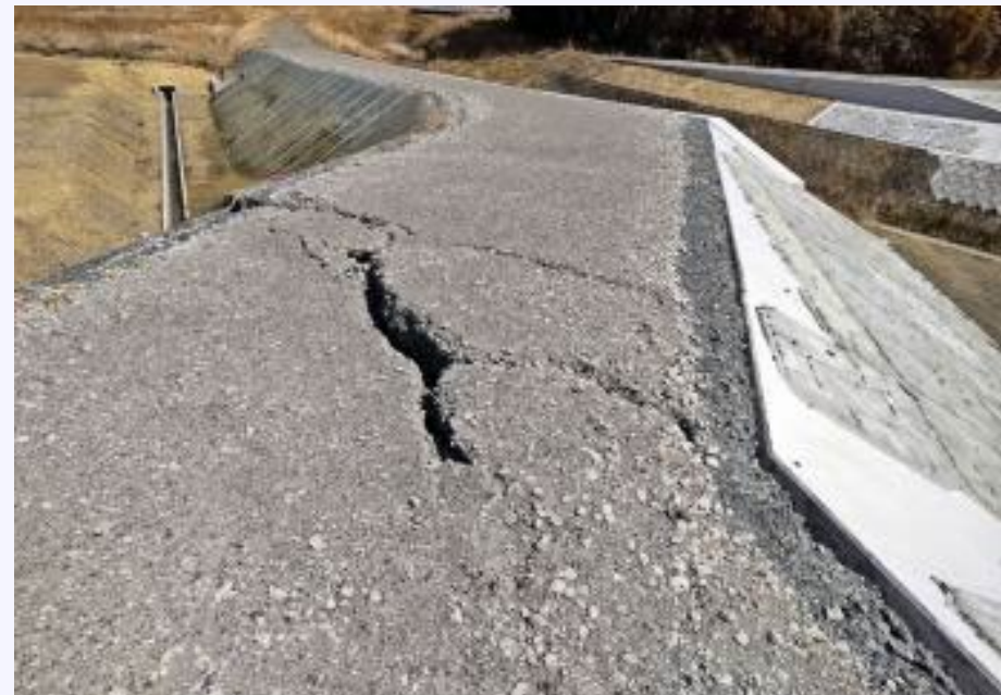
左岸堤防天端の亀裂
