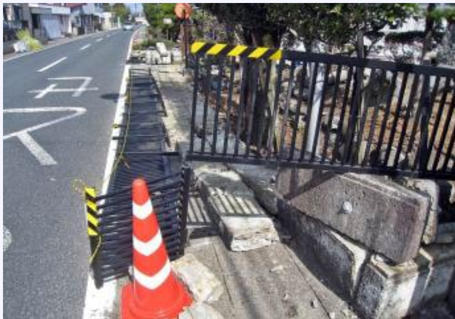
石塀の倒壊（南相馬市鹿島区）
