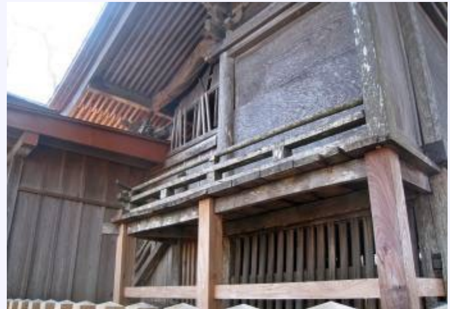
社殿の損傷（同左）
