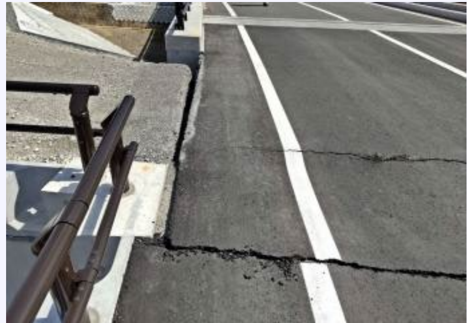
取付盛土の水平移動により出来た間隙
