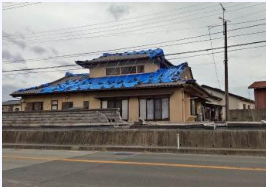
家屋屋根瓦の破損（相馬市尾浜B地点）
