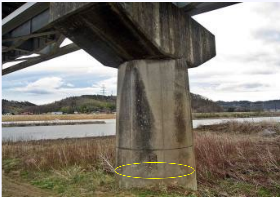
P 1 橋脚の根元に生じた亀裂
