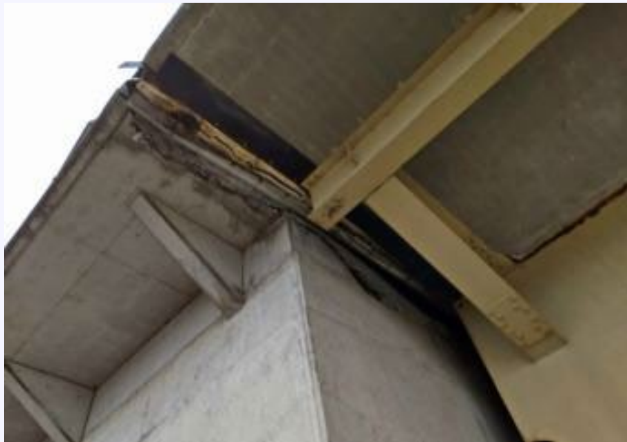
橋台と橋桁の接合部の変状
