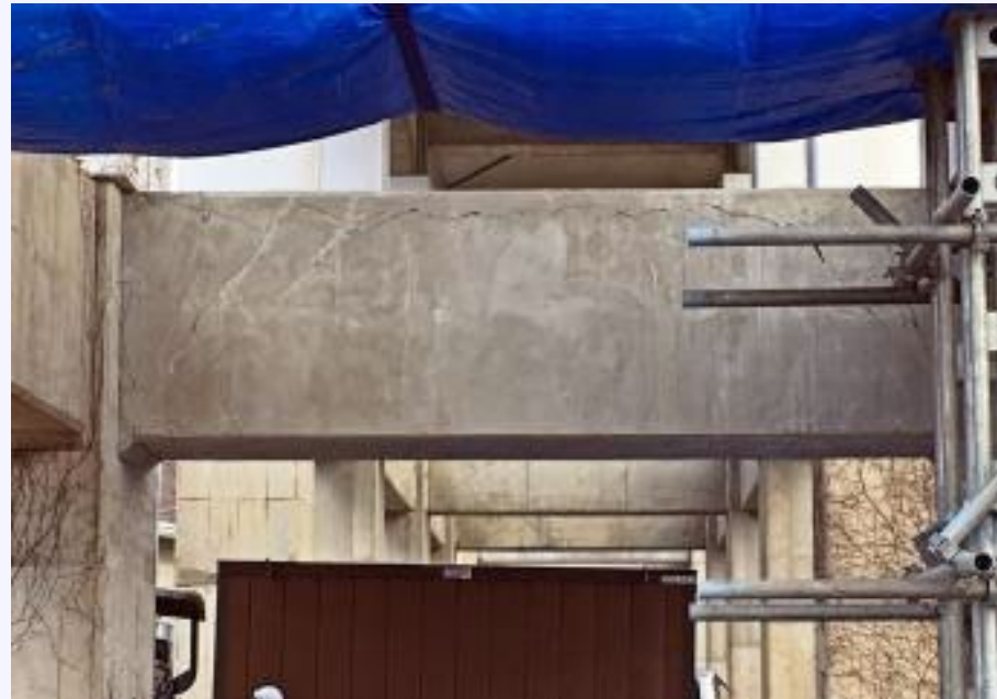
中層梁の斜め亀裂と上端部の水平亀裂
