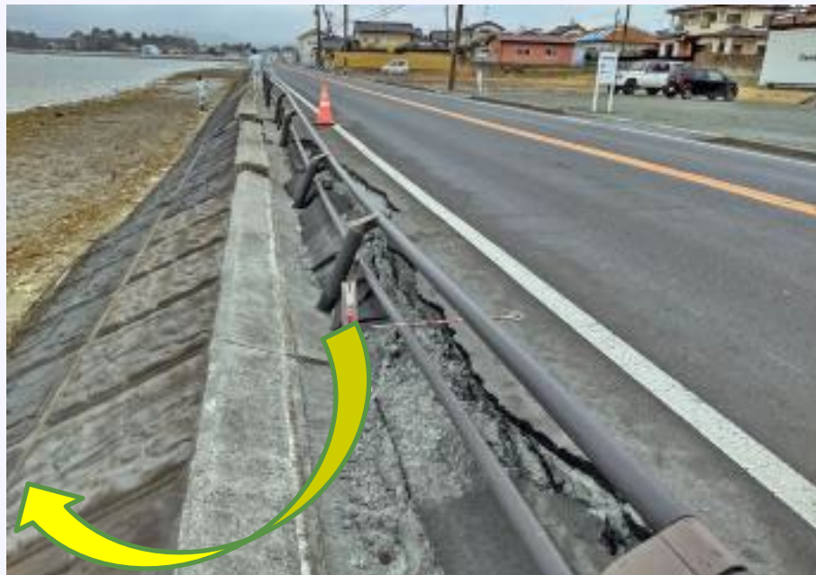
法肩は道路面に対して回転するように沈下した (A地点)
