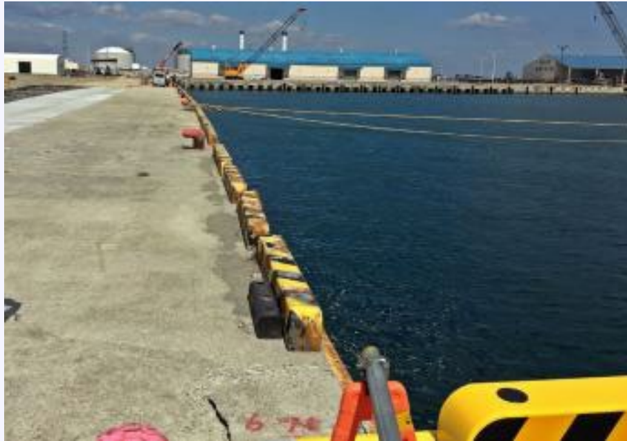
東側泊地岸壁(-5.5m)のはらみ出し
