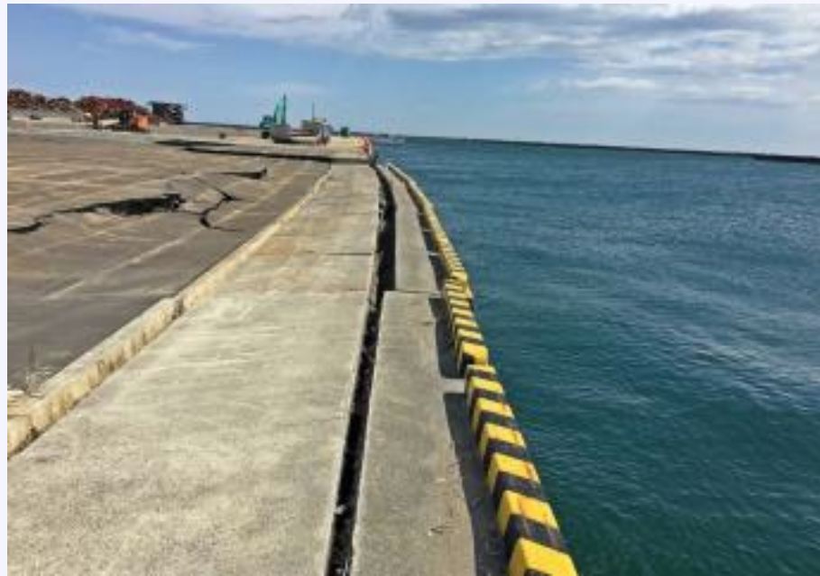
第2船溜まり(-4m)のはらみ出しと背後の亀裂
