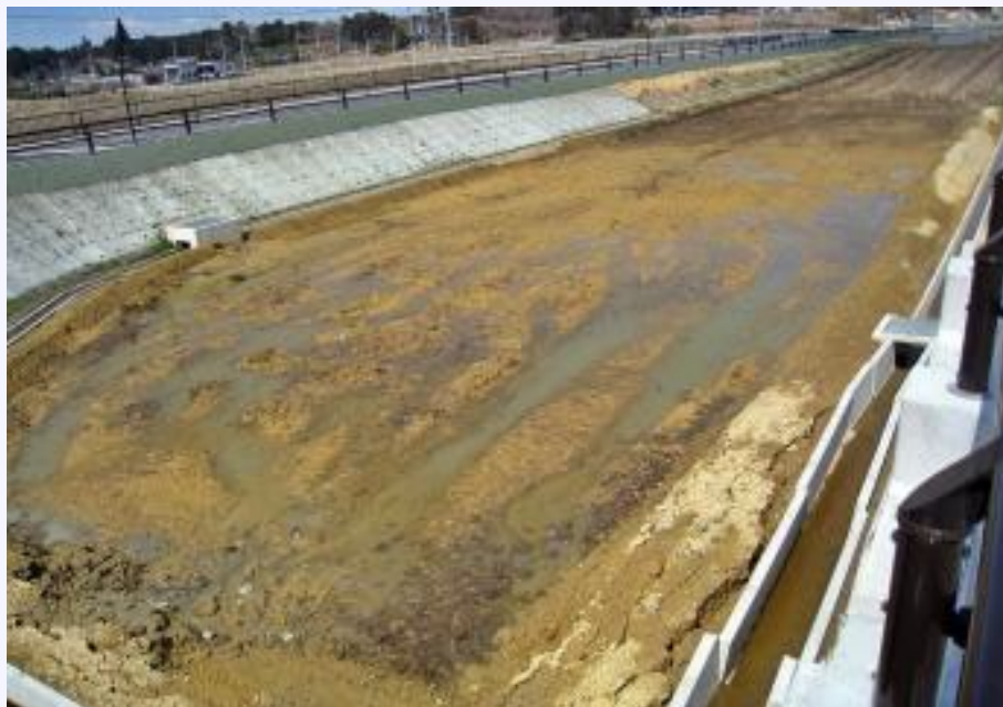
砂子田川左岸沿いの地盤に見られた噴砂とU字溝の変状
