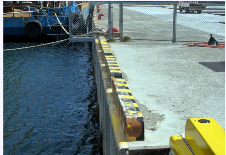
6号岸壁(-5.5m)のはらみ出し
