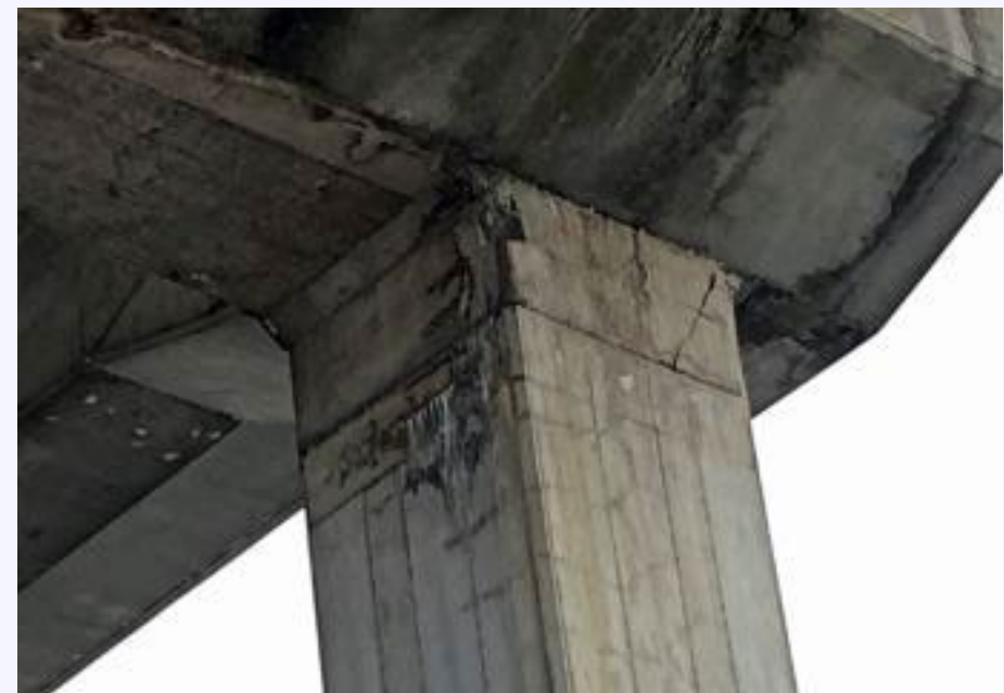
橋脚の上端部の亀裂（古そうなので、今回の地震のものではないかもしれない）
