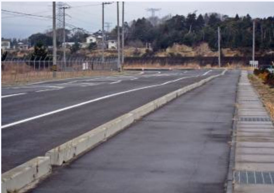
北側防潮護岸背後道路の波うち
