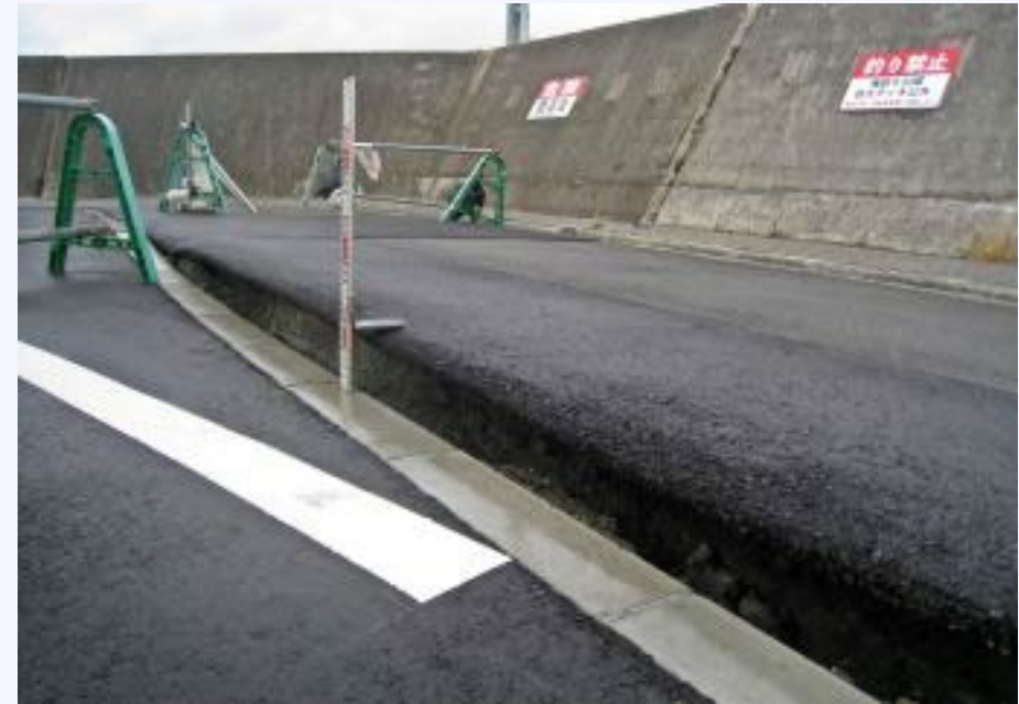
北側防潮護岸背後の道路沈下
