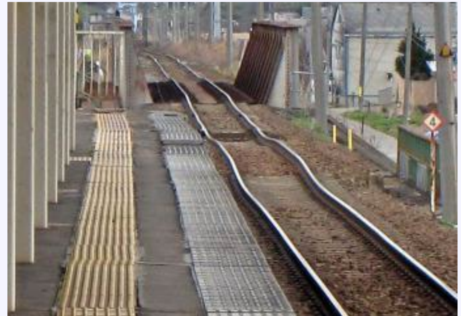
盛土の沈下によるレールの波うち
