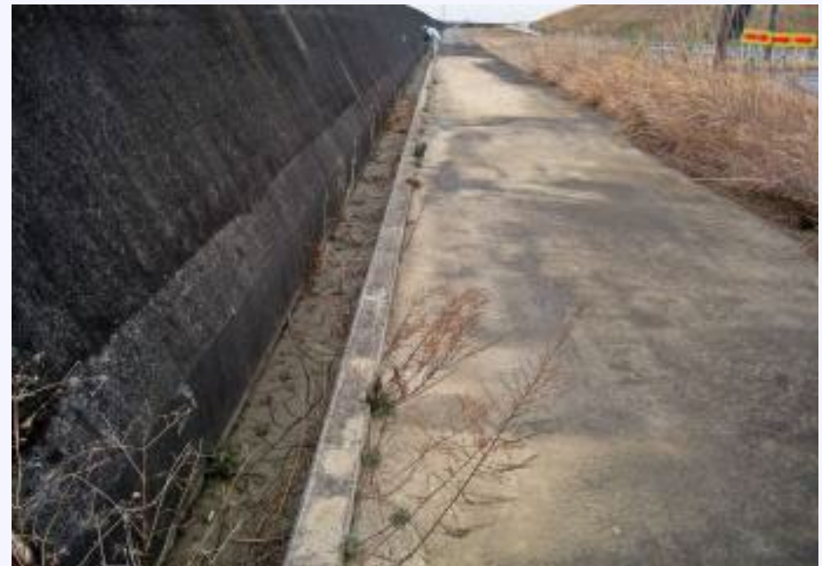
北側防潮護岸背後の水路に堆積した噴砂
