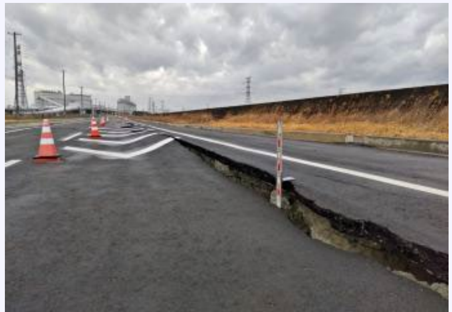
北側護岸背後の路面陥没
