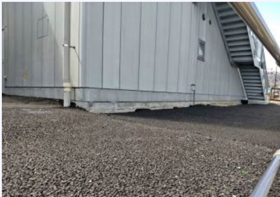
液状化に伴う地盤沈下で露出した基礎。付近は新たに舗装されているようである。
