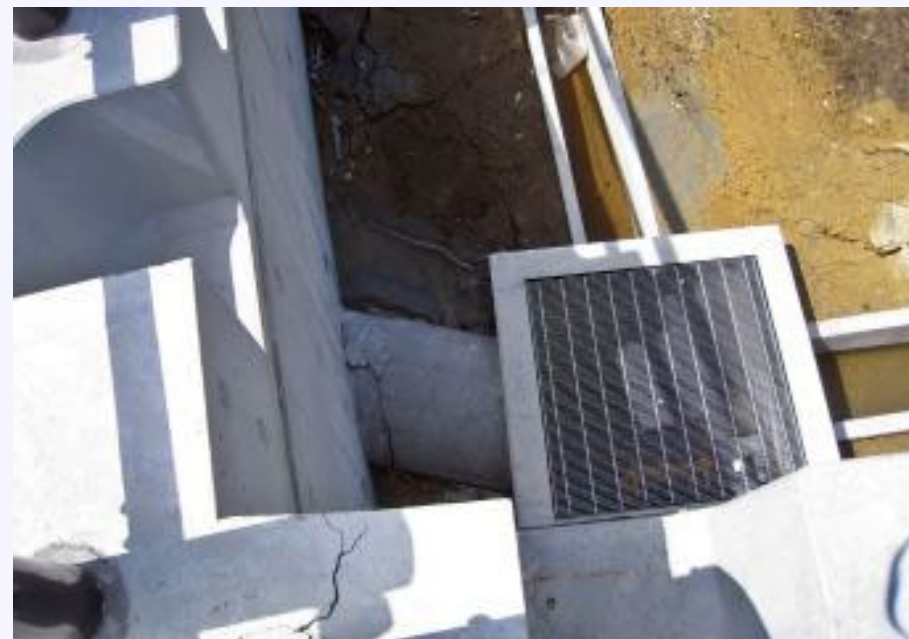
左岸取付盛土を貫通する排水管の破損
