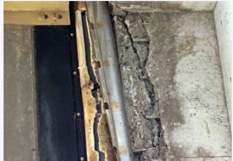
同左 橋台のコンクリート剥落部が古いため、今回の地震のものではないかもしれない
