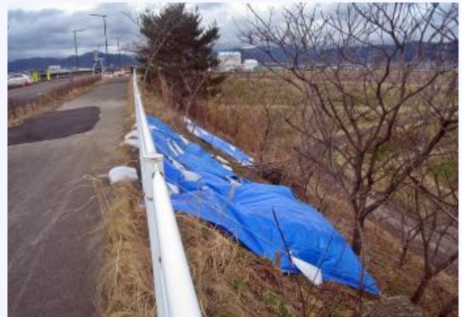
取付盛土下流側法面の被害
