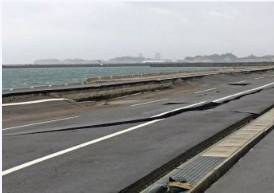
東側岸壁(-10m) のエプロン沈下と亀裂
