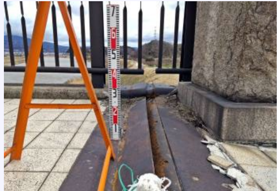
変形した橋台（右側）と橋桁（左側）の接続部
