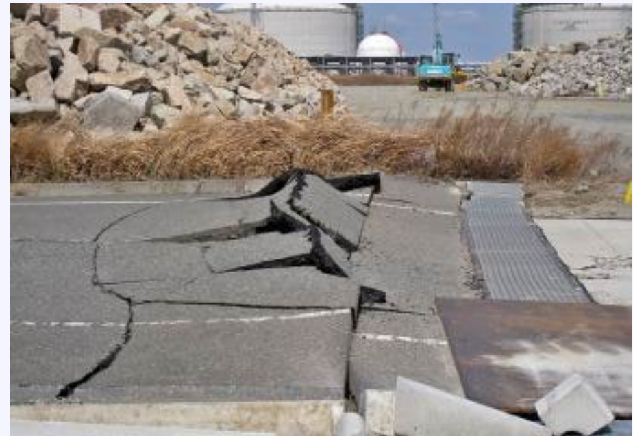
第2船溜まり(-4m)背後道路のバックリング
