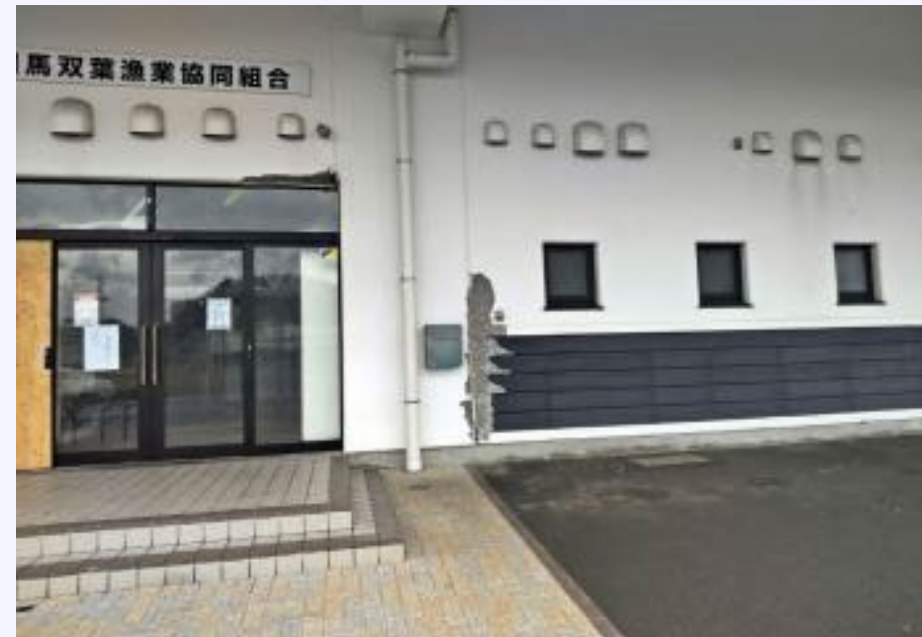
同左 玄関横のコンクリート剥落
