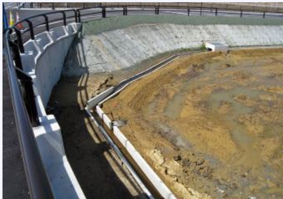
左岸取付盛土脇のU字溝の変状
