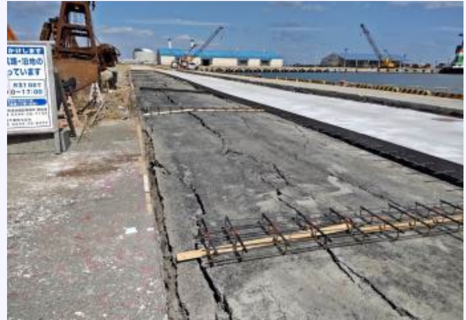
5号岸壁(-5.5m)背後エプロンの亀裂。同所は2021年の地震の復旧箇所と思われる。
