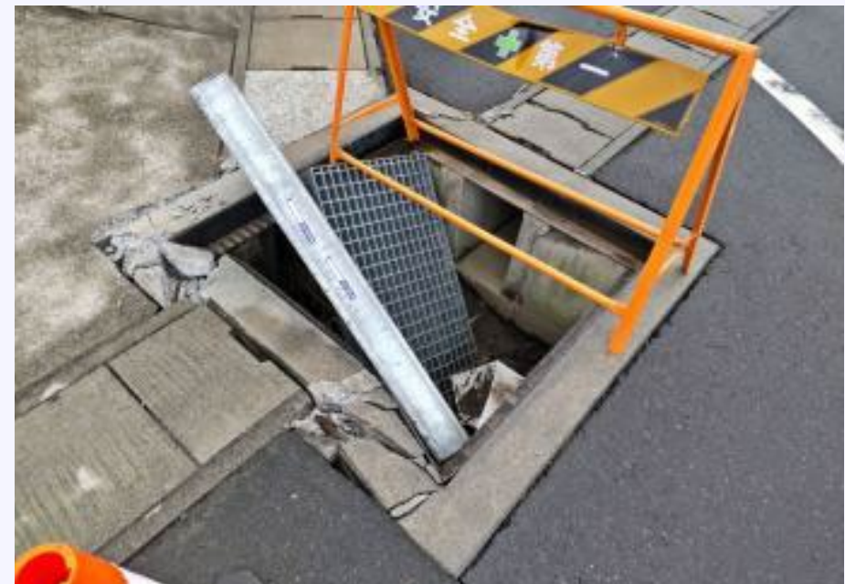
押されて変状した排水柵（A地点）
