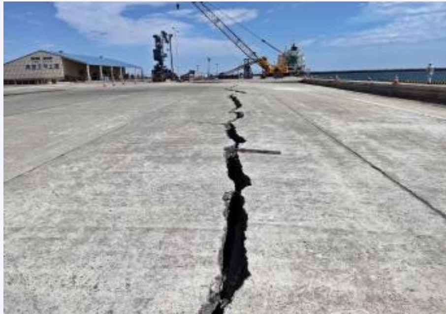
1号岸壁(-5.5m)背後エプロンの沈下・亀裂
