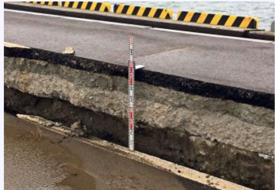
同左 エプロン沈下の近景
