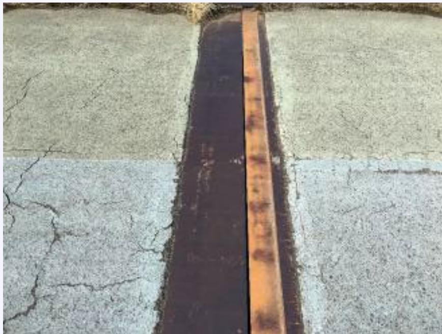
橋桁連結部の床板のずれ（西側から1区間目）
