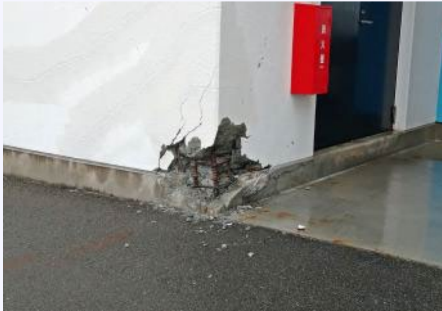
卸売市場の建物角の損傷
