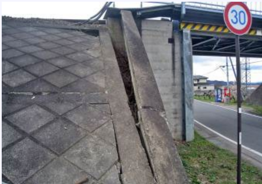
盛土のもたれ擁壁のはらみ出しと亀裂
