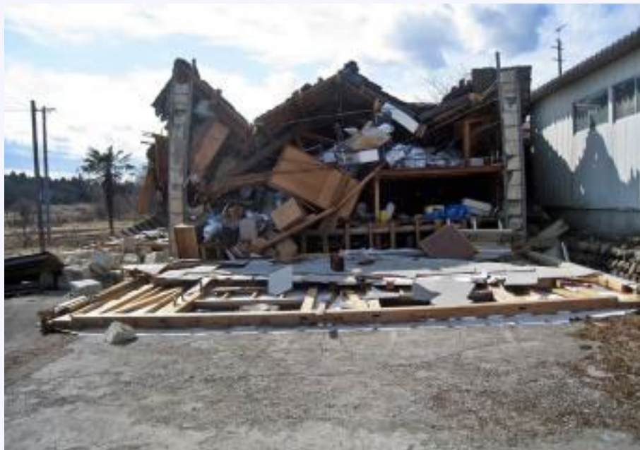
側面の倒壊した木造壁。柱代わりのチャネル材の部分だけ石が残っている（同上）。
