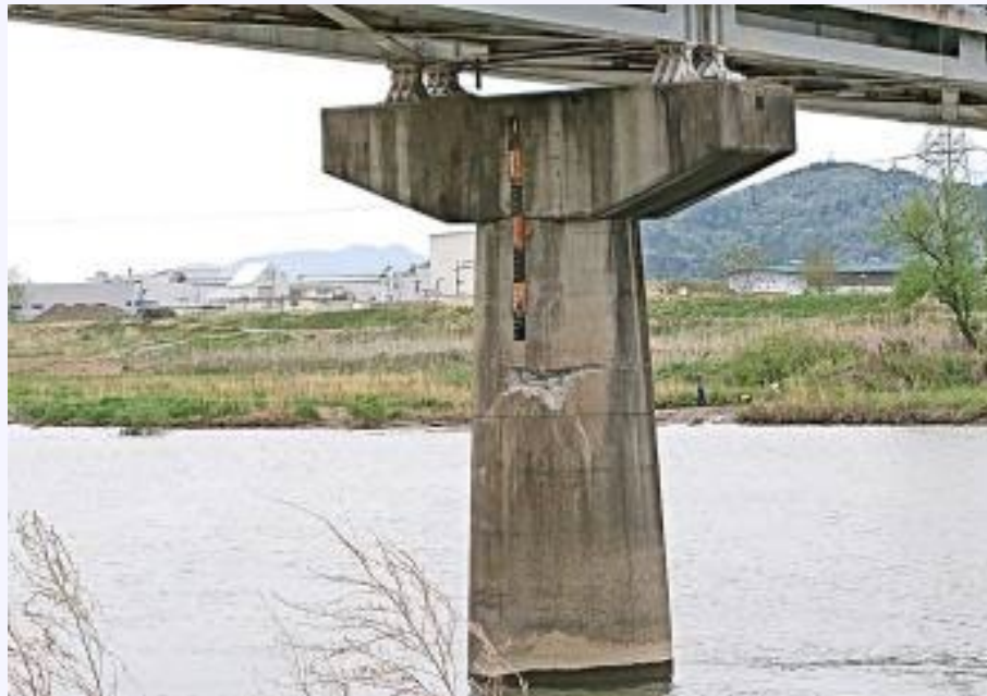
右岸側より見たP3橋脚の被害
