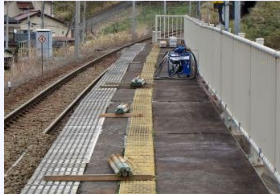
向瀬上駅のホームの変状
