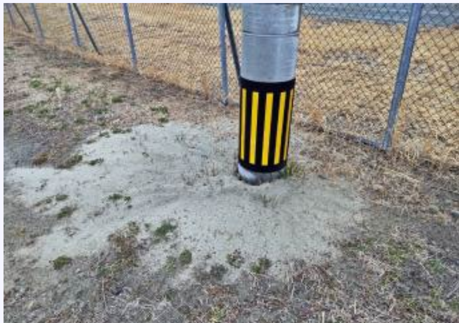
液状化による電柱の沈下と噴砂
