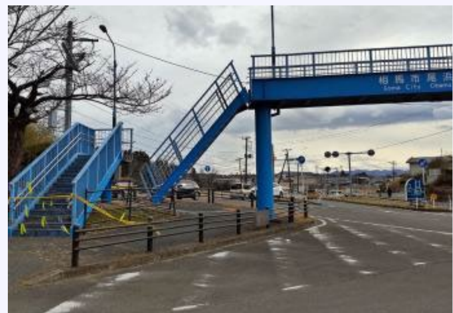
歩道橋の落下（B地点）
