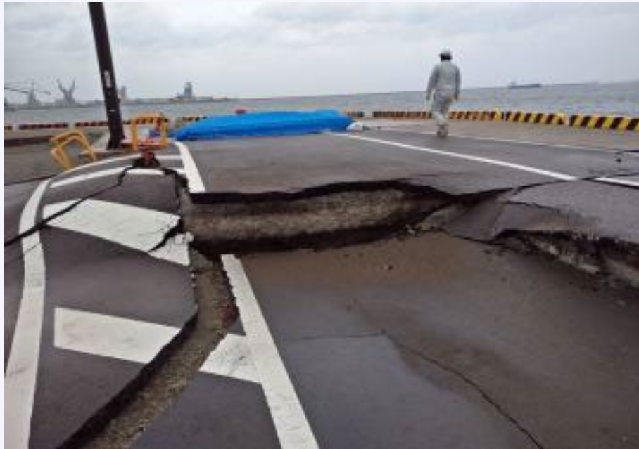
1号岸壁(-12m、耐震) のエプロン陥没
