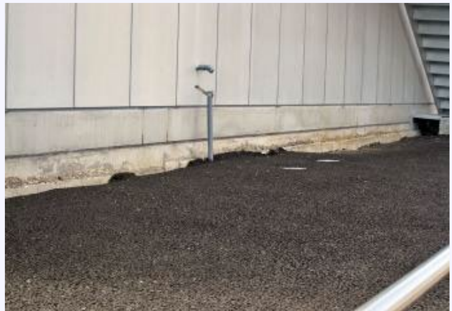
同左 近景。地盤沈下により塩ビ管が抜け出しているように見える。
