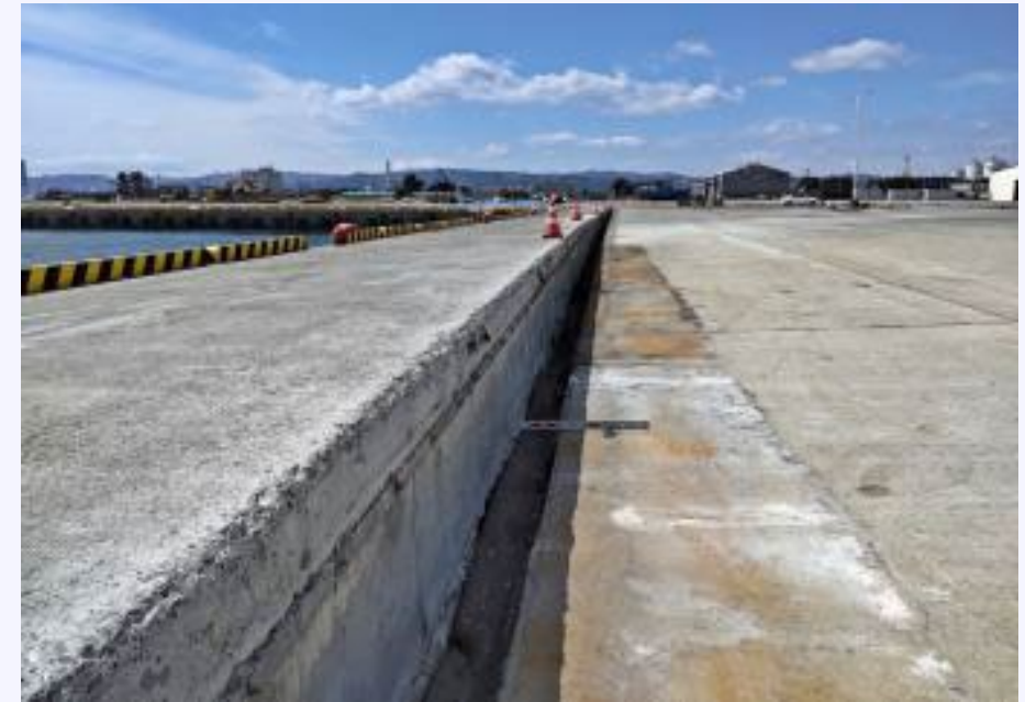
1号岸壁(-5.5m)背後エプロンの沈下
