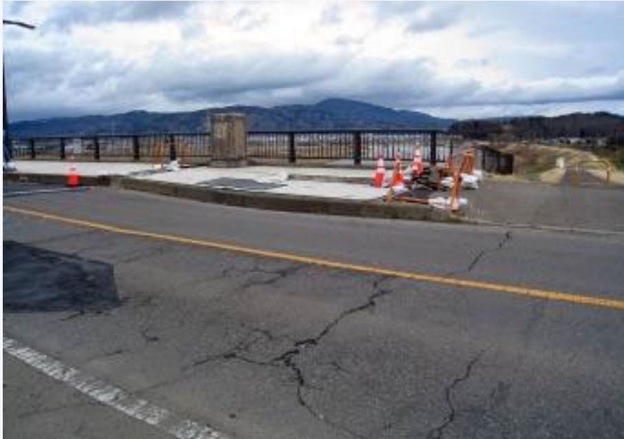
取付盛土の沈下によると思われる歩道の沈下と車道の亀裂
