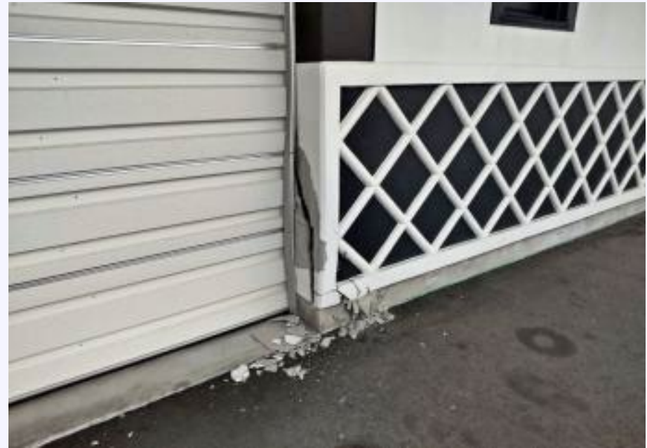
卸売市場の建物壁の損傷
