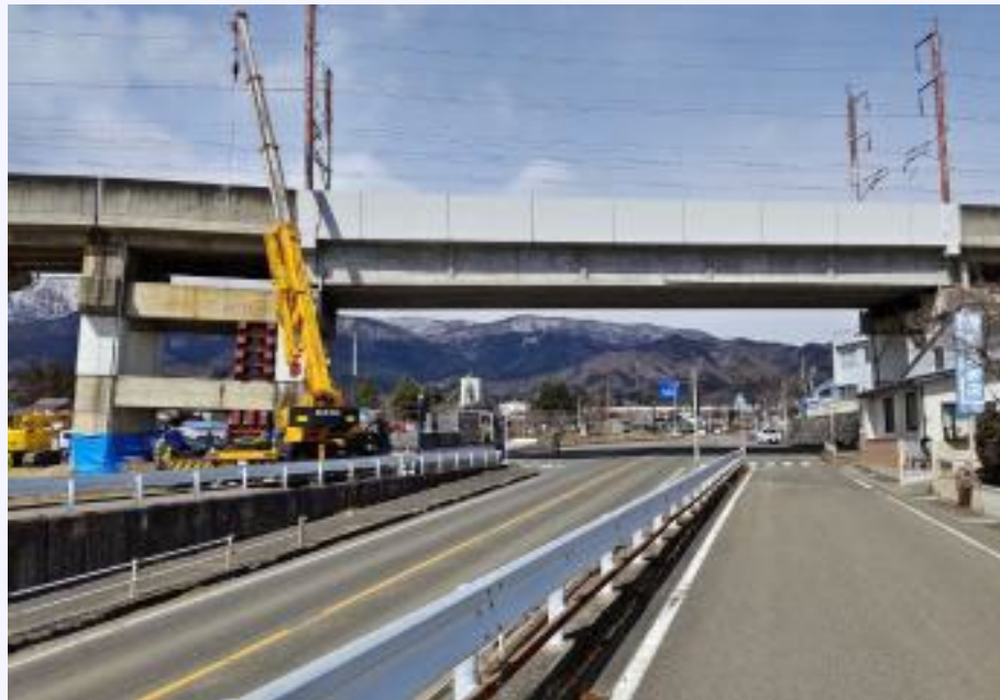
東北新幹線が県道46号を横断する被害箇所
