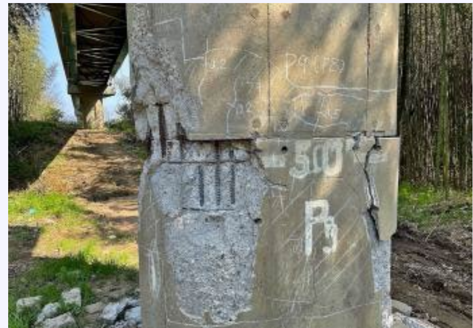
枝野橋P 9 橋脚の被害状況（2）
