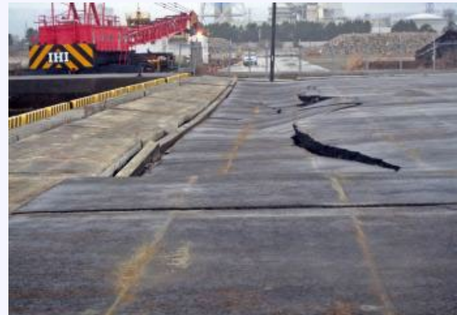
護岸のはらみ出しに伴う背後地盤の沈下
