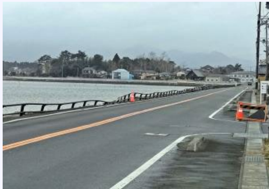
道路法肩の防護柵の変状（県道38号A地点）
