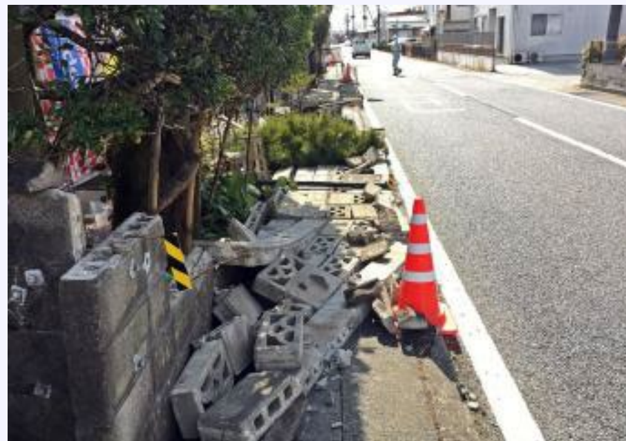
ブロック塀の倒壊（同左）
