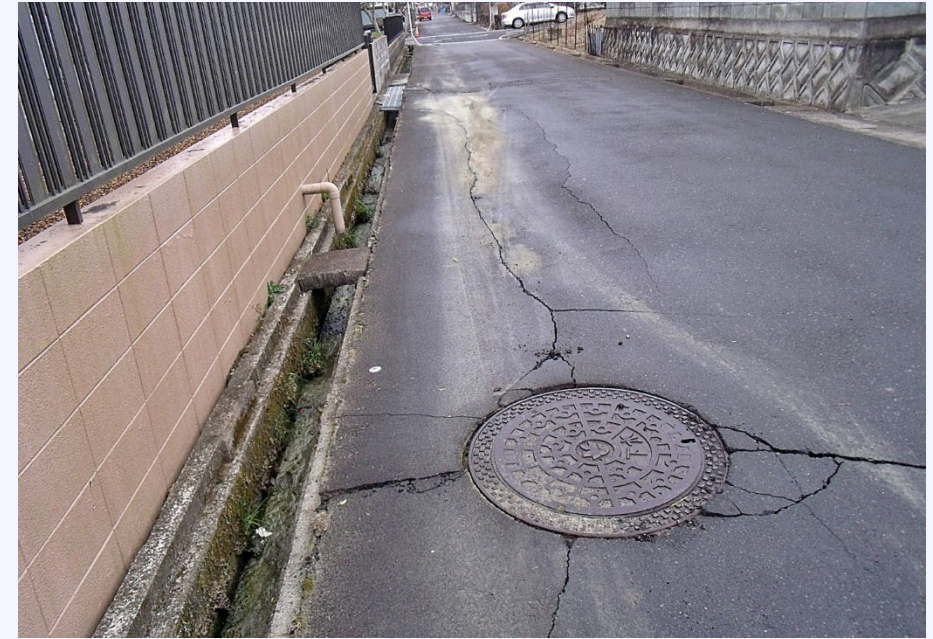
下水管路埋戻し箇所の亀裂・沈下
