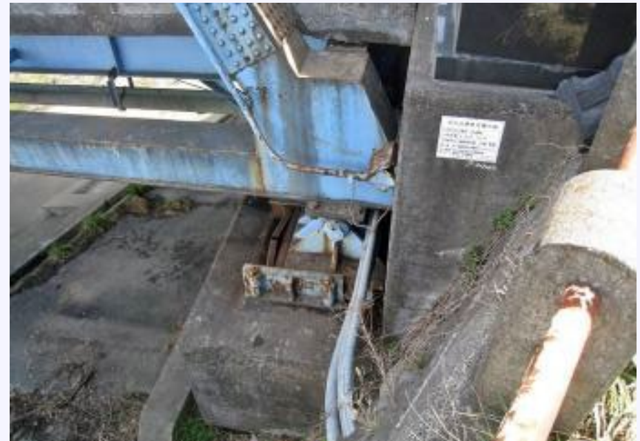
左岸橋台部における支承の移動
