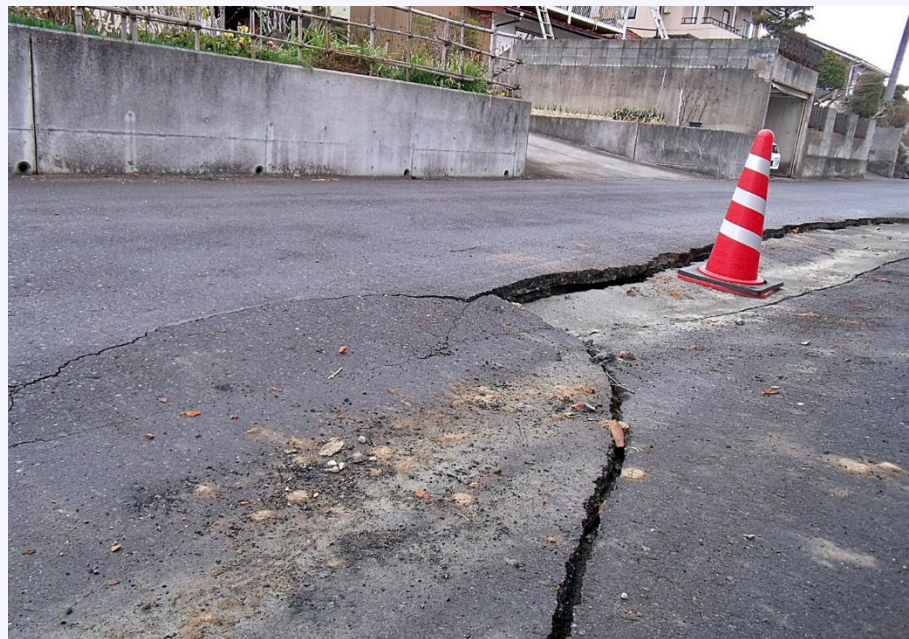
下水管路埋戻し箇所の亀裂・沈下
