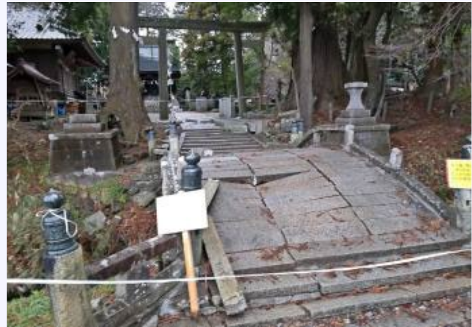
石橋の被害と鳥居の貫の倒壊
