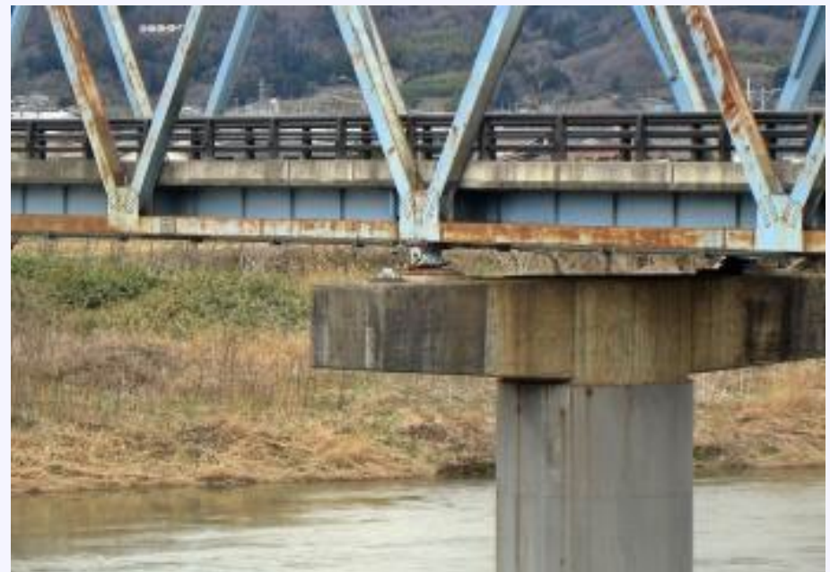
橋脚部の支承の変状。橋脚は鋼板巻きで耐震補強が行われているようである。
