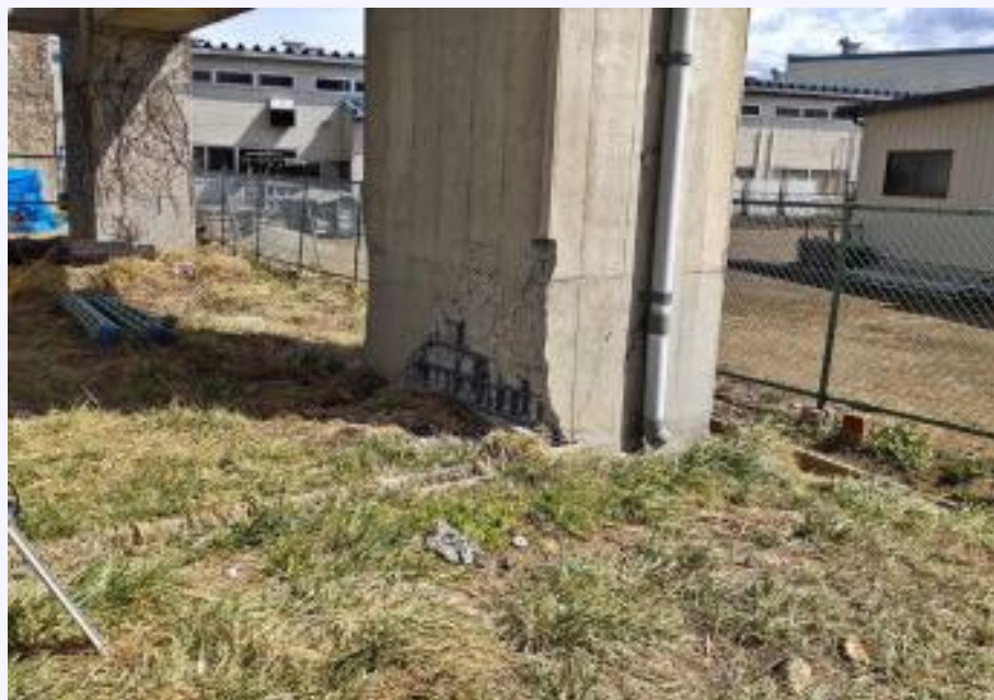
橋脚下端部のコンクリート剥落
