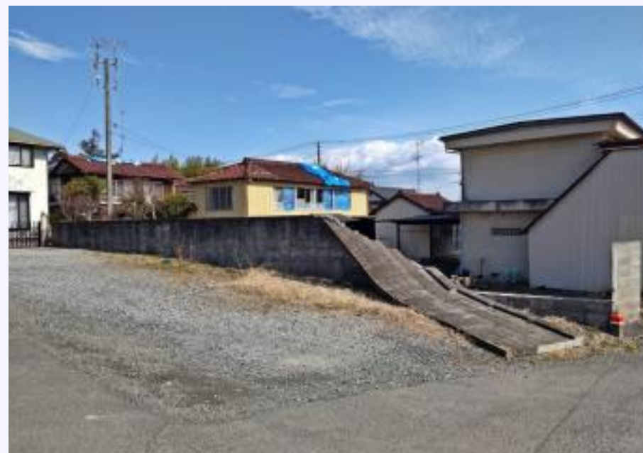
ブロック塀の倒壊（相馬市JR日立木駅近傍）
