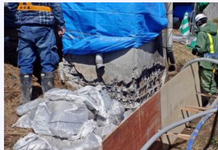
橋脚下端部のコンクリート剥落（修復のため、ある程度コンクリートを剥がしていると思われる）
