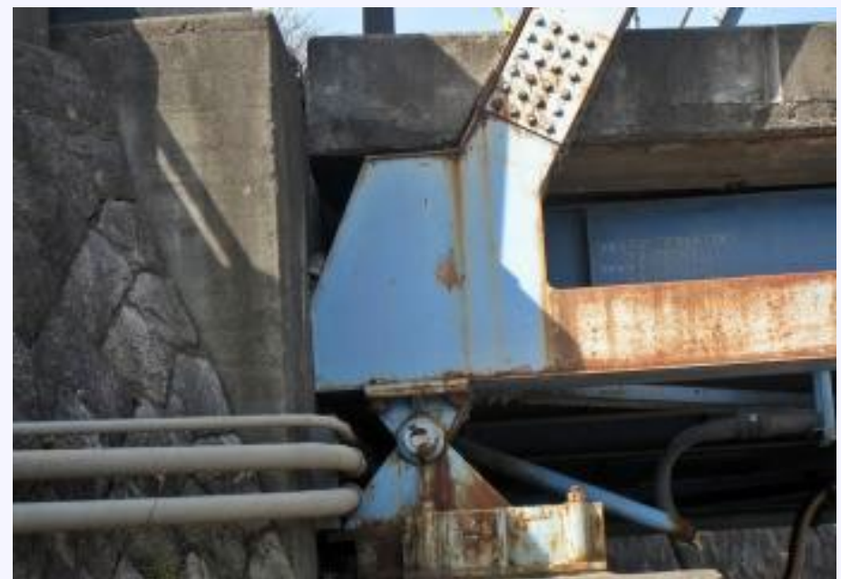
橋台が橋桁に押された状態で接触している
