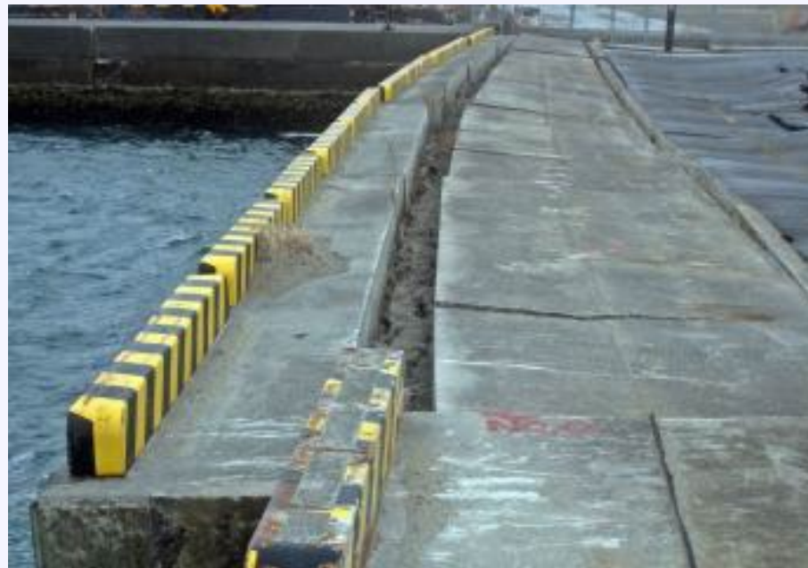
護岸のはらみ出し
