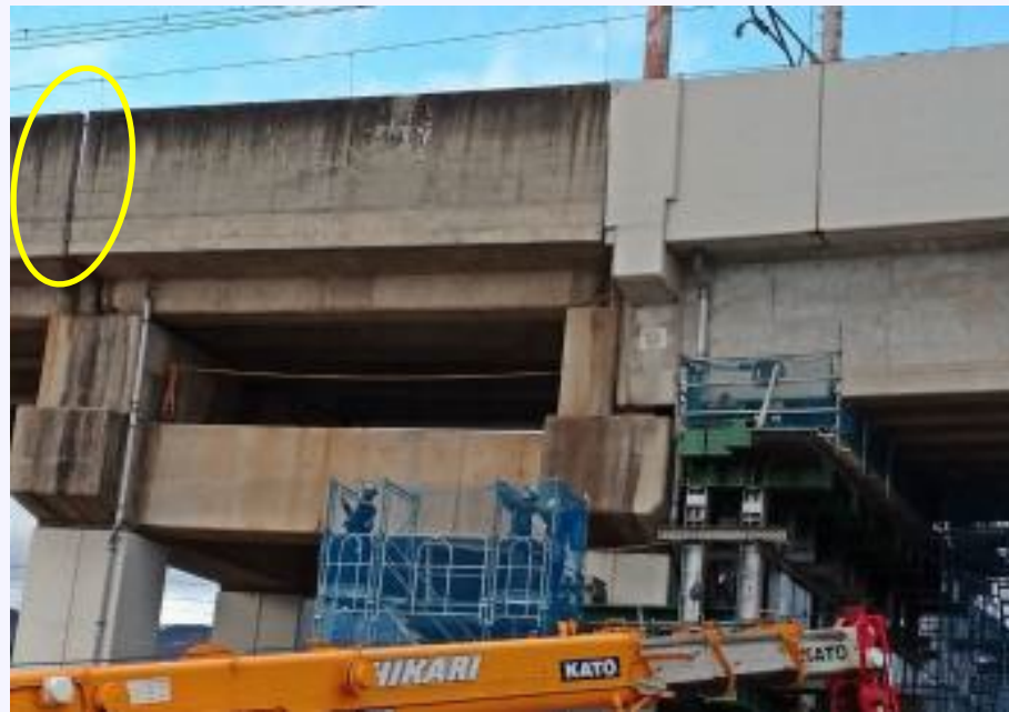
防音壁の開口（右側の橋脚が沈下したか）
