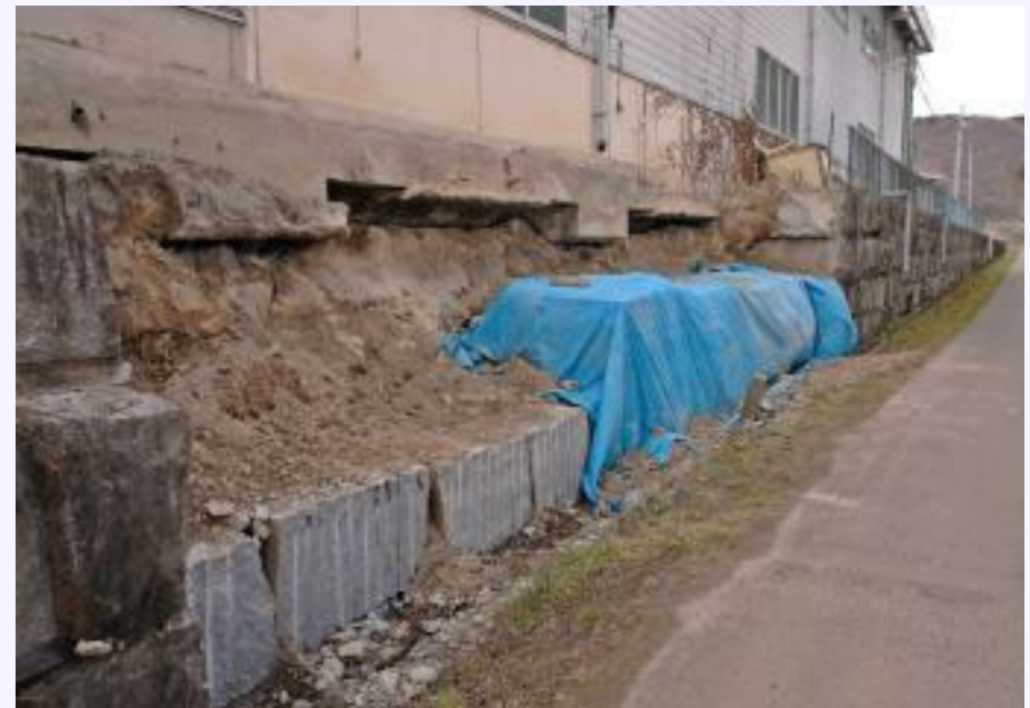
高架橋に隣接する建物の石積擁壁の崩壊
