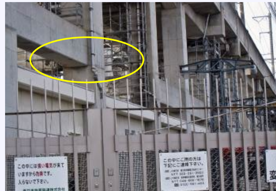
足場より垣間見える亀裂
