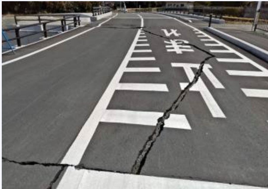
取付盛土の変状により生じた路面の亀裂
