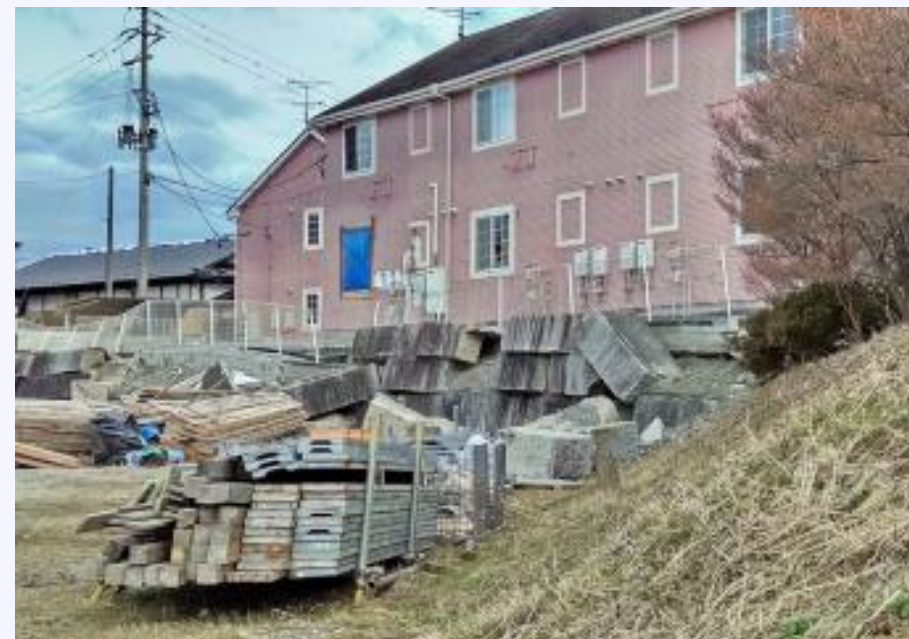
石積み擁壁の崩壊（相馬市尾浜B地点）
