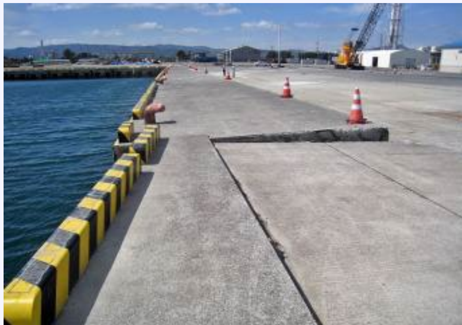
1号岸壁(-5.5m) のはらみ出しによる段差
