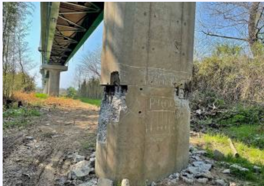
枝野橋P 9 橋脚の被害状況（1）
