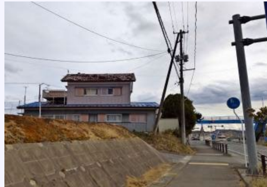
県道38号歩道橋近傍の家屋屋根瓦の破損（相馬市尾浜B地点）
