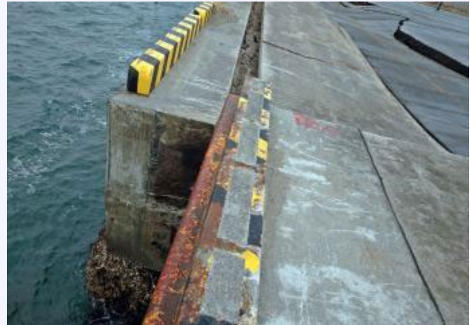
第2船溜まり(-4m)のはらみ出しの近景
