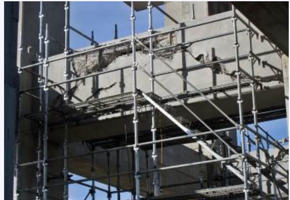
中層梁の斜め亀裂とコンクリート剥落
