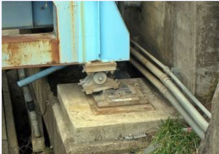
右岸橋台部の支承の脱落
