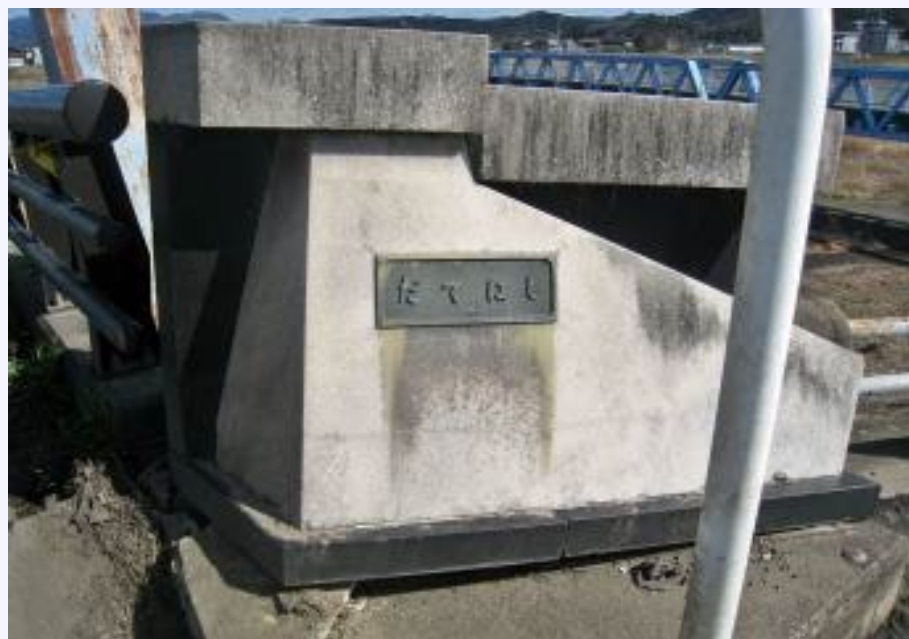
左岸橋台の親柱（基礎が橋桁に押され変形している）
