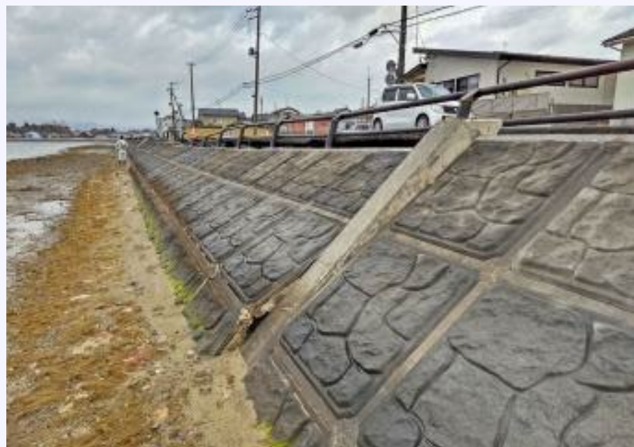
法面保護ブロックの浮き上がり(A地点)
