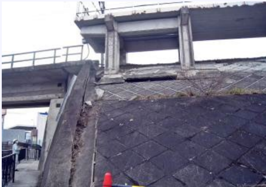
盛土被覆ブロックの変状
