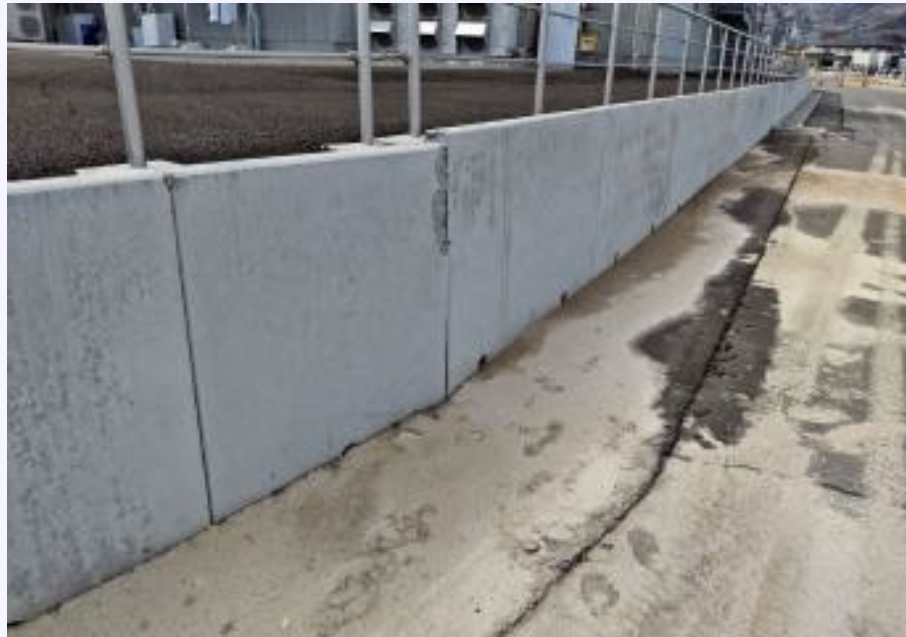
擁壁前面の亀裂から噴出した細粒の砂
