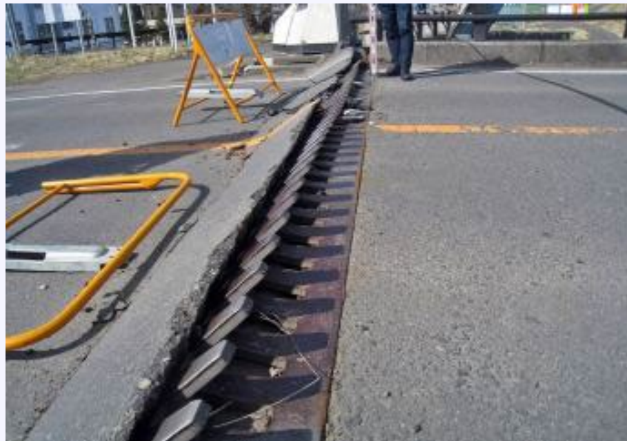
左岸（西側）橋台部の伸縮装置の浮き上がり
