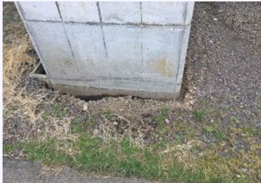
橋脚部周囲の空隙と地盤沈下
