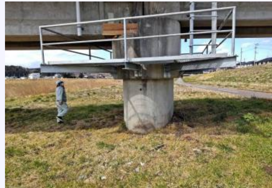
橋脚の応急復旧（詳細は不明）。手前に散らばったコンクリート塊が見える。
