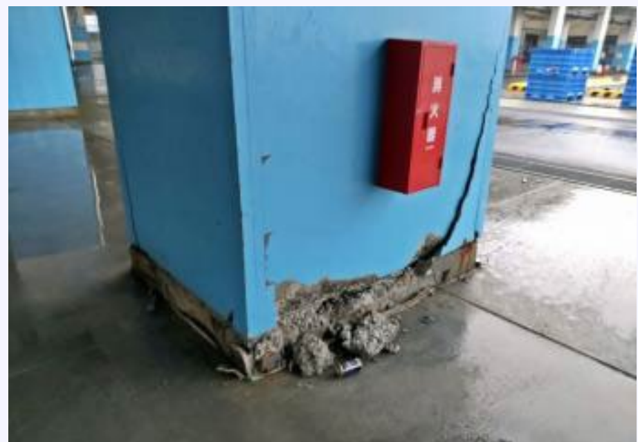
卸売市場の荷捌き場における柱の損傷
