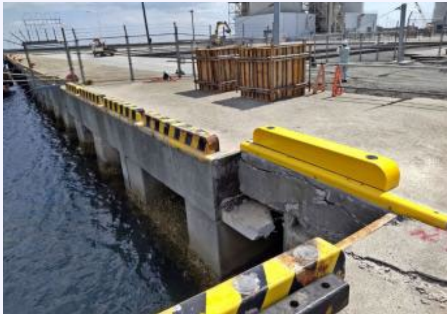
6号岸壁(-5.5m)付近に生じた亀裂
