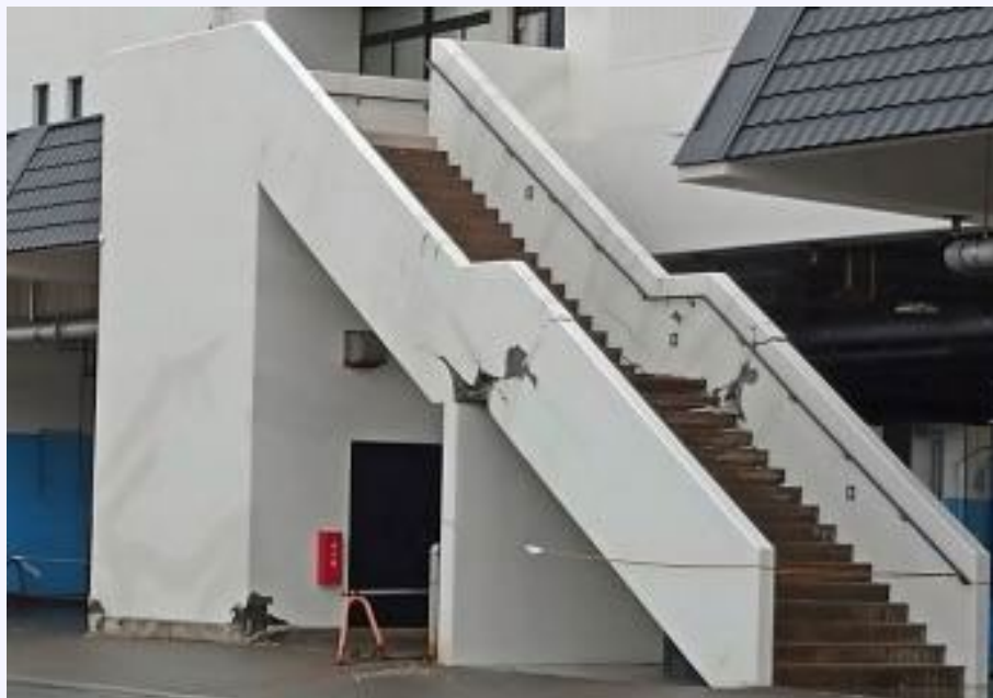
屋外階段の損傷
