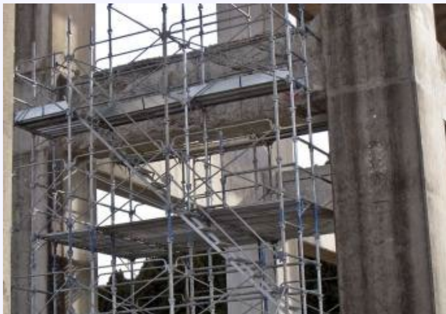
被害があった中層梁（表面のコンクリートはすでに落とされている）
