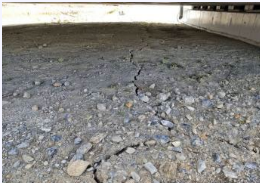
左岸橋台の前面地盤の亀裂
