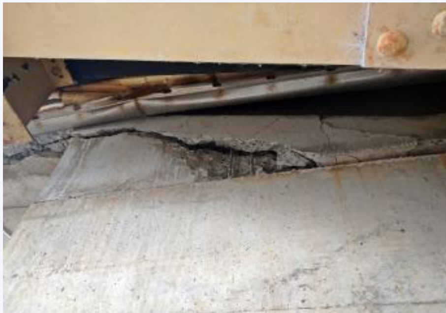
同上 橋台の鉛直面のコンクリート剥落
