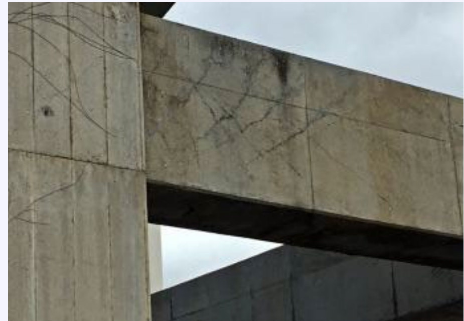
中層梁の斜め亀裂（古そうな感じを受ける）
