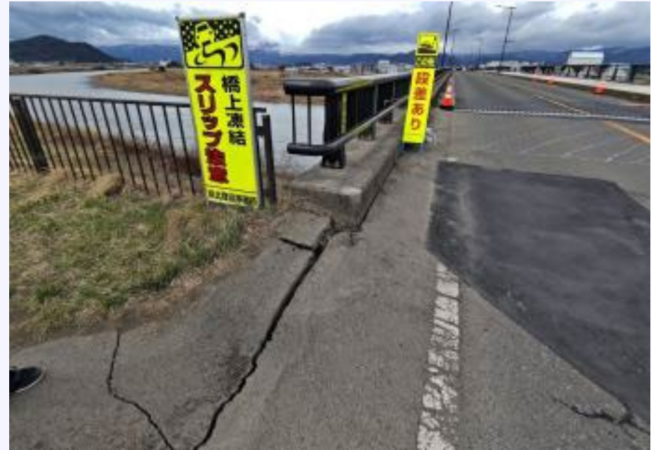
取付盛土の沈下に伴う亀裂
