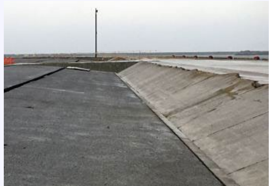
1号岸壁(-12m、耐震) のエプロン沈下
