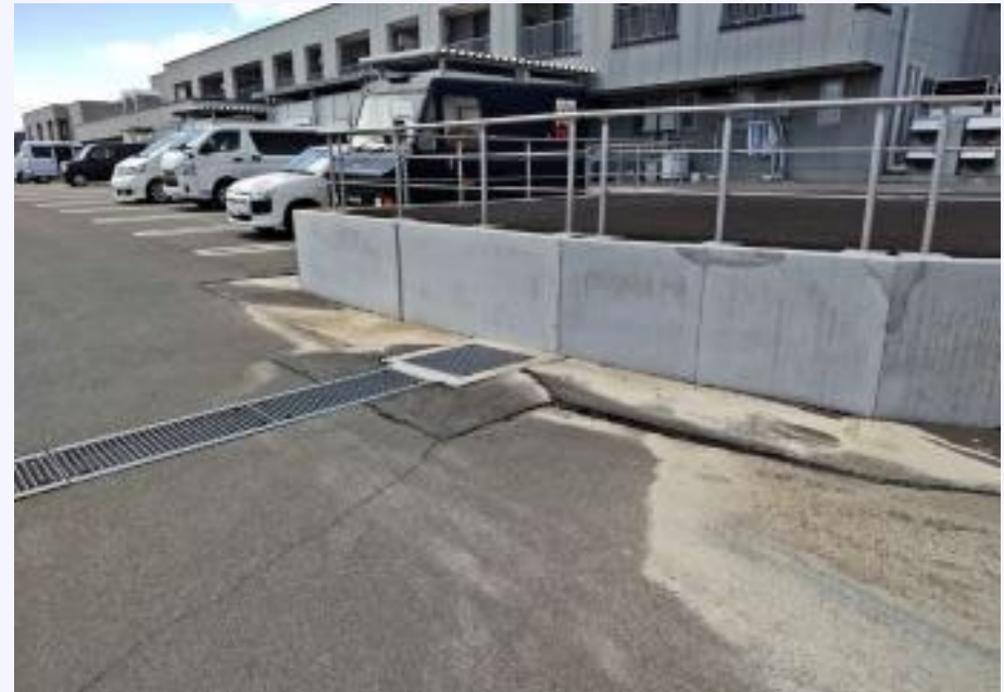
擁壁付近から噴出した細粒の砂。排水枡付近の地盤沈下は補修されているようである。
