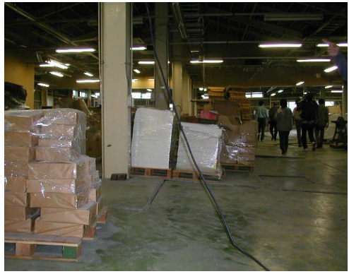
写真-4.4.13 工場内の床の陥没
