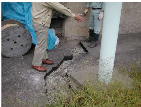
写真-4.5.4 揖屋干拓堤防排水機場の建屋非常階段基礎の変状
