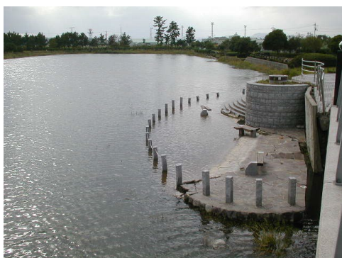
写真-4.5.14 さんとぴあ橋親水護岸の 低水敷の水没
