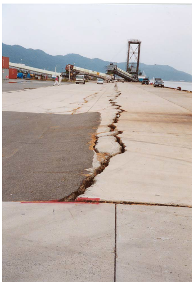
写真-4.3.8 背後地盤の沈下
