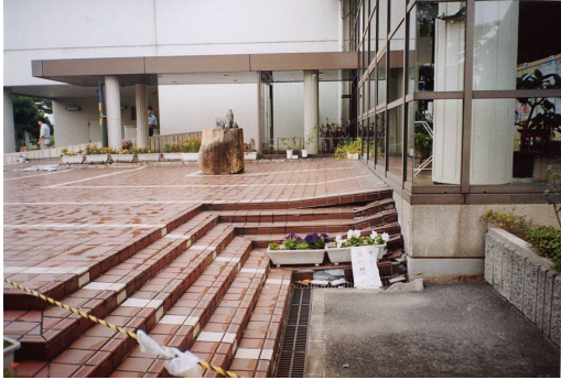
写真-4.2.2 建物との取り付け部の被害
