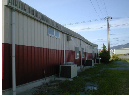
写真-4.4.11 工場建屋の不同沈下
