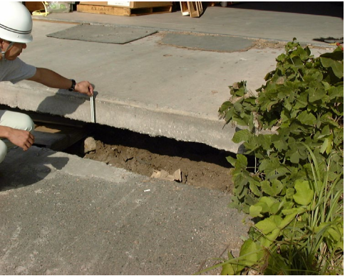
写真-4.4.12 倉庫基礎の隙間
