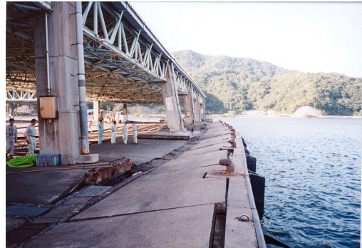
写真-4.3.4 前面にはらんだ岸壁
