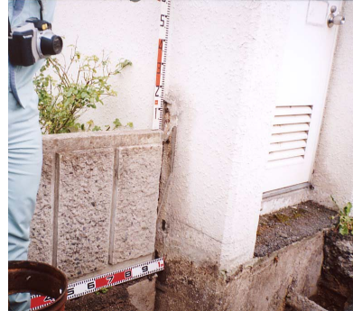
写真-4.2.3 塀と建物との間の隙間
