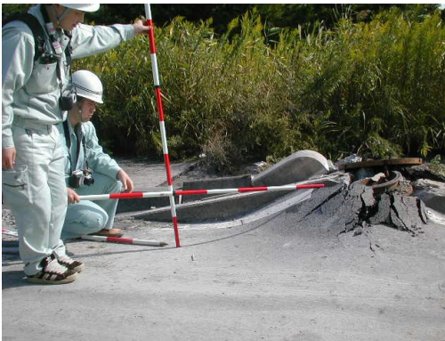
写真-4.4.2 団地南側入口道路におけるマンホールの隆起
