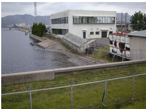
写真-4.5.9 境港側崩壊跡(北側)
