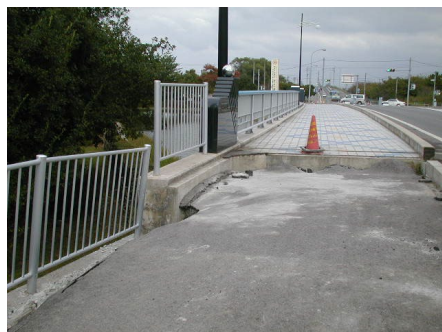
写真-4.5.15 さんとぴあ橋取付部の段差
