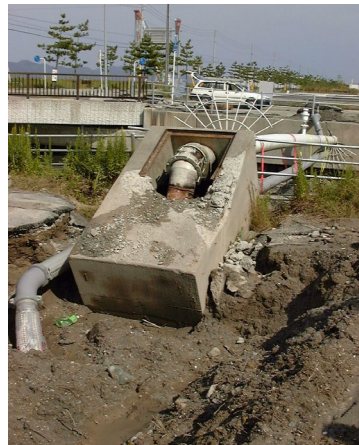
写真-4.4.9 水管橋橋台の破損
