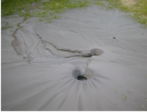
写真-4.4.10 工場敷地内の噴砂
