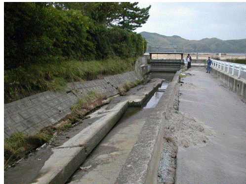
写真-4.2.14 団地東側水路の破損
