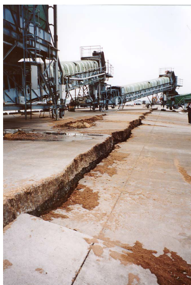
写真-4.3.9 大きな段差
