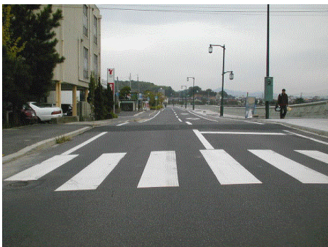
写真-4.3.11 背面道路の沈下 (手前がカルバートで、前後の地盤が沈下)
