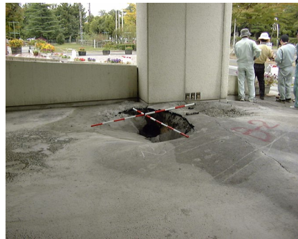
写真-4.2.5 柱の近くに生じた陥没穴
