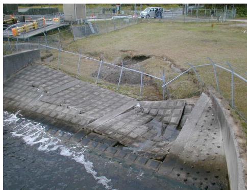
写真-4.5.10 境港側崩壊跡(南側)
