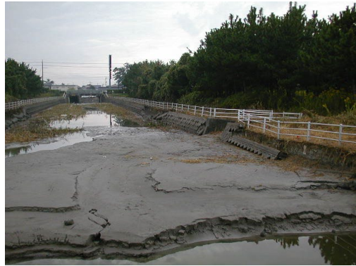
写真-4.4.7 水路と河川合流部の噴砂、護岸変状
