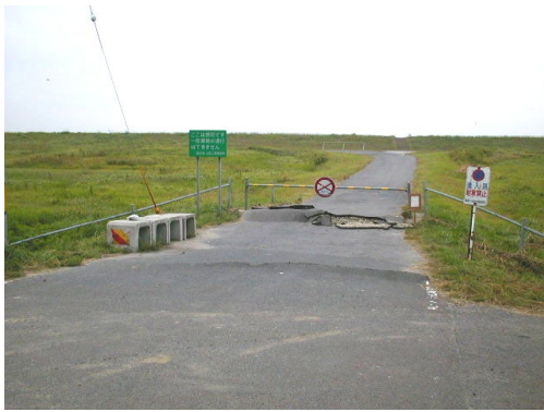
写真-4.5.5 アスファルトの捲れ上がり
