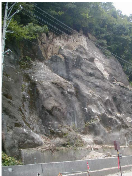
写真-4.6.5 日野町黒坂の吹付斜面の剥落
