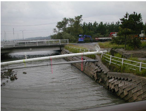
写真-4.4.8 水路の護岸破壊
