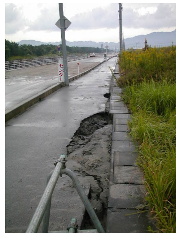
写真-4.4.5 団地内道路における歩道陥没(2)
