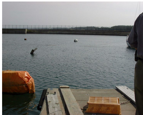
写真-4.4.16 桟橋の消失部
