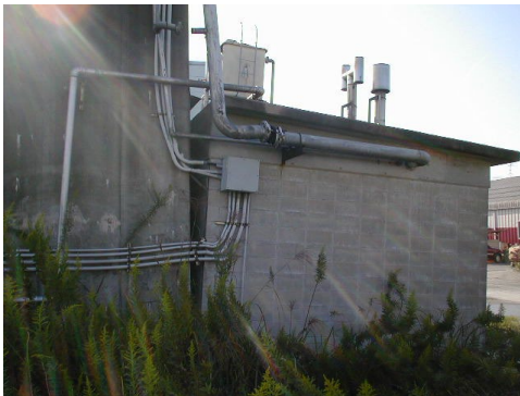
写真-4.4.14 小屋の傾斜
