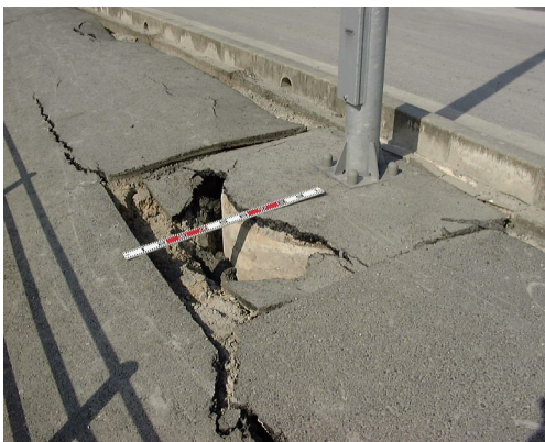
写真-4.4.4 団地内道路における歩道陥没(1)
