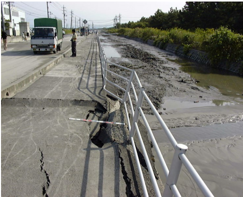
写真-4.4.6 水路の変状
