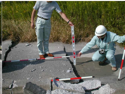
写真-4.4.3 団地南側入口道路における路面段差
