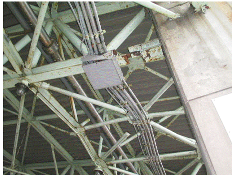
写真-4.3.5 上屋トラスの変形
