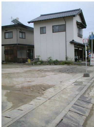
写真-4.2.17 住宅の傾斜 (左に 1.5^\circ 傾斜)
