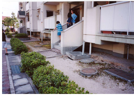
写真-4.2.12 階段取付部の破損
