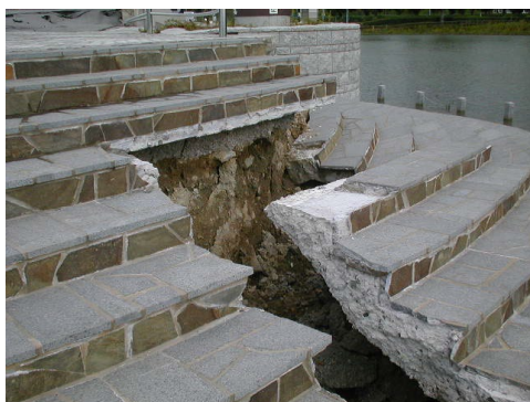
写真-4.5.13 さんとぴあ橋親水護岸の崩壊
