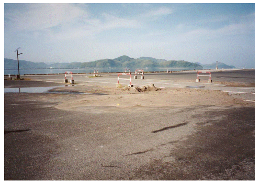
写真-4.3.3 護岸背後地盤の噴砂
