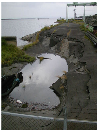
写真-4.5.11 江島側崩壊跡(南側)
