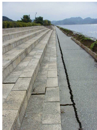
写真-4.2.7 護岸背後の変状*
