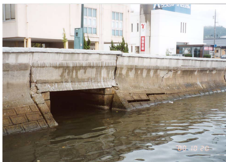
写真-4.3.10 カルバート取付け部の破損
