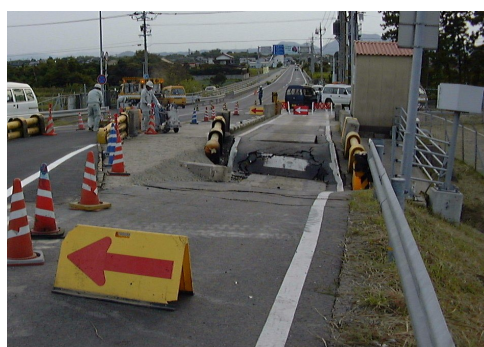
写真-4.5.12 水門道路陥没箇所
