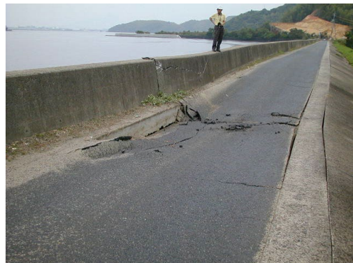
写真-4.5.8 堤防道路の陥没
