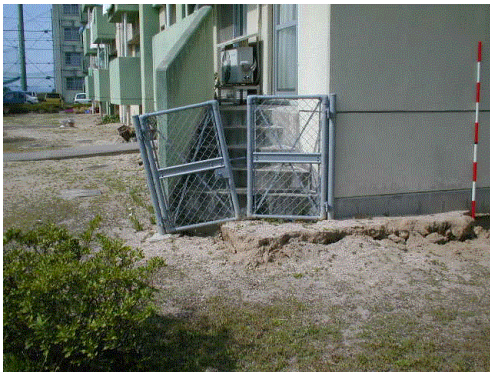
写真-4.2.13 建物脇の扉の破損
