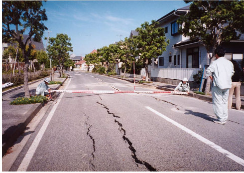
写真-4.2.9 道路に発生したクラック
