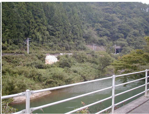
写真-4.6.2 JR 伯備線トンネル坑付近の 斜面崩壊
