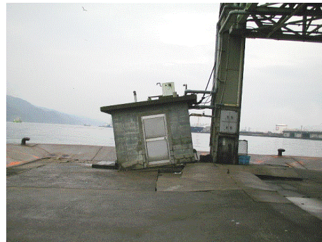
写真-4.3.6 隣接する小屋の傾斜
