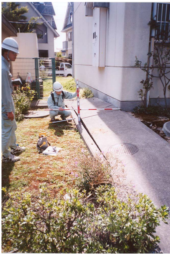
写真-4.2.11 建物脇通路の破損
