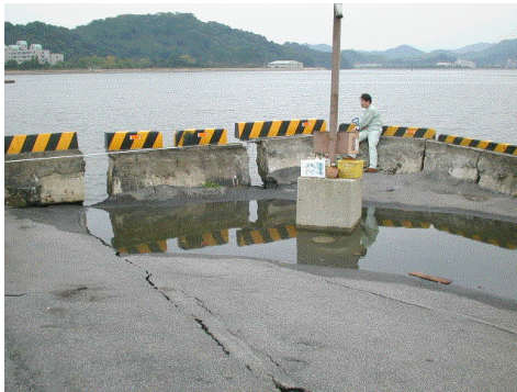
写真-4.3.2 背後地盤の沈下と岸壁の破損
