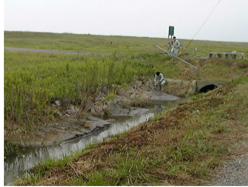
写真-4.5.6 水路内の噴砂
