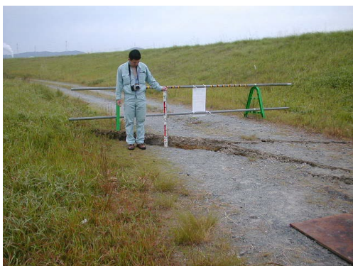
写真-4.5.3 揖屋干拓堤防排水機場の堤防亀裂(西側)
