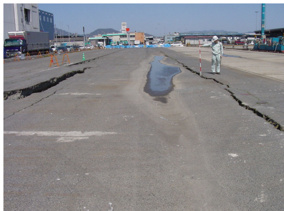
写真-3.9 沈下箇所の全景
