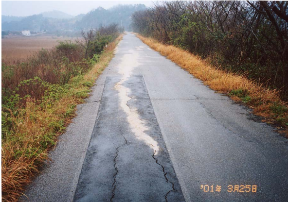
写真-3.27 悪水溜堤防に生じたクラック 堤防天端路面の亀裂
