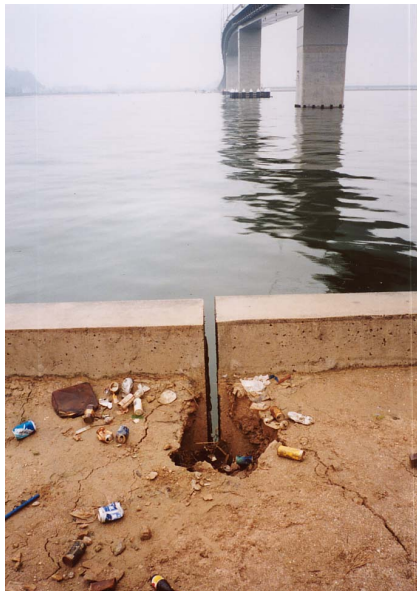
写真-3.4 吸出しによる 背面地盤の陥没
