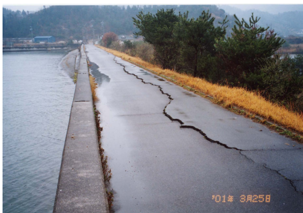
写真-3.25 干拓堤防に発生したクラック 堤防天端路面に、ほぼ全線に渡って 縦方向の亀裂が発生。 (もともと小規模なクラックは存在していた)
