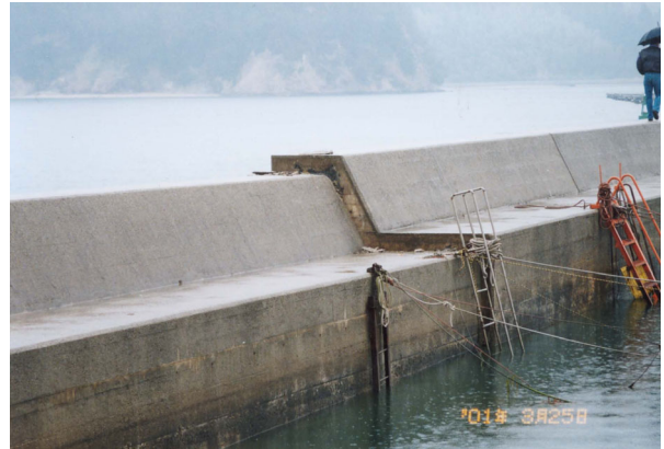
写真-3.28 防波堤の前面移動と沈下 接触面でコンクリートが剥離 (防波堤天端高はもともと10cm低い設計である)
