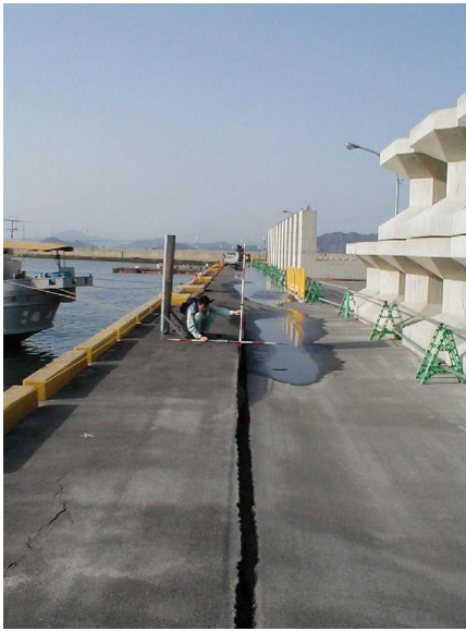
写真-3.32 天保山2丁目埠頭 護岸背後が陥没した。
