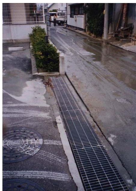
写真-3.21 路面と U 字側溝に生じた段差
