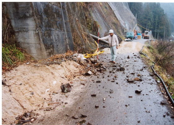
写真-3.23 斜面崩壊 (A地点) 未対策区間よりφ10~40mmの落石が 多数生じている
