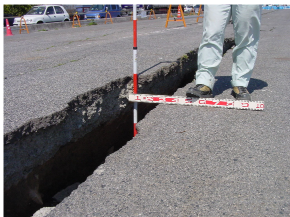
写真-3.11 背面に生じたクラック
