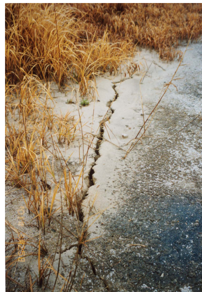
写真-3.26 干拓堤防内地盤の亀裂 と噴砂
