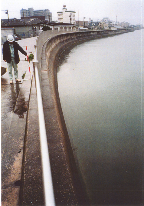
写真-3.13 護岸接合部の開口
