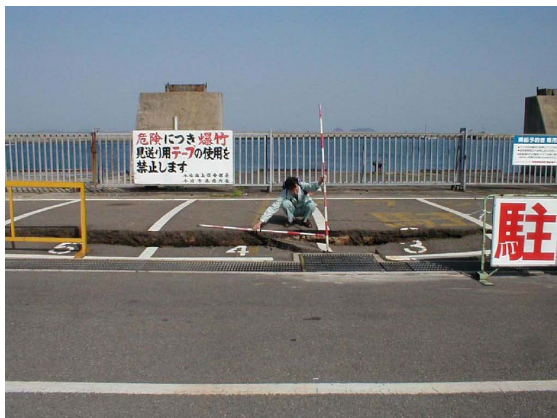
写真-3.30 フェリー乗場集水溝沿いに生じた段差。護岸背後地盤が沈下している。
