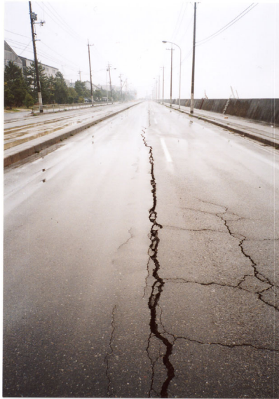
写真-3.1 護岸に平行に発生したクラック 発生したクラック (写真右手が護岸)
