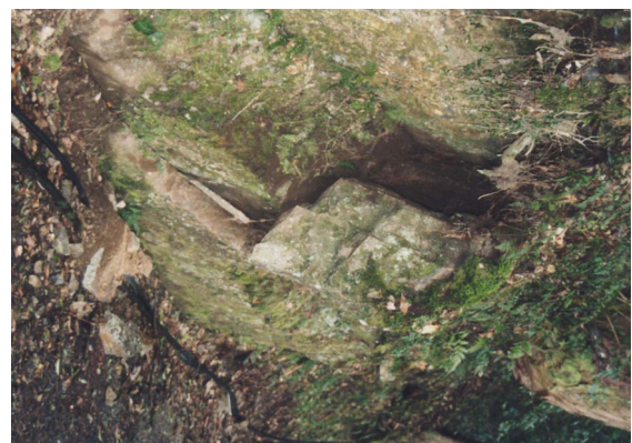
写真-3.24 道路沿い岩塊の 開口亀裂 (B地点)
