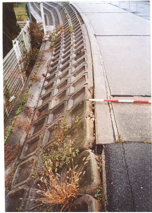
写真-3.14 堤内側のり肩空洞
