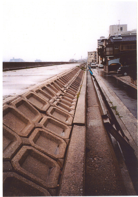
写真-3.15 堤内側のり肩空洞化陥没
