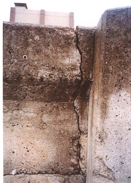
写真-3.7 樋門門柱部に生じた クラック
