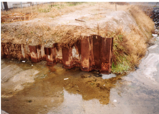
写真-3.6 樋門西側の潮廻し 右側矢板根元に噴砂
