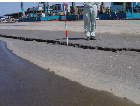
写真-3.10 背面に生じた 10cm 程度の段差
