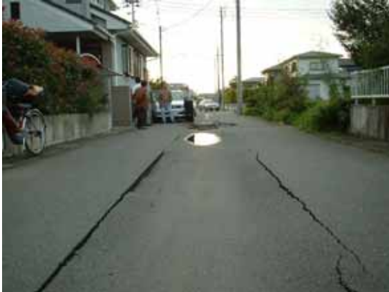
写真-4.5.15 下水管周辺の地盤沈下
