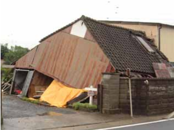
写真-4.2.2 家屋の被災状況 (国道 108 号沿い)
