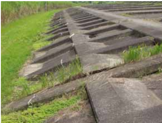
写真-4.4.18 鳴瀬川右岸 14.8km 堤外側法尻付近の護岸コンクリートに 生じた亀裂
