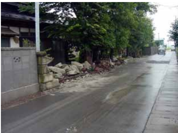
写真-4.2.6 石塀の倒壊
