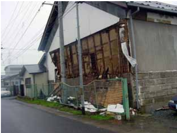
写真-4.2.5 外壁が剥落した倉庫
