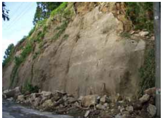
写真-4.5.14 小野橋付近の崖崩れ (吹付け5cm)
