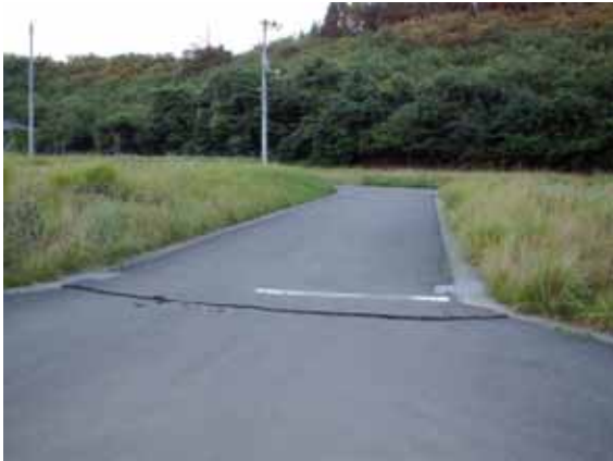
写真-4.6.5 宅造地内の道路の亀裂 (矢本グリーンタウン)
