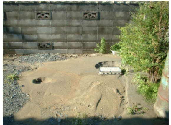
写真-4.7.6 民家敷地内の噴砂
