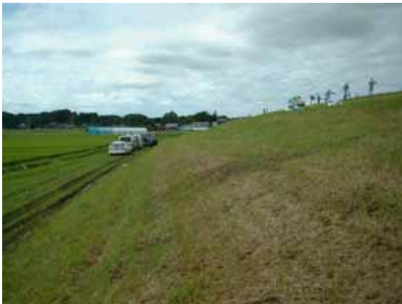
写真-4.4.15 鳴瀬川右岸 14.8km 堤内側法尻付近のはらみ出し
