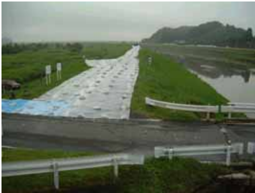
写真-4.5.11 鳴瀬川と吉田川を分かち背割り り堤の被害
