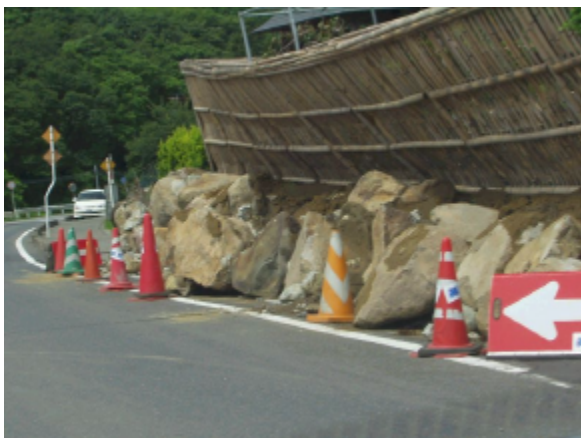
写真-4.3.26 石積み塀の崩壊
