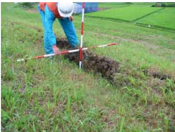
写真-4.4.22 鳴瀬川右岸 14.9km 付近 亀裂による段差が約 40cm
