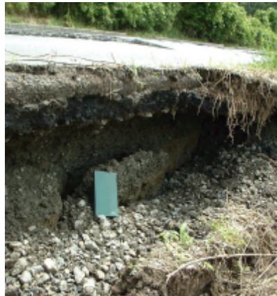
写真-4.3.15 道路端の陥没部 約45cm沈下
