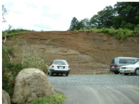
写真-4.3.6 崩壊した斜面の対面の切土斜面
