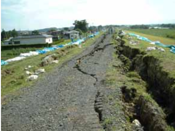
写真-4.4.23 鳴瀬川左岸 13.4km 堤内側天端付近の沈下と亀裂
