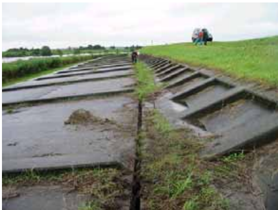
写真-4.4.21 鳴瀬川右岸 14.9km 付近 護岸に亀裂 (下流を望む)
