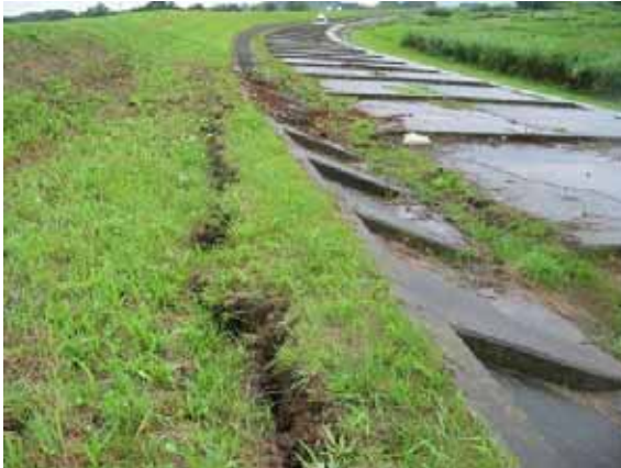
写真-4.4.20 鳴瀬川右岸 14.9km 付近 川表護岸上部に亀裂 (上流を望む)
