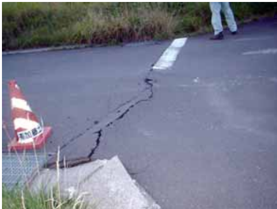
写真-4.6.6 宅造地内の道路の亀裂 (矢本グリーンタウン)
