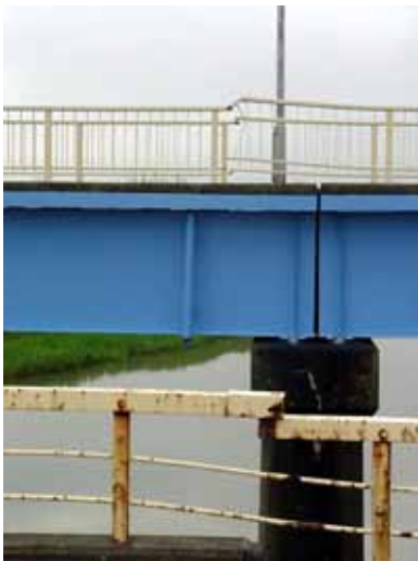
写真-4.5.8 小野橋と並行する歩道橋の欄干 地震中に一度抜けて再び元に戻ろうとした ような挙動が見られる
