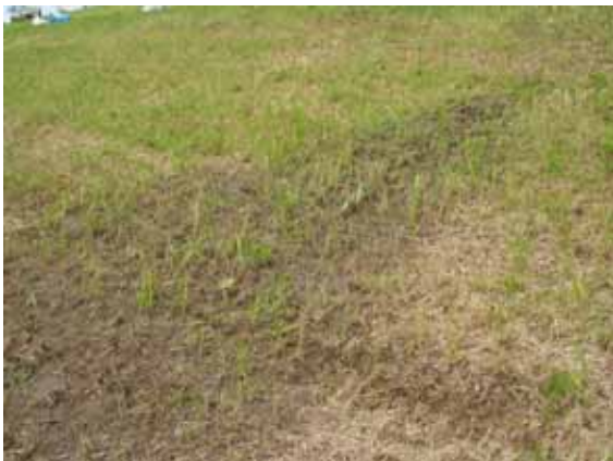
写真-4.4.16 鳴瀬川右岸 14.8km 堤内側法面からの染み出し
