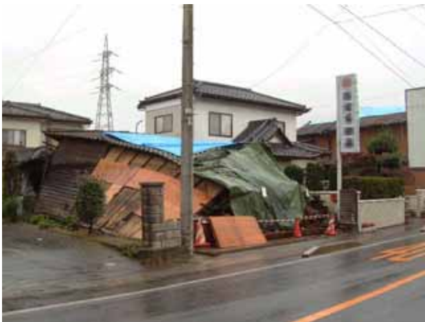
写真-4.2.3 全壊した店舗
