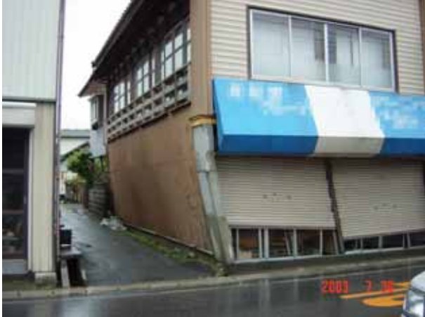
写真-4.2.4 店舗一階部分のせん断変形
