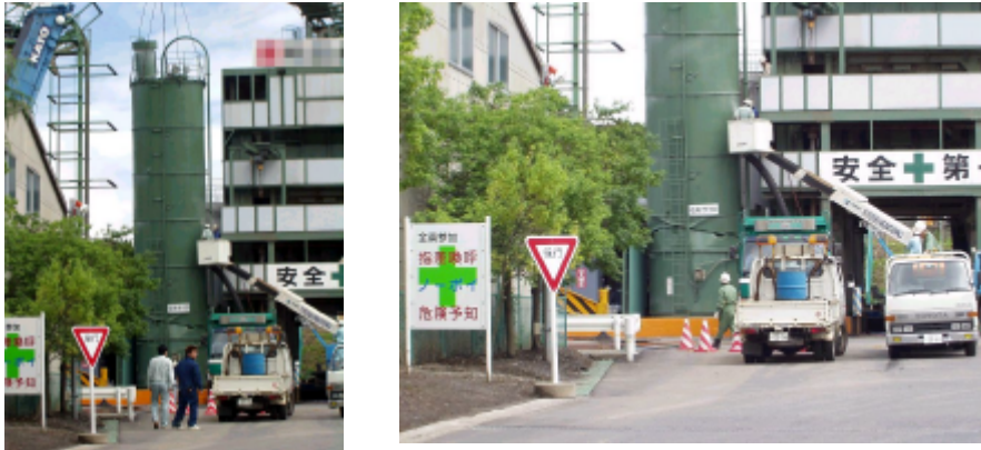
写真-4.3.17 座屈した石粉サイロ
