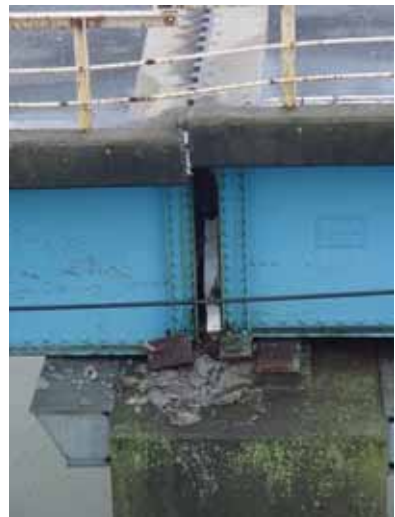
写真-4.5.3 小野橋（鳴瀬川） 支承が破壊して橋桁が支承からずれ落ちる
