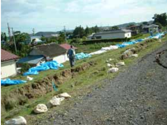
写真-4.4.26 鳴瀬川左岸 13.4km 法面の亀裂
