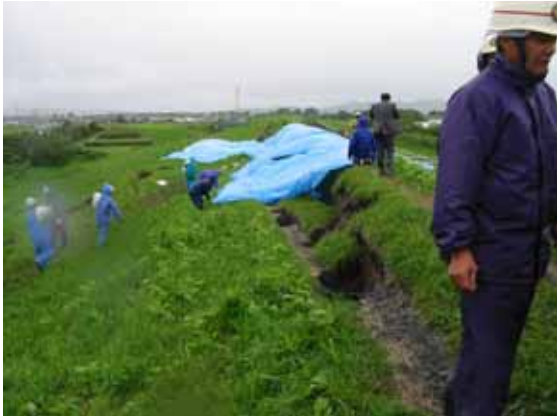
写真-4.4.2 鳴瀬川右岸 13.0km 付近 下流から崩壊部を望む
