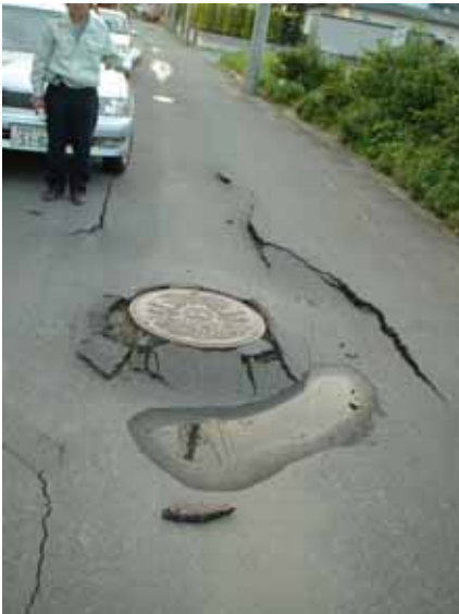
写真-4.5.16 下水管周辺の地盤沈下
