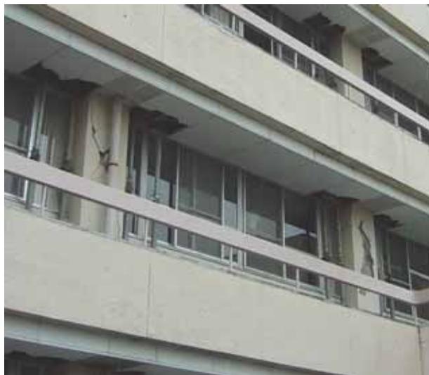
写真-4.2.8 公立深谷病院西棟 柱のせん断亀裂
