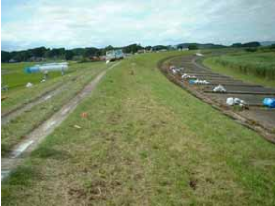
写真-4.4.17 鳴瀬川右岸 14.8km 堤外側天端付近の沈下と亀裂
