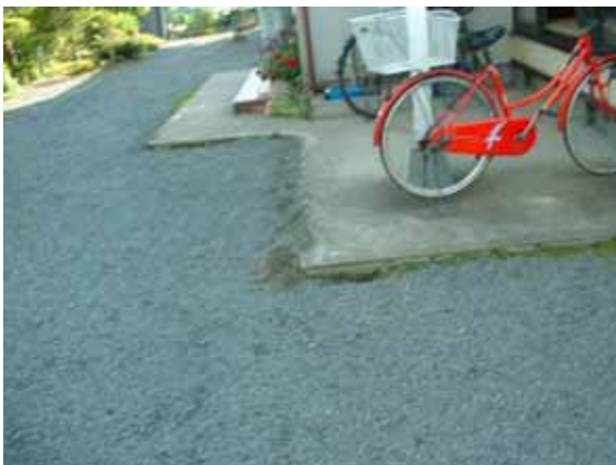
写真-4.4.28 鳴瀬川左岸 13.4km 堤防法尻 土間コンクリート前面の盛上がり
