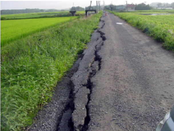
写真-4.7.10 付近の様子 農道に生じたクラック 農道の左側が水路
