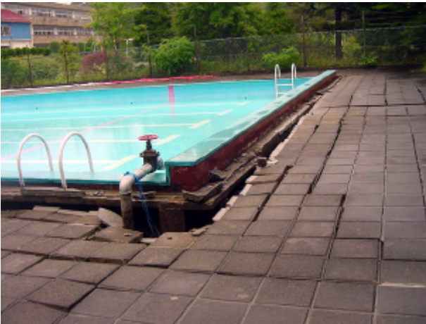
写真-4.3.22 校庭横のプールの 被害
