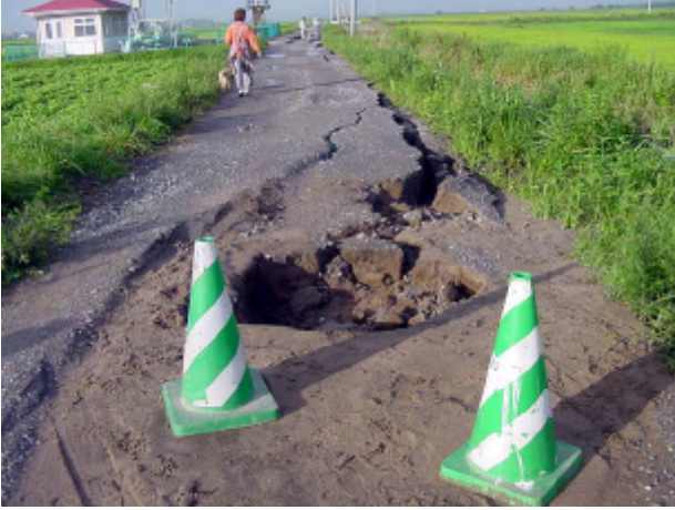
写真-4.7.12 農道の陥没
