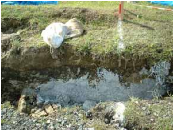
写真-4.4.25 鳴瀬川左岸 13.4km 天端の沈下
