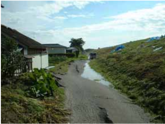
写真-4.4.27 鳴瀬川左岸 13.4km 堤内側法尻の盛上がり
