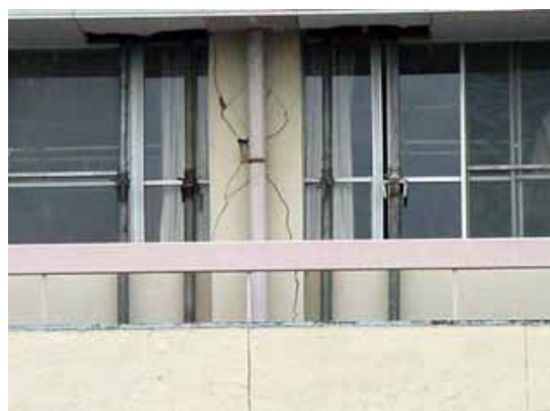
写真-4.2.9 公立深谷病院西棟 柱のせん断亀裂
