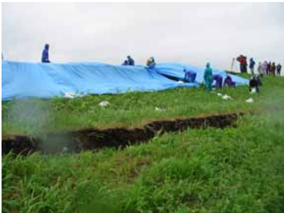
写真-4.4.3 鳴瀬川右岸 13.0km 付近 川裏法面中腹から崩壊部を望む
