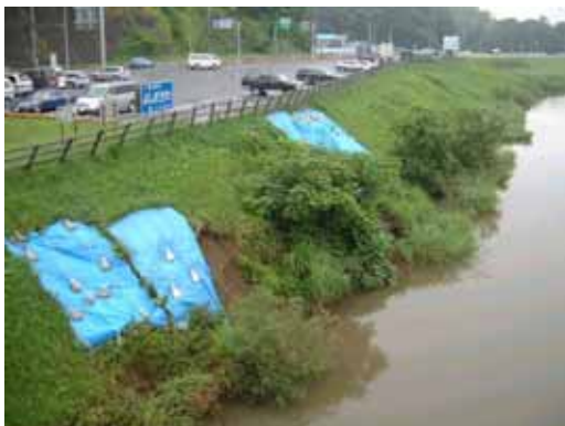
写真-4.5.13 西小野橋(吉田川)右岸堤防 のり面の一部がすべって手摺が傾いている
