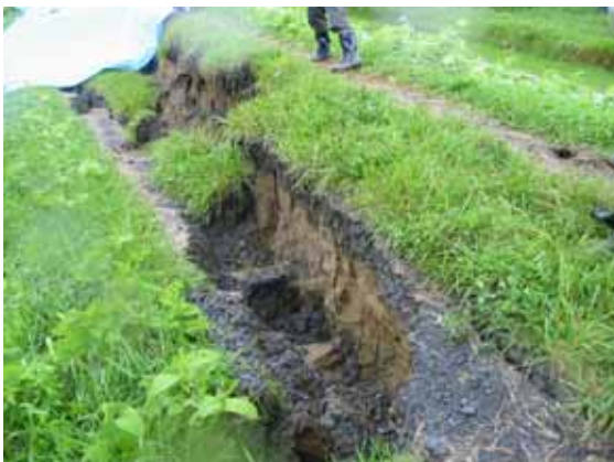
写真-4.4.4 鳴瀬川右岸 13.0km 付近 川裏法面付近のクラックの近景
