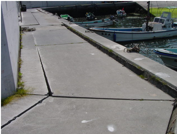
写真-4.1.21 護岸背後地盤の 沈下 (左側は防潮堤)
