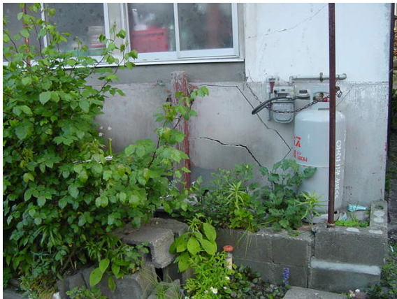
写真-4.1.18 公園近隣の家屋壁の亀裂
