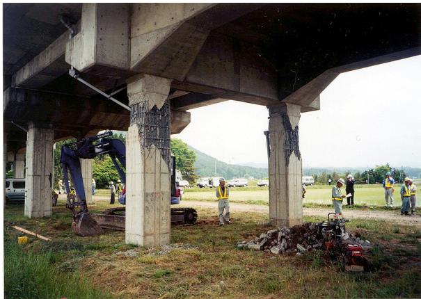
写真-4.3.3 被害状況(下り面)
