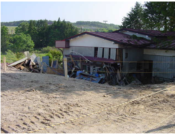
写真-4.2.6 崩壊土砂のため一部損壊した家屋
