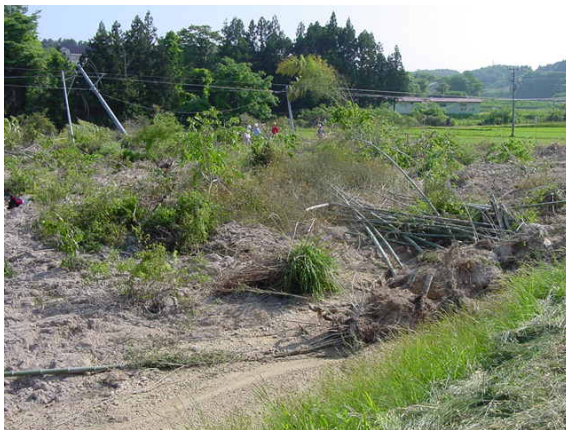
写真-4.2.9 崩壊した土砂のために電柱が大きく傾いた
