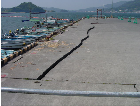
写真-4.1.20 -2m 岸壁背後の亀裂 (幅 7～15cm) ・段差 (3～6cm)
