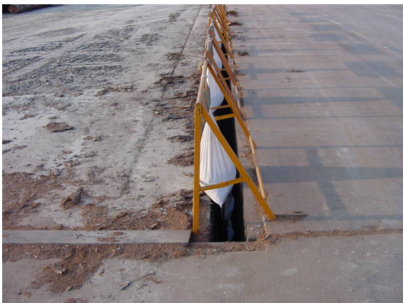
写真-4.1.10 -7.5m 岸壁背後の覆工板の落下
