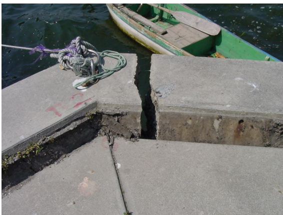
写真-4.1.22 護岸隅角部の亀裂・ 開口
