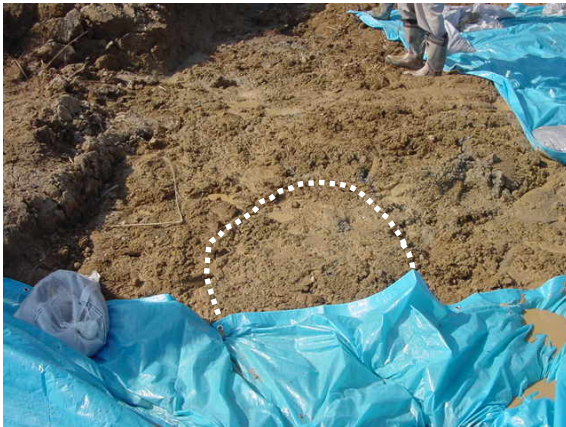
写真-4.2.7 水を含んで泥濁化した土砂
