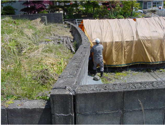
写真-4.1.27 ブロック壁の土留壁 の変状
