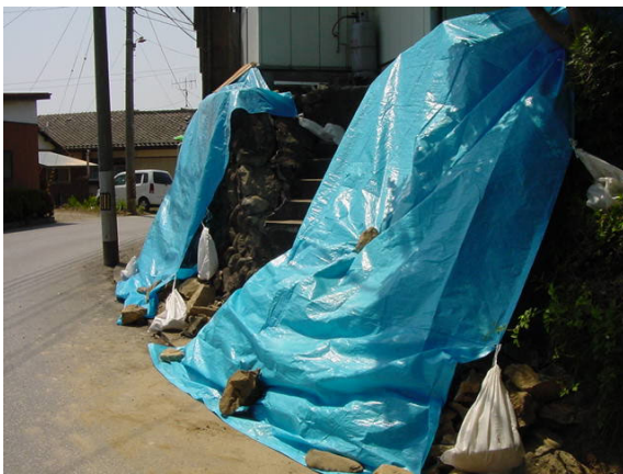
写真-4.1.24 石積擁壁の被害
