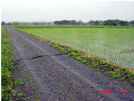
写真-4.4.2 亀裂(農道部)写真
