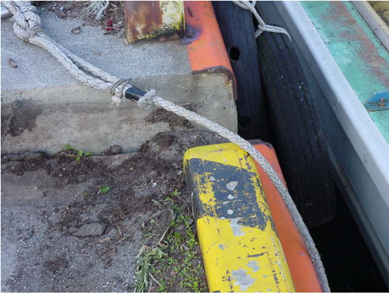
写真-4.1.11 岸壁のはらみ出しと沈下
