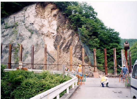
写真-4.4.6 斜面崩壊状況(南側から撮影)
