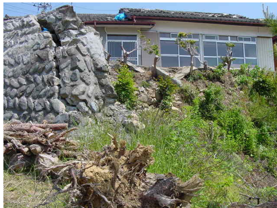
写真-4.1.25 石積擁壁の被害
