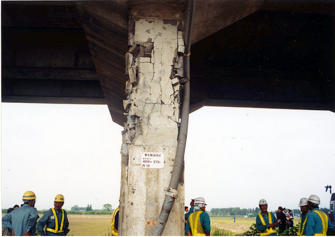
写真-4.3.5 被害状況(側面)
