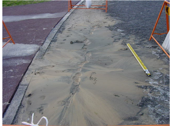
写真-4.1.17 公園内で噴砂（2）
