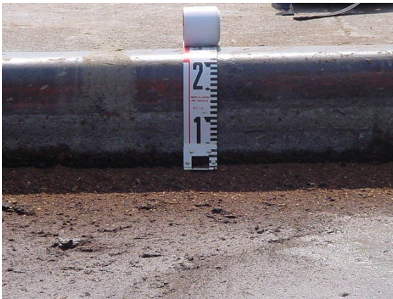
写真-4.1.7 同上 エプロンの段差 近景
