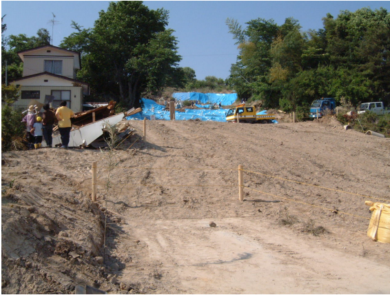
写真-4.2.5 崩壊斜面を下の道路より見る
