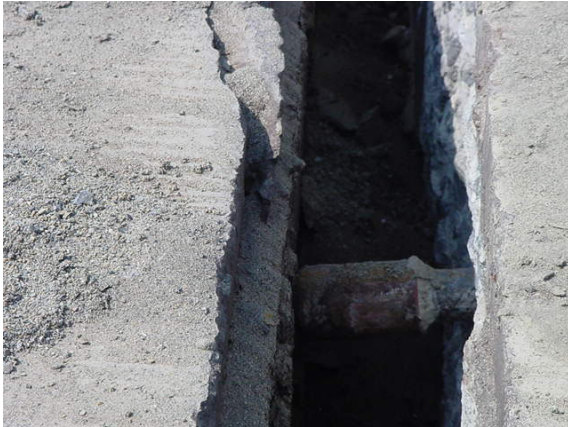
写真-4.1.9 開口したコンクリート打継部
