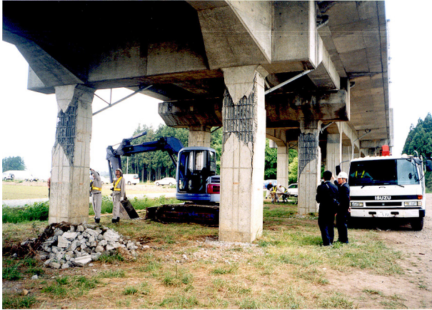
写真-4.3.2 被害状況(上り面)
