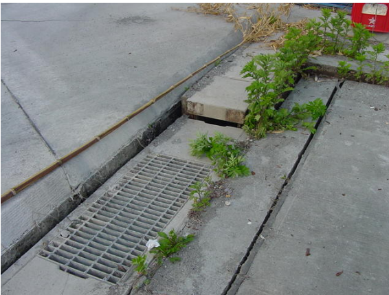
写真-4.1.12 岸壁背後のU字溝の沈下
