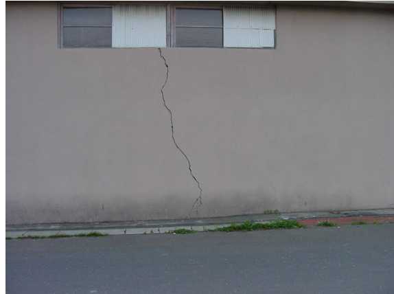
写真-4.1.19 公園近隣の倉庫壁の亀裂
