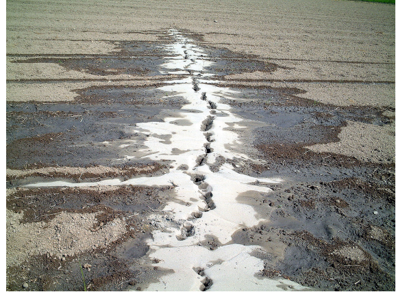
写真-4.4.5 亀裂および噴砂跡(近景)
