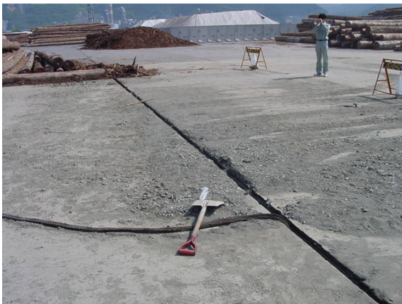
写真-4.1.8 岸壁背後地盤の液状化に より噴出した砂・小礫
