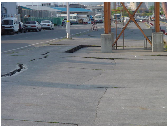
写真-4.1.4 岸壁背後コンクリートの 段差
