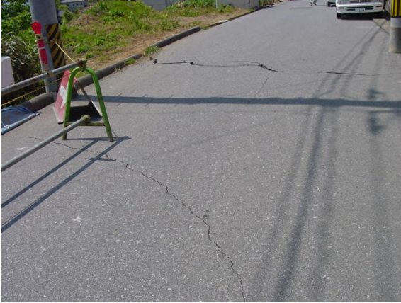
写真-4.1.26 道路に生じた横断亀裂 (亀裂は斜面まで続いている)
