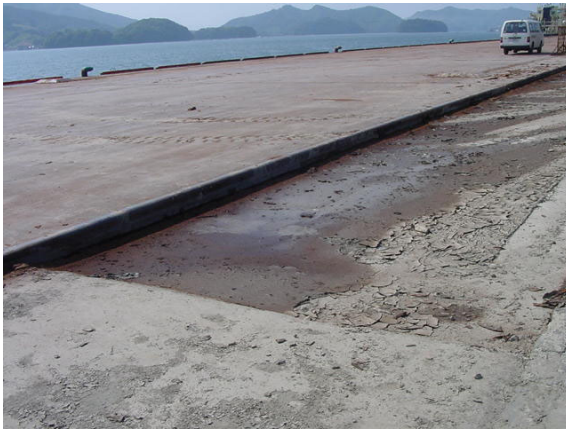
写真-4.1.6 -13m 岸壁エプロンの 段差泥状の噴出物
