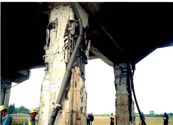
写真-4.3.4 被害状況(側面)
