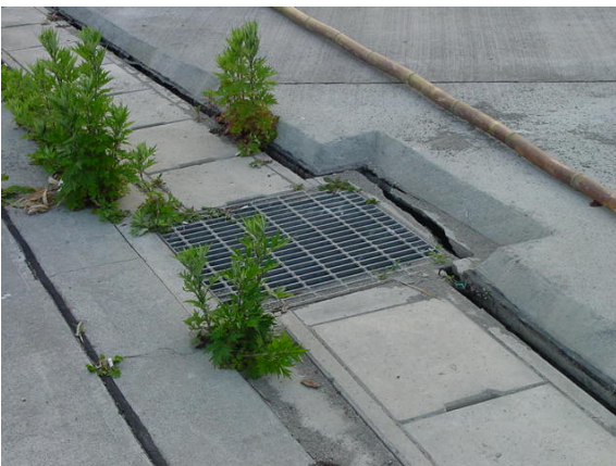
写真-4.1.13 岸壁背後のU字溝の沈下と移動
