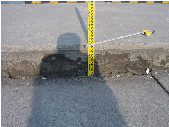
写真-4.1.3 岸壁背後コンクリートの 段差
