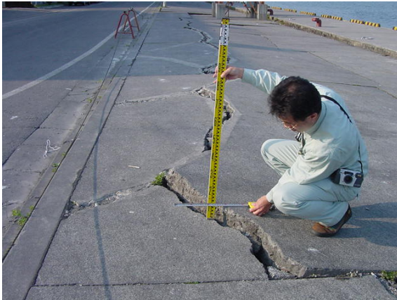
写真-4.1.2 岸壁背後の段差と コンクリートの亀裂
