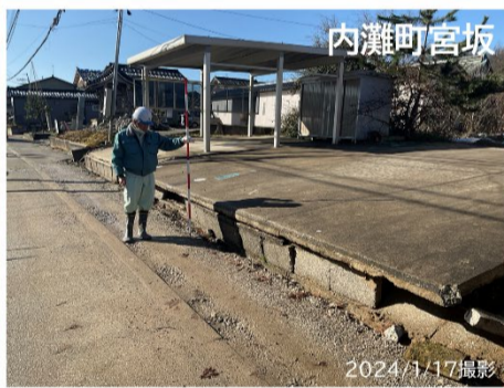
住宅地で段差が発生している
