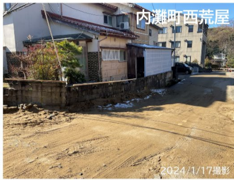
噴砂、段差が発生している
