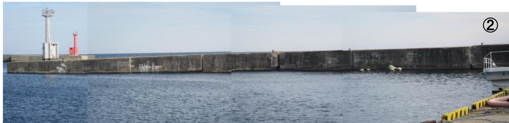
防波堤ブロックの陸側への移動（津波被害？）
