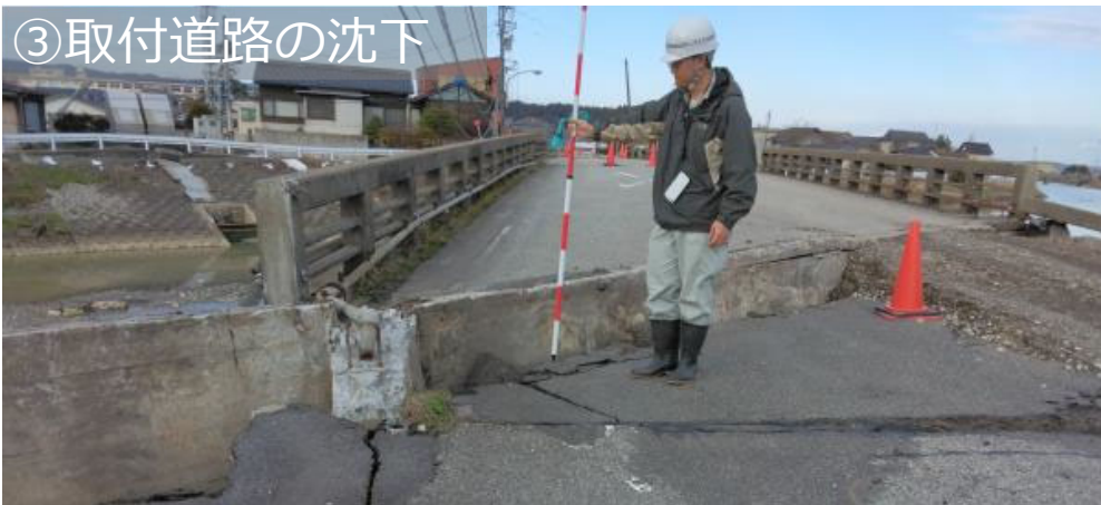
②堤防の亀裂、沈下
