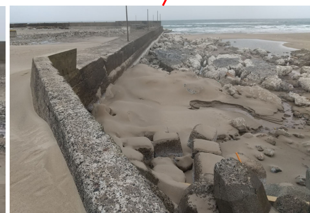
③防波堤（地盤の隆起）
