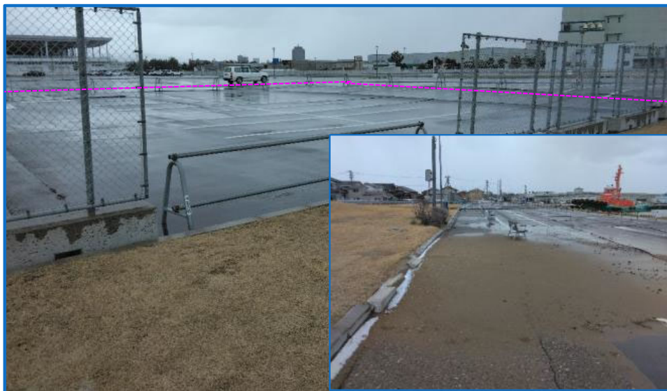
駐車場（路面）の沈下、噴砂
