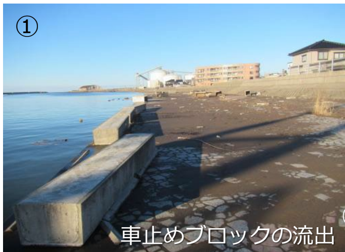
関川 河口右岸付近の津波被害
