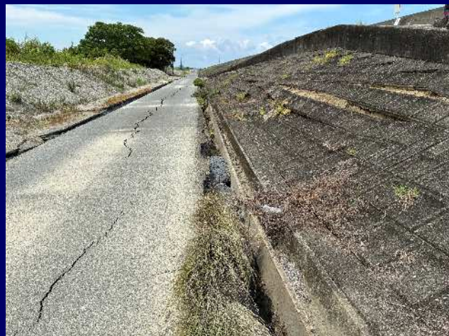
① 法面はらみだし
