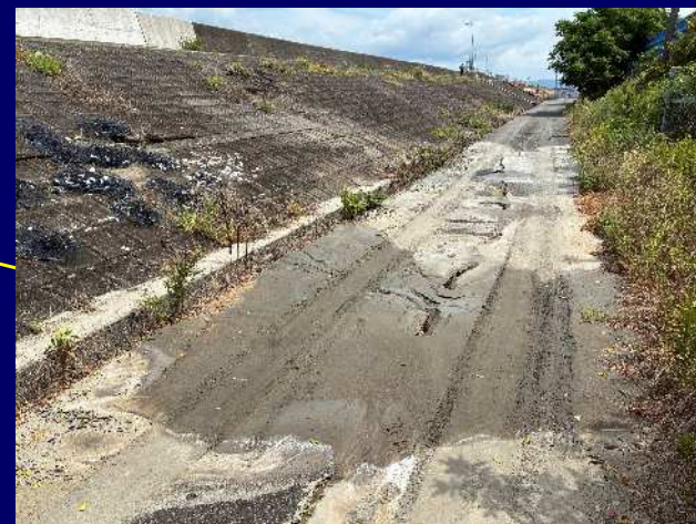
② 法面はらみだし・噴砂
