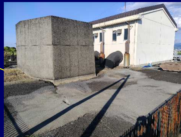
④ 排水機場内の噴砂
