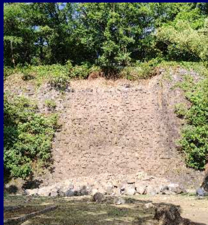
② 櫓方櫓跡付近の石垣の崩壊
