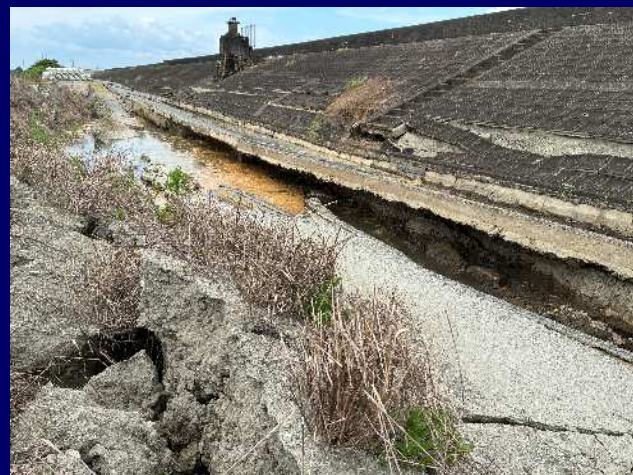
③ 法面はらみだし・法尻沈下
