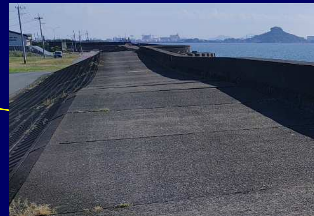
② 堤防天端の沈下
