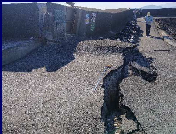
③ 樋門接続部の亀裂・段差
