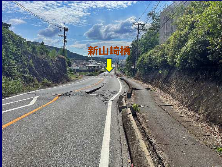
②-1 新山崎橋西側の道路右横ずれ
