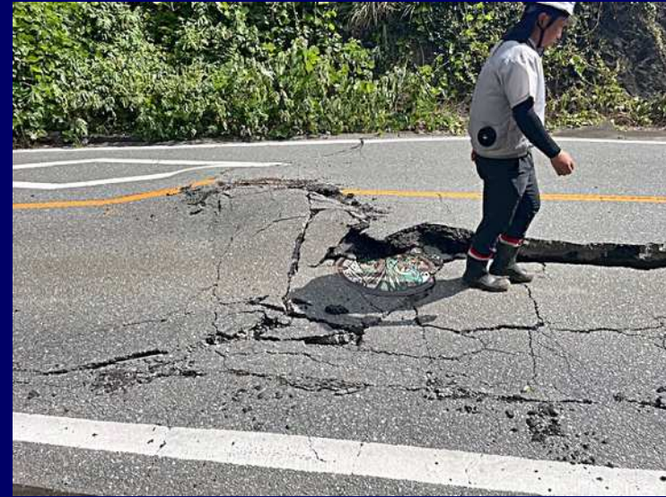
②-2 新山崎橋西側のマンホール突出
