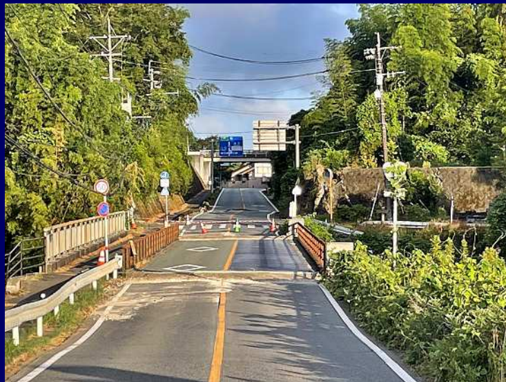
②-3 新山崎橋東側橋台部（手前）の段差
