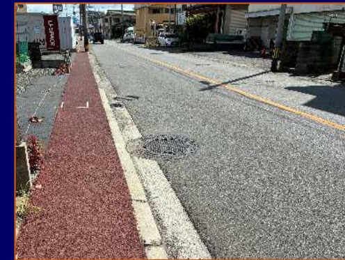
マンホールポンプ
