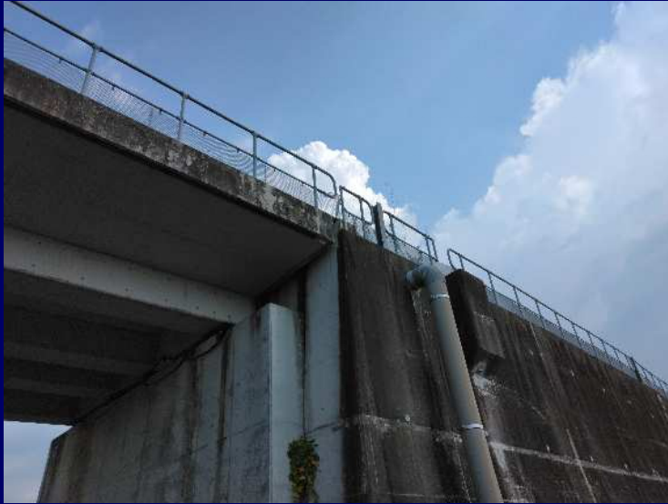
③ 高架支承部の損傷
