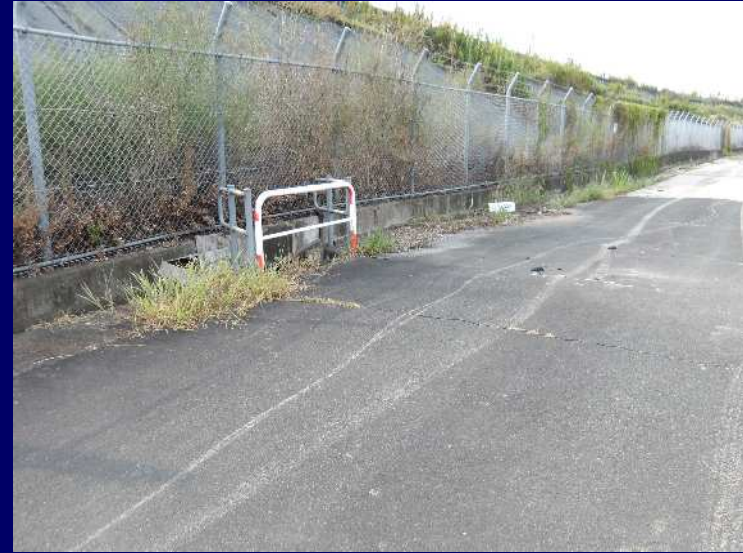
④ 側道を横断する埋設管の隆起と周辺沈下
