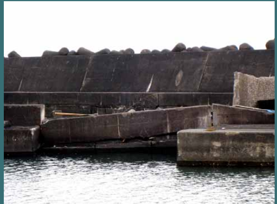
防波堤の側のコンクリートブロック(役割 不明)が一部沈下しているように見える
