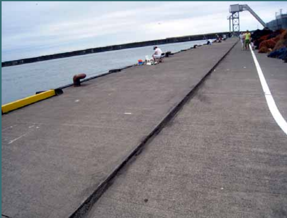
岸壁エプロンの沈下
