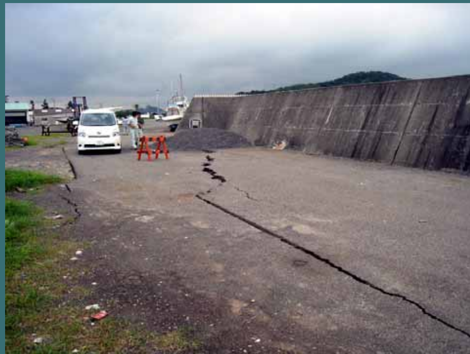
護岸背後地盤の沈下・亀裂
