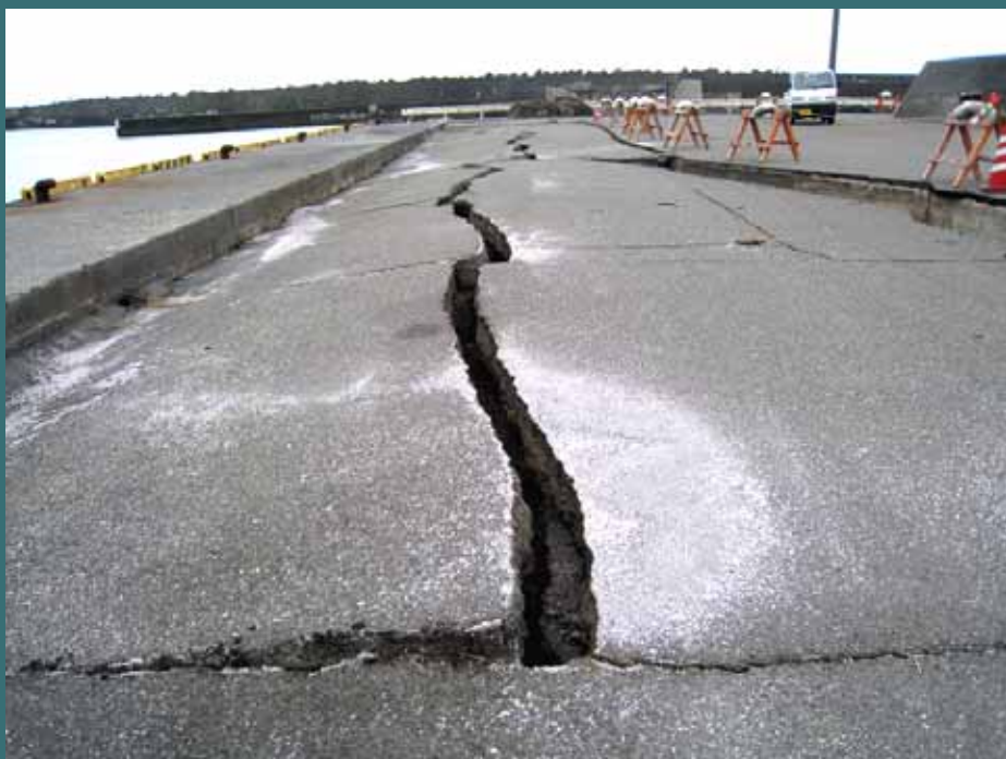
エプロンの亀裂・陥没の近景
