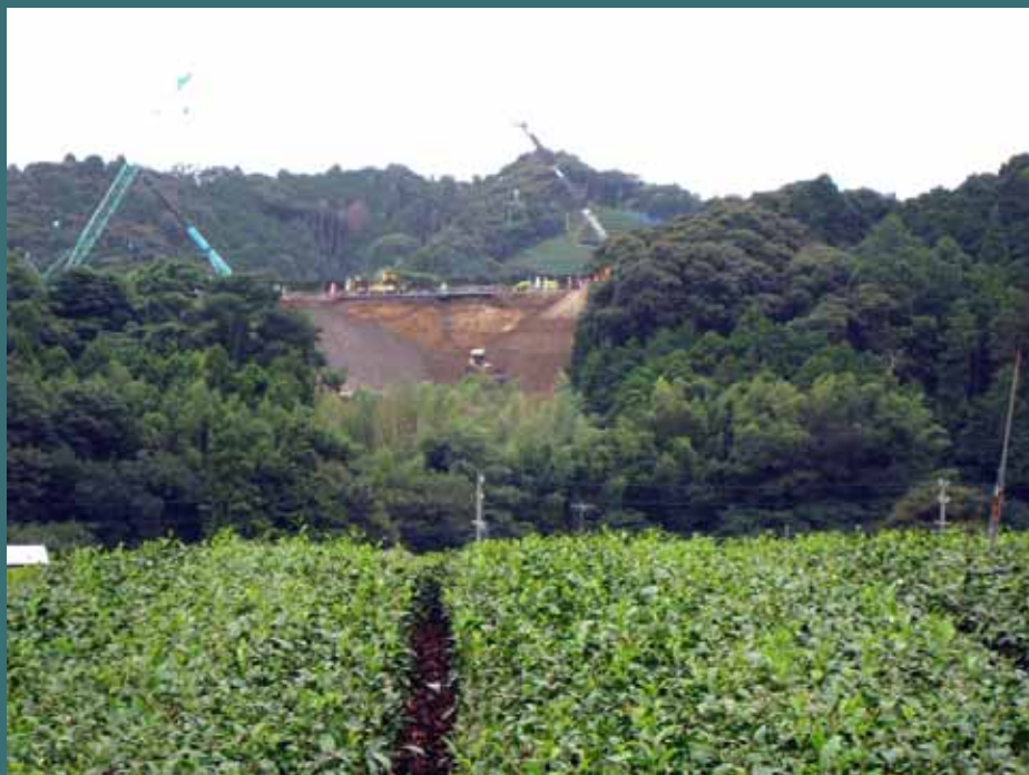
東名高速道路の崩壊地点の全景
