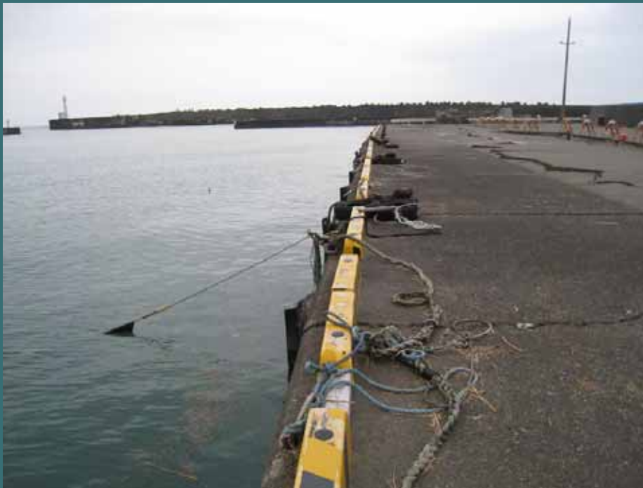
エプロンの陥没が発生した岸壁の法線。 はらみ出しが分かる
