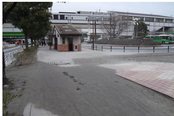
② 新木場駅前広場の液状化による噴砂 (安田教授提供)
