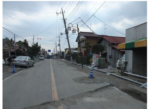
②⑥ 一面の不等沈下と電柱の傾斜 (安田教授提供)
