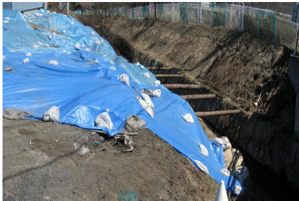
③ 田子町宅地盛土斜面のすべり破壊
