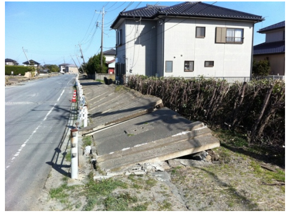
② 日の出地区の舗道直下水路の浮上り
