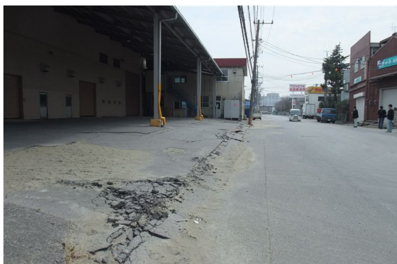
㉓ 液状化で生じた工場敷地と道路との段差 (安田教授提供)
