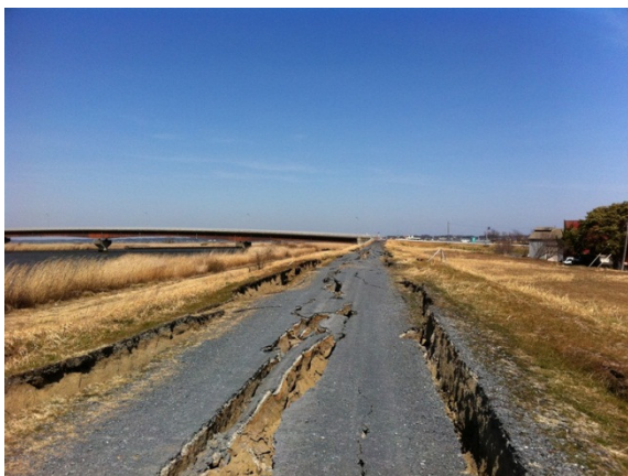
⑤ 液状化による堤防全体の沈下
