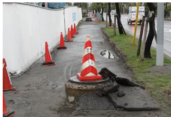
⑥ 千葉市日の出のマンホールの突出
