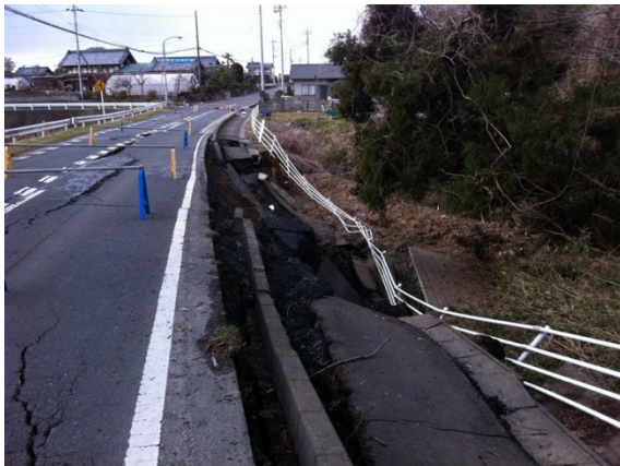
②6 樋管横断部の被害(1)
