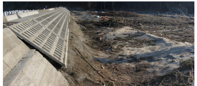
③ 小本川右岸河口付近の被害
