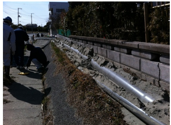
④ 道路脇配管の浮上り
