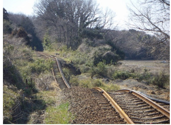
⑫ 盛土のすべり破壊
