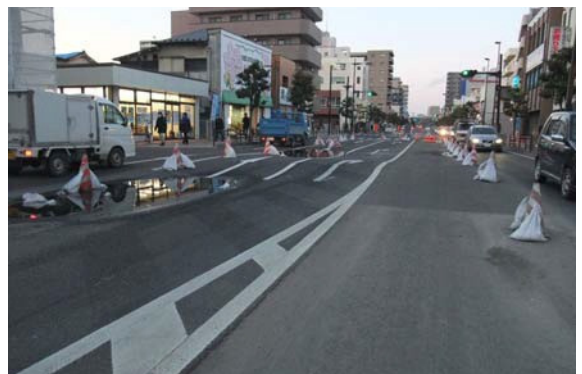
④ 仙台市太白区長町の NATM 工法で建設された地下鉄上の道路中央部の沈下 (安田教授提供)
