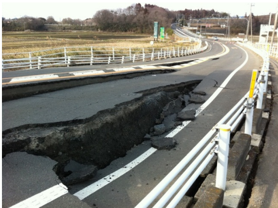
③⑭ 県道道路盛土斜面の崩壊
