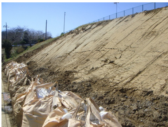
⑨ 盛土斜面崩落跡 (応急復旧がなされている)
