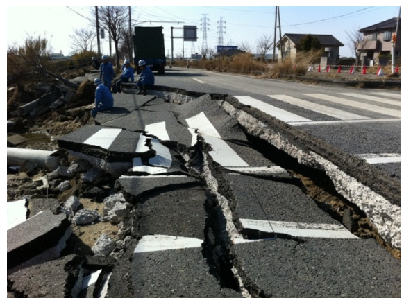
④⑦ 栗生木崎線の掘割川交差点～居切交差点間の津波による道路崩壊
