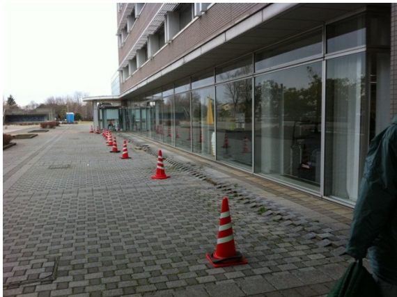
③⑧ 埋戻土の沈下で突出した東海村役場基礎
