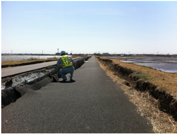
① 稲敷市の稲敷大橋周辺の堤防のり面のすべり破壊
