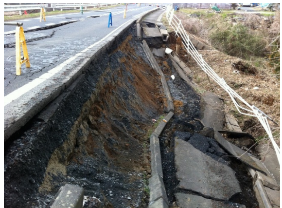
②9 樋管横断部の被害(4)
