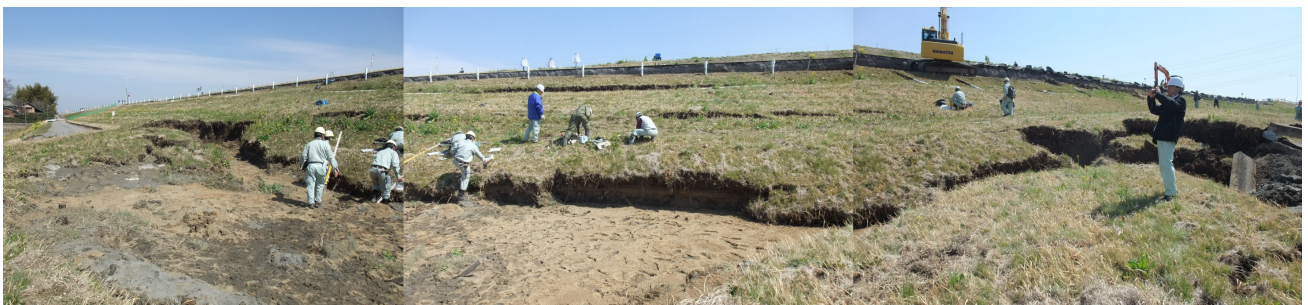
②⑨ のり尻に発生したクラック (江戸川右岸 57.8km 付近) (安田教授提供)
