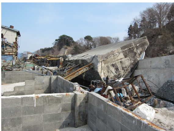
⑧ 山田漁港背後の津波で倒壊した胸壁
