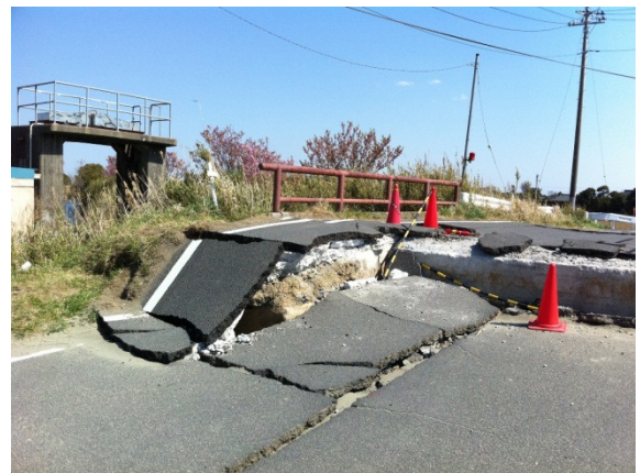
④⑤ 潮来市営前川市の河川橋梁部の段差
