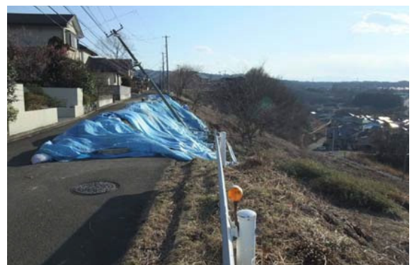
⑥ 仙台市泉区北中山の住宅地のり面の崩壊 (安田教授提供)
