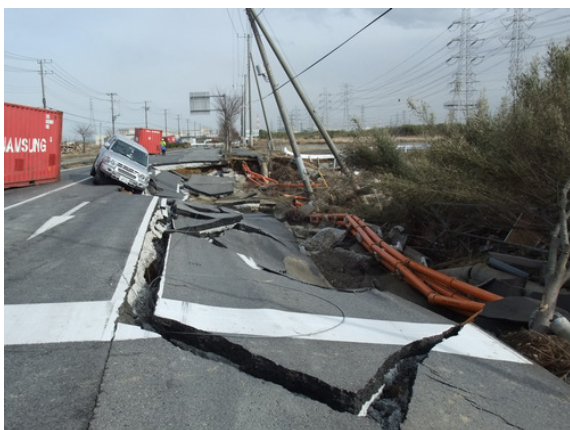
④⑥ 鹿島港周辺の液状化後の津波による道路崩壊（安田教授提供）
