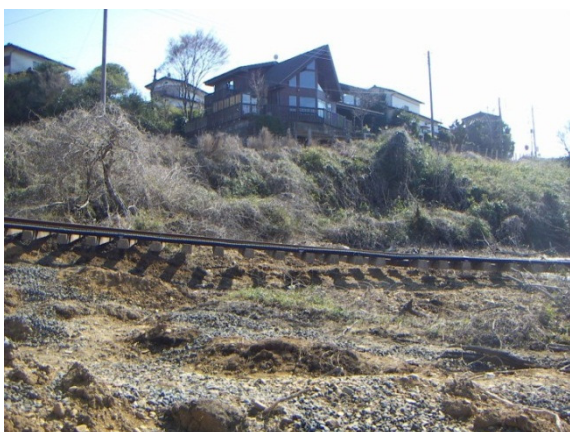
⑮ 軌道が宙に浮いている
