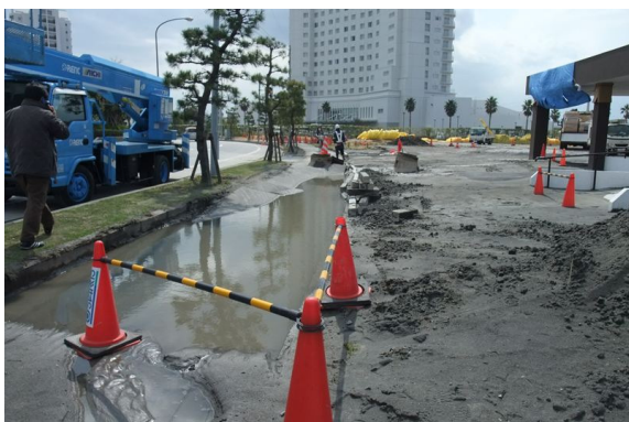
⑤ 液状化で陥没した歩道 (安田教授提供)
