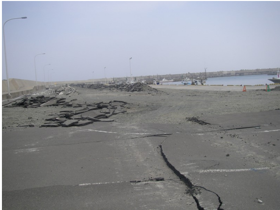
⑫ 三沢漁港埋立部の液状化による不等沈下
