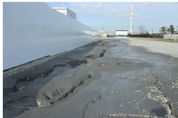
② 大きな亀裂から吹き出した噴砂 (安田教授提供)
