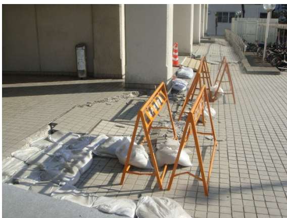
④ 液状化による水戸市役所建屋の突出被害
