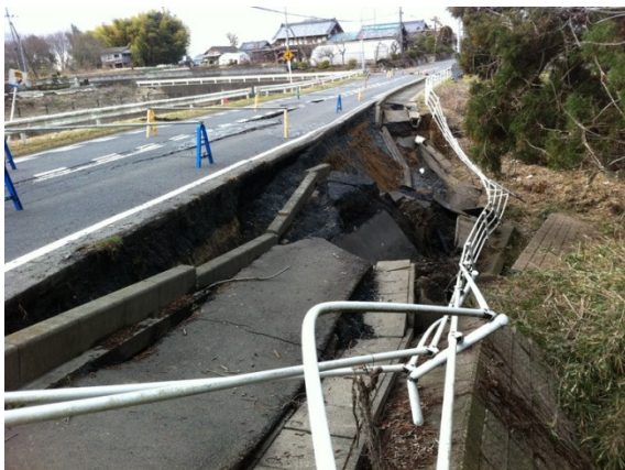
②8 樋管横断部の被害(3)
