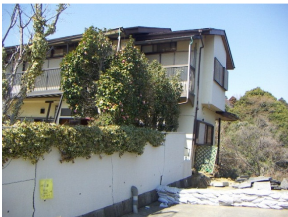
⑳道路盛土の崩壊(4)
