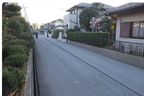
㉒ 街路の不等沈下による中央部クラックと電柱の転倒 (安田教授提供)
