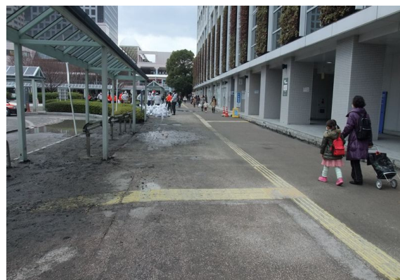
④ 新浦安駅前のデパート基礎の突出 (安田教授提供)
