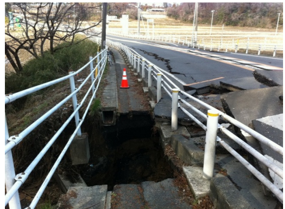
③⑮ 県道の陥没。埋設水道管の破断による土砂流出と推定される
