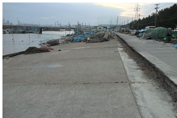
⑭ 物揚場の沈下と段差 (安田教授提供)
