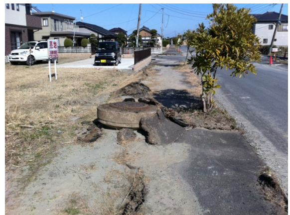
⑥ 液状化によるマンホールの浮上り
