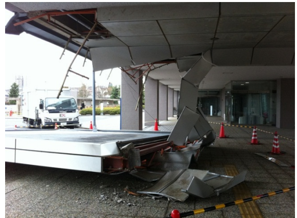
③⑨ 東海村役場ピロティ天井の落下
