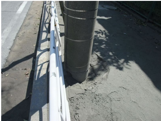
⑤ 電柱の根元の噴砂跡 (安田教授提供)
