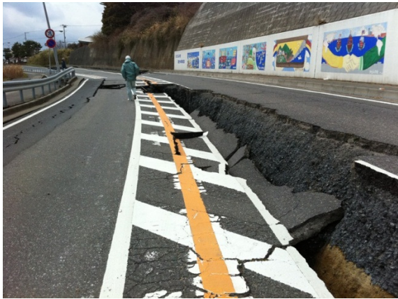
③⑩ 県道 6 号の道路盛土部の液状化による陥没
