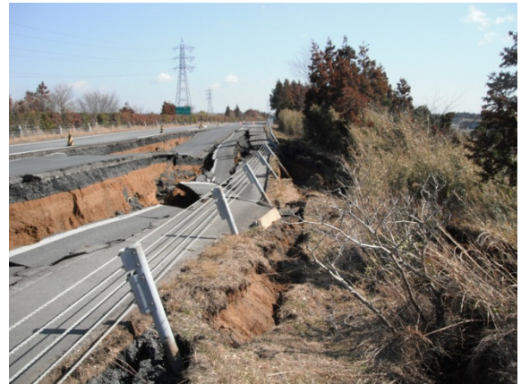
③⑬ 道路盛土斜面の崩壊
