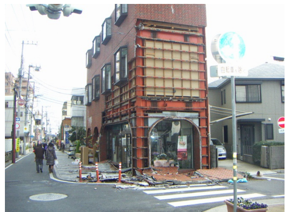
⑤ 外壁が落下したビル
