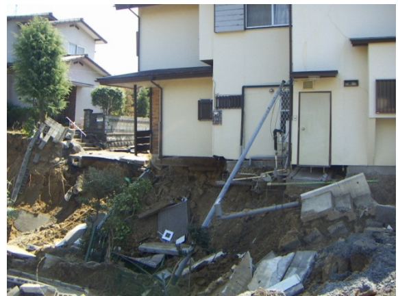
⑲道路盛土の崩壊(3)
