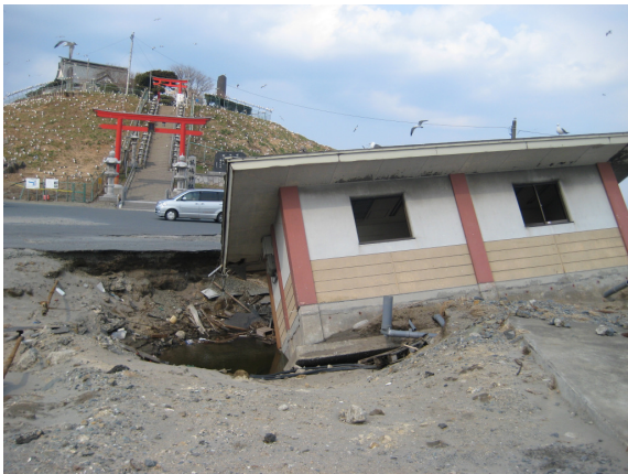
⑭ 基礎部地盤が洗掘され建物が倒壊している八戸港の津波被害
