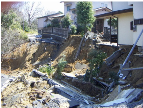
⑱道路盛土の崩壊(2)
