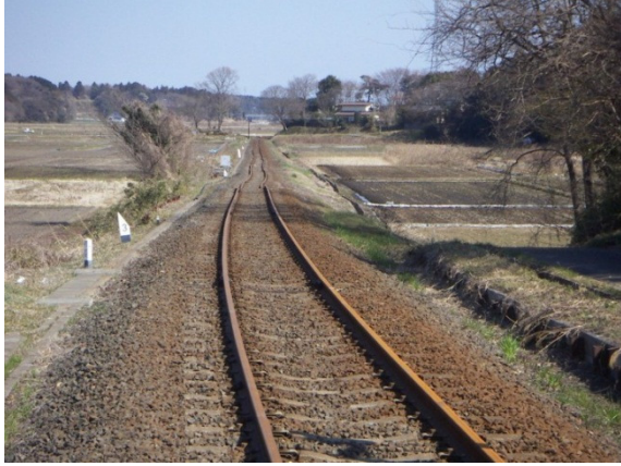
⑪ 鉄道盛土の沈下と水平変位
