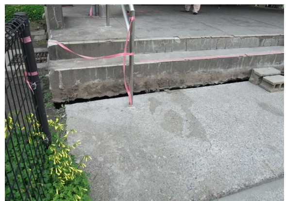
⑧ 辰巳団地の基礎部の段差 (安田教授提供)
