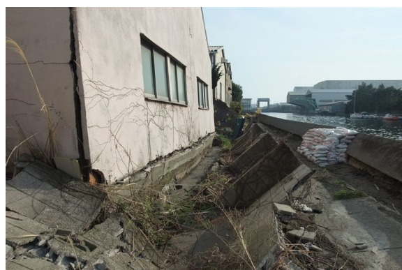
⑯ 擁壁の転倒 (安田教授提供)
