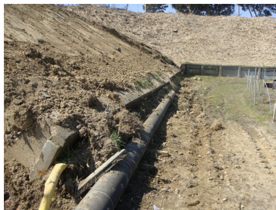
⑩ 崩落土砂が流入した隣接民家敷地内境界部 (応急復旧後)
