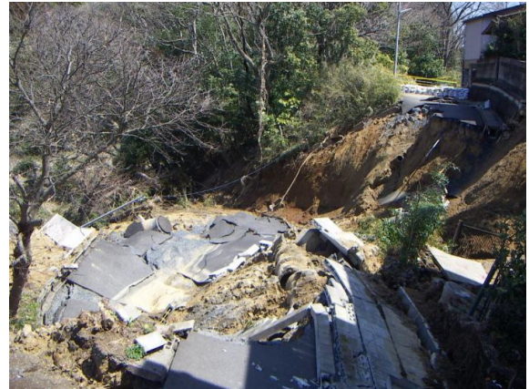
⑰道路盛土の崩壊(1)
