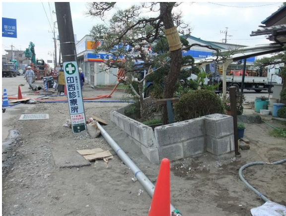
②⑤ 液状化による不等沈下と埋管の浮上り (安田教授提供)
