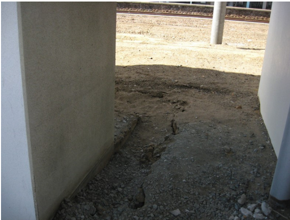
⑧ 三沢駅構内の建築物基礎直近の沈下 (ゆすり込み沈下?)
