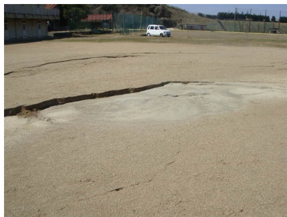
⑧ 校庭盛土部の液状化現象
