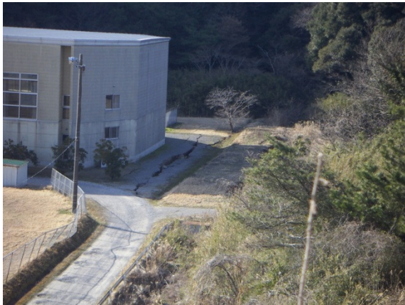
③⑥ 鹿嶋市の谷埋め造成地の建屋周辺の沈下
