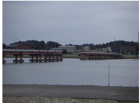
④③ 行方市山田の鹿行大橋（橋桁）の落下
