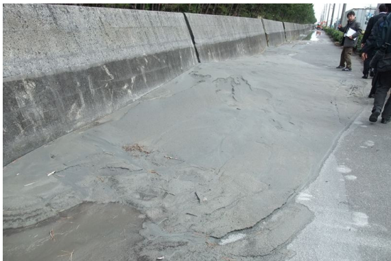
⑨ 土留擁壁の目地から流れ出した噴砂 (安田教授提供)
