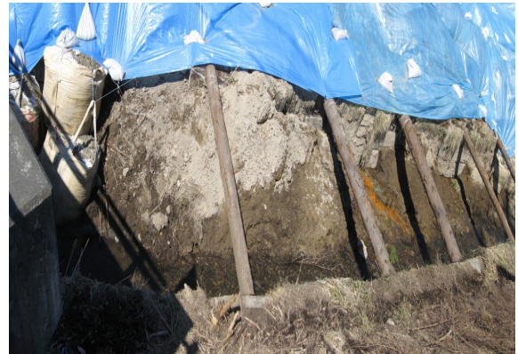
④ 田子町宅地盛土斜面のすべり破壊
