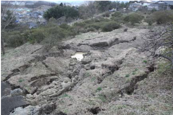
① 白石市緑が丘の宅地のり面の崩壊で地割れが建物基礎にまで及んだ (安田教授提供)
