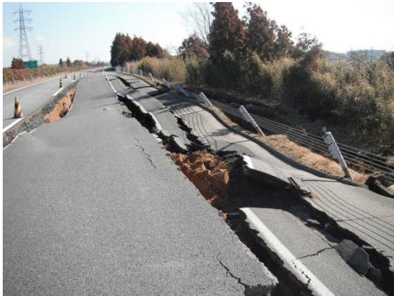
③⑫ 道路盛土斜面の崩壊
