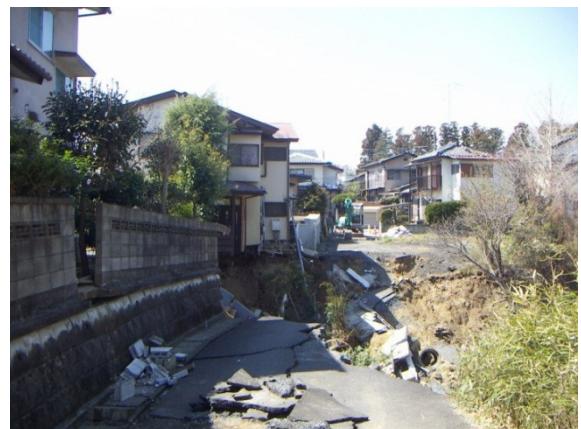
㉑道路盛土の崩壊(5)
