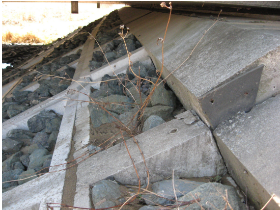
⑥ 三沢駅近傍道路橋台すり付部のり枠の段差
