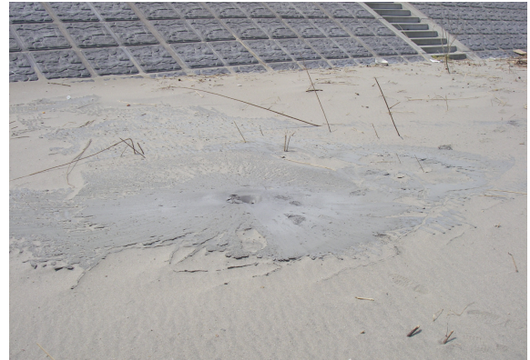
② 宮城県阿武隈川右岸河口部堤外地の再液状化跡 (本震後の噴砂は津波で流されている)
