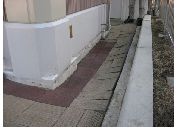
⑦ 三沢駅構内の建築物基礎直近の沈下
