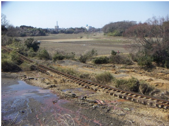
⑬ 広範囲にわたる側方流動とすべり破壊による盛土の喪失
