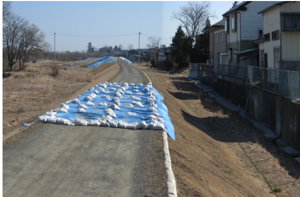
① 八戸市馬淵川右岸 5.3km 付近の河川堤防 天端クラック
