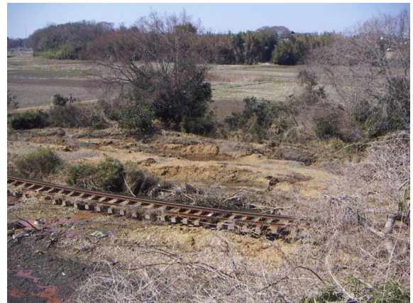
⑭ 広範囲にわたる側方流動とすべり破壊による盛土の喪失
