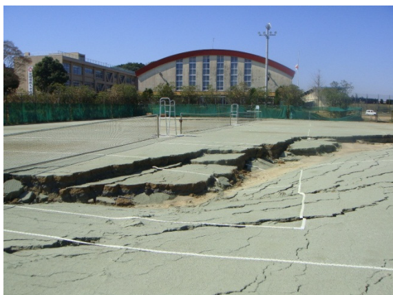
⑦ 校庭盛土部で生じた段差
