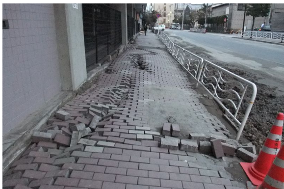
③ 液状化による道路の沈下と歩道の変状 (安田教授提供)
