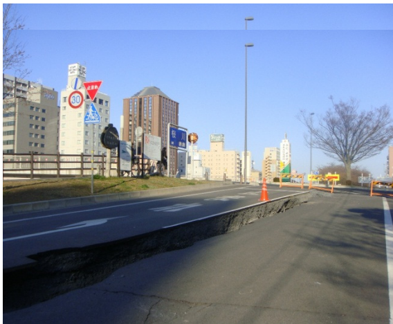
② 桜川堤防天端道路の段差
