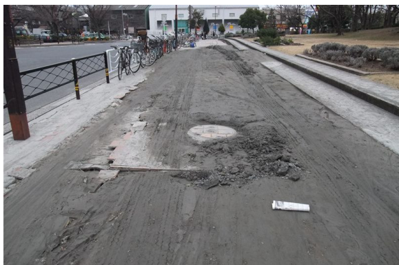
① 新木場駅前のマンホールの浮上り (安田教授提供)
