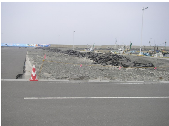
⑩ 三沢漁港埋立部の液状化被害
