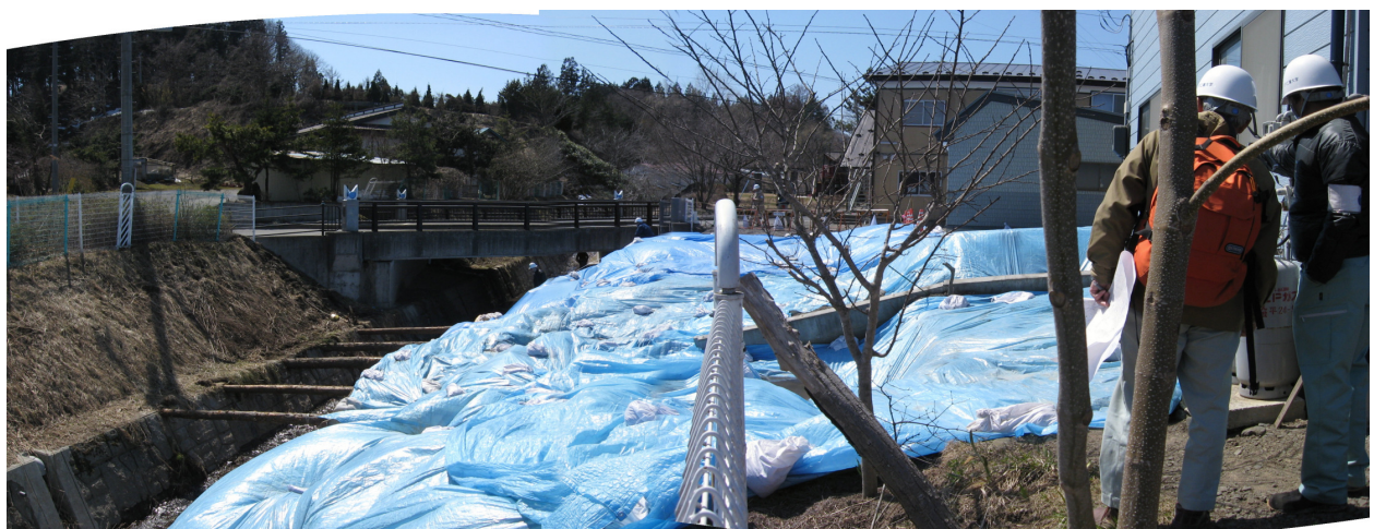
⑤ 田子町宅地盛土斜面の崩壊でクラックは家屋基礎近傍まで及んでいる
