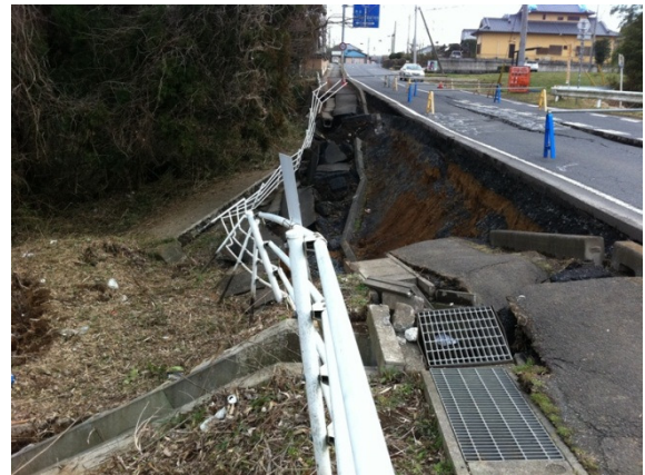
②7 樋管横断部の被害(2)
