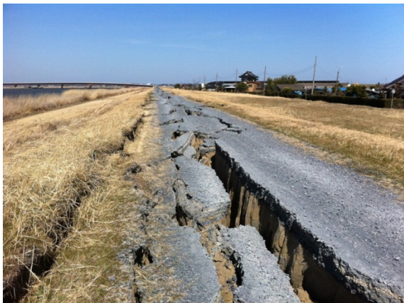
③ 液状化による堤防天端の陥没
