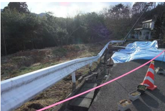
③ 白石市緑が丘の宅地のり面が 30m に渡って崩壊した (安田教授提供)
