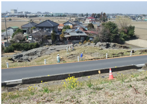
②⑦ のり肩から見た全体の崩壊状況 (江戸川右岸 57.8km 付近) (安田教授提供)
