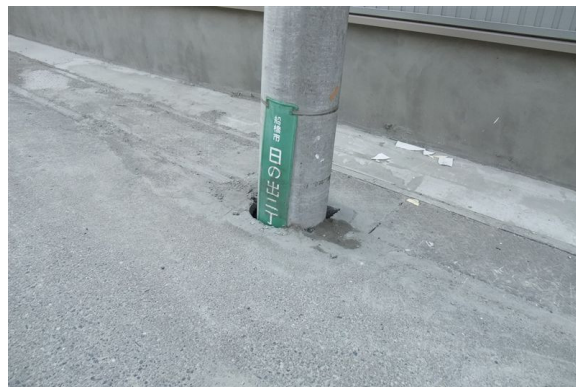
⑱ 液状化による電柱の沈み込み (安田教授提供)
