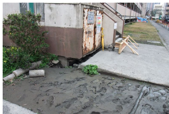
⑨ 辰巳団地基礎の突出と液状化跡 (安田教授提供)
