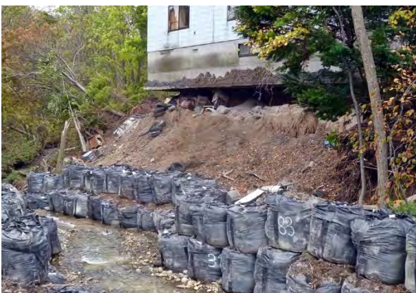
写真 4.3.27 河川側の擁壁の崩壊 (D 地点)
