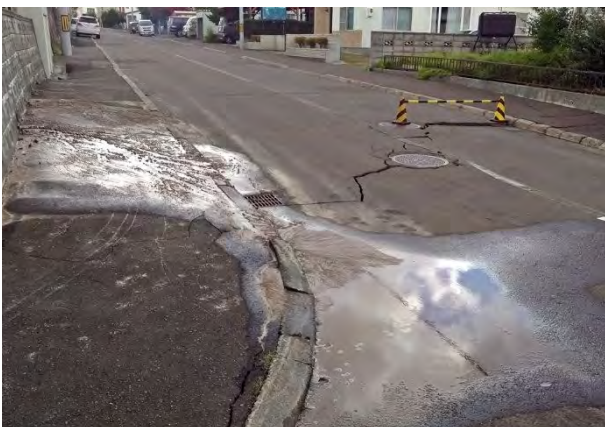
写真 4.5.9 路面の亀裂と噴砂
