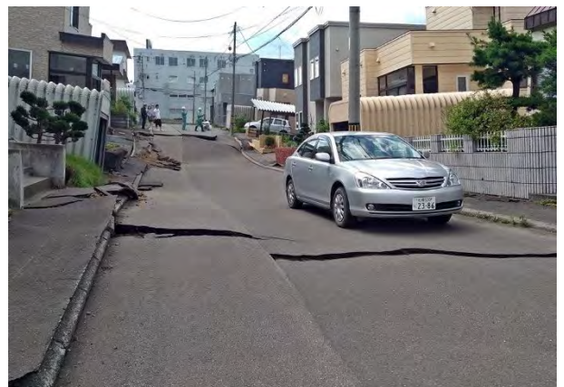
写真 4.3.11 道路の沈下・陥没（地点⑨）
