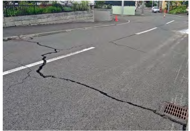
写真 4.5.12 路面の横断亀裂
