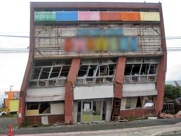
写真 4.3.38 3階建て建物のせん断変形 (地点⑤)
