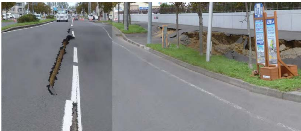
写真 4.1.10 東 15 丁目屯田通の被害（北 46 条）
