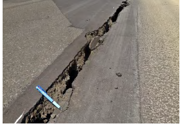
④同左。路面の縦断亀裂と段差の近景
