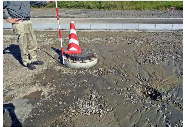
写真 4.5.35 マンホール近傍の噴砂（変状箇所 B）
