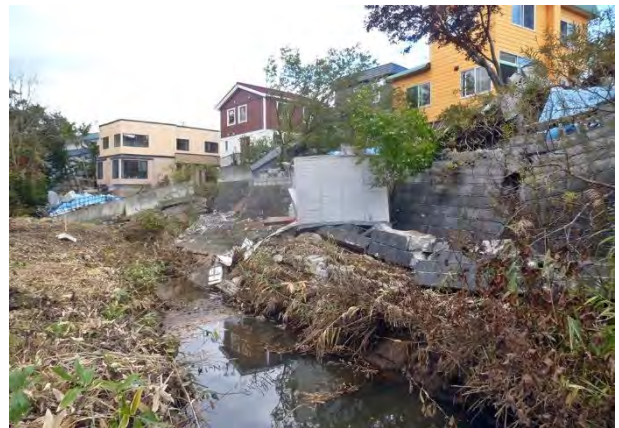
写真 4.3.26 河川側の擁壁の崩壊 (C 地点)
