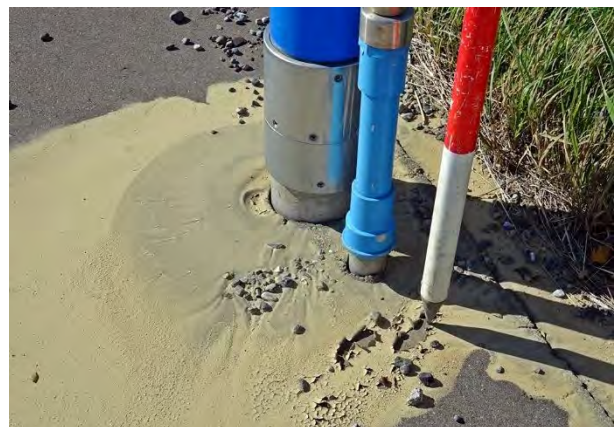
写真 4.5.33 同左近景（変状箇所 A）
