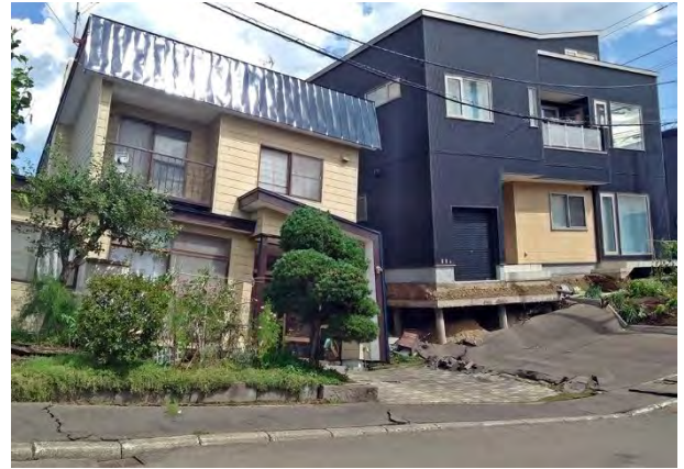
写真 4.3.9 地盤の陥没による家屋の傾斜。右の家は杭基礎のため傾斜がくいとめられている
