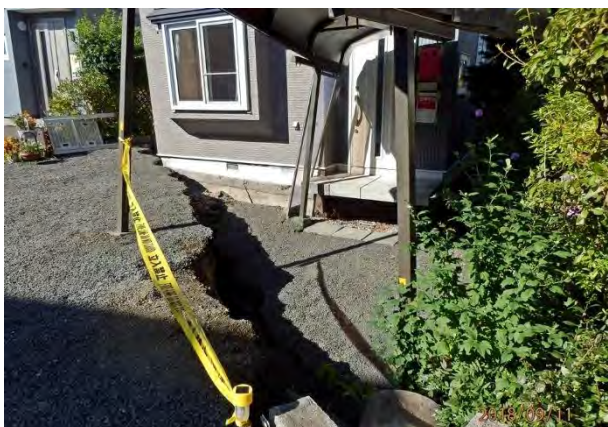
写真 4.3.19 敷地の段差と落ち込んだ家屋 (A 地点)
