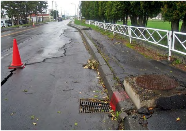
写真 4.5.40 マンホールの浮上と道路の縦断亀裂
