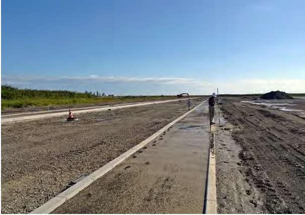
写真 4.5.34 造成中の道路遠景。複数個所で噴砂が発生（変状箇所 B）
