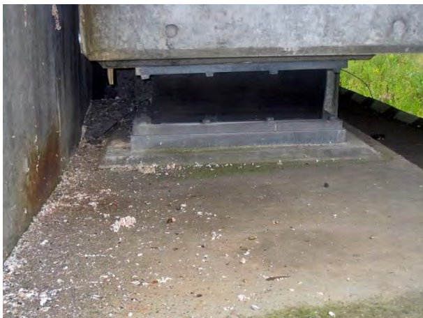
写真 4.2.11 橋台ゴム支承の変形
