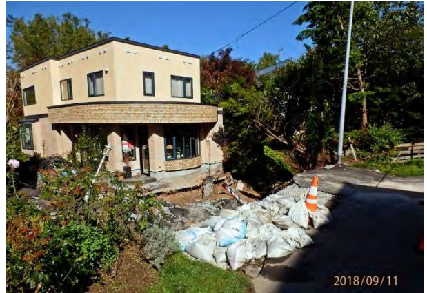
写真 4.3.24 家屋の沈下と敷地の開口 (B 地点)
