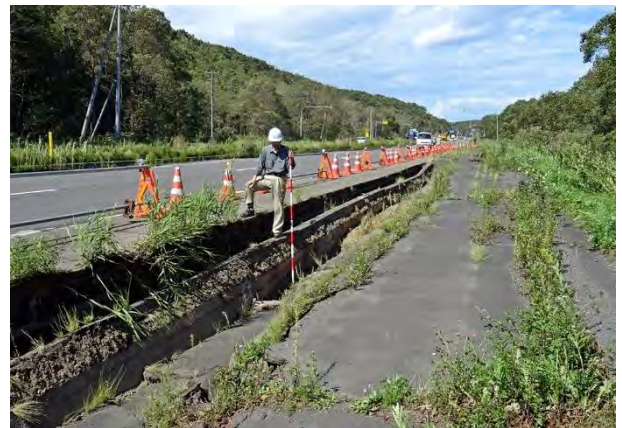
写真 4.1.12 歩道の沈下・陥没
