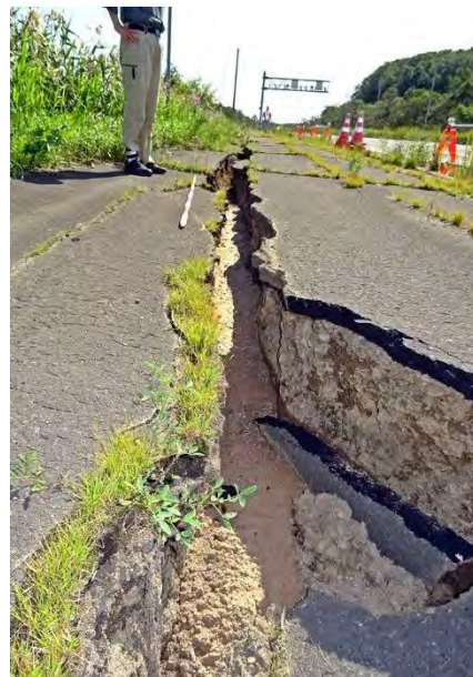
写真 4.1.18 上り線歩道の沈下と開口
