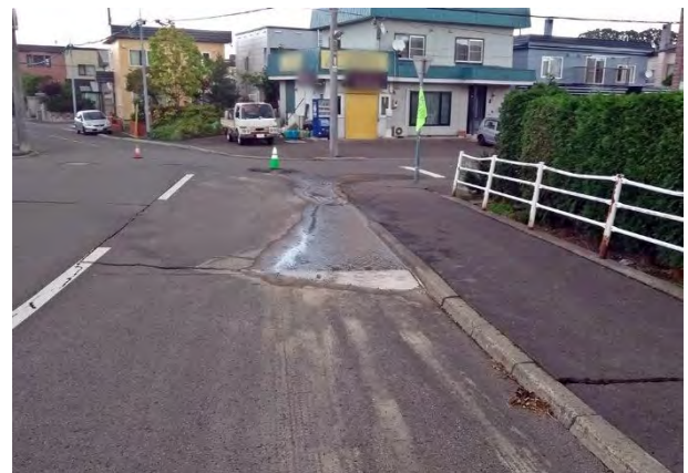
写真 4.5.10 路面の噴砂と沈下
