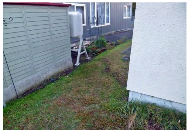
写真 4.3.22 敷地に生じた軽微な段差と開口。写真 4.3.21 の右手前の擁壁背後に当たる (A 地点のやや南)
