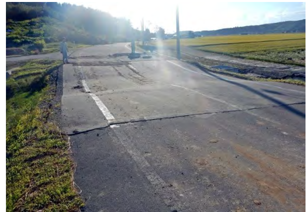
写真 4.5.29 水路際の道路の沈下
