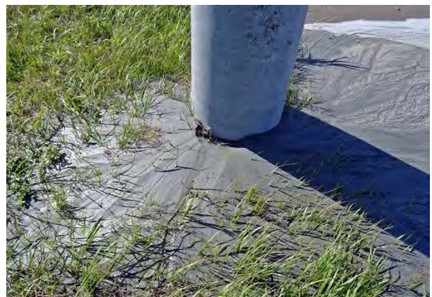
写真 4.5.31 同左。噴出箇所の近景（変状箇所 A）
