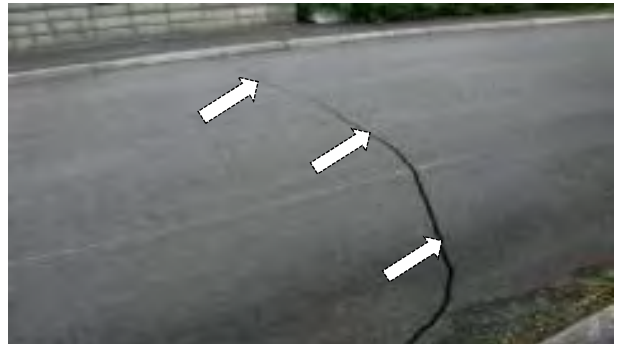
地点⑥ 道路上のクラック (矢印)
