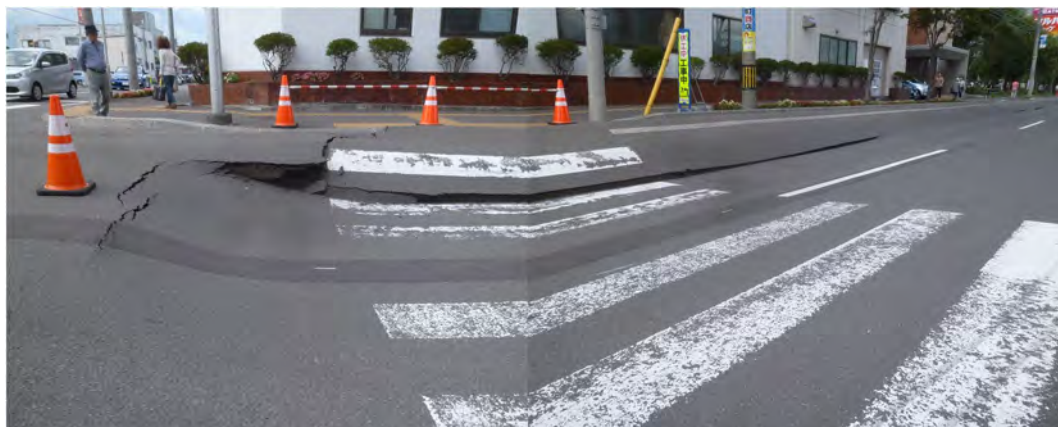
道路の沈下・陥没
