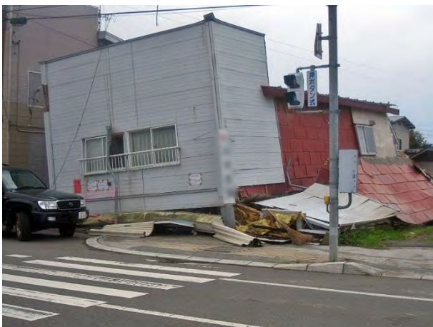
写真 4.3.34 2階建て建物の層崩壊 (地点①)
