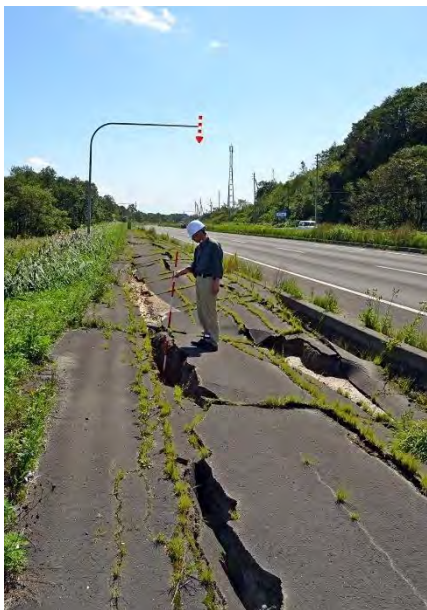
写真 4.1.17 上り線歩道の沈下と開口
