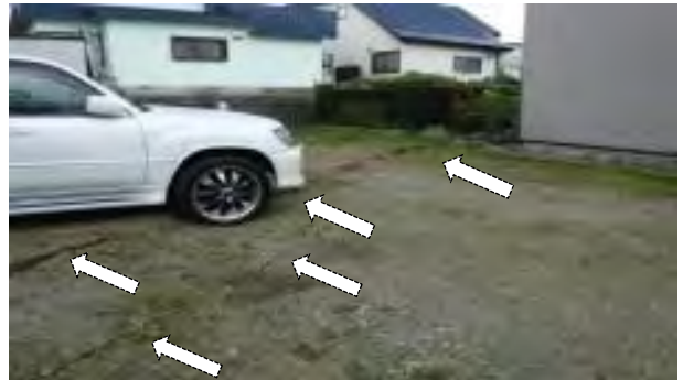
地点② 空地内に生じたクラック (矢印、段差 5~15cm)
