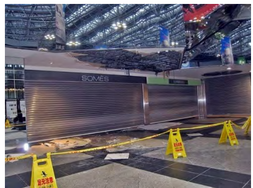
写真 2.3.2 ターミナルビルの天井パネルの被害（新千歳空港）
