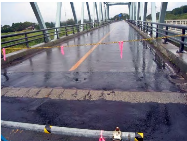
写真 4.2.6 橋台部の沈下（補修済み）
