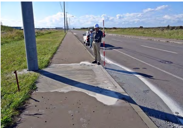
写真 4.5.30 電柱根元から噴出した噴砂（変状箇所 A）
