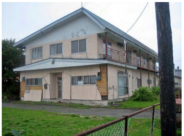
写真 4.3.41 建物外壁の剥落 (地点⑦)
