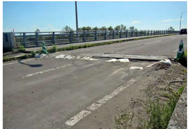
写真 4.2.2 西側橋台裏の亀裂と沈下
