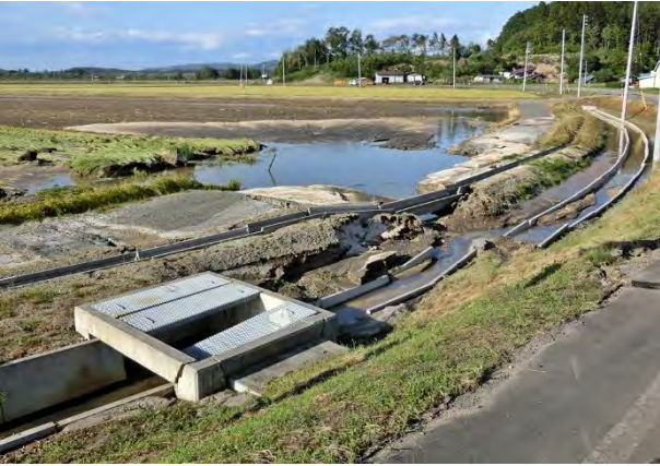
写真 4.5.24 水田の沈下と水路の変形
