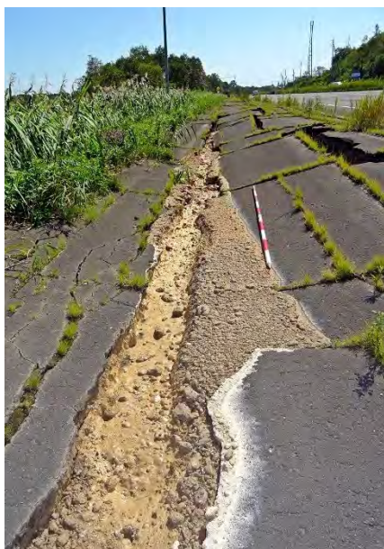
写真 4.1.19 上り線歩道の開口と噴砂。 歩道は法尻側にやや傾斜している
