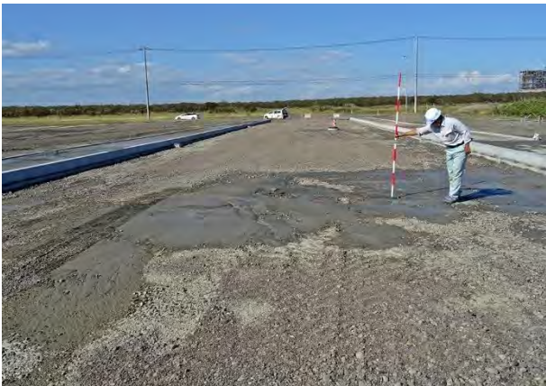
写真 4.5.36 造成道路中央からの噴砂（変状箇所 B）
