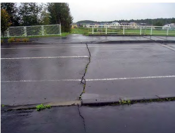
写真 4.2.15 橋台背後の横断亀裂
