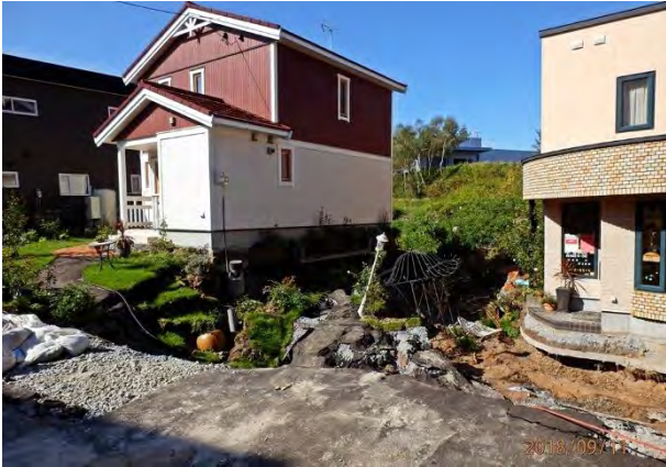
写真 4.3.23 隣接する敷地の段差と開口 (B 地点)
