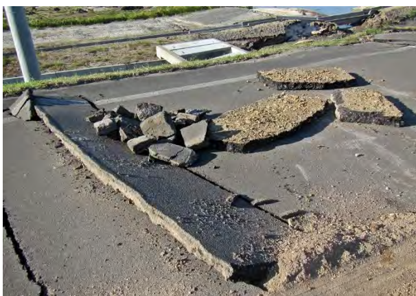
写真 4.1.29 道路のバックリング
