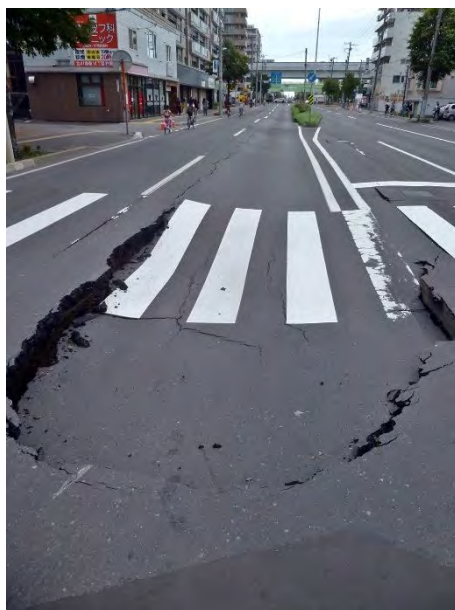
②道路の陥没
