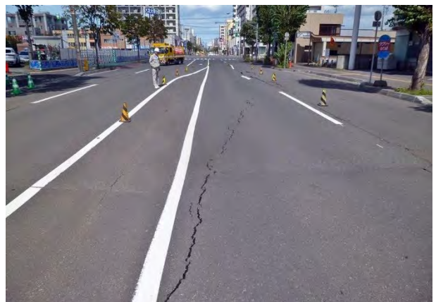
④車道の亀裂
