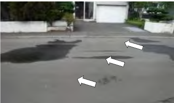
地点⑦ 道路上のクラック (矢印)
