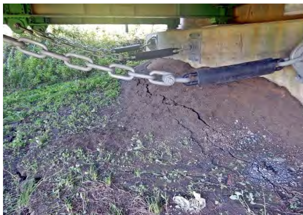
写真 4.2.3 橋台前面盛土の亀裂
