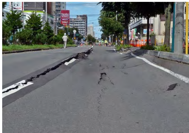
②道路の沈下・陥没
