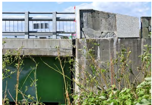
写真 4.2.4 親柱の化粧板の剥落
