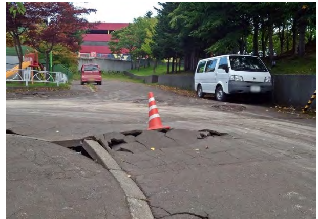
写真 4.5.8 清田区美しが丘 7 丁目道路屈曲部の盛り上がり
