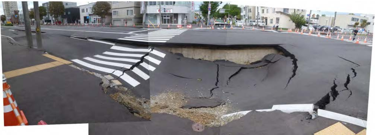
写真 4.1.9 東 15 丁目屯田通の被害（北 45 条その 2）
