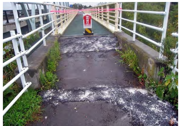
写真 4.2.8 隣接する人道橋の橋台裏の沈下
