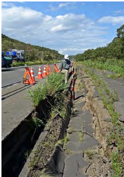
写真 4.1.13 歩道の沈下・陥没
