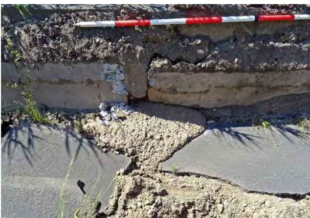
写真 4.1.15 歩道陥没部で噴出した軽石混じり火山灰
