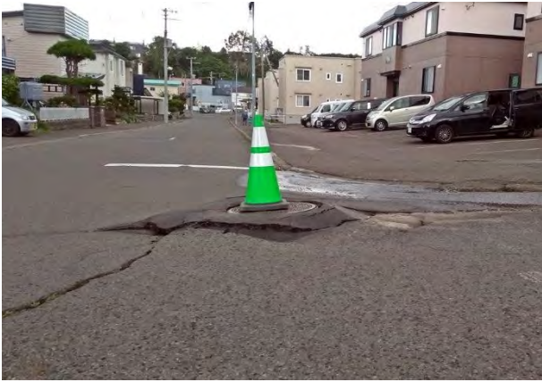
写真 4.5.11 マンホールの浮き上がり
