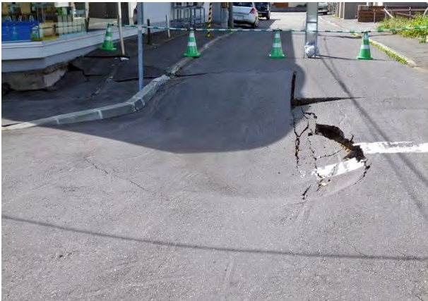
①車道の陥没
