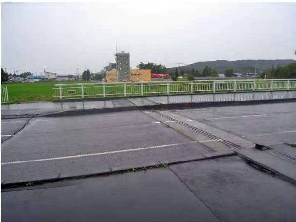
写真 4.2.14 橋台裏の沈下
