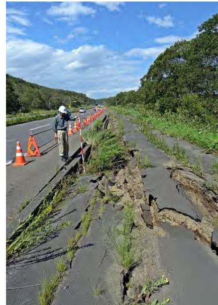
写真 4.1.14 歩道の沈下・陥没
