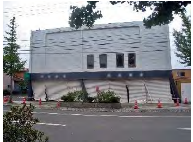
写真 4.3.37 2階建て建物のせん断変形 (地点④)
