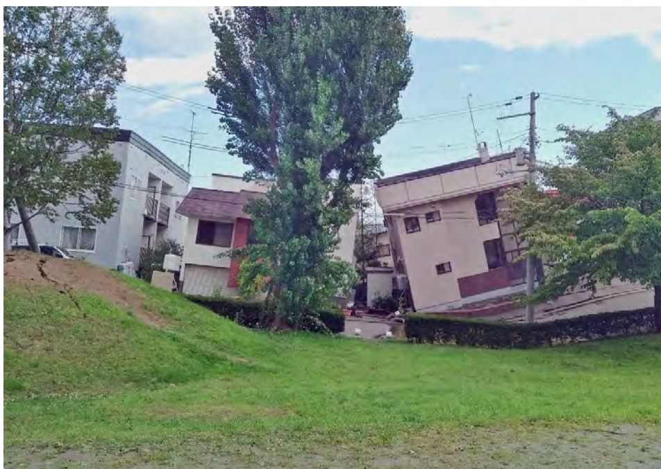
地盤陥没による家屋の傾斜（札幌市清田区里塚地区）
