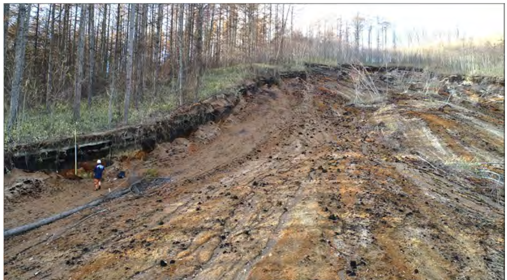
写真 4.4.5 平面型崩壊の事例写真①
