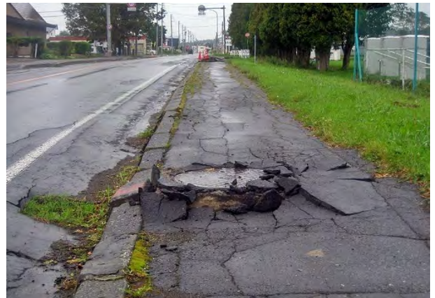
写真 4.5.45 マンホールの浮上
