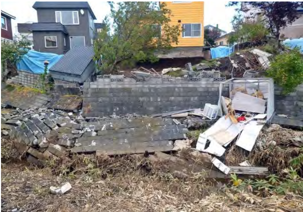
写真 4.3.25 河川側の擁壁の崩壊 (C 地点)
