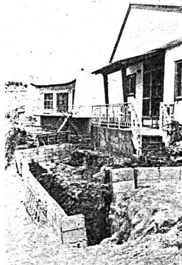
写真 4.5.15 盛土法面の崩壊により被害を受けたブロック塀 (A 地区) (1968 年十勝沖地震) 18)
