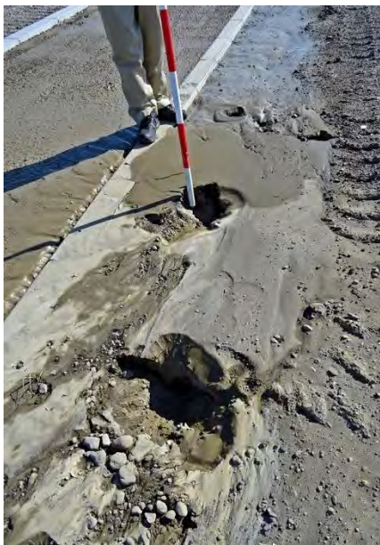
写真 4.5.38 造成中道路側部に見られた噴砂孔（変状箇所 B）
