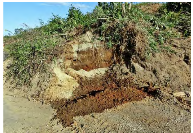
写真 4.1.28 崩壊土砂の近景
