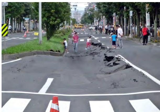
①大規模な道路の陥没
