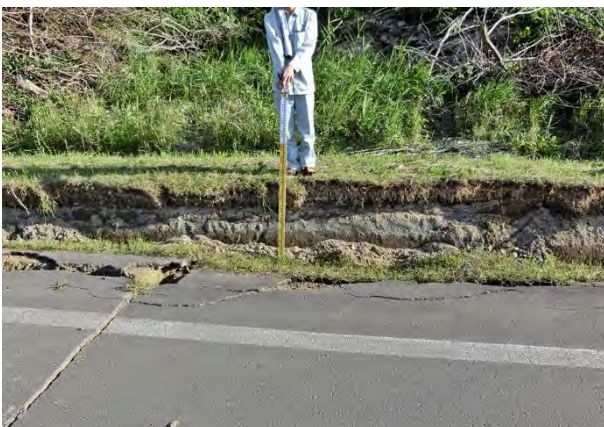
写真 4.1.23 正面よりみた隆起断面
