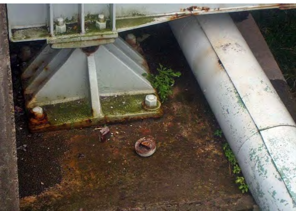
写真 4.2.7 支承部の落下部品
