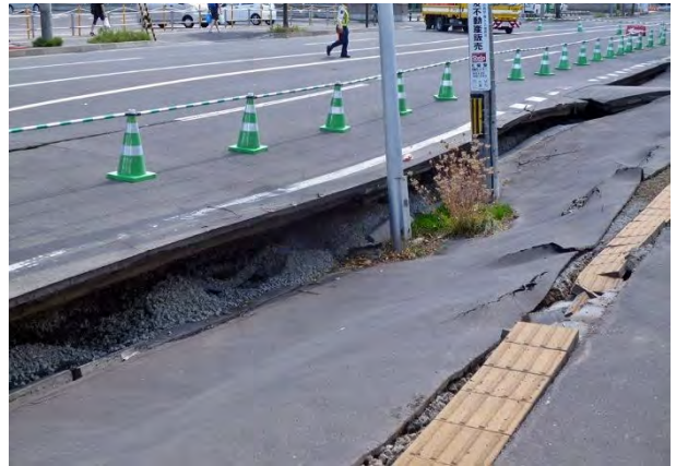
②歩道の陥没
