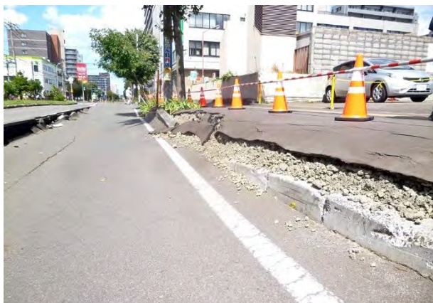
③道路の沈下・陥没
