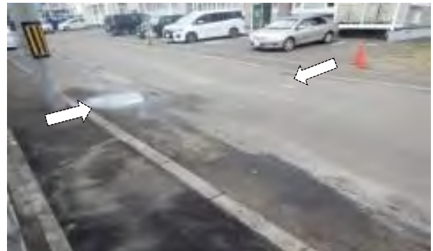
地点⑧ 道路陥没・水たまり (矢印)
