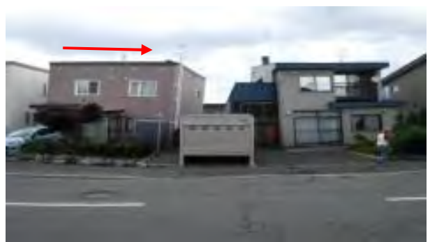
地点④ 住宅の傾斜
