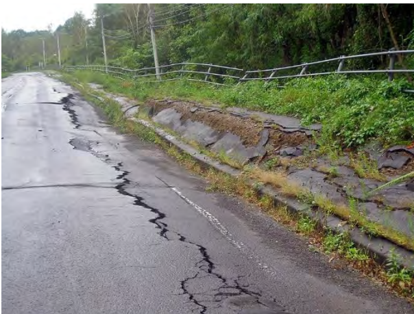
写真 4.1.31 法肩の沈下とはらみ出し
