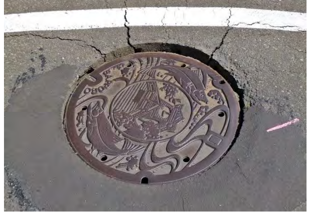
②マンホールの見かけ上の沈下
