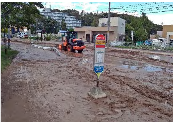
写真 4.3.2 道路に流出・堆積した土砂 (地点①-1)
