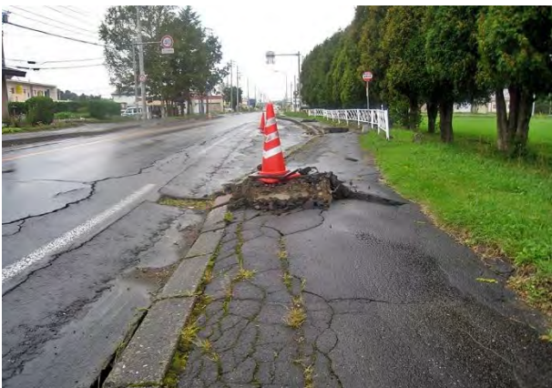
写真 4.5.44 マンホールの浮上
