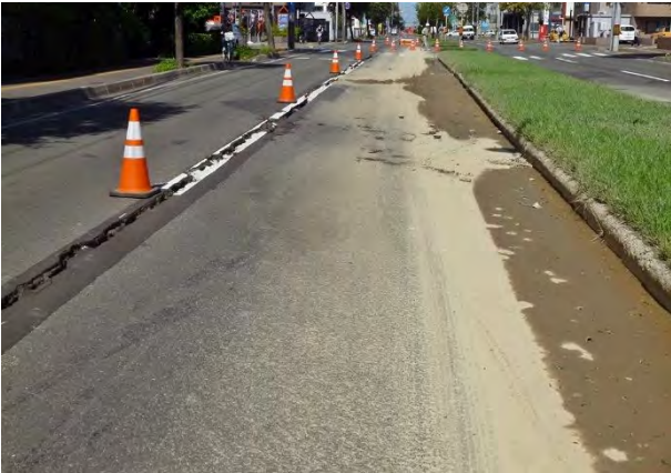
③中央分離帯付近の噴砂と路面の縦断亀裂・段差
