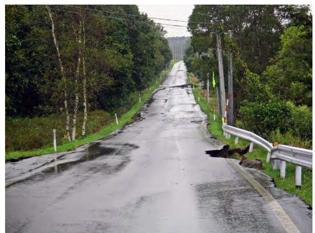
写真 4.1.34 分岐する町道の路面陥没
