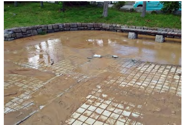
写真 4.5.6 同左 奥が沈下して冠水している
