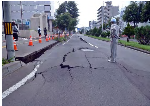
④道路の沈下・陥没・縦断亀裂
