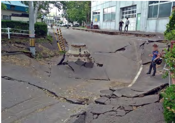
写真 4.3.8 地盤の陥没による相対的に突出したマンホール（地点⑥）
