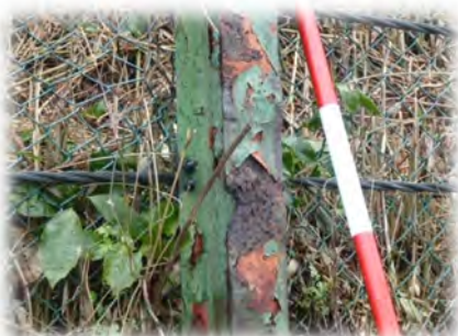
落石防護柵の老朽化
