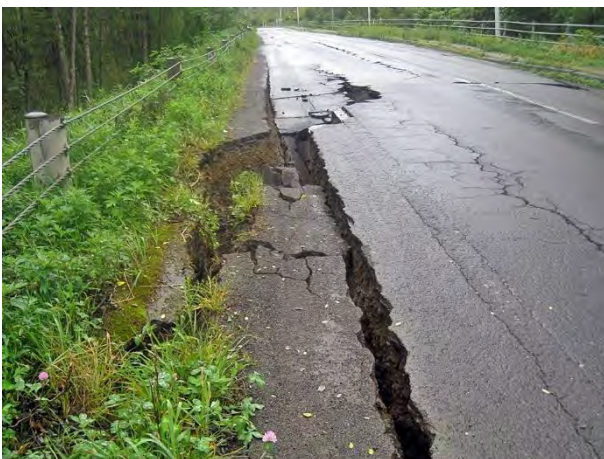
写真 4.1.33 法肩の陥没 (沢横断部)
