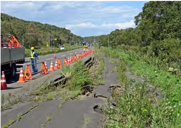
写真 4.1.11 道路法肩（歩道）の変状
