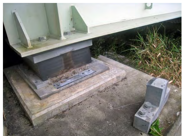
写真 4.2.16 橋台ゴム支承のサイドブロックの損傷
