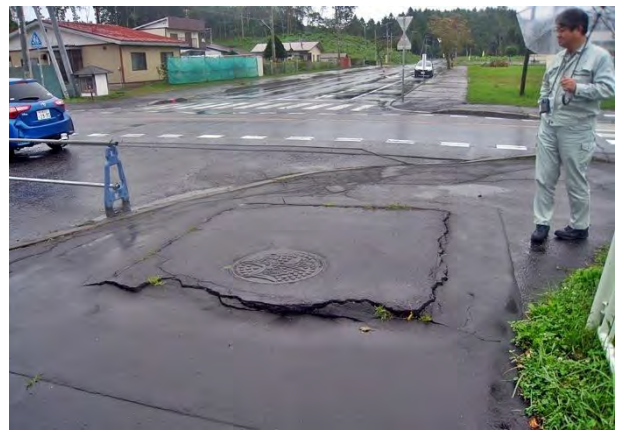
写真 4.5.43 マンホールの浮上
