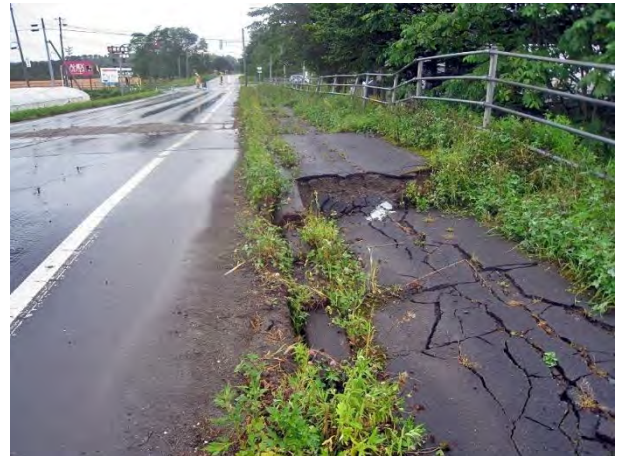
写真 4.2.12 アプローチの歩道の陥没
