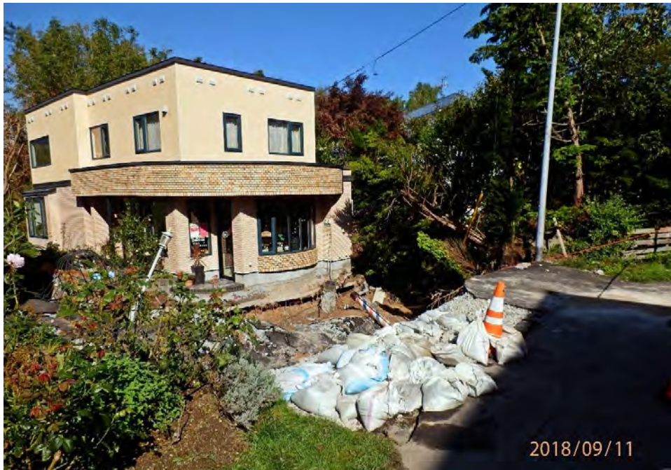
擁壁の崩壊により沈下・傾斜した建物（北広島市大曲並木地区）
