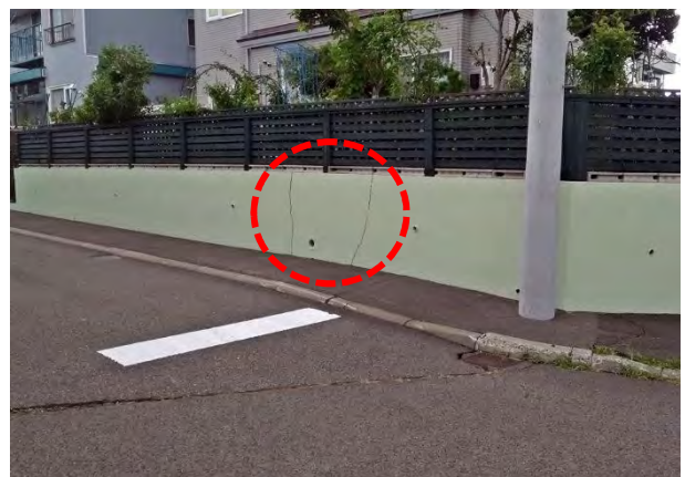
写真 4.5.13 コンクリート塀の亀裂
