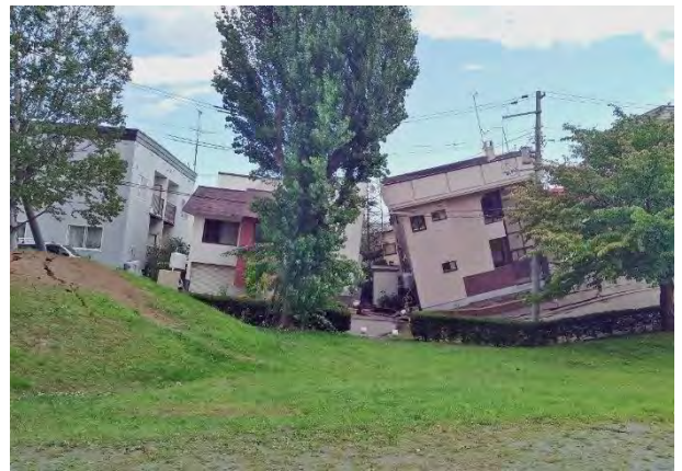
写真 4.3.7 地盤の陥没による家屋の傾斜（地点⑤）
