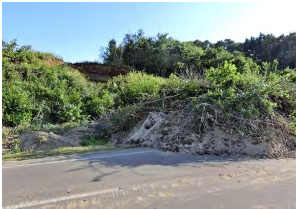
写真 4.1.27 道路を覆った崩壊土砂
