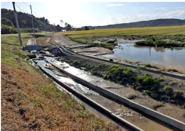
写真 4.5.22 水田の沈下と水路の変形
