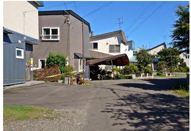
写真 4.3.20 家屋の沈下とカーポートの変形 (A 地点)
