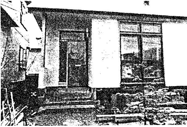
写真 4.5.16 平屋の基礎南半分の沈下 (B 地区) (1968 年十勝沖地震) 18)
