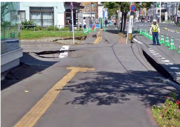
③歩道の陥没
