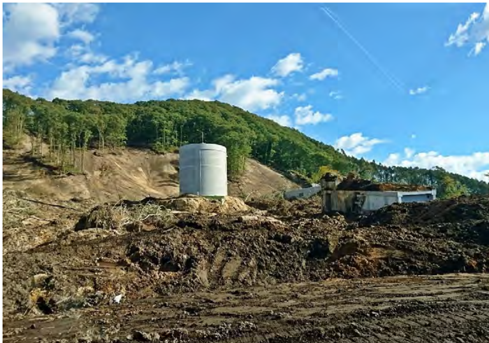
背後の斜面崩壊により倒壊・移動した浄水場の構造物（勇払郡厚真町富里）
