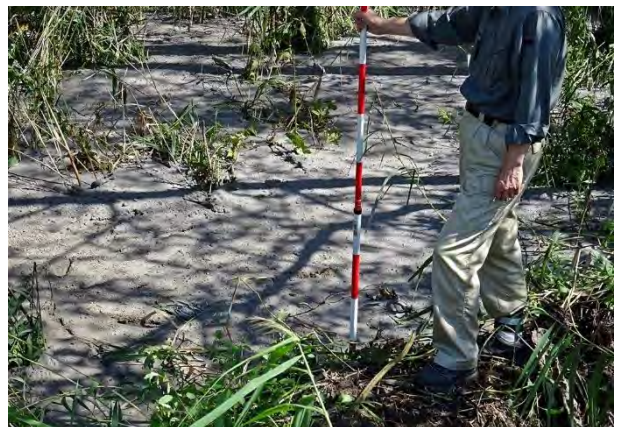
写真 4.1.16 道路盛土法尻から噴出した火山灰の噴砂
