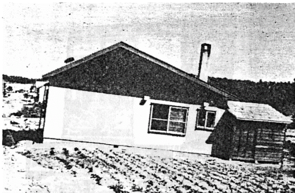
写真 4.5.14 3 度程度傾斜した家屋 (A 地区) (1968 年十勝沖地震) 18)
