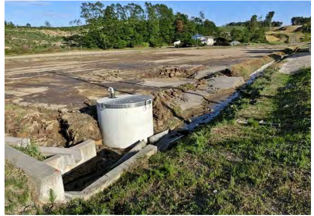
写真 4.5.25 水田の沈下と水路の変形
