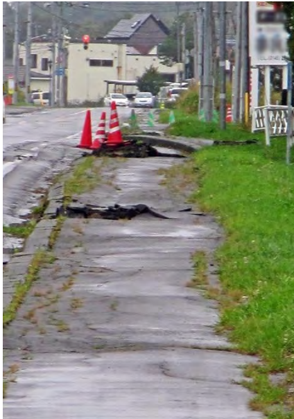
写真 4.5.42 マンホールの浮上
