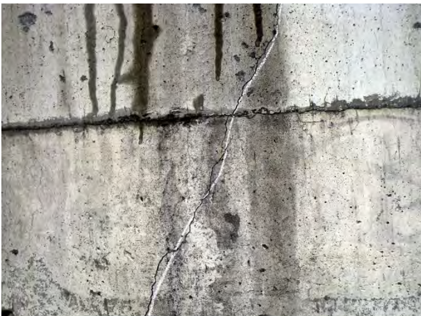
写真 4.2.10 左岸橋台の斜め亀裂
