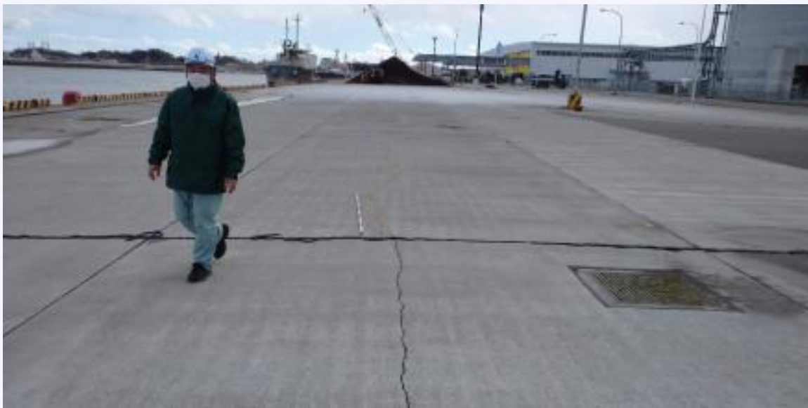
岸壁背後エプロンの亀裂（-7.5m東側岸壁）
