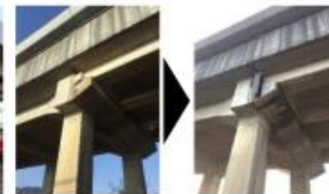
福島～白石蔵王間 高架橋サイドブロック損傷
