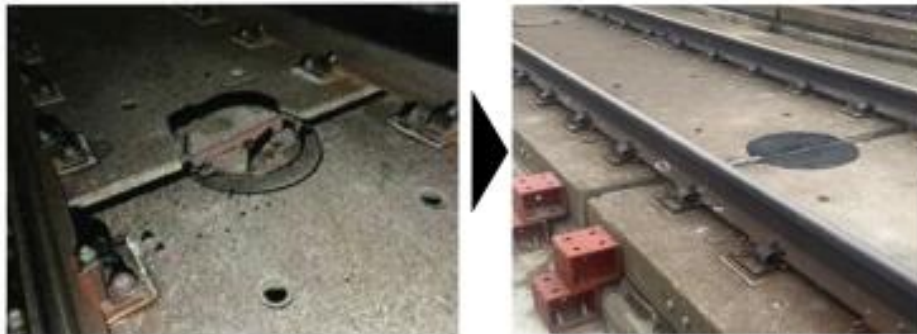
福島～白石蔵王間 スラブ軌道突起部損傷
