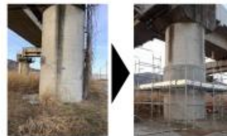
福島～白石蔵王間 高架橋柱損傷
