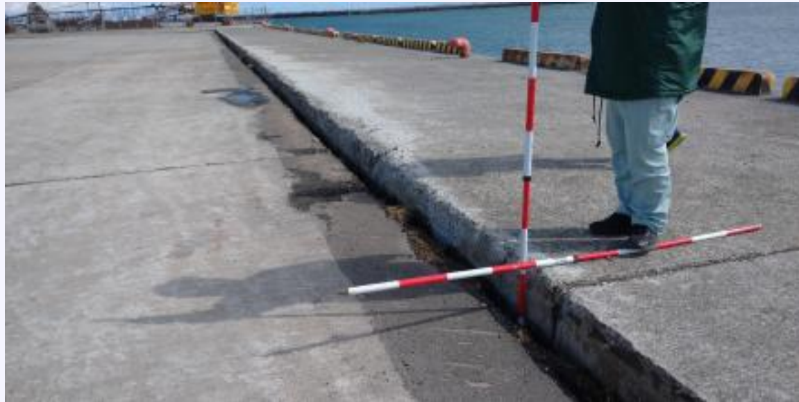
岸壁とエプロンの段差（-5.5m南側岸壁）
