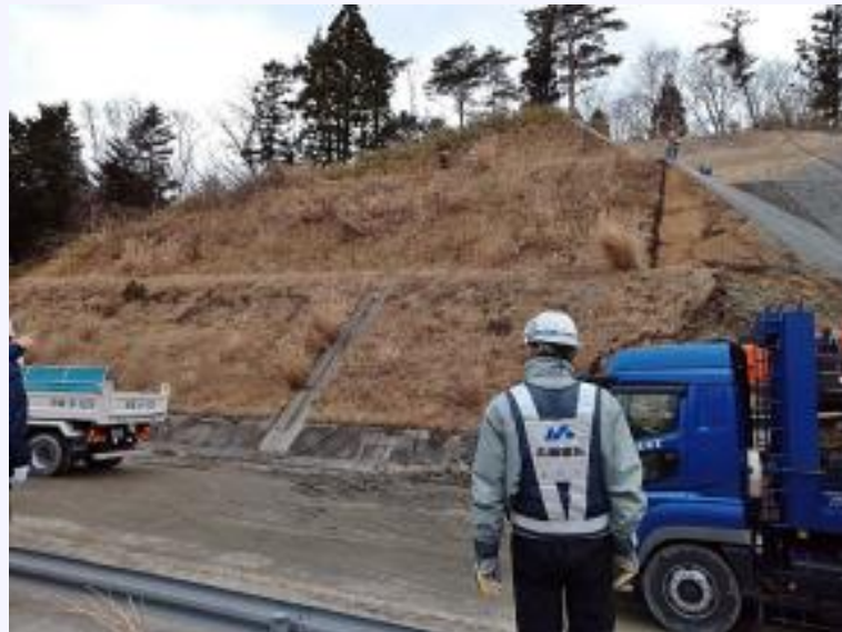
崩壊しなかった切土斜面。右手は崩壊部分と不安定部分を撤去した箇所
