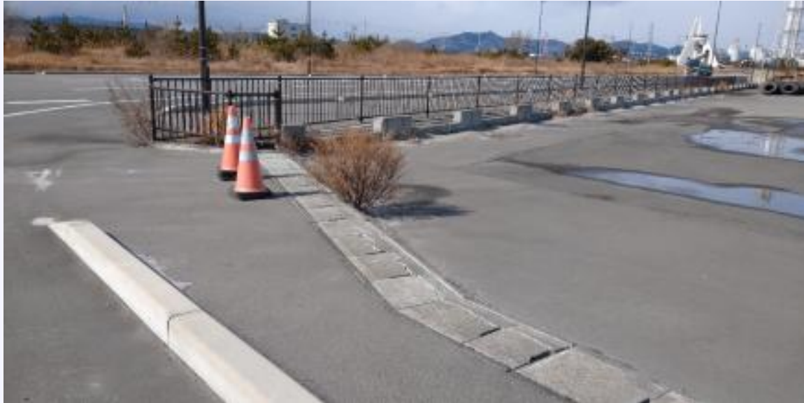
U字溝蓋の亀裂
