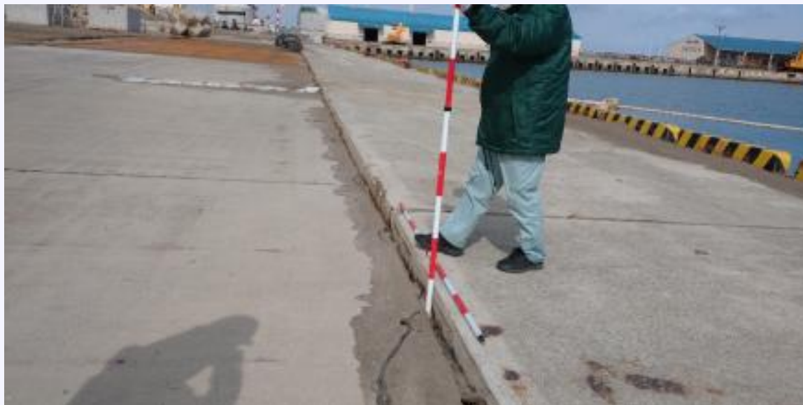
岸壁とエプロンの段差（-5.5m西側岸壁）
