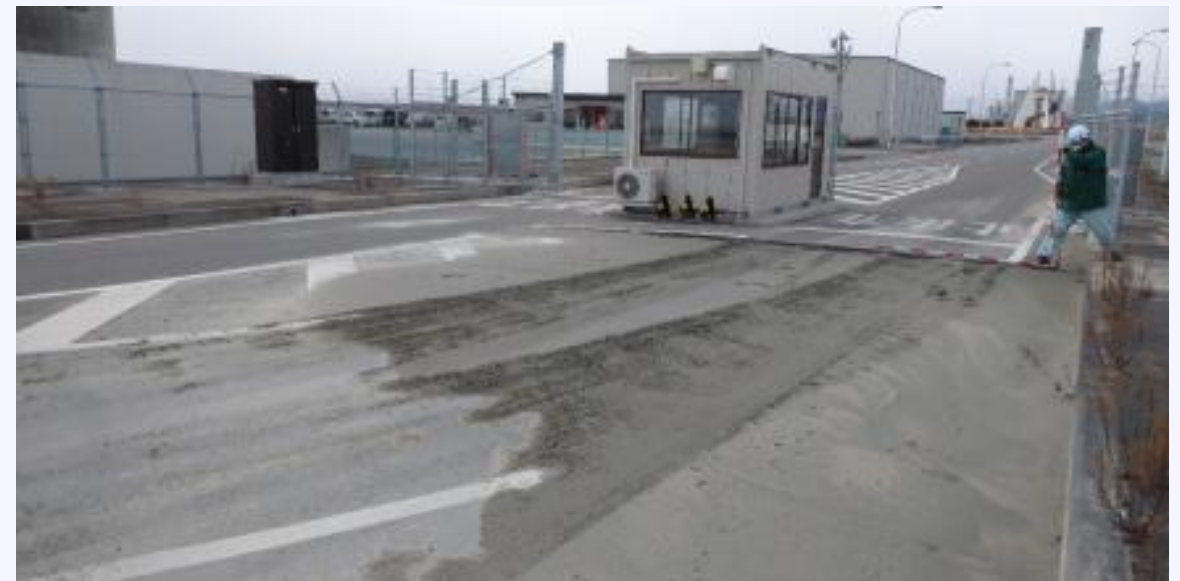
岸壁背後道路の噴砂
