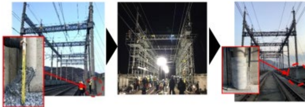
福島～白石蔵王間 電柱折損
