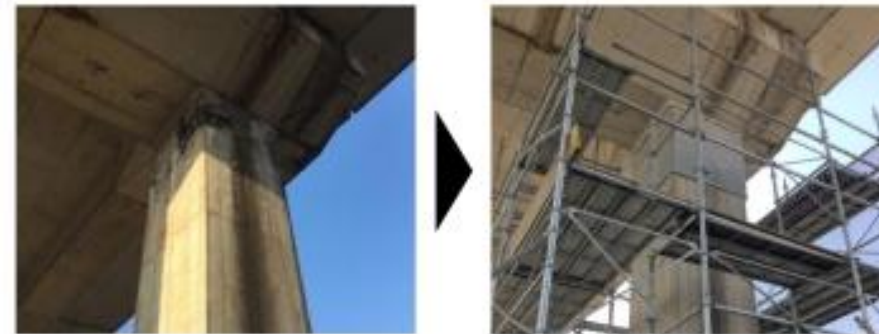
福島～白石蔵王間 高架橋柱損傷
