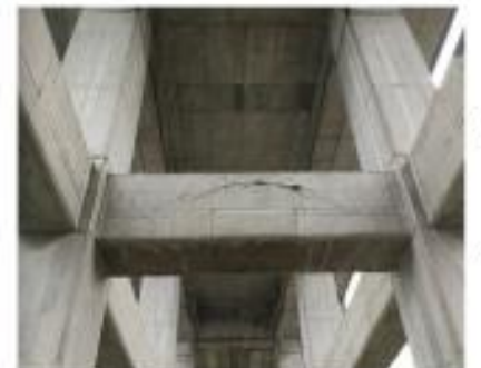
福島～白石蔵王間 高架橋中層梁損傷
