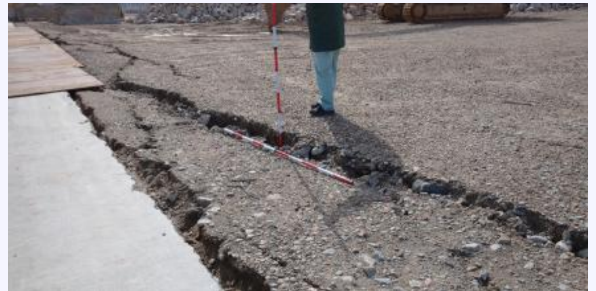
岸壁背後の沈下と地割れ（-5.5m西側岸壁）
