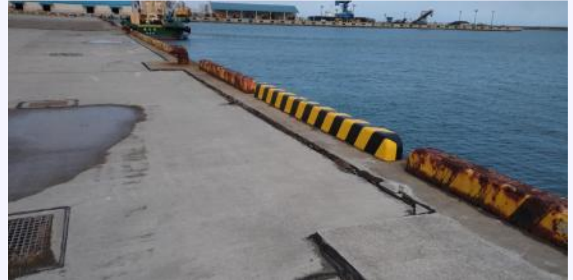
岸壁背後の沈下と段差（-7.5m東側岸壁）
