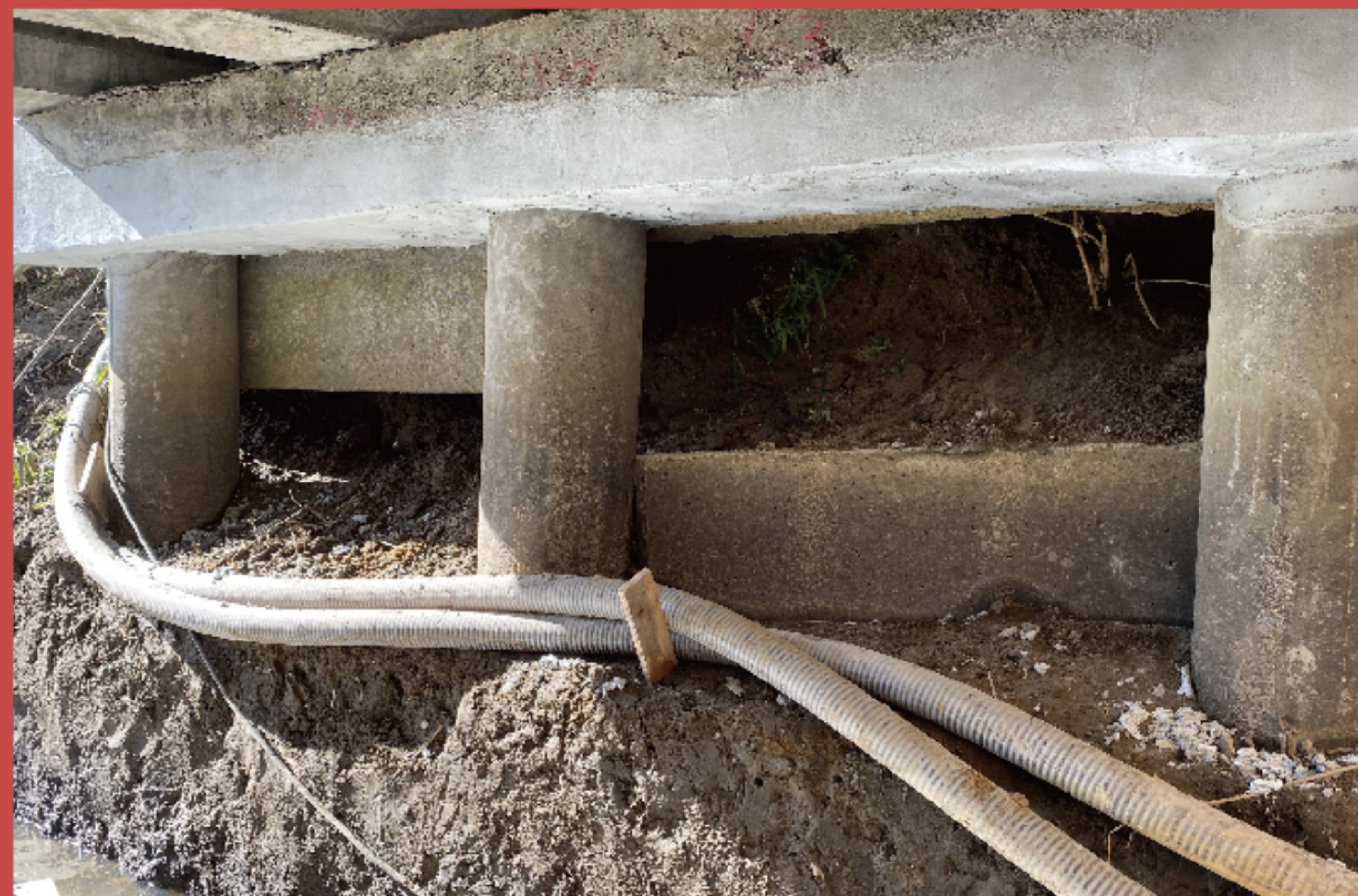
施工前(橋台の損傷、土砂流出)
