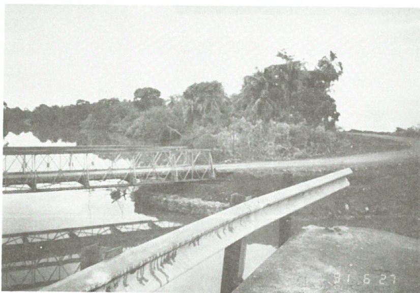
写真4.30 Estero Negro川に架かる 橋の落橋状況 （写真6.21～27参照）
