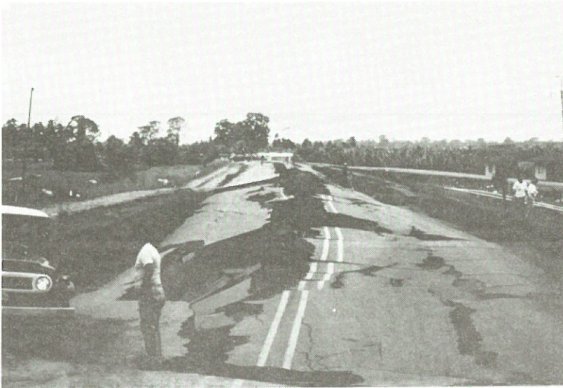
写真4.2 路面の大きなクラック (Mora博士提供)
