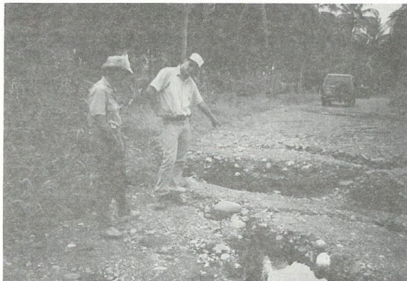
写真4.15 Matina川河口より少し南側での道路の陥没 (写真6.9参照)
