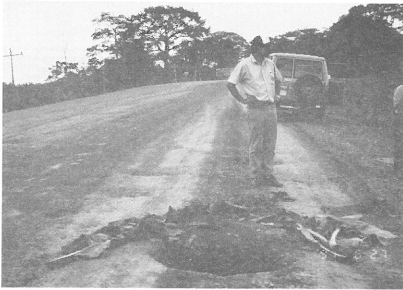
写真6.4 盛り土道路の側方流動による沈下と亀裂に起因する修復後の陥没孔
