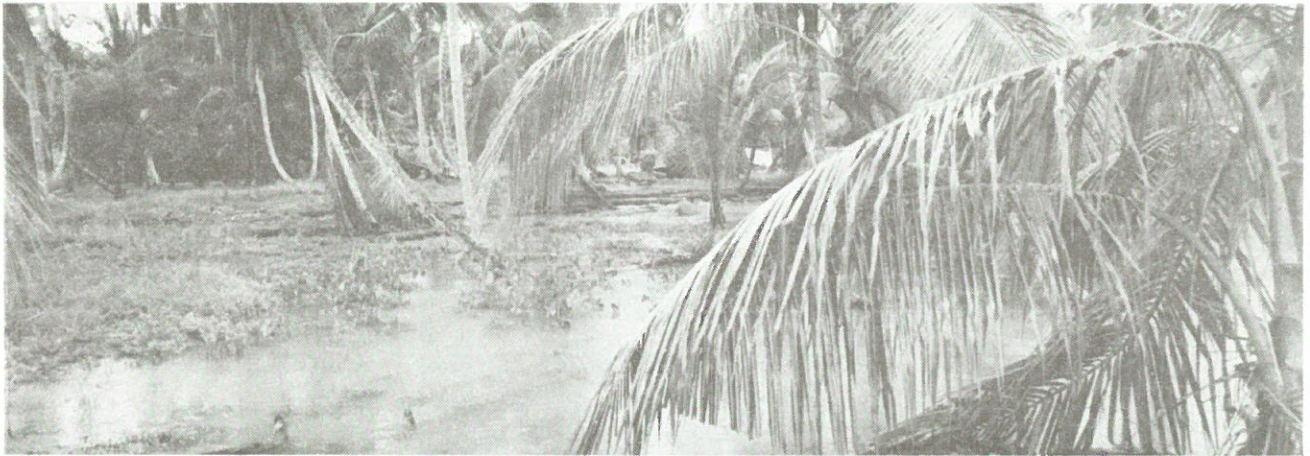
写真4.29 Bananito川右岸に発生したクラック（側方流動を物語る大きなクラックと沈下が見られる）
