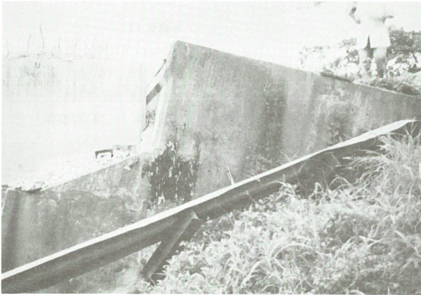
写真6.14 Vizcaya川に架かる橋の 側方流動により傾斜した アバットメント
