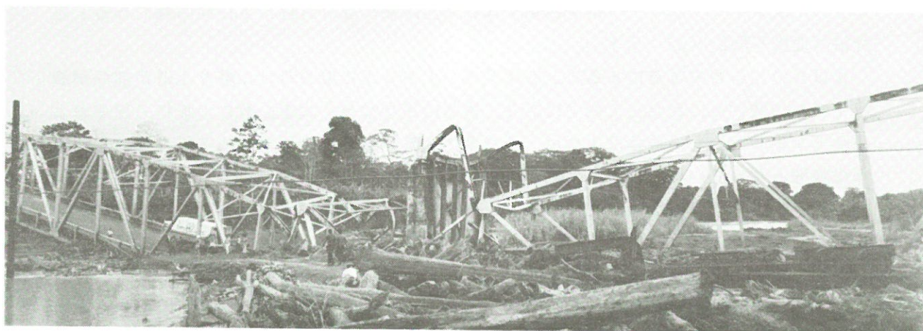
写真6.29 Estrella川に架かる橋の落橋全景
