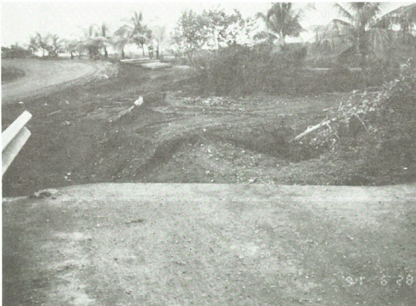
写真6.21 Estero Negro 川に架かる橋の落橋状況
