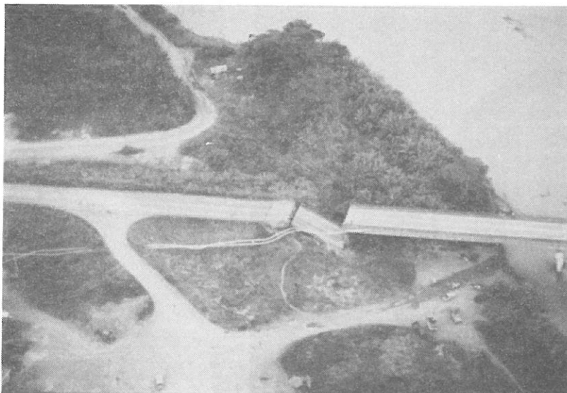
写真6.5 Chirripo Atlantica川に架かる橋の落橋 道路の下の2本の白い線状のものは、MoinとSan Joseを繋いでいる石油のパイプライン （Mora博士提供）
