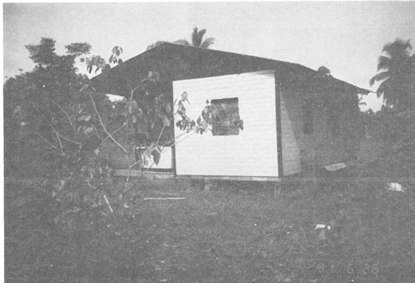
写真4.22 液状化により少し沈下した家屋
