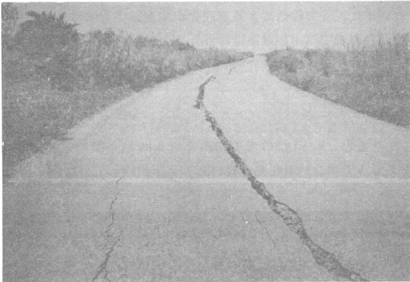
写真6.2 盛り土道路の 側方流動による路面の亀 裂
