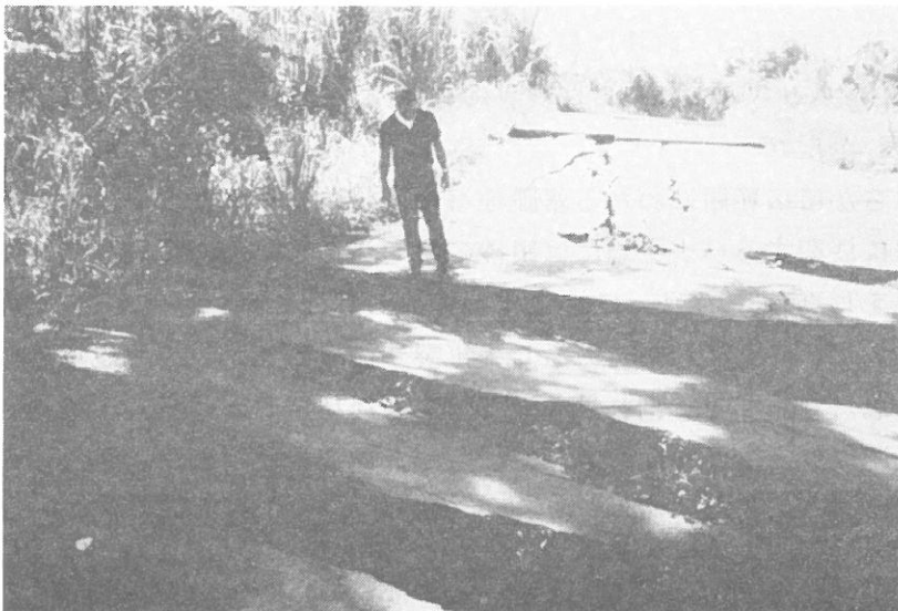
写真6.3 盛り土道路の側方流動に よる路面の断裂
