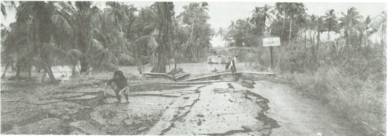
写真4.28 Bananito川に架かる橋の落橋状況（写真6.15～19参照）
