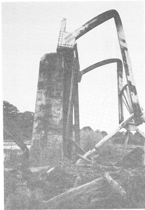
写真6.30 Estrella川に架かる橋の落橋後の 中央橋脚の近景
