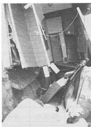
写真9.14 住宅の被害（住宅F。地中ばりの鉄筋が抜け出している）
