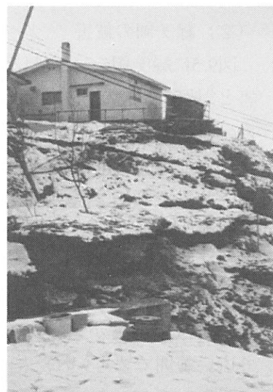
写真9.8 釧路市材木町18番地の斜面崩壊（急傾斜地崩壊危険指定地） (Photo 9.8 Slope Failure at 18 Zaimoku-cho, Kushiro City)
