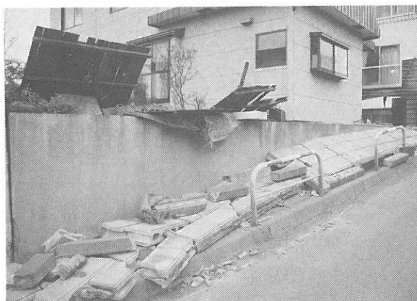
写真9.7 緑ヶ岡地区のブロック塀の倒壊 (Photo 9.7 Collapse of a Concrete Block Wall in Midorigaoka Area)
