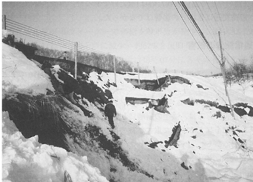
写真10.1 白糠町和天別付近の道路盛土崩壊による光ケーブル切断箇所
