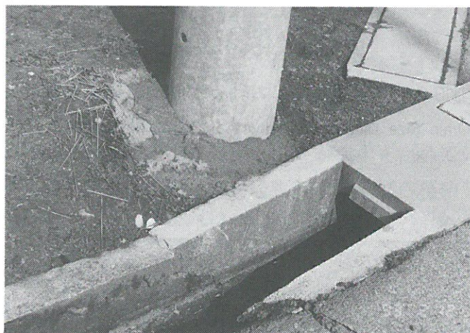
写真3.5 市営住宅周辺の電柱の根元からの噴砂
