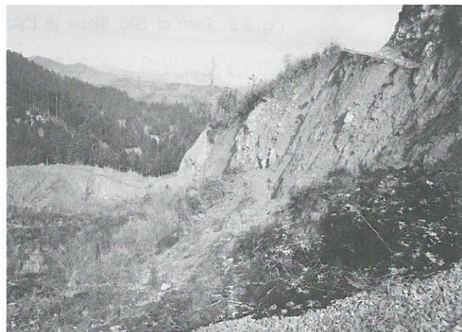
写真3.7 柳田村久田の斜面崩壊状況
