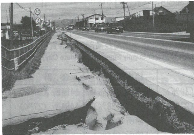
写真10.1 中の沢小学校前の歩道の陥没（長万部町）
