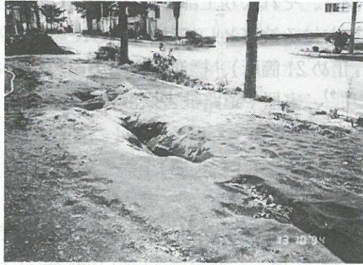
写真 9.1 道道斜里線歩道の被害
