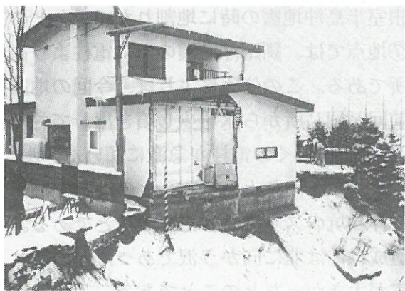
写真 9.1 1993 年釧路沖地震による緑ヶ岡 6-12 の被害
