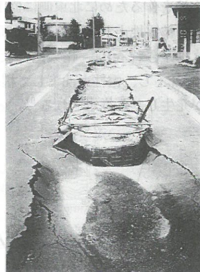
写真 9.9 マンホールの浮き上がり 8) (Photo 9.9 Up-lift of Manholes in Shibetsu)
