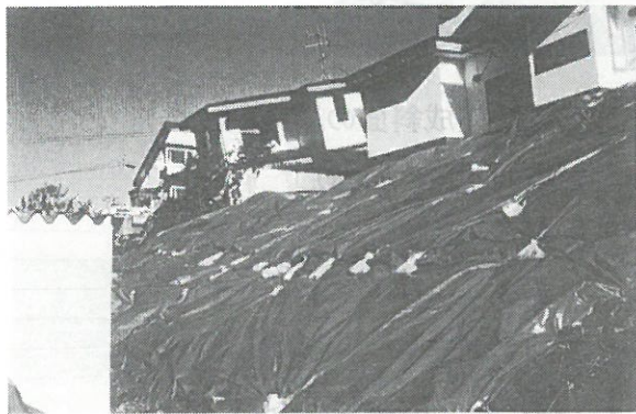
写真 9.10 東 11 条南 6 丁目の斜面崩壊 7) (Photo 9.10 Slope Failure at Site ① in Fig.9.9)
