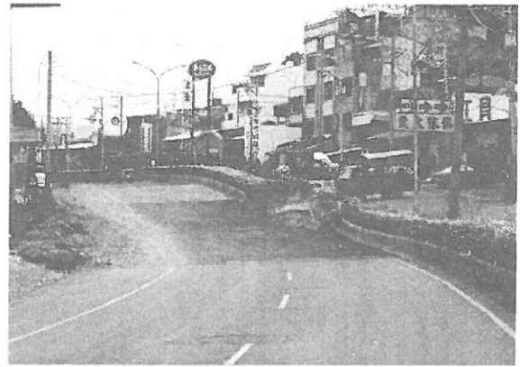
写真 3.1.38 ガス輸送導管の被害地点 (写真奥 200m が烏溪橋)
