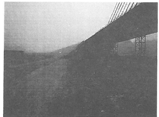
写真 3.2.11-4 集鹿大橋 (主塔から南側 に向って 3 番目の橋脚が西側 にずれている)
