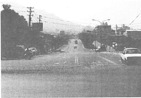
写真 3.1.43 通信管路の被害地点遠景 (草屯鎮公所正門から被害地点を望む)
