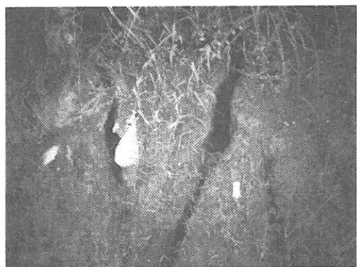
写真 3.2.10-4 名竹大橋（橋梁から 50m ほど離れた河床に亀裂）
