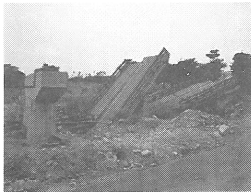
写真 3.2.5-4 一江橋 (2 つの橋脚は完全に崩壊)
