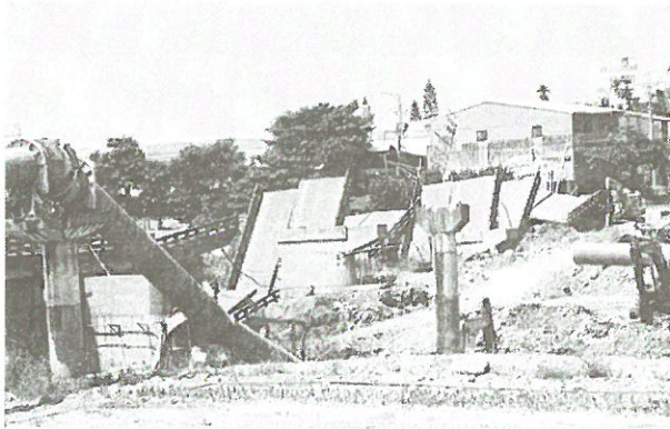
写真 3.1.5 一江橋水管橋の被害状況 (上流側中州から右岸側を望む) (土木学会調査団)
