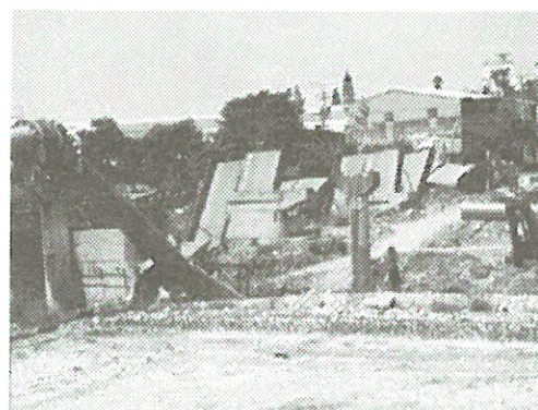
写真 3.2.5-8 一江橋 (一江橋と並行して建設されていた水道管橋は管路が脱落) (3.2.3)
