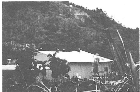
写真 3.1.34 烏溪橋の北東に位置する工場 (断層によって屋根が変形)
