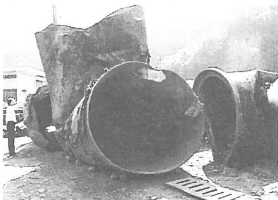
写真 3.1.17 変形した口径 2000mm の送水管 (断層変位によって曲げ変形が発生)
