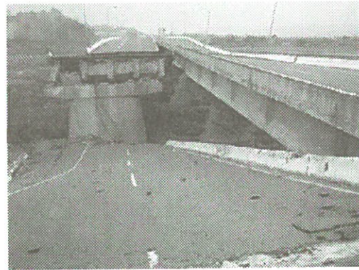
写真3.2.6-2 烏溪橋（上り線の霧峰側の2つの桁が落橋）
