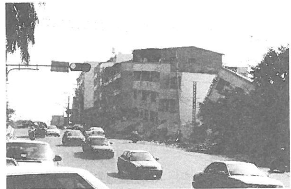
写真 3.1.46 鎮公所前道路の断層変位 (草屯鎮公所正門から望む)
