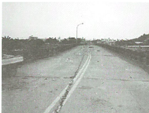
写真 3.2.5-5 一江橋 (太平市側から見たもので、上下、水平に 2~3m の相対変位が見られる)
