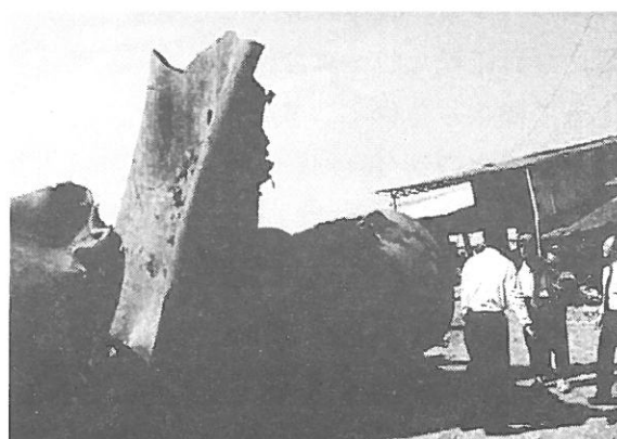
写真 3.1.18 変形した口径 2000mm の送水管 (断層変位によって曲げ変形が発生)
