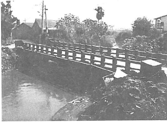
写真 3.1.23 萬崙橋の全景 (液状化によって橋脚が傾斜している)
