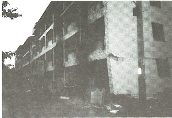
写真-5.2.1 樹人路から見た幸福家園の被害状況
