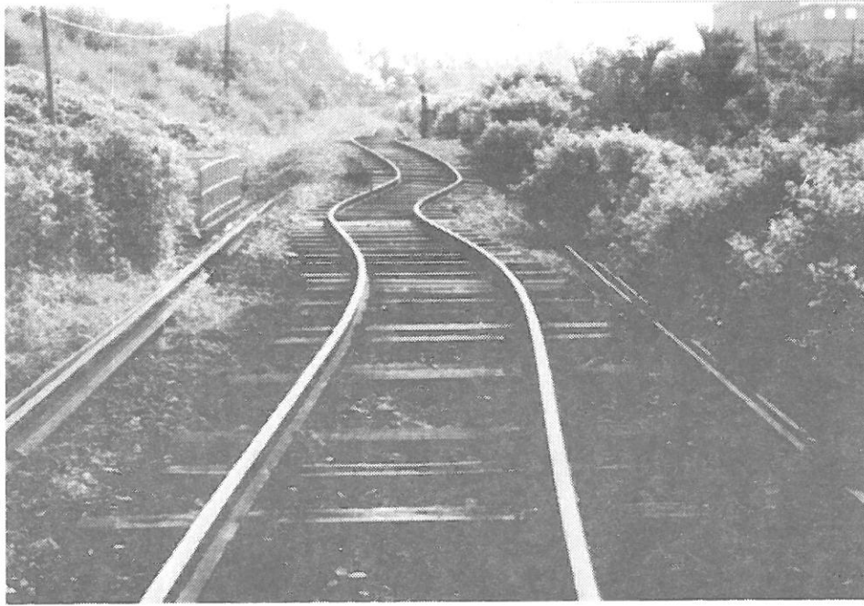
写真-3.3.8 断層上盤側で見られたレールの変形
