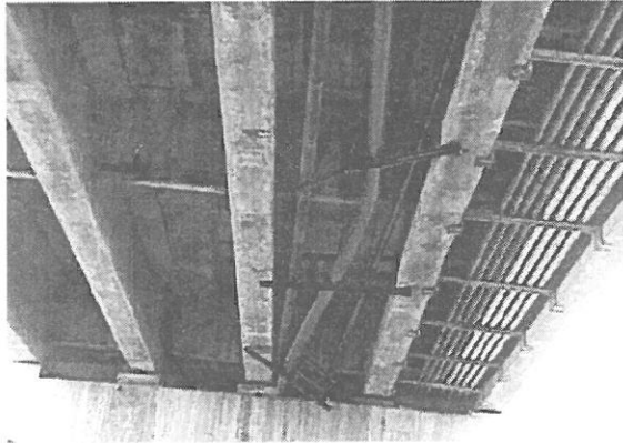
写真 3.1.29 烏溪新橋添架管の変形 (添架ガス管：左から 150,200,100mm) (添架通信管：8 条)
