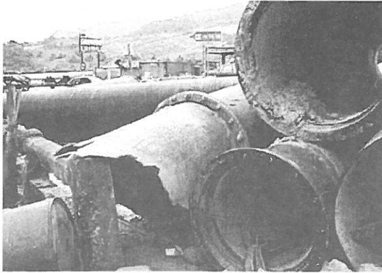
写真 3.1.9 損傷した配水管
