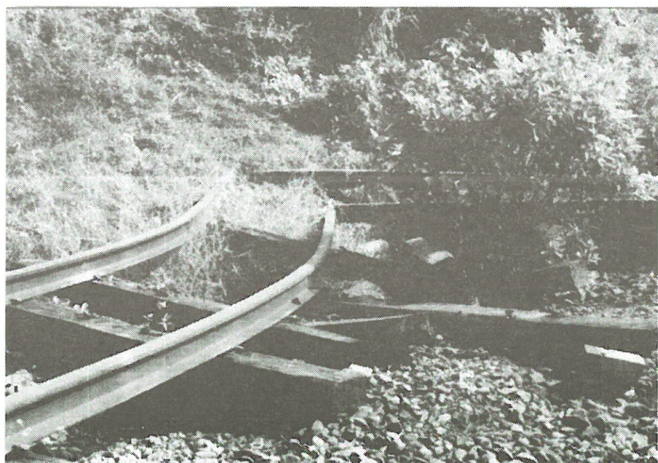
写真-3.3.7 断層上盤側でのレールの座屈
