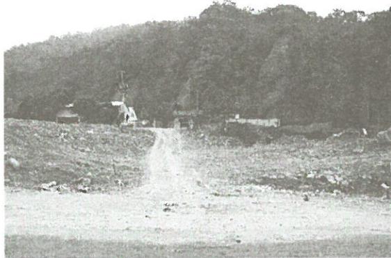
写真 3.1.21 復旧した送水管の被害箇所 (第一浄水場の資材運搬通路)
