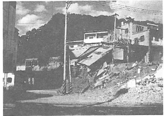
写真 3.1.4 一号橋右岸側の断層変位と被害 (右側が断層の上盤側にあたる)
