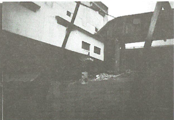
写真-5.2.4 埔里酒廠工場の被害状況
