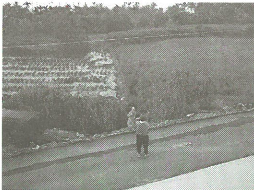
写真 3.2.10-7 名竹大橋 (周辺地盤で 2m の断層変位を確認)
