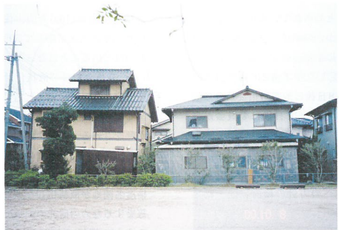
写真1 液状化により不同沈下した家屋
