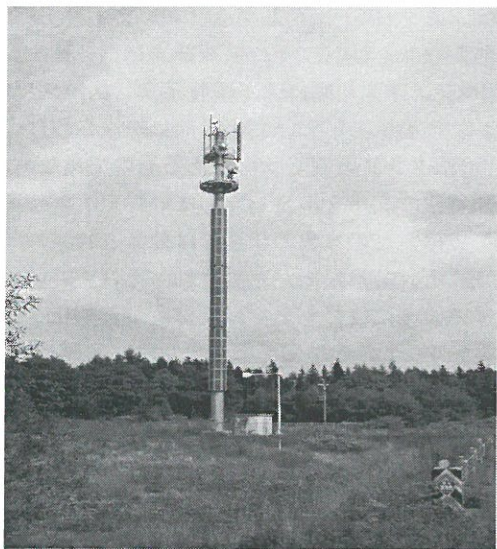
写真-11.3.4 鉄塔・基地局の全景 (基地局・周辺道路の状況)
