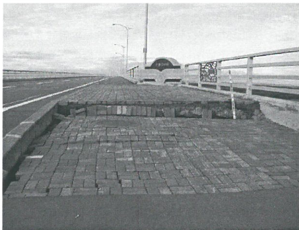
写真-11.3.2 橋梁部分陥没状況
