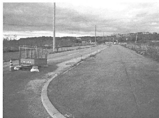
写真-11.1.8 新東陽団地の人孔の浮上がりと道路脇の噴砂
