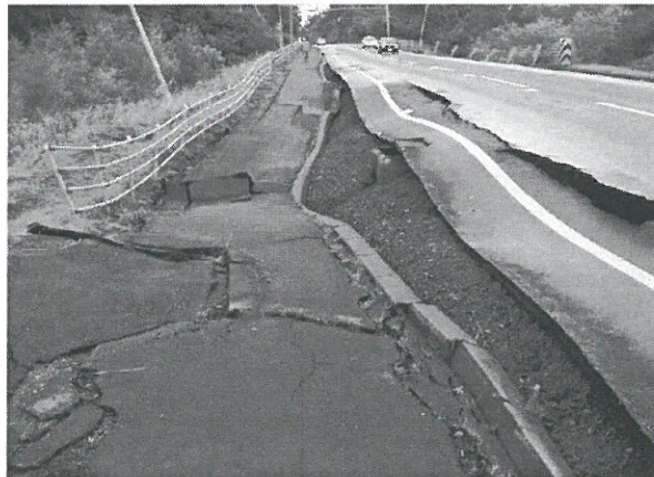
写真-11.3.1 盛土区間の法面崩壊状況
