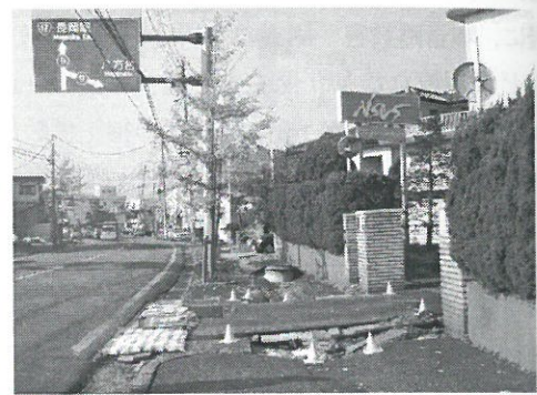
写真-13.10 管路上の路面に生じた陥没 (長岡市)
