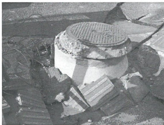
写真-13.12 浮上がった人孔とその周囲
