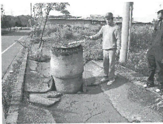
写真-13.14 若葉町の突出したマンホール
