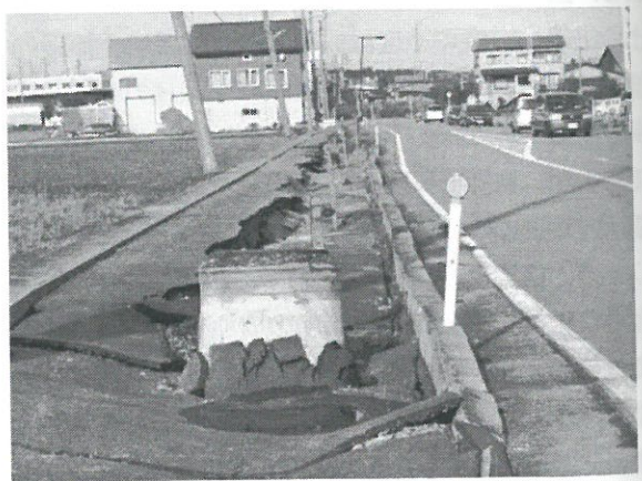
写真-13.15 桜町の被害の様子
