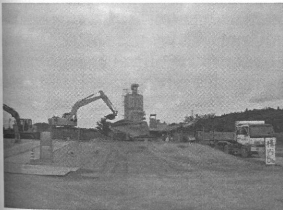
写真-13.18 下水道の復旧にあたって長岡市で建設された発生土改良プラント
