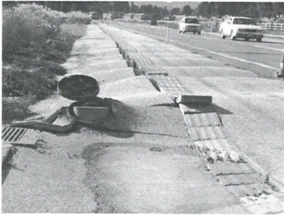
写真-13.16 人孔の浮上がり被害 (掘地区) 22)
