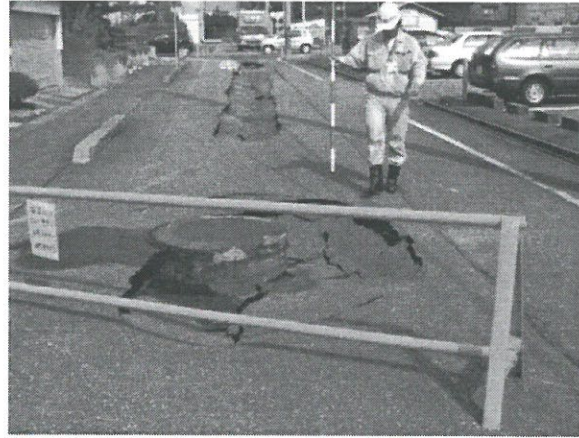
写真-13.17 埋戻し部の沈下 (田中地区) 22)
