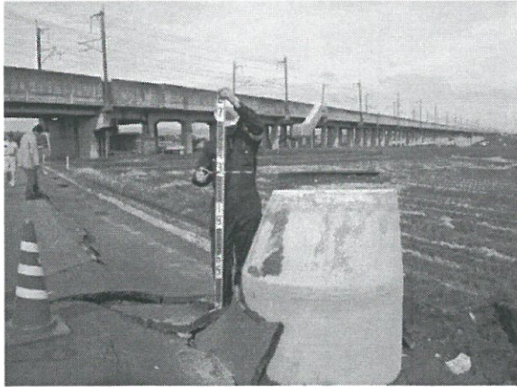
写真-13.13 長岡市村松地区の人孔被害
