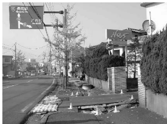
写真-2 管路上の道路の陥没 (長岡市)
