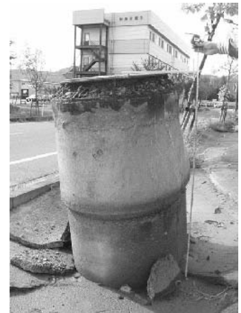
写真-3 若葉地区(図-1中のA地点)で1mほど浮上がったマンホール
