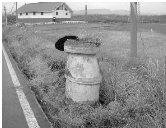
写真-1 大きく浮上がったマンホール (小千谷市)
