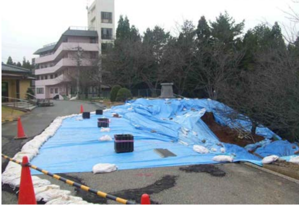
穴水の造成盛土の崩壊（老人ホーム）
