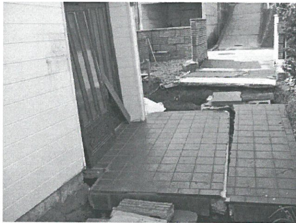
写真 3.7.7-2 宅地内に生じた段差 (図 3.7.7-2 の Photo(B)) (写真 3.7.2-2 の家屋の別アングル)
