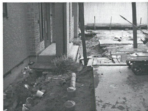
写真 3.7.2-3 開口部を生じさせ移動した家屋（北側地域中段、写真 3.2.6-1 のサウンディング地点④）
