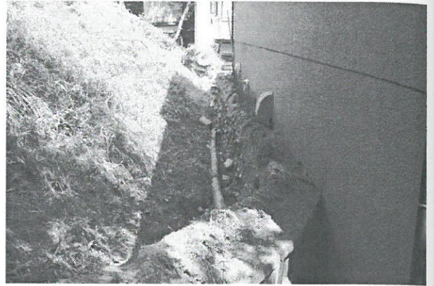
写真 3.7.8-1 a 宅の背面に衝突した擁壁
