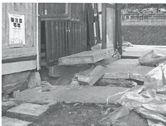
写真 3.7.7-3 宅地内に生じた段差 (図 3.7.7-2 の Photo(C))
