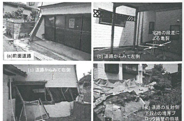
写真 3.7.8-2 家屋下を過った滑落崖被害 (c 宅)
