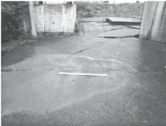
写真 3.8.1-3 道路上に残る噴砂（旧河道以外）
