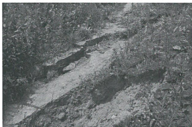
写真 3.7.8-5 h 宅と向かいの砂丘斜面の亀裂
