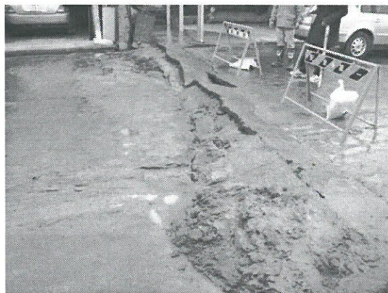
写真 3.8.1-5 道路の盛り上がりと噴砂痕
