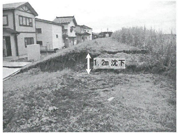
写真 3.8.1-6 鯖石川新河道堤防の沈下（柏崎地域振興局提供）
